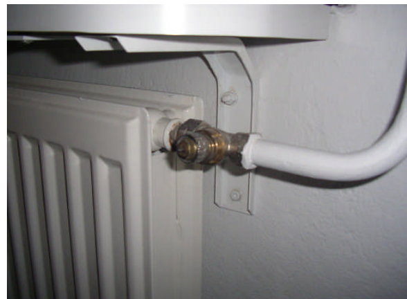
Patteriventtiileistä oli termostaattiosia irti.
