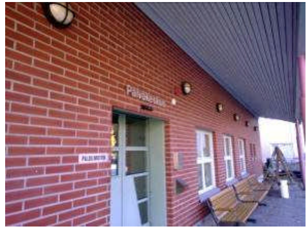
Rakenteisiin asennettuja valaisimia.
