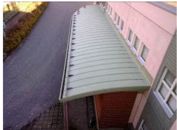
Katoksen kourussa on sulanapitokaapeli.
