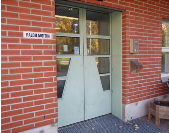
Metalliset sisäänkäynnin ulko-ovet, sähkökäyttö. Ovi on kunnossa.
