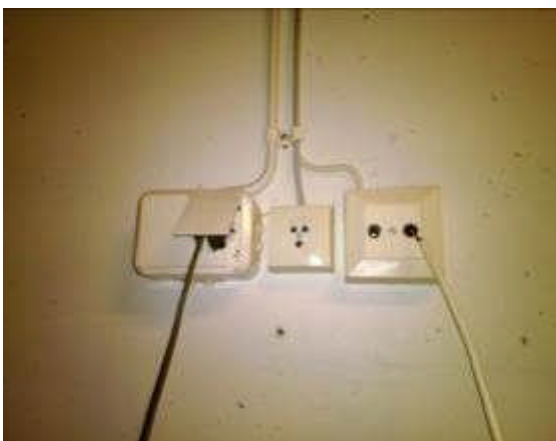
Sähkökalusteita teknisissä tiloissa.
