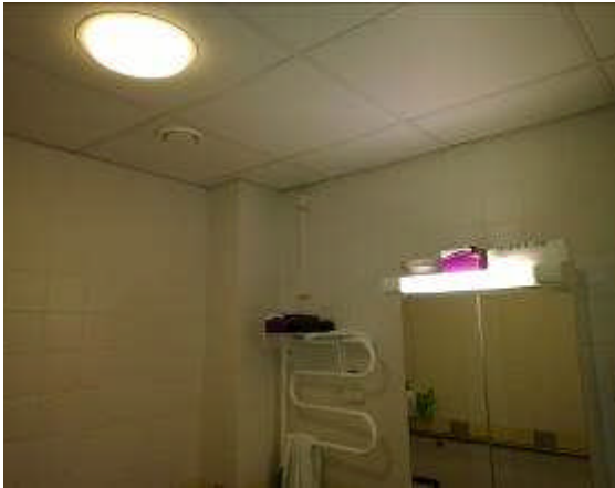
Huoneiston pesuhuoneen valaisimia.
