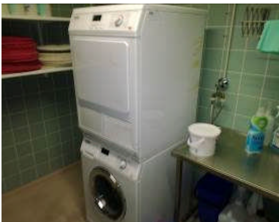
Pyykinpesukone ja kuivausrumpu.
