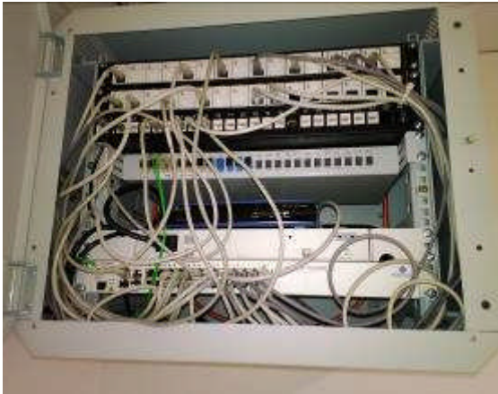
Uusittu/ lisätty kerrosjakamo.
