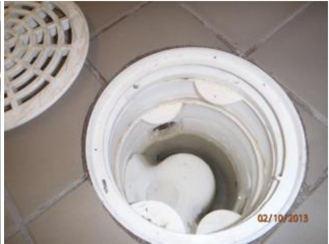
kuva 17 Lattiakaivot ovat muovisia.
