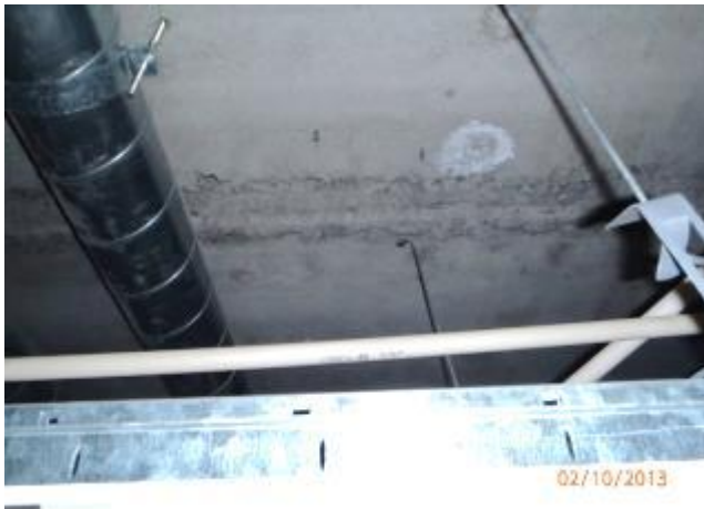
kuva 15 Ontelolaattojen saumoissa on todennäköisesti vanhoja kosteusjälkiä.
