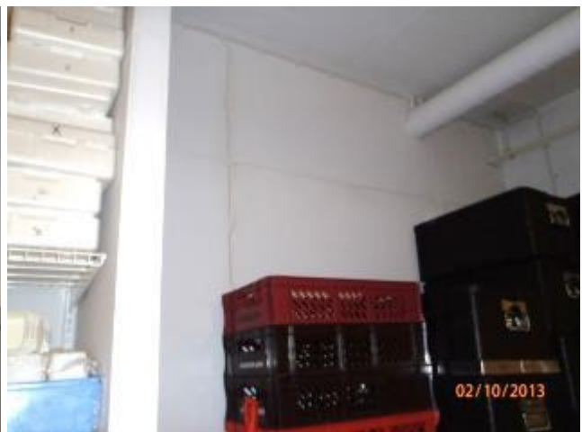
kuva 6 ...paljon halkeamia levyjen saumakohtissa.
