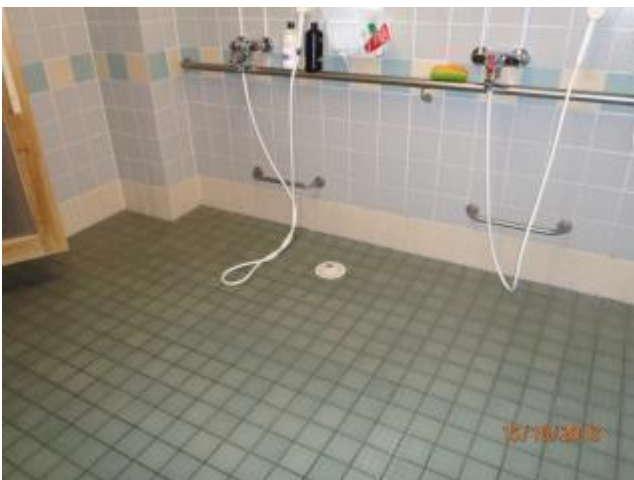
kuva 20 Pesuhuoneiden D218 ja D118 suihkuseinän...
