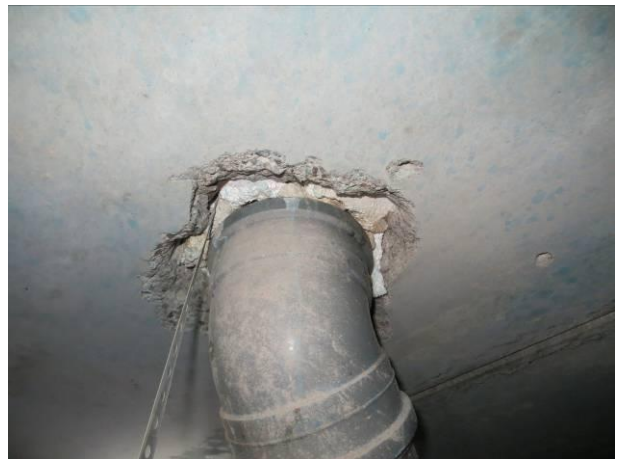
Kuva 26 Alapinnastaan epätiivis viemäriläpivienti.
