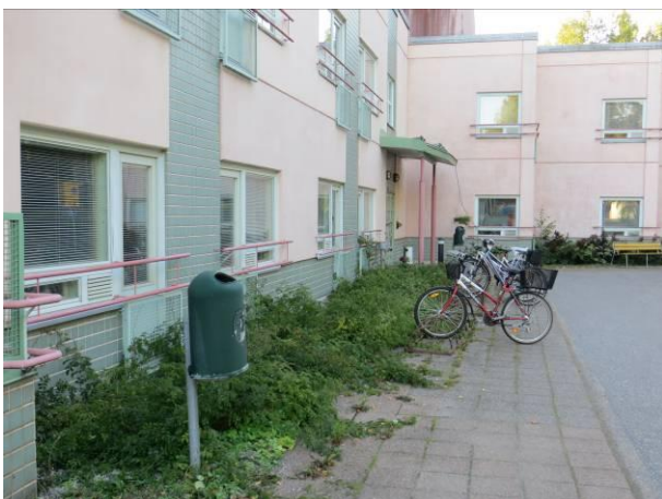
Kuva 5 C-osan itäisivua, jossa seinävierillä on painumia.
