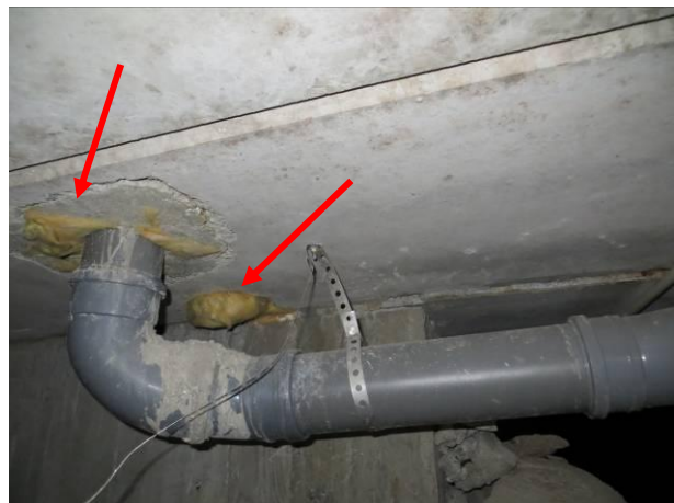
Kuva 30 Epätiivis läpivienti ja reikä.
