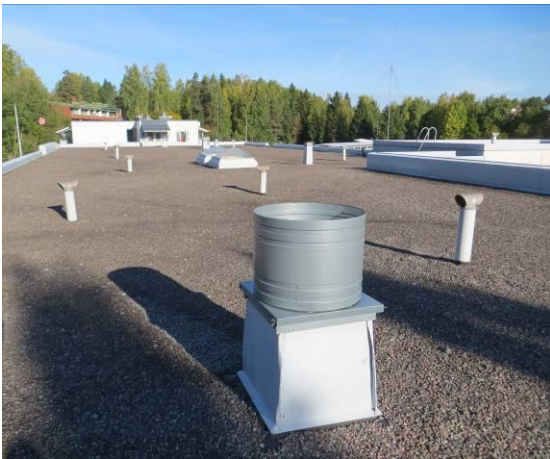
Kuva 7 Alustatilojen poistoilmapuhallin C-osan vesikatolla.
