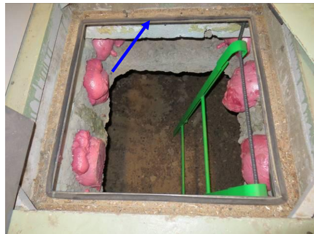
Kuva 10 Kulkuluukun tiivistys on välikannen kehyksessä. Tiivistetyt ontelolaattojen päät, viimeistelemätön kulkuaukko.
