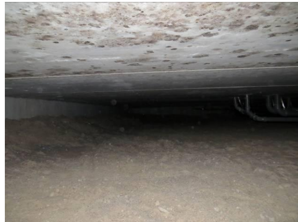
Kuva 28 Itäsivu lohossa 7, katossa vanhaa mikrobikasvustoa, hiekan pinta on kova.
