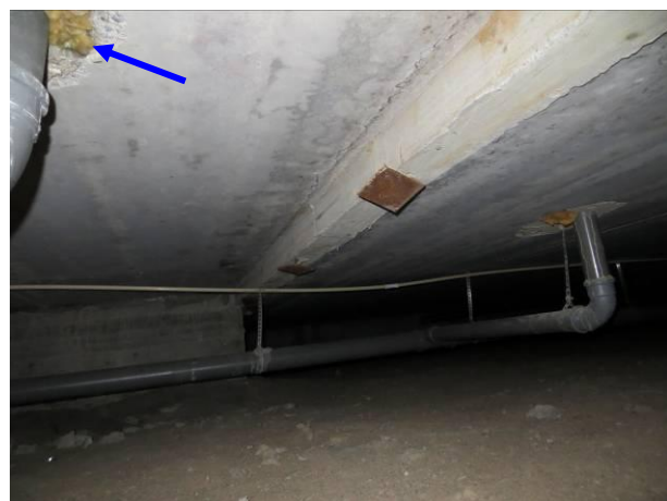
Kuva 14 Tasoerokohta 265/ 400 mm ontelojen rajalla, epätiivis viemärläpivienti.
