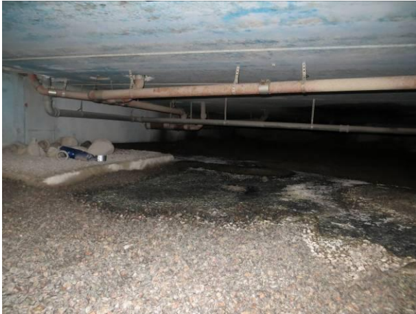
Kuva 23 Viemäriletettä ja ruostepilkkuisia valu- rautaviemäreitä.
