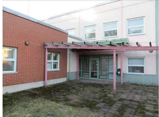
Kuva 2 A- ja B-osan kulmaus länsisivulla, jossa on tapahtunut veden lammikoitumista.
