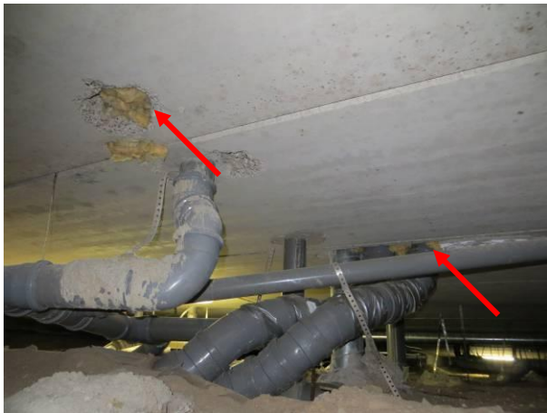
Kuva 41 Epätiivittä läpivientejä ja muita reikiä.
