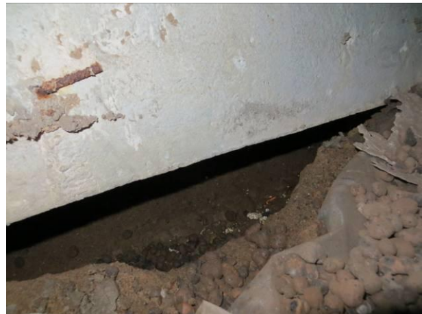
Kuva 18 Sokkelipalkin vierellä painuma, vastatäyttö puuttuu.
