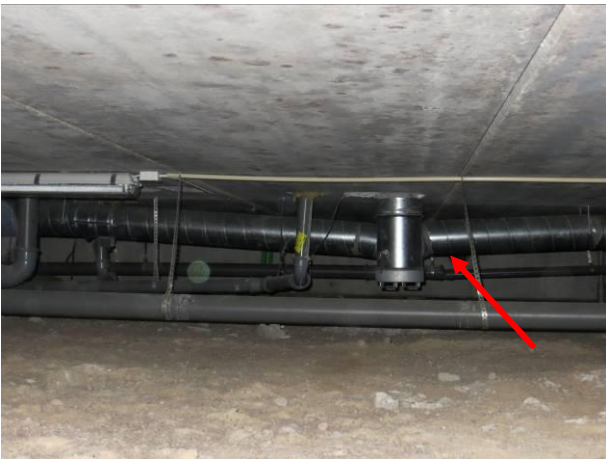
Kuva 27 C-osan alueelta vesikatolle nouseva poistokanava.
