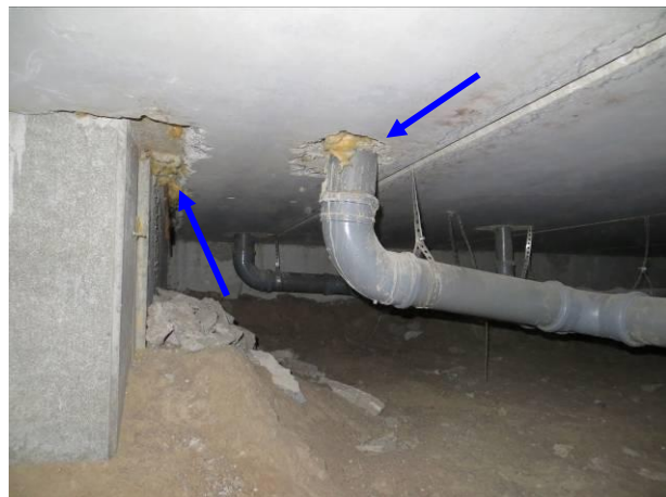
Kuva 12 Epätiiviltä vaikuttavia kohtia.
