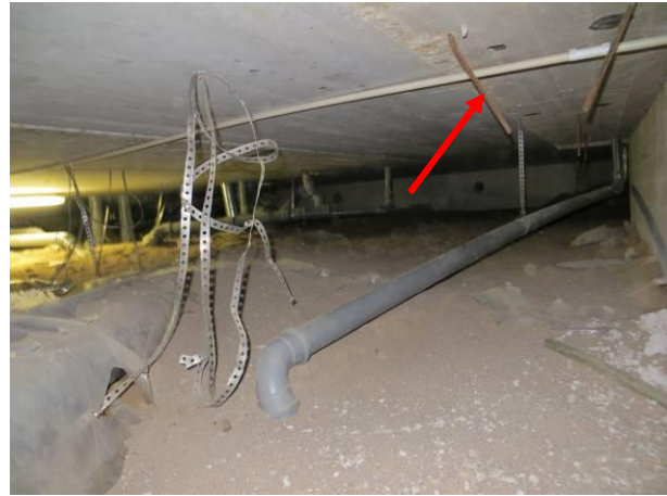
Kuva 40 Törröttäviä teräksiä katossa, löysä viemärikannakointi voi olla riittämätön.
