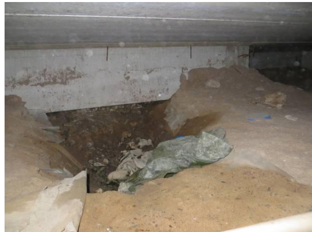
Kuva 38 Kunnostuksen aikainen kostea kaivanto sokkelin vierellä, vastatäyttö puuttuu.
