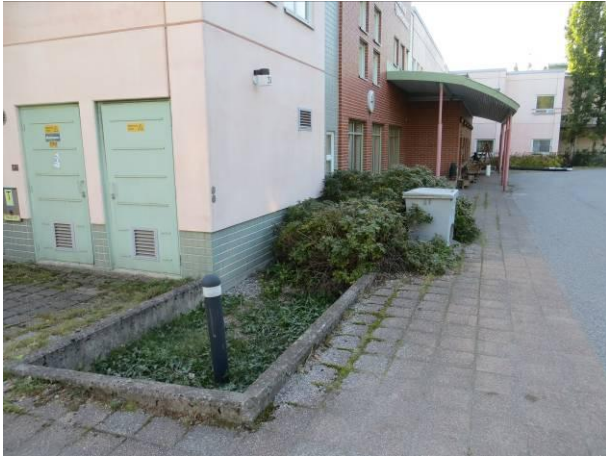
Kuva 1 A-osan länsisivua, vettä keräävä potero seinän vierellä.
