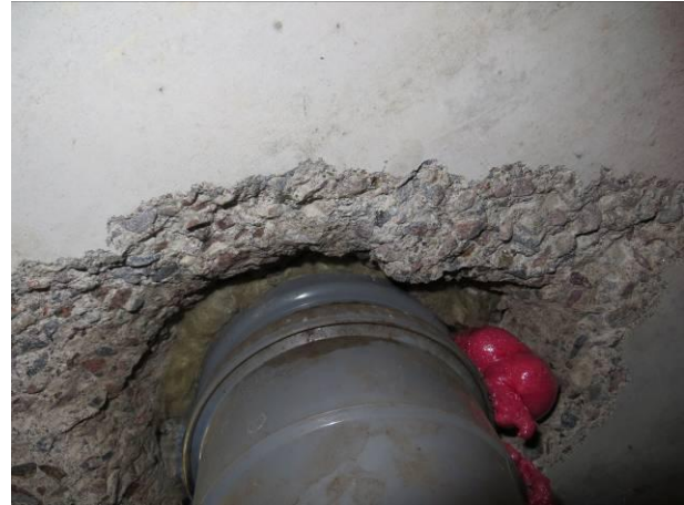
Kuva 20 Tiivistäminen on jäänyt vaiheeseen.
