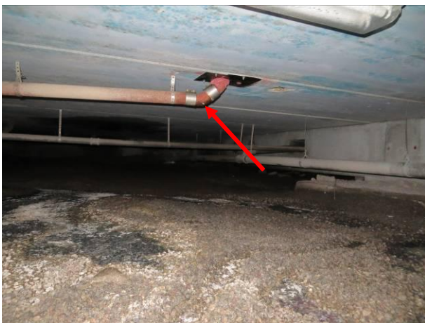
Kuva 21 Viemäri-lietettä maassa 2.10.13. Viemärimutkassa on vuotoa.
