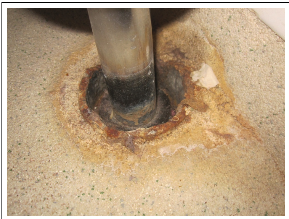
Kuva 20. Pesualtaan viemärin läpivienti, jonka ympärillä tummentumaa
