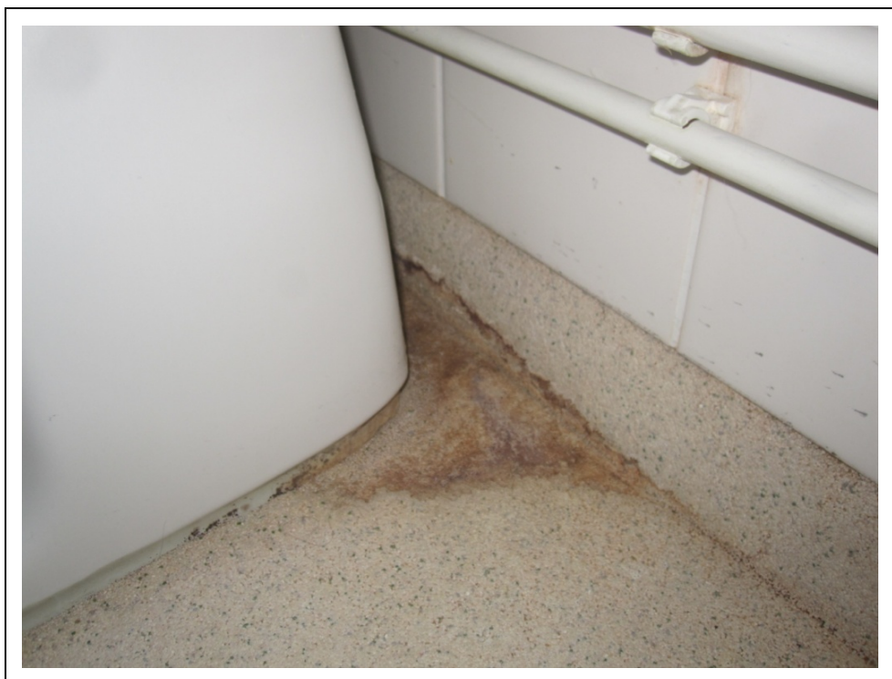
Kuva 11. Kosteuden aiheuttama jälki WC-istuimen takana, syynä puutteellinen lattian kallistus sekä puhdistus .
