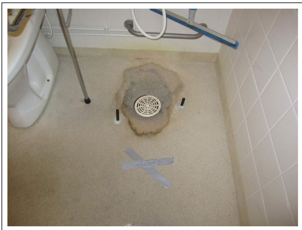
Kuva 7. Vaurioalue lattiakaivon ympärillä (C209)
