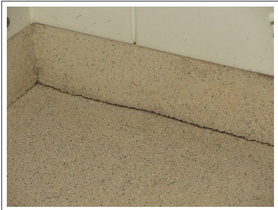
Kuva 8. Halkeama lattian ja seinän liitoksessa
