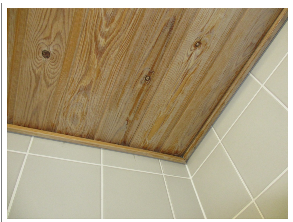
Kuva 20. Katon paneelien yleistä kulumaa
