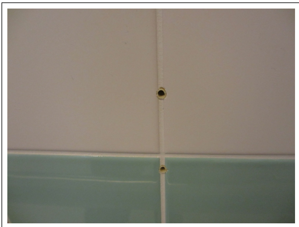
Kuva 15. Paikkaamattomia vanhan kiinnityksen läpivientejä
