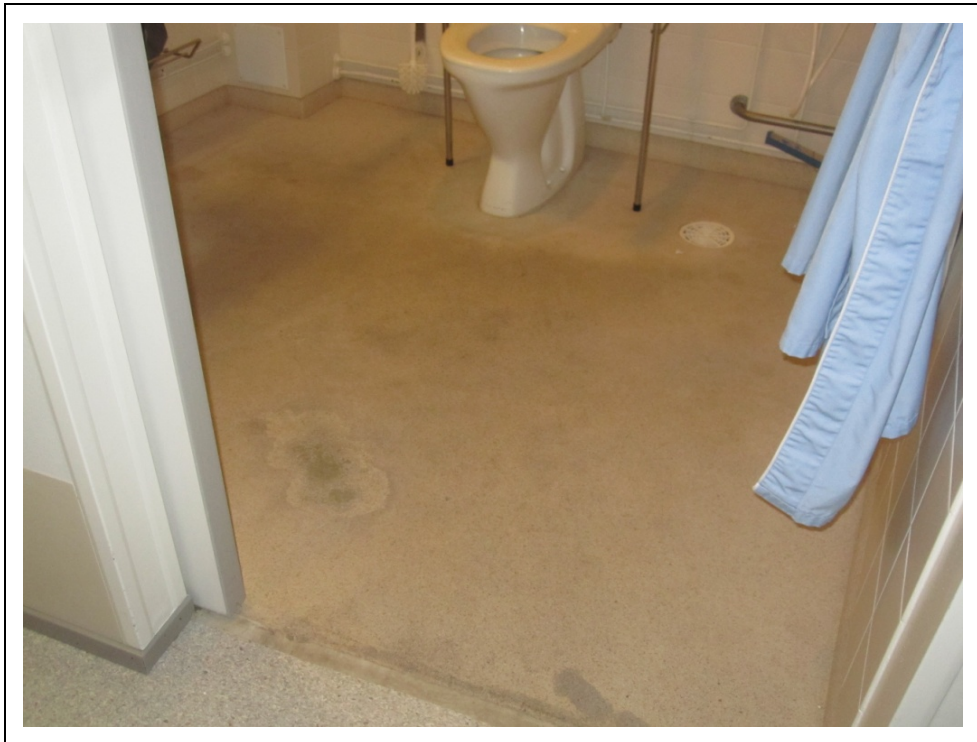
Kuva 9. Lattian pinnoitteen (vedeneriste) kulumaa paikoin betoniin saakka
