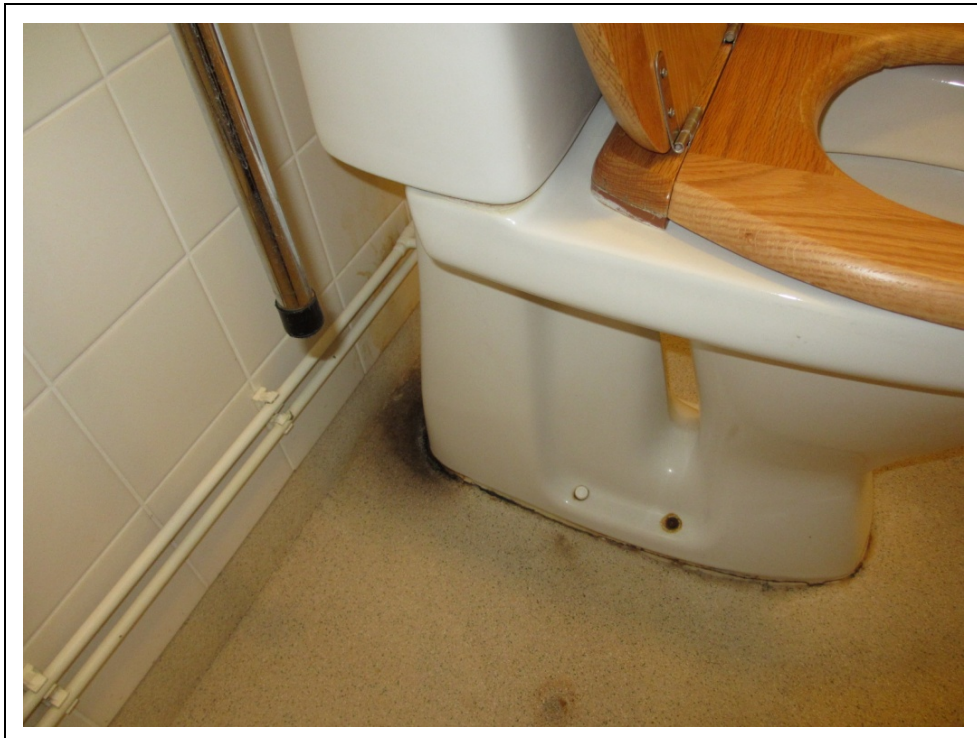
Kuva 10. WC-istuimen takana voimakas tummentuma. Vastaavanlaisilta alueilta otettiin näytteet mikrobianalysejä varten.
