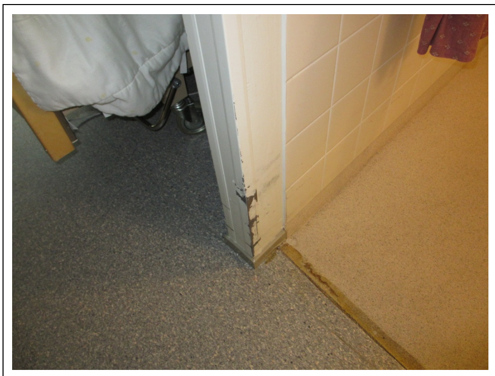
Kuva 17. Ovenkarmissa maalivaurio ja kynnyks irrotettu, sauma kohta avoin
