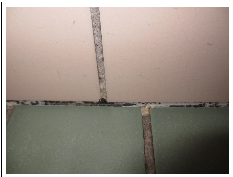
Kuva 19. Saumojen tummentumaa ja mikrobivaurio
