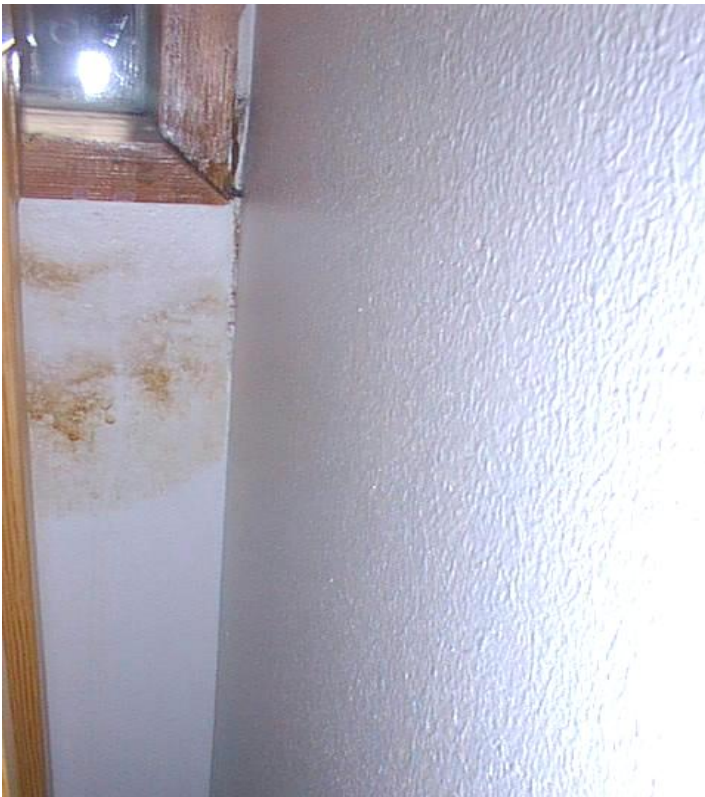
Kuva 1. Pohjoissiiven käytäväseinän ikkunan alla vanha kosteusvaurio korjaamatta.
