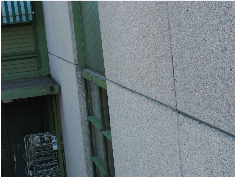
Kuva 1. Julkisivu etelään. Elementtien nurkissa on havaittavissa lohkeamia.
