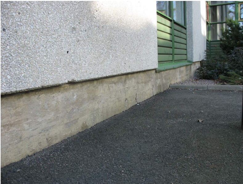
Kuva 9. Näytteenotto kohta näytteille SO 3 ja SO 4. Raudoitteita on monin paikoin sokkelin pinnassa.
