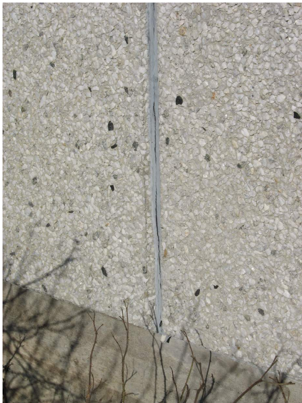
Kuva 6. Eteläisivun saumaukset ovat pääosin kuvan mukaisessa kunnossa. Elementtien saumaukset on vaihdettavassa kunnossa kaikilta osin.
