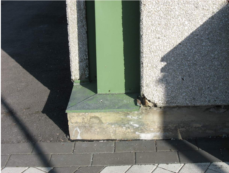
Kuva 3. Eteläsivun alanurkassa törmäysvaurio.
