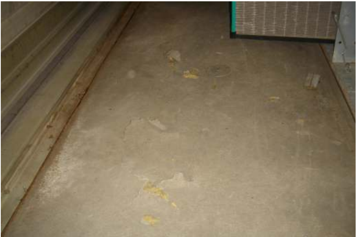
KUVA 14. Tuloilmakoneen kammiot on eristetty villaeristein, joka on paikoin rikki.
