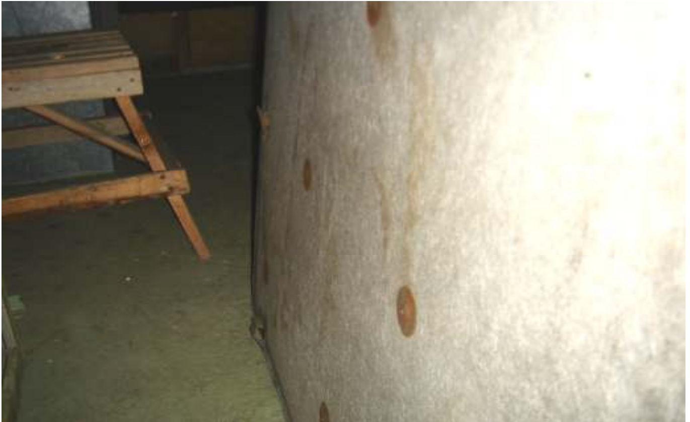
KUVA 5. Tuloilmakoneen kammiot on eristetty mineraalivillalla.
