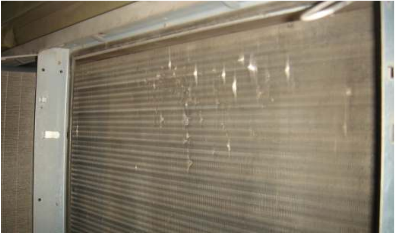
KUVA 7. Lämpöpatteri on hieman pölyinen ja patterissa on muutama kolhu.
