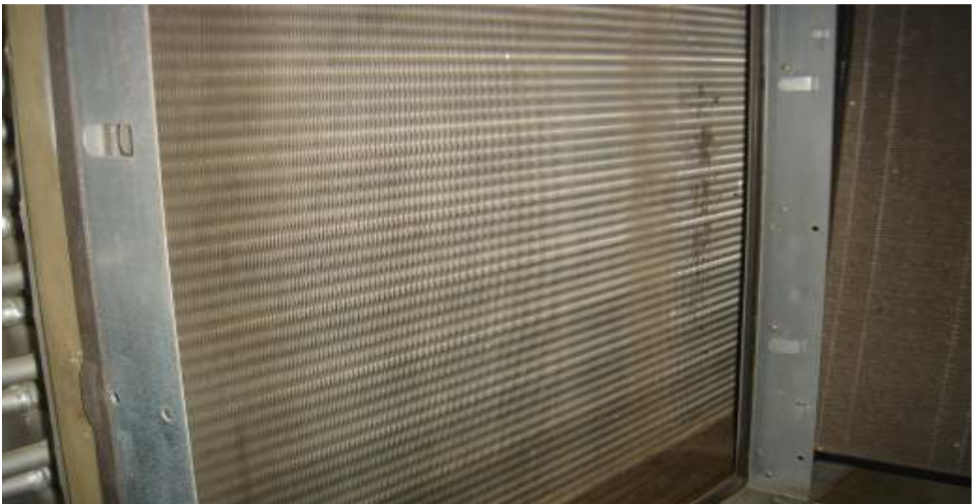
KUVA 2. Lämmityspatteri on hieman pölyinen.
