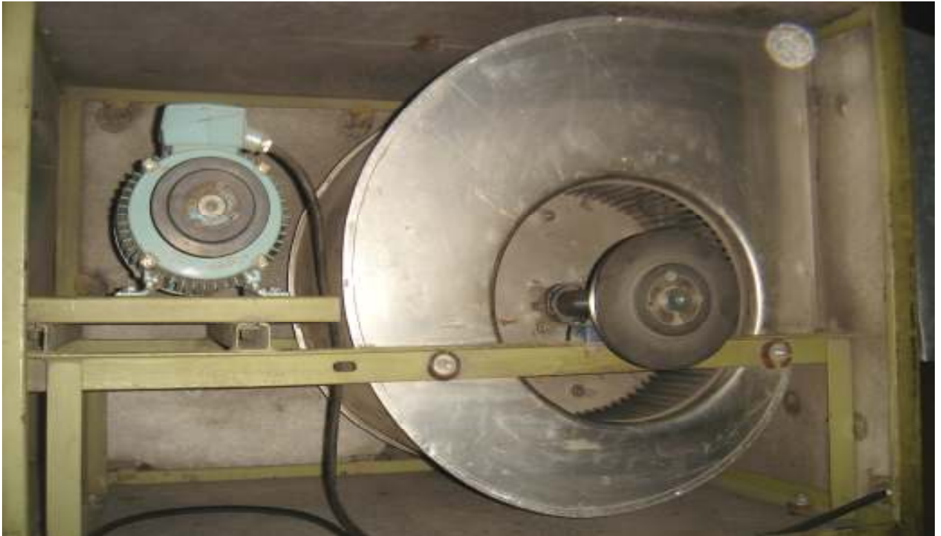
KUVA 13. Tulo- ja poistoilmapuhaltimien kumityynyt ovat osin huonossa kunnossa.
