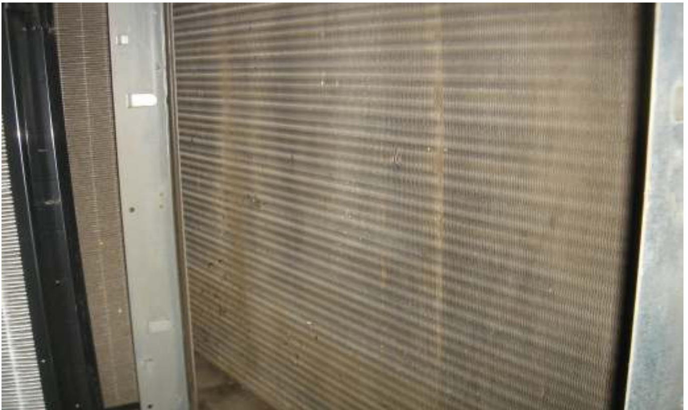
KUVA 10. Lämmityspatteri on hieman pölyinen.
