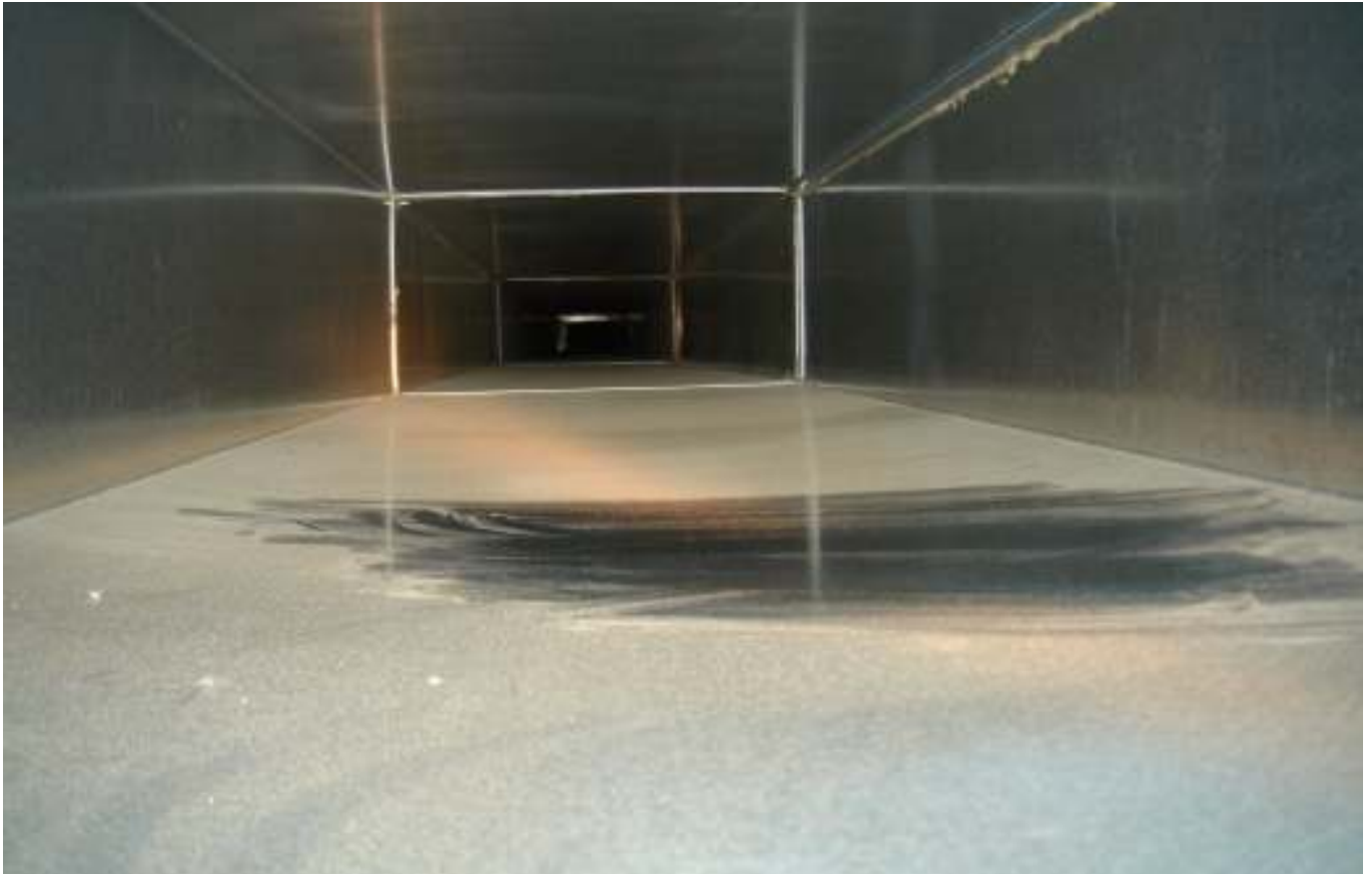
KUVA 25. Yleiskuva ryhmätyöhuoneen n:o 226 L tuloilmakanavasta.
