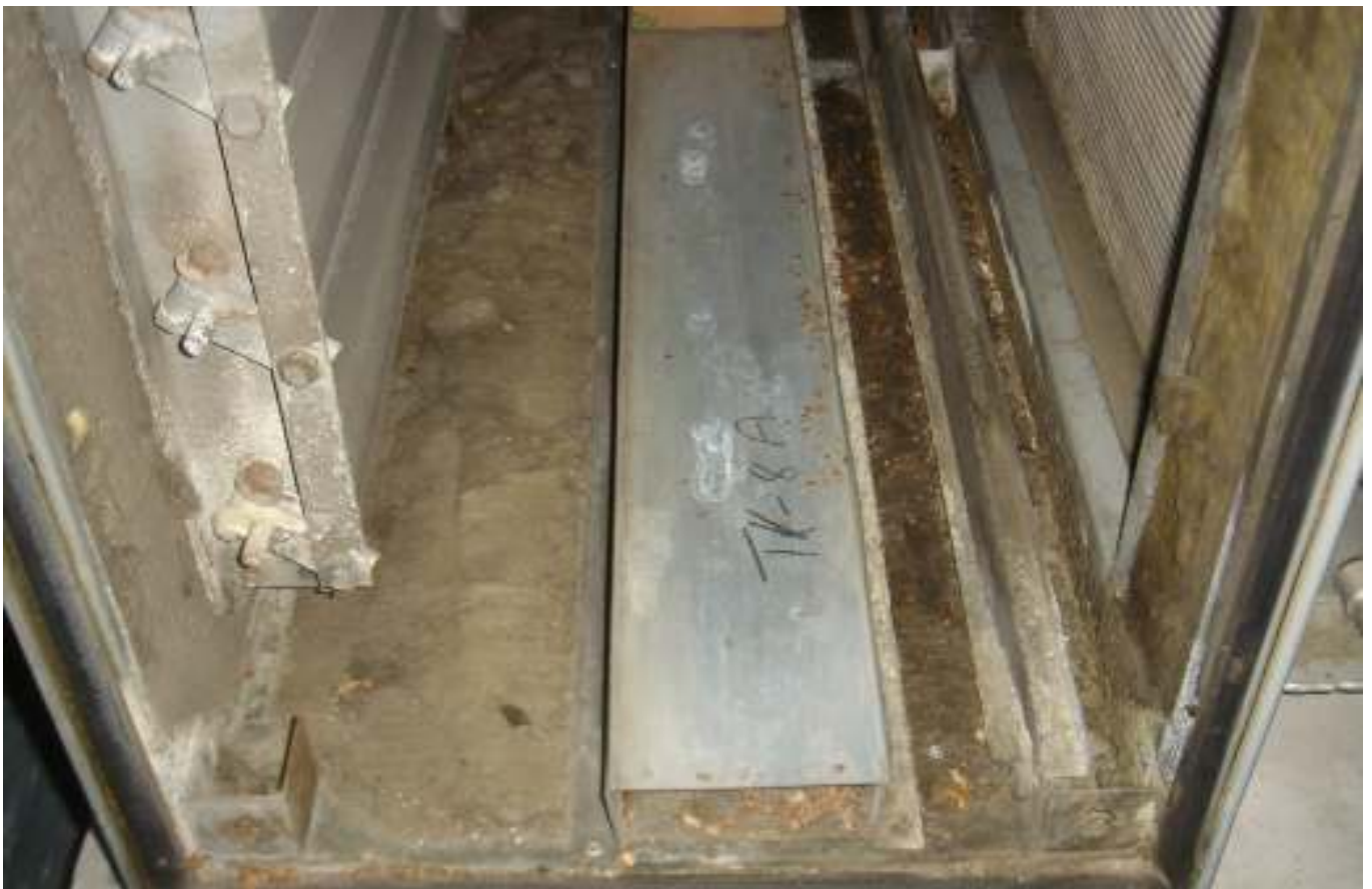
KUVA 22. Tuloilmakoneen kammioissa on roskaa ja pölykertymää.
