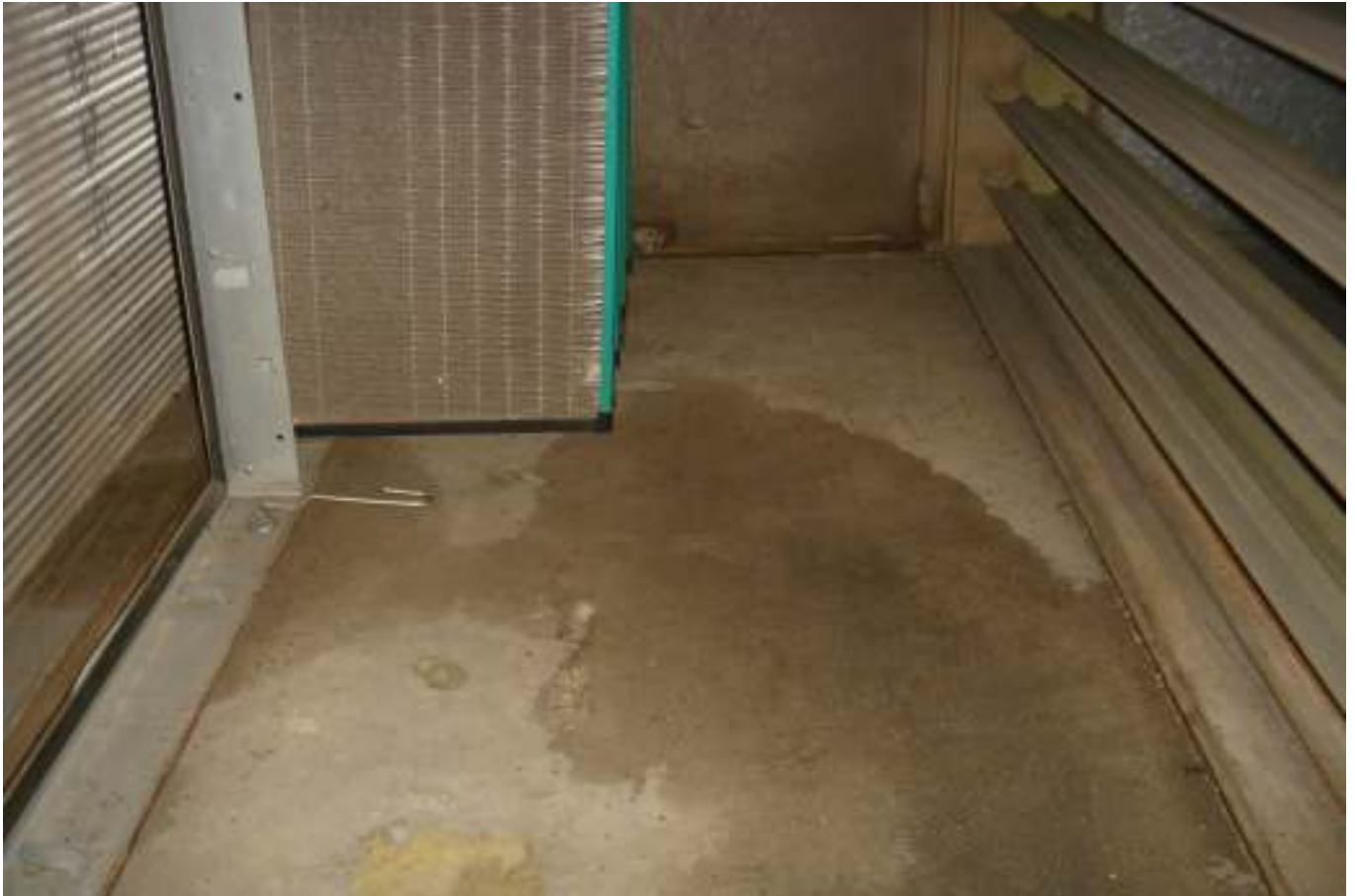
KUVA 1. Yleiskuva LIK 1 kammiosta ja suodattimista.
