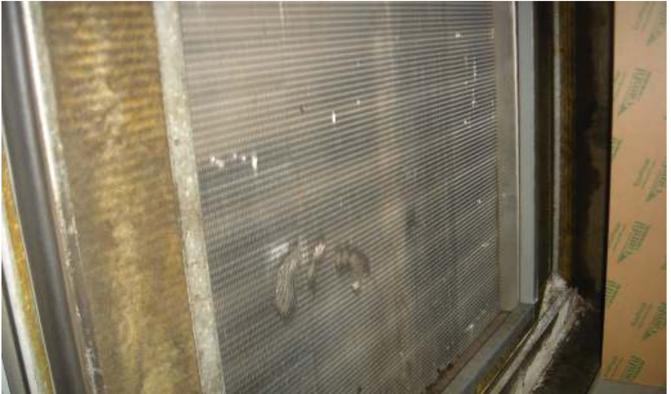
KUVA 21. Lämmityspatteri on hieman pölyinen ja patterissa on muutama kolhu.
