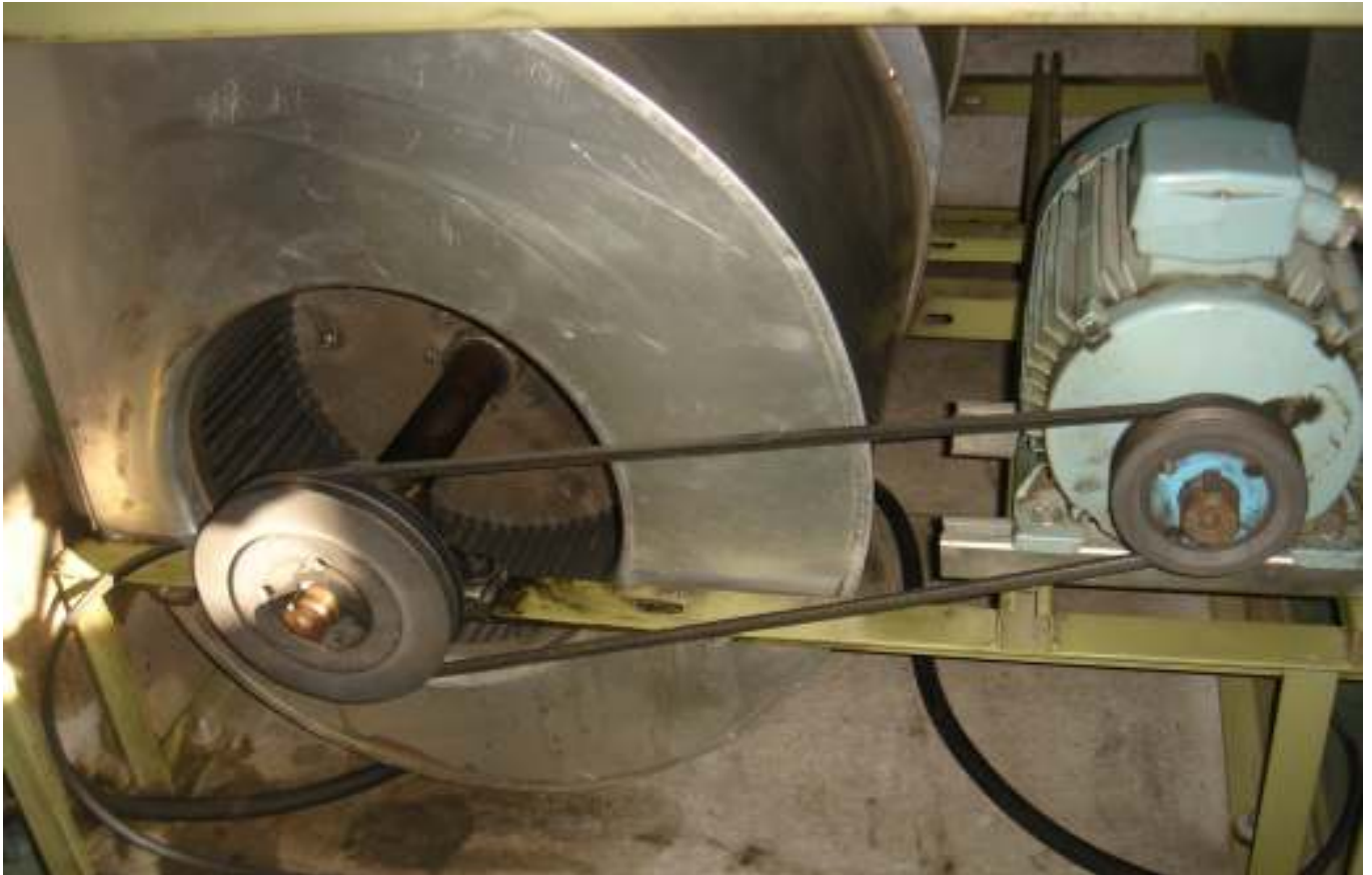
KUVA 3. Tuloilmapuhaltimen toinen hihna on poikki.
