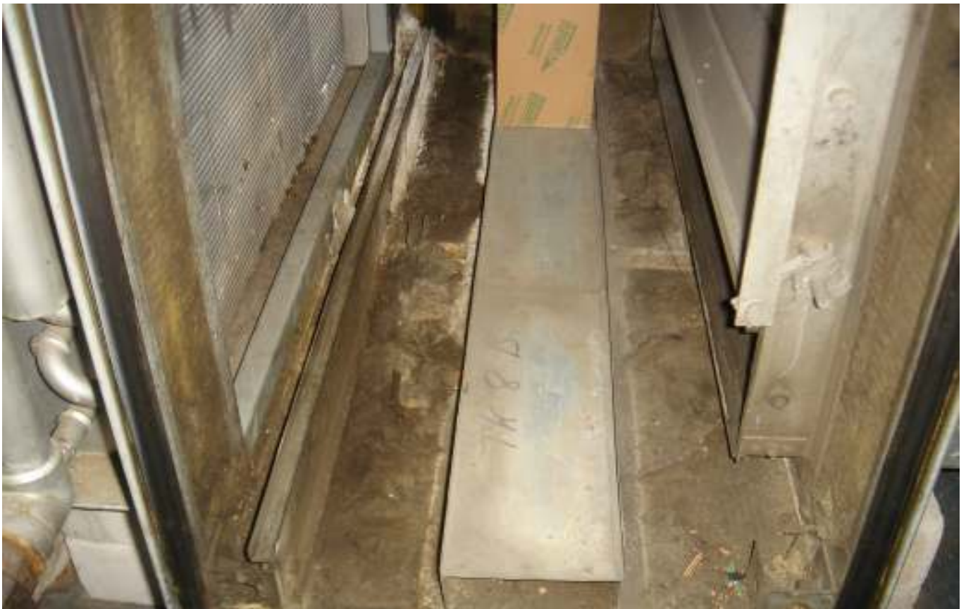
KUVA 20. Tuloilmakoneen kammioissa on roskaa ja pölykertymää.
