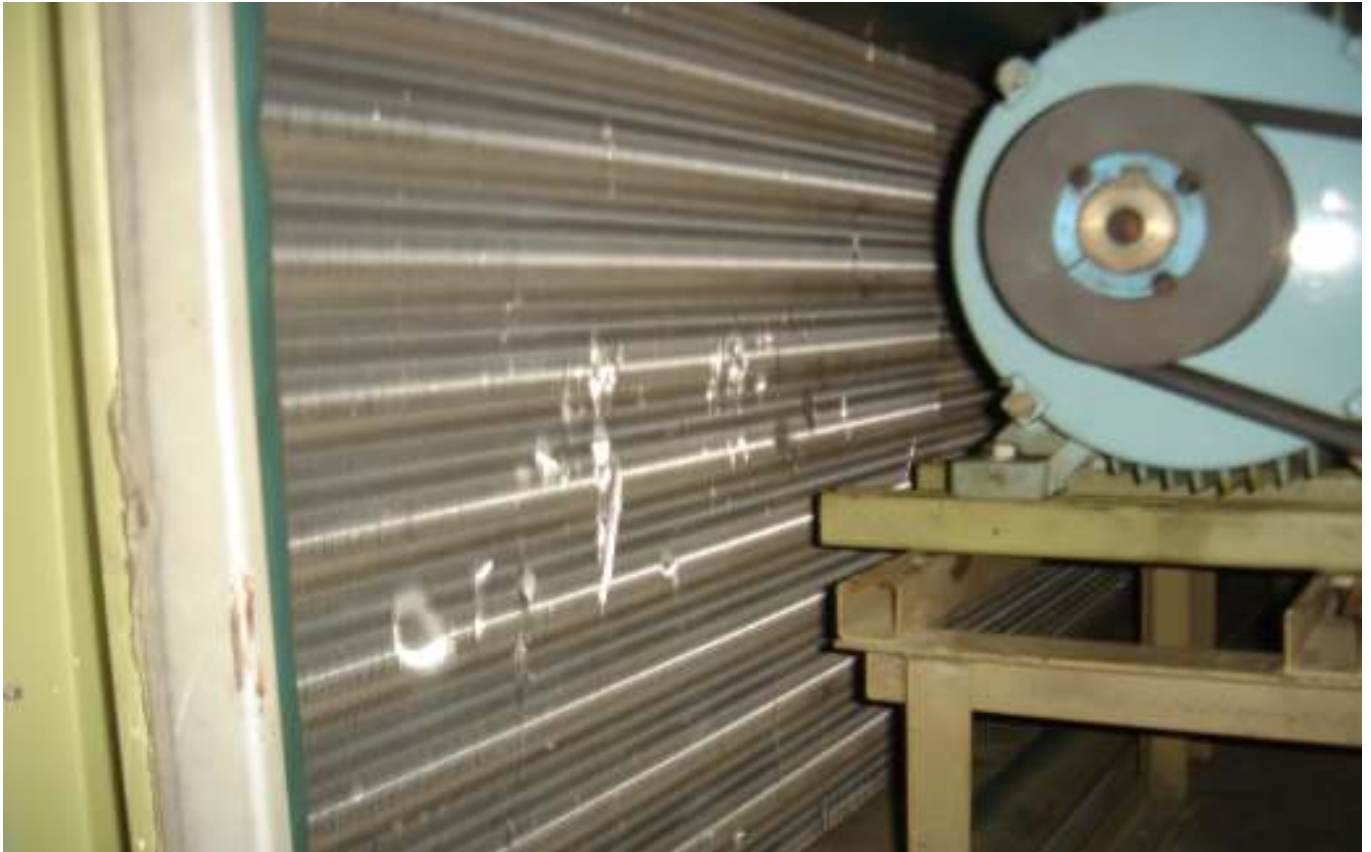
KUVA 11. Lämmityspatteri on hieman pölyinen ja patterissa on muutama kolhu.
