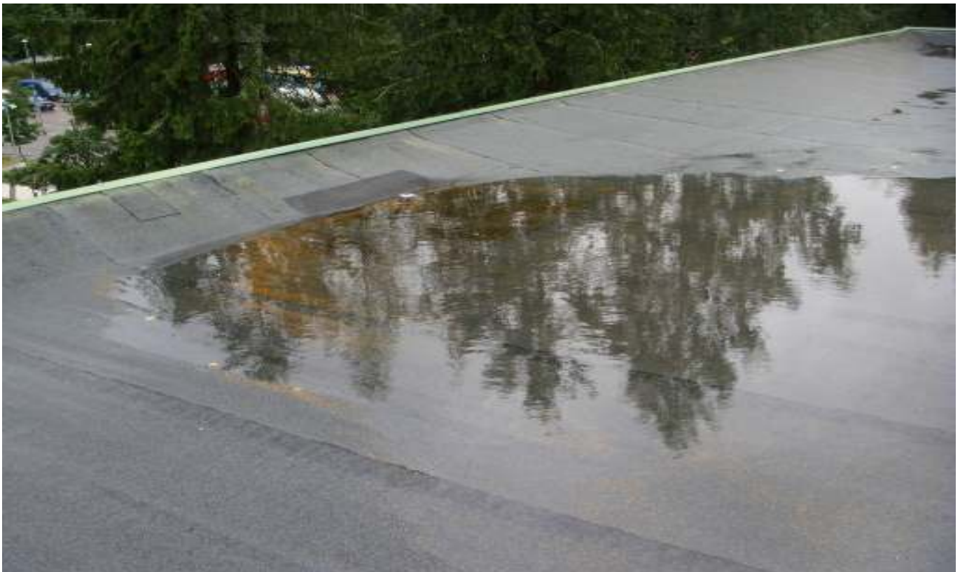
KUVA 28. Vesikatolla olevissa kattokaivoissa on melko paljon roskaa.
