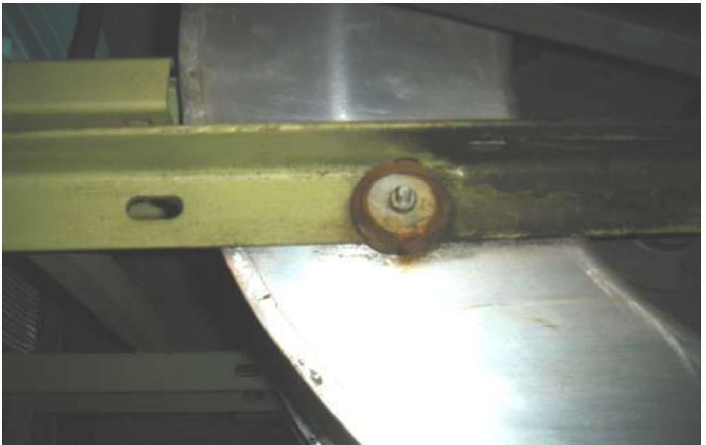
KUVA 16. Tulo- ja poistoilmapuhaltimien kumityynyt ovat huonossa kunnossa.
