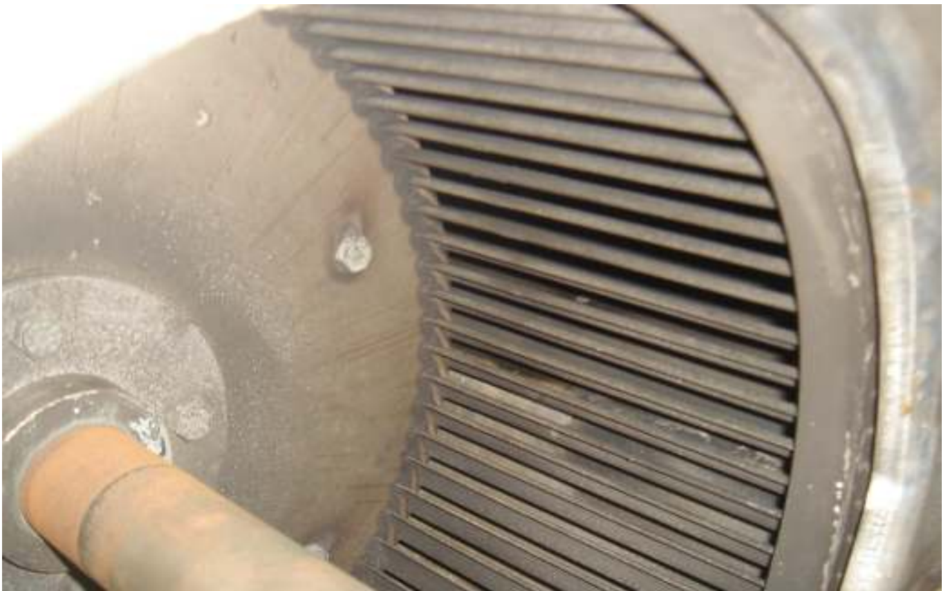
KUVA 12. Yleiskuva LIK 4:n tuloilmapuhaltimesta.
