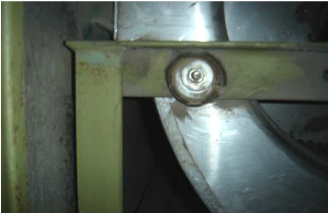
KUVA 8. Puhaltimien kumityynyt ovat osin huonossa kunnossa.
