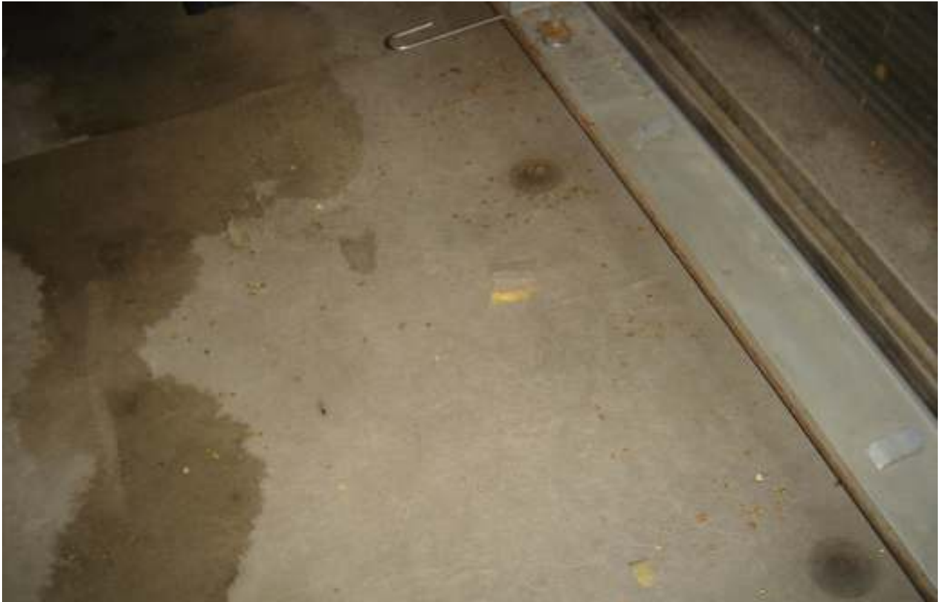
KUVA 9. Tuloilmakoneen kammiossa on hieman roskaa ja pölyä.
