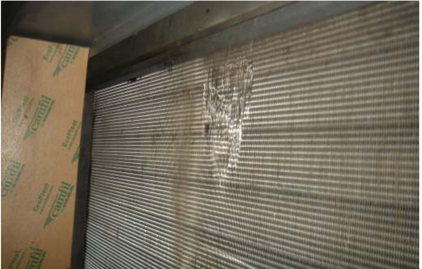
KUVA 23. Lämmityspatterin pölyinen ja patterissa on muutama kolhu.
