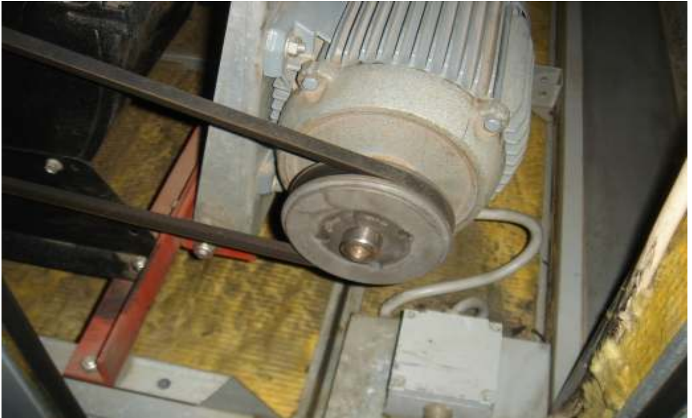
KUVA 19. Tuloilmakoneen kammiot on eristetty villaeristein, joka on paikoin rikki.
