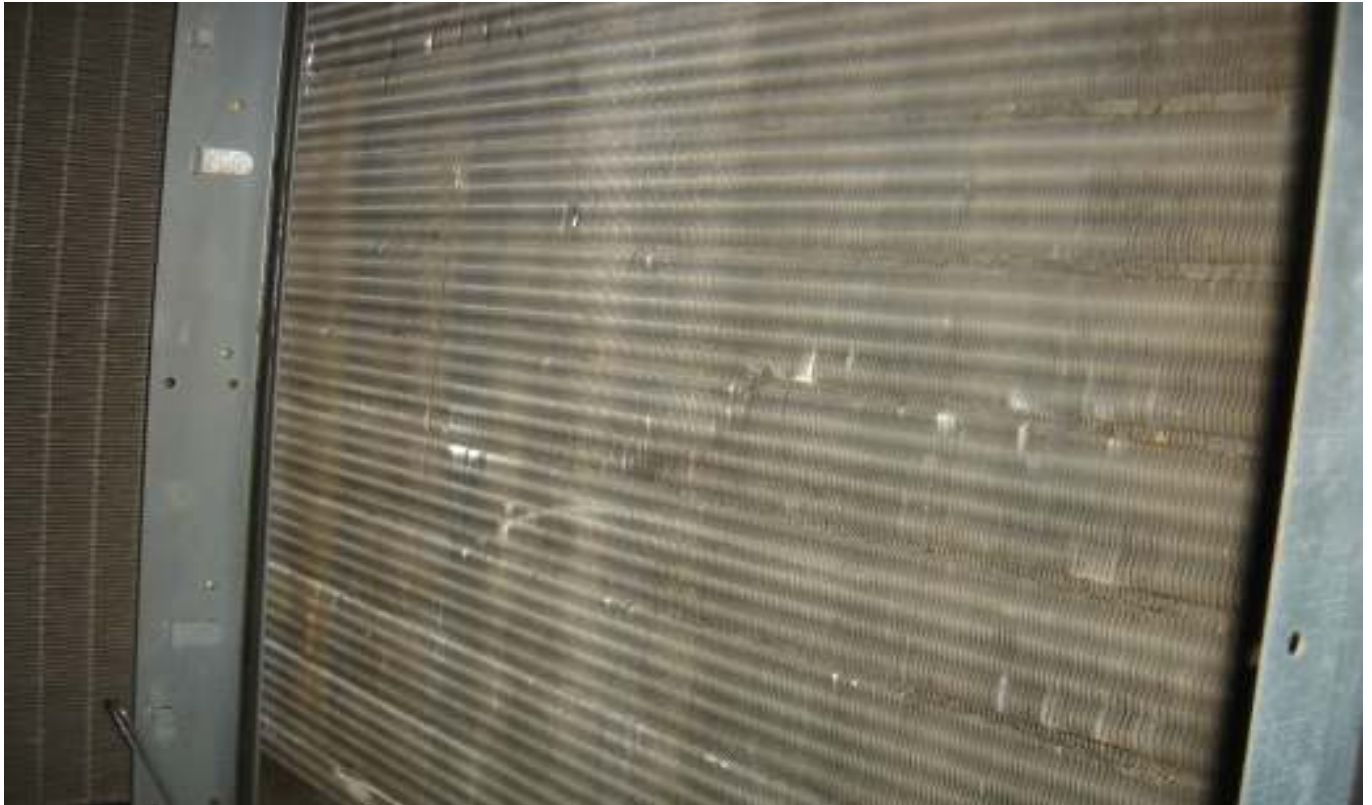
KUVA 15. Lämmityspattereri on hieman pölyinen ja patterissa on muutama kolhu.
