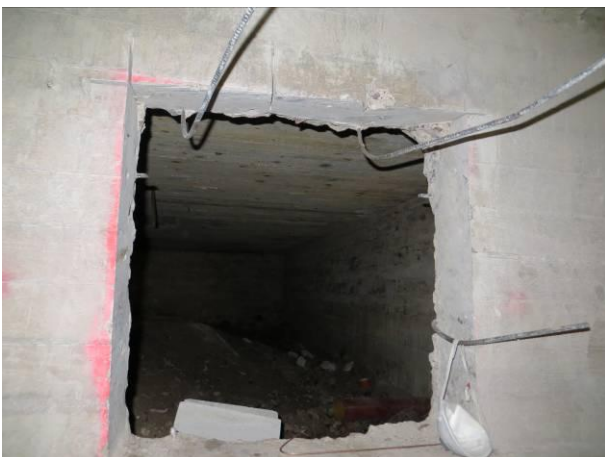
Kuva 39 Kulkuaukko sivulohkoon, viemärinpätkiä yms. rojua. Sojottavia teräksiä.
