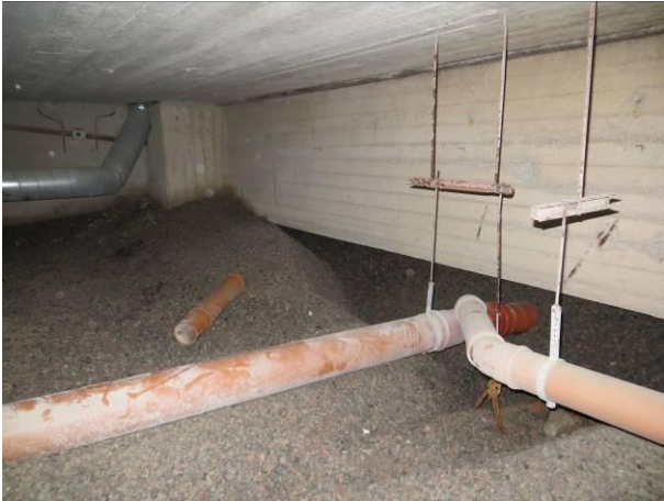
Kuva 27 Kostea maata, vastatäyttö puuttuu, sidosteräksiä, kulmassa IV-kanava.
