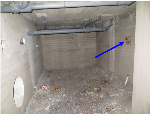
Kuva 45 E4-lohko, oikealta maanpaineseinästä tulee viemäripätkä.
