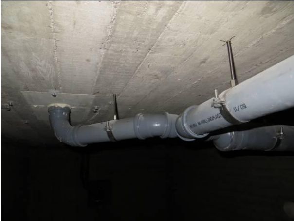
Kuva 49 E5 –lohkon katon viemäreissä on väärin tehtyjä kallistuksia.
