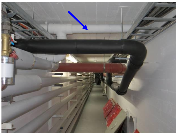
Kuva 17 PT1-putkitunneli/ käytävä, katossa E-alustatiloista tuleva poistokanava, joka on viety PT1 kautta D-alustatilaan.
