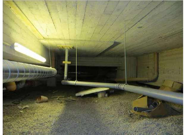
Kuva 22 Rakennusjätettä pohjalla luukun lähellä.
