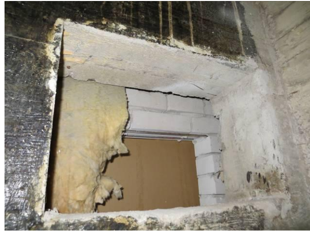
Kuva 38 Siivouskeskuksen 002 rajalla oleva aukko, josta näkyy seinälevy.
