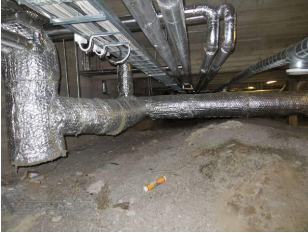
Kuva 35 Yleiskuva C1-päälohkoon, maanpinnassa on mikrobikasvua.
