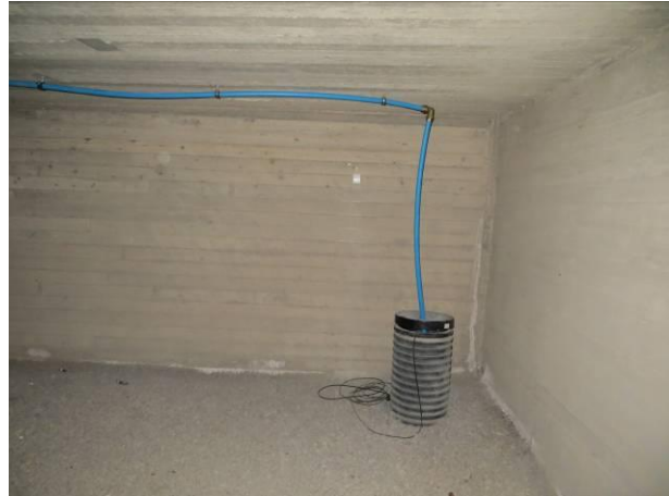
Kuva 32 Salaojakaivosta on uoppumpppausjärjestely, joka ei ollut käyttökunnossa.
