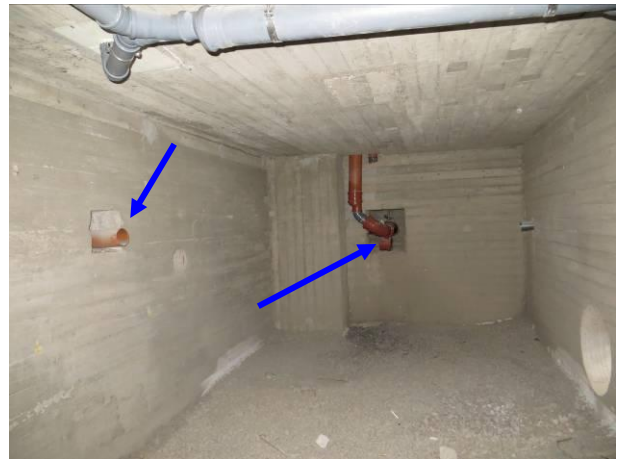
Kuva 46 E5-lohko, perällä on aukko portaan alle, viemäripätkä maanpaineseinästä.
