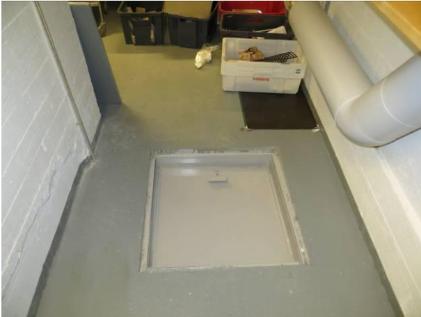
Kuva 21 A-alustatilan kaksoisluukku, jossa ei ole tiivisteitä.
