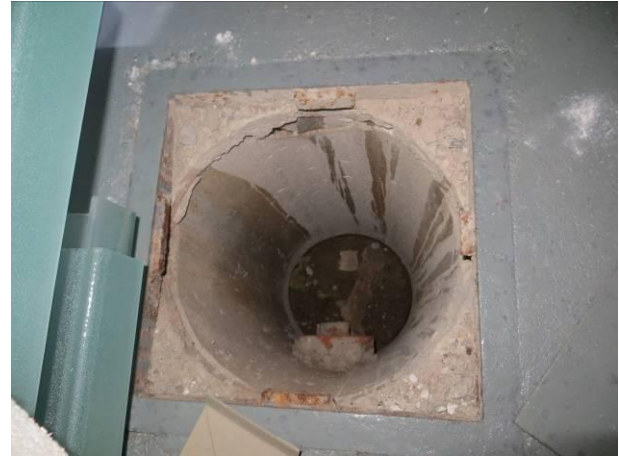
Kuva 50 Epätiivis kansi vanhassa tb-salaoja-kaivossa, jossa on maapohja, pohjalla on kosteutta. Salaojana on ruukkuputki.
