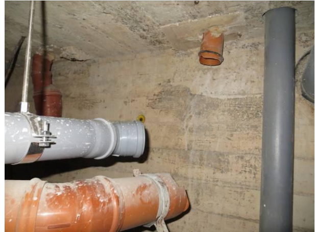
Kuva 28 Epätiivisiä vanhoja viemärivetoja välipohjaan ja purkamattomia viemäreitä.
