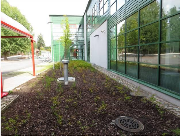
Kuva 7 Sadevesikaivo on jäänyt ylös maanpinnasta C-alustatilan kulmalla.
