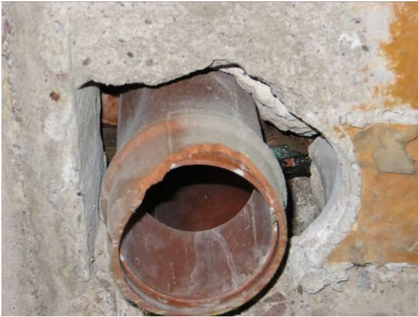
Kuva 37 Täysin tiivistämätön läpivienti.
