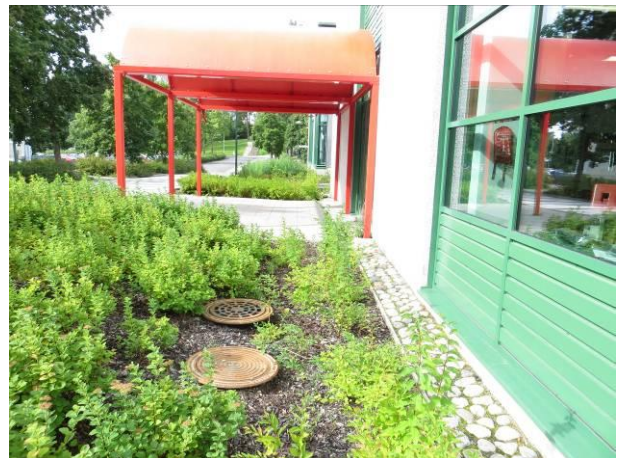
Kuva 6 A-alustatilan päädyssä sadevesikaivo on jäänyt ylös maanpinnasta.
