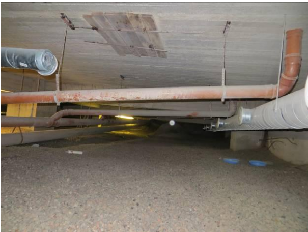
Kuva 9 A-alustatilan toimimaton poistokanavointi.
