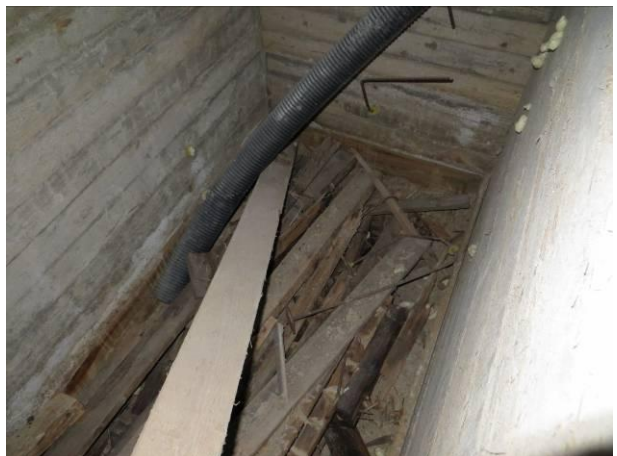
Kuva 48 Lahoa muottijätettä portaan alla.
