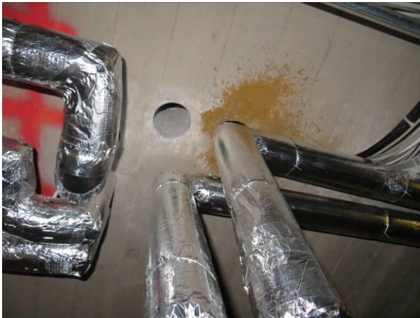
Kuva 33 Epätiivitä putki- ja kaapeliläpivientejä.
