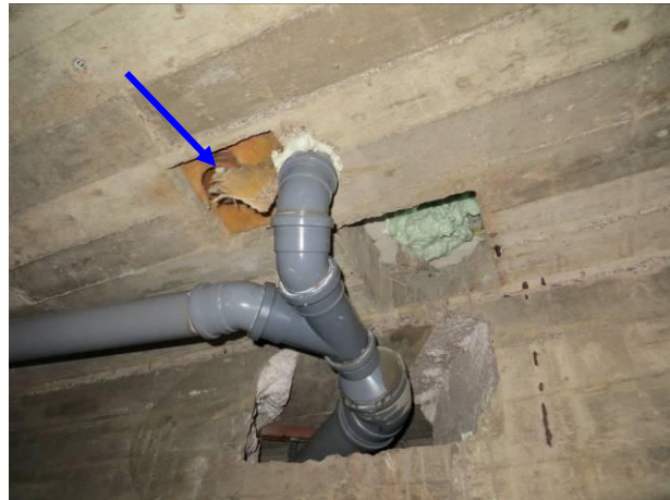
Kuva 34 Epätiivis vanha viemäriläpivienti ja uudempien viemärien heikko kannakointi.
