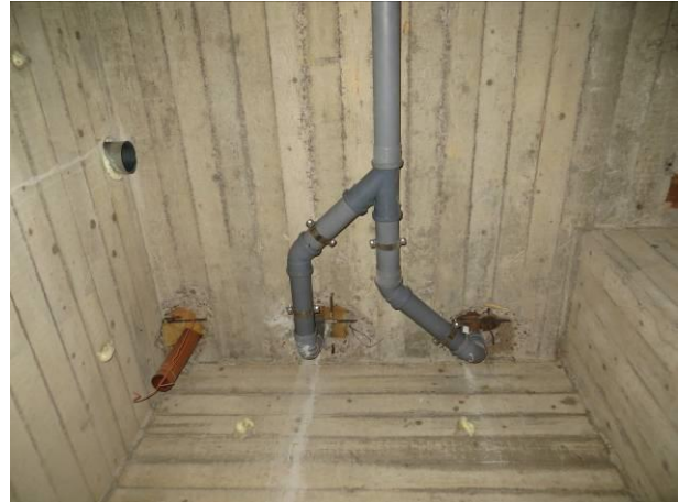
Kuva 44 E2-lohkon katon/ alapohjan viemäriäpiviennit eivät ole tiiviit.
