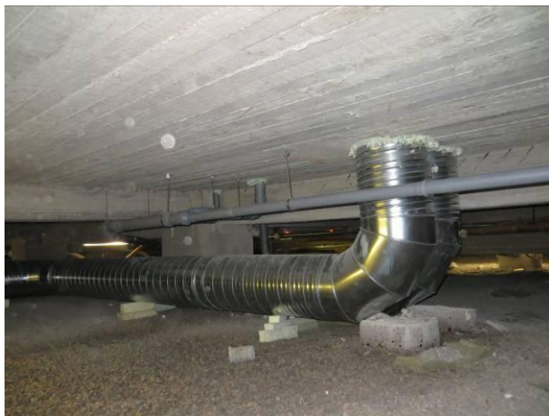
Kuva 25 Keskialueen isot IV-kanavat, niiden läpiviennit on tiivistetty pu-vaahdolla.
