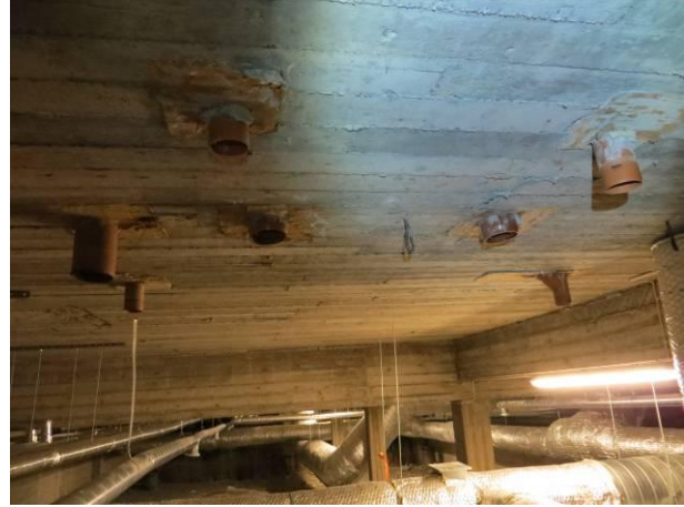
Kuva 36 Katossa on useassa paikassa tiivistämättömiä viemärinpätkiä.
