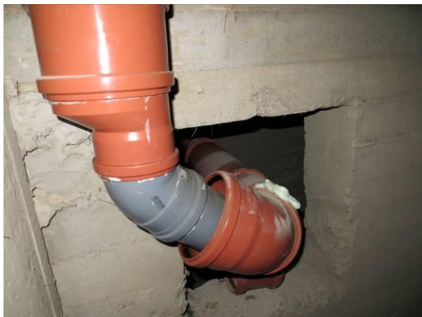
Kuva 47 E5:n epätiivis viemäri liittymä ja aukko portaan alusonteloon.
