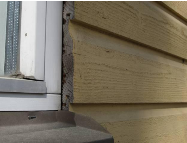
Kuva 19 Epätiivis liittymä, loiva vesipelti.
