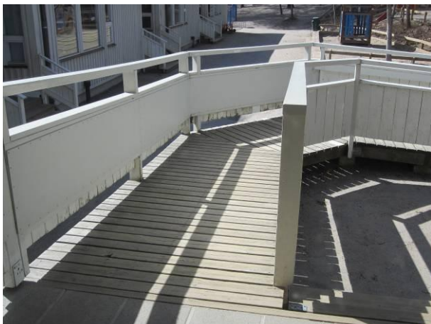
Kuva 25 Sisäpihan luiska, kaiteissa selvästi lahoa.
