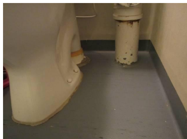
Kuva 44 Kittaus wc-pytyn juuressa.
