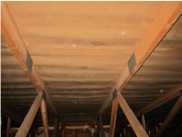
Kuva 37 Homekasvua aluskatteen alapinnassa.
