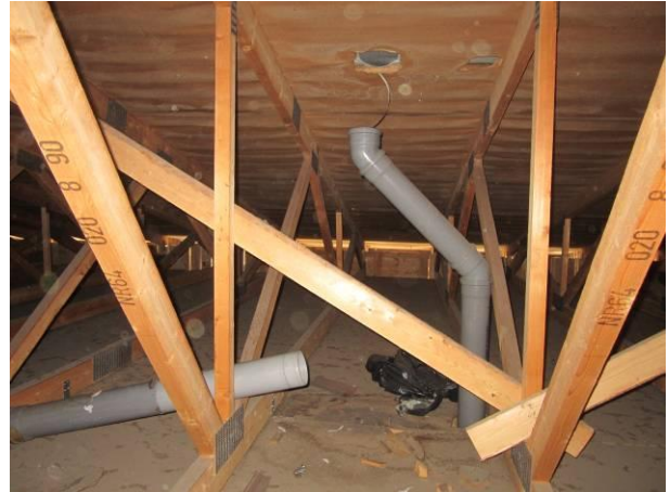
Kuva 32 Tuuletusviemärin pää ullakolla.
