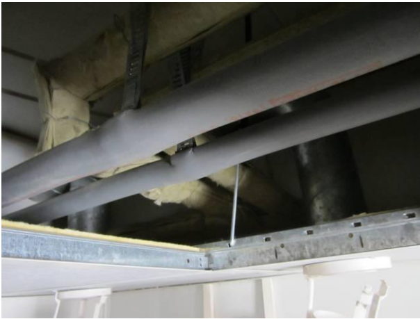
Kuva 49 Eristettyjä lämpö- ja kv-putkia.
