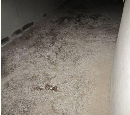
Kuva 11 Maassa kosteaa mursketta ja mikrobikasvua Tk 15 alapuoella.
