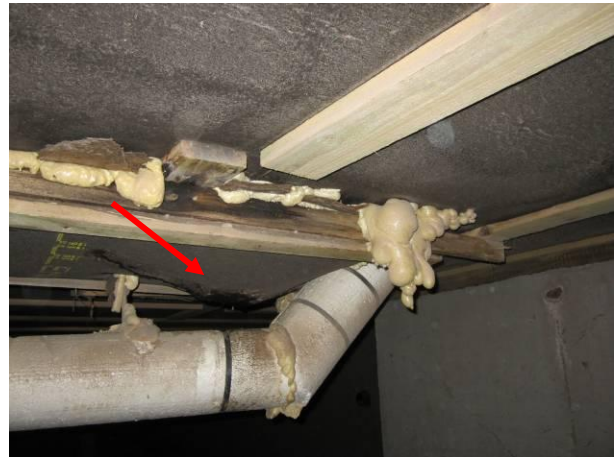
Kuva 12 Aktiivinen vesivuoto Tk/ märkäeteinen 15 lattiakaivon kohdalla.
