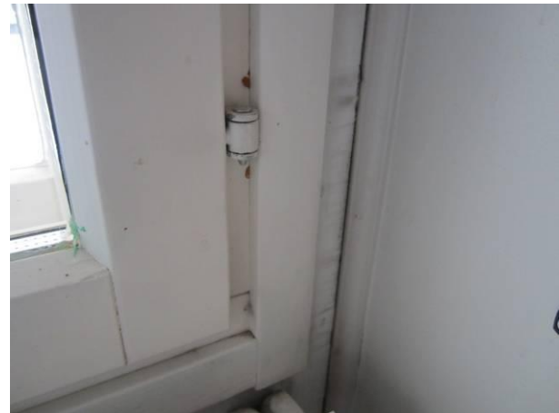
Kuva 48 Ilmavuotojälkiä seinäliittymässä, ryhmähuoneessa 10.
