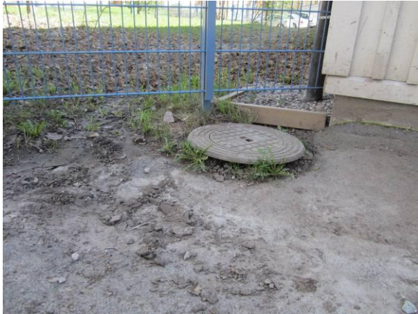
Kuva 7 Yläpäädyn salaojan tarkastuskaivo ryhmätila 50 kulmalla.
