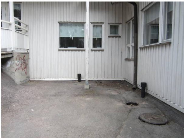
Kuva 5 Sisäpihan nivelalueen porrastus, jossa asfaltti on vasten puuseinää.
