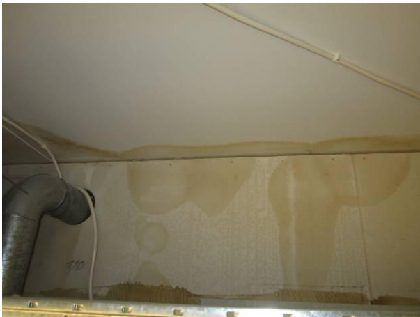
Kuva 47 Vuotojälkiä alakattotilassa henkilötilan 23 vaatehuoltotilassa.
