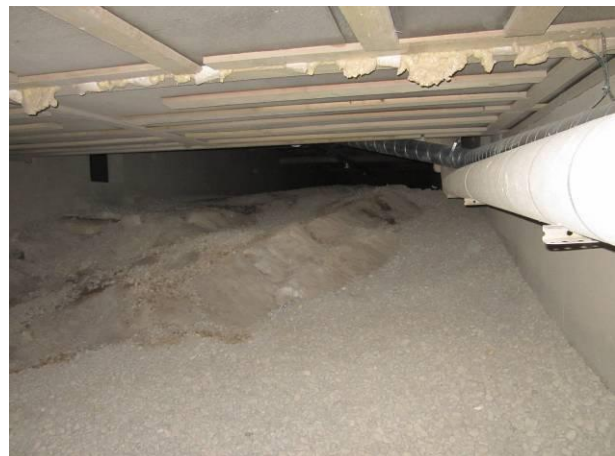
Kuva 10 Kallio pinnassa, mikrobikasvua maanpinnassa.
