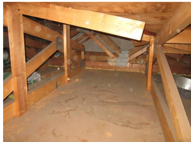
Kuva 34 Vesivuotojälkiä jiiirin alla
