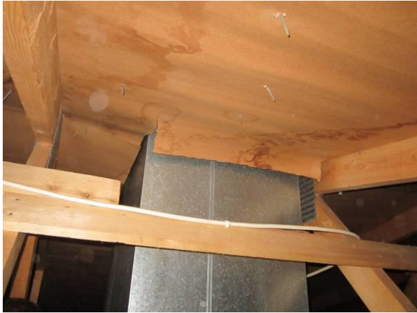
Kuva 35 Iv-kanavan läpivienti ei ole tiivis.
