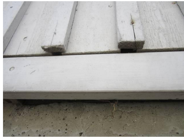
Kuva 20 Lautojen päät on huonosti maalattu, tästä johtuen puun halkeilua.
