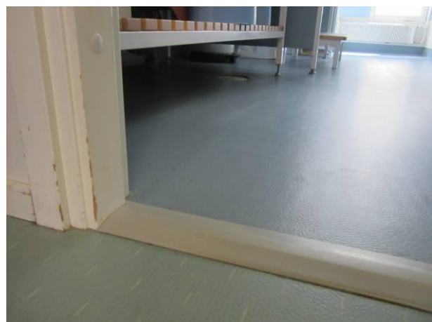
Kuva 14 Matala kynnyks märkätilan ja käytävän välissä.
