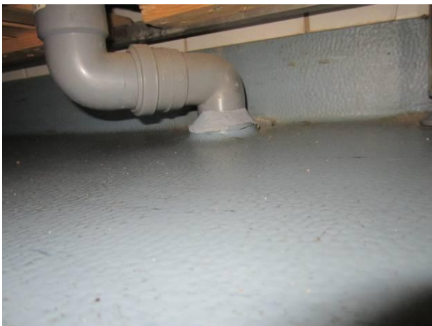
Kuva 17 Märkäeteisen lavuaariviemärin liittymä.
