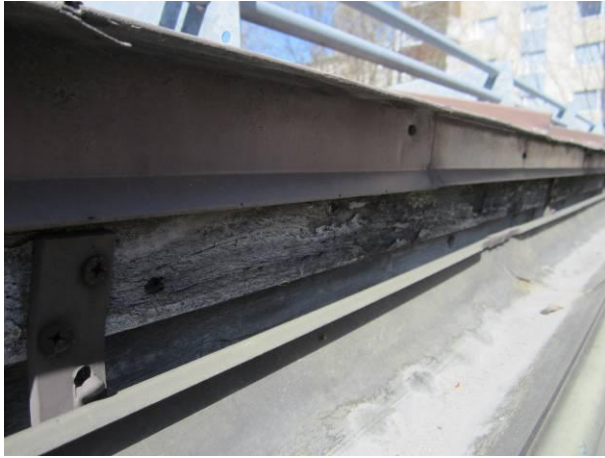
Kuva 27 Lahoa otsalautaa räystäällä.
