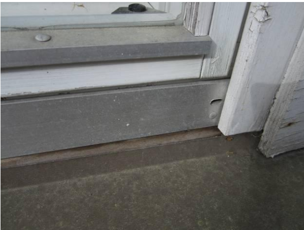
Kuva 21 Loiva / tasainen vesipelti, joka ei liity tiiviisti ikkunaan.
