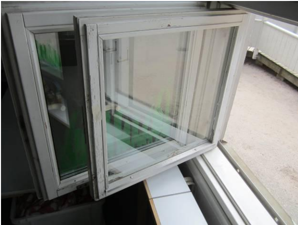
Kuva 23 Tuuletusikkuna, hieman kulunut.
