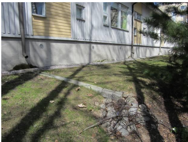
Kuva 1 Paikointusalueen sivua, pintakallistukset ovat hyvät, sepelöinti rakennusvierillä, loiskekourut ja kivipesät imeytysalueella.
