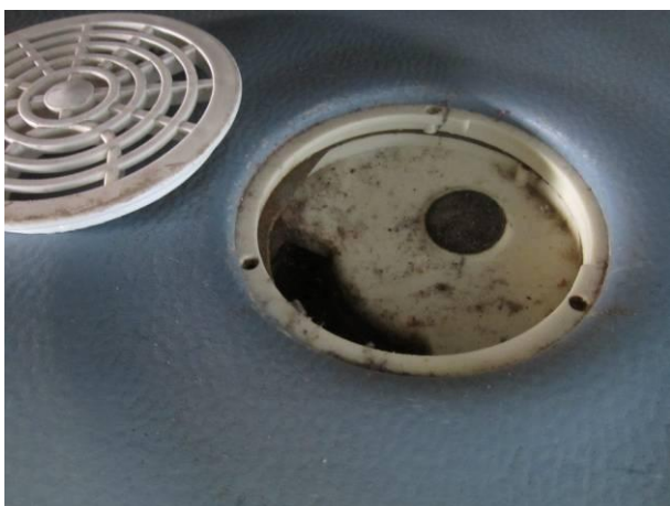
Kuva 13 Muovimatto on irti lattiakaivon ympärillä.
