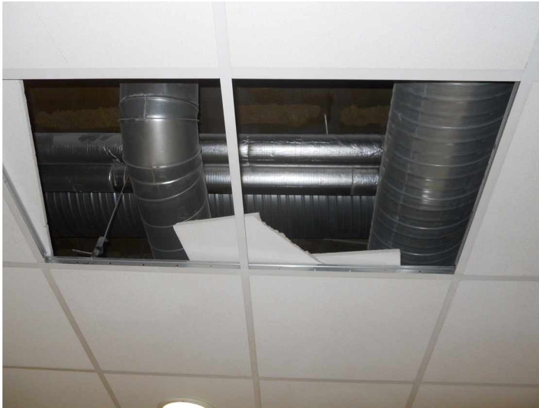
Kuva 37. 1. kerroksen alakaton sisäistä kanavointia ja putkistoa.
