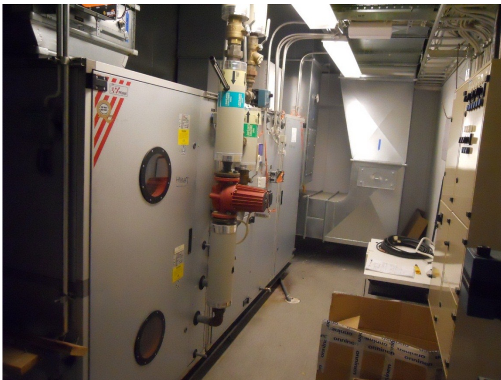
Kuva 17. Pukutiloja- ja aulaa palveleva TK02.
