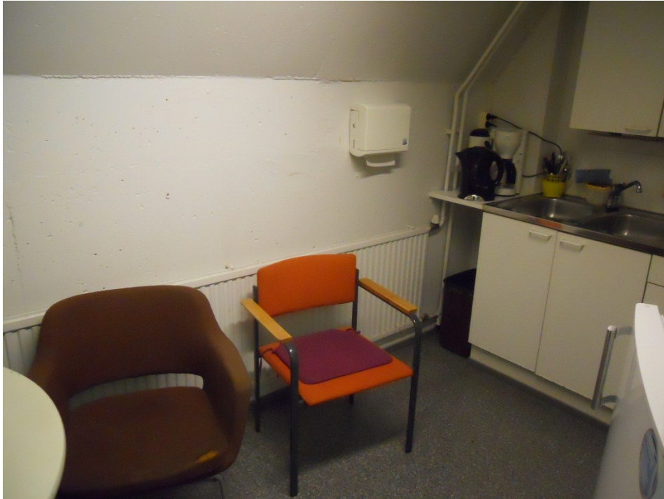
Kuva 6. Pohjakerroksen suojatilan K7 alkuperäinen radiaattori.
