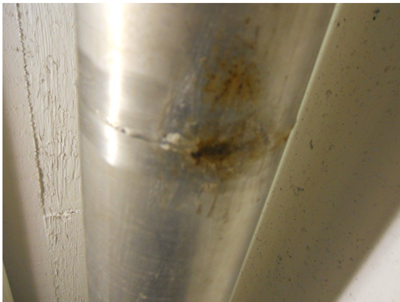
Kuva 12. Vuotanut sauma Rst-allasvesiputkessa.
