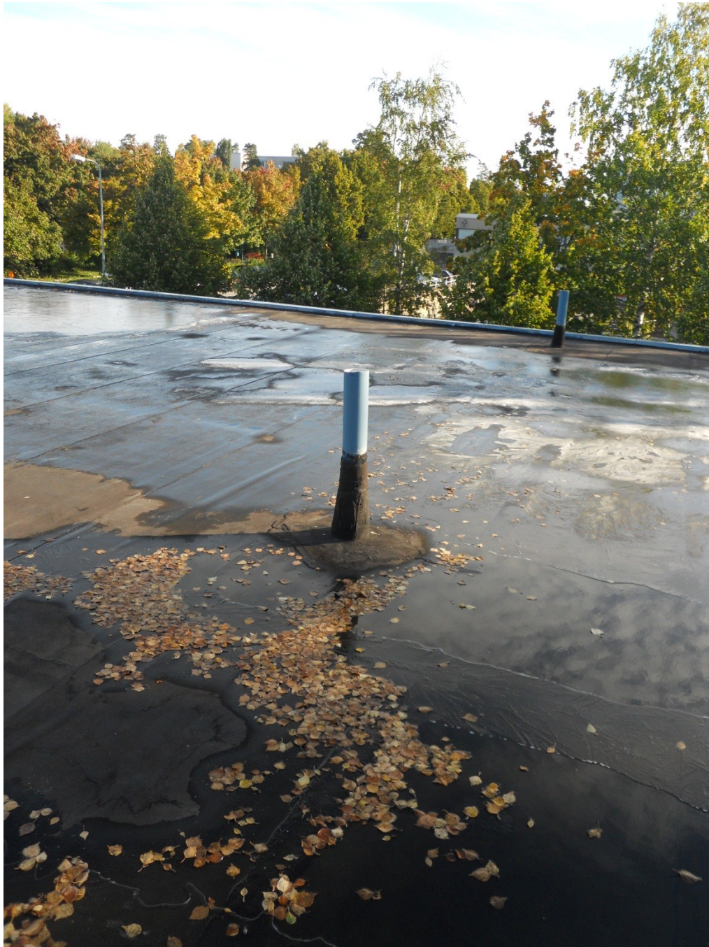
Kuva 14. Viemäreiden eristämättömiä tuuletusputkia vesikatolla.
