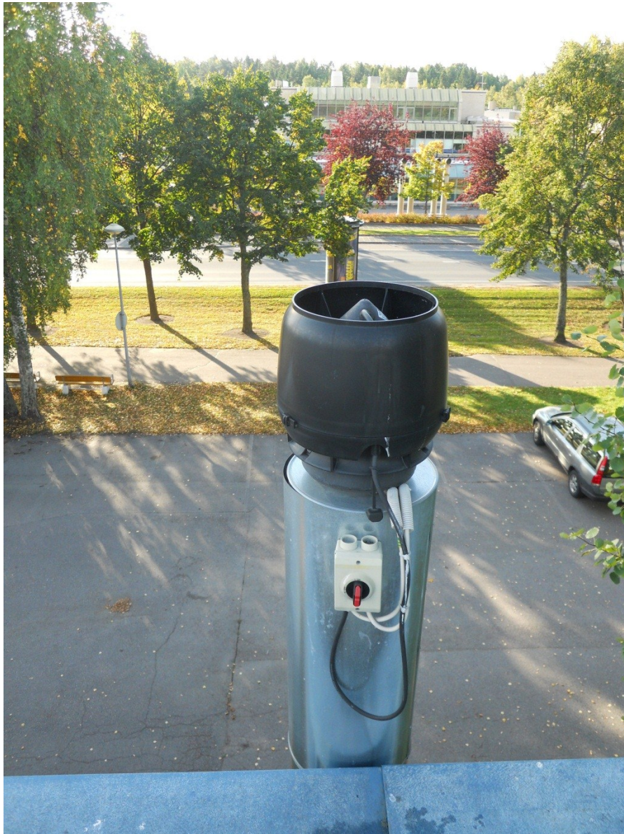
Kuva 23. Kloorihuoneen poistopuhallin PK08.
