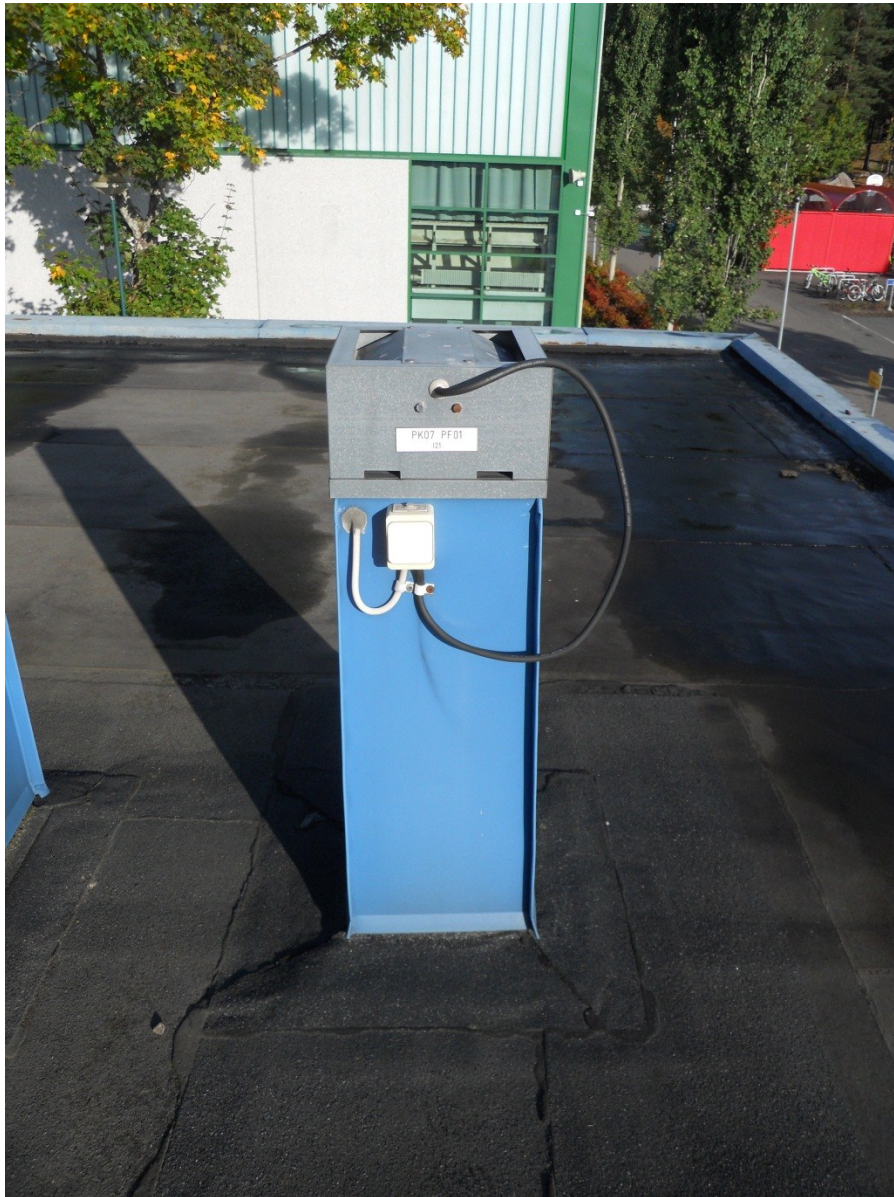
Kuva 22. 1. kerroksen iv-konehuoneen poistopuhallin PK07 PF01.
