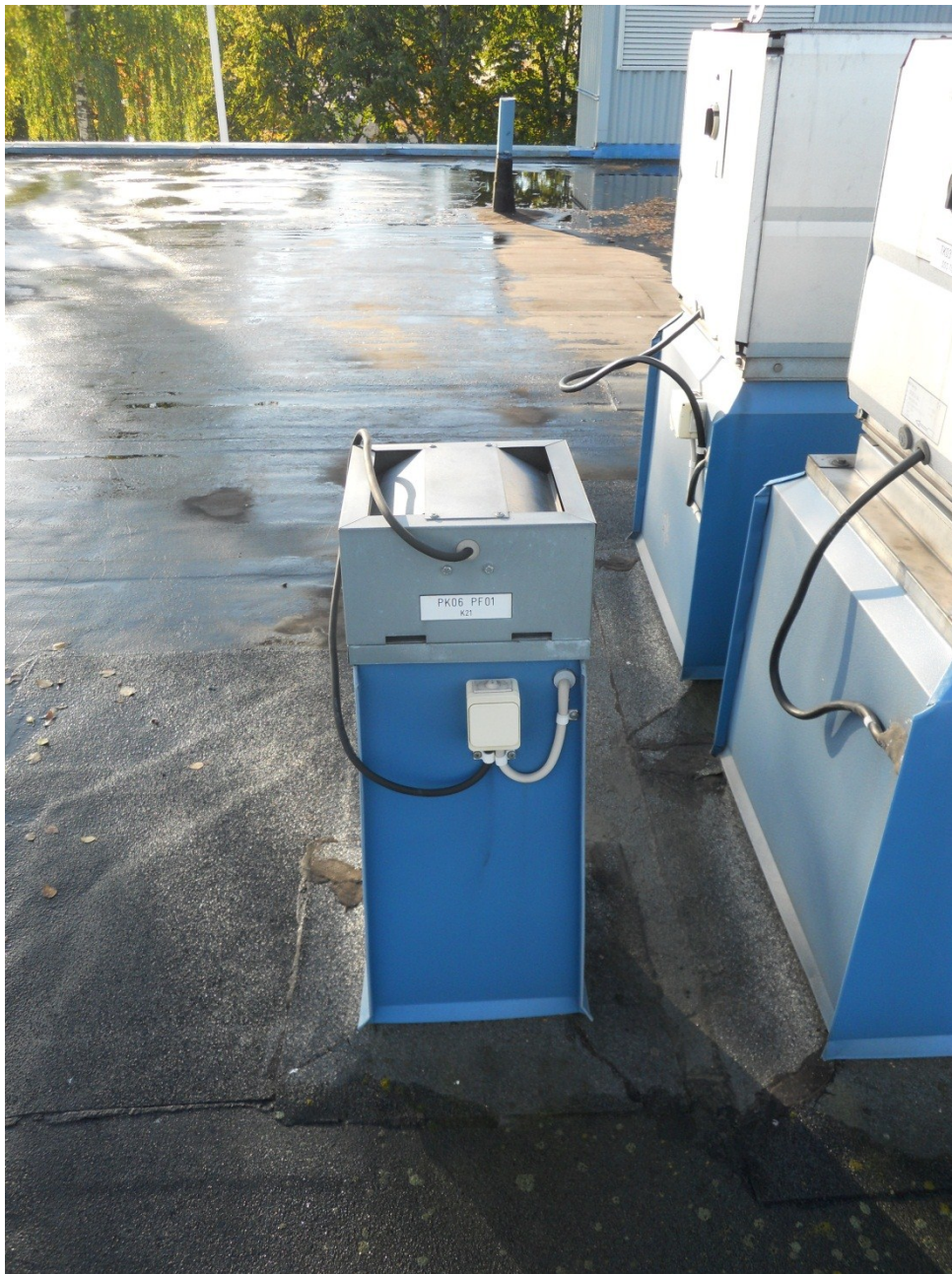
Kuva 21. kellarin iv-konehuoneen poistopuhallin PK06 PF01.
