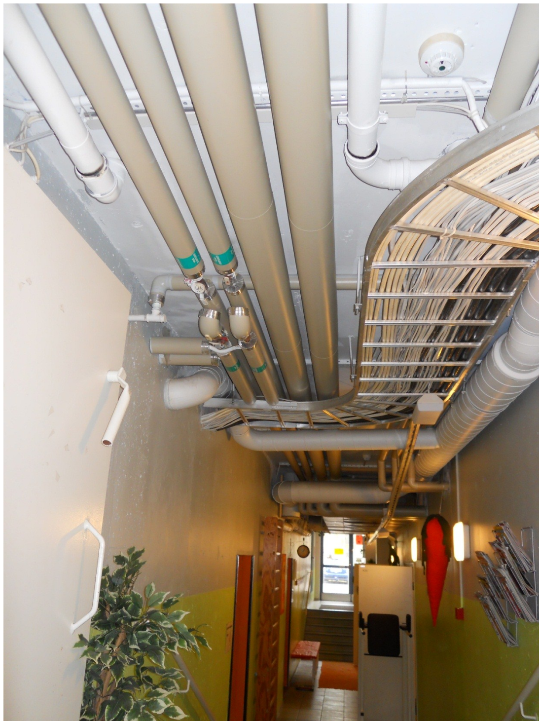
Kuva 38. Pohjakerroksen käytävän putkituksia ja kanavoiteja.
