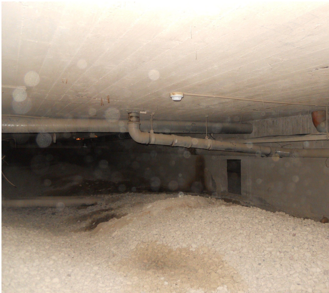
Kuva 32. Alustatilan poistoilmakanavointia ja viemäriputkistoa.
