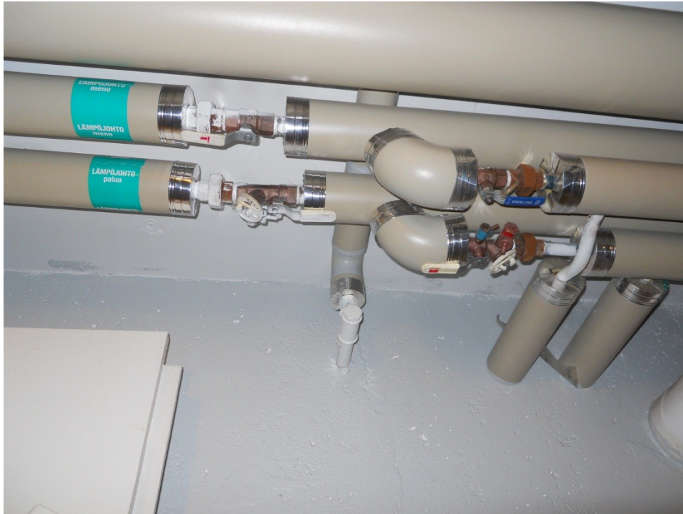
Kuva 5. Pohjakerroksen käytävän lämpöjohtoja ja -venttiileitä.
