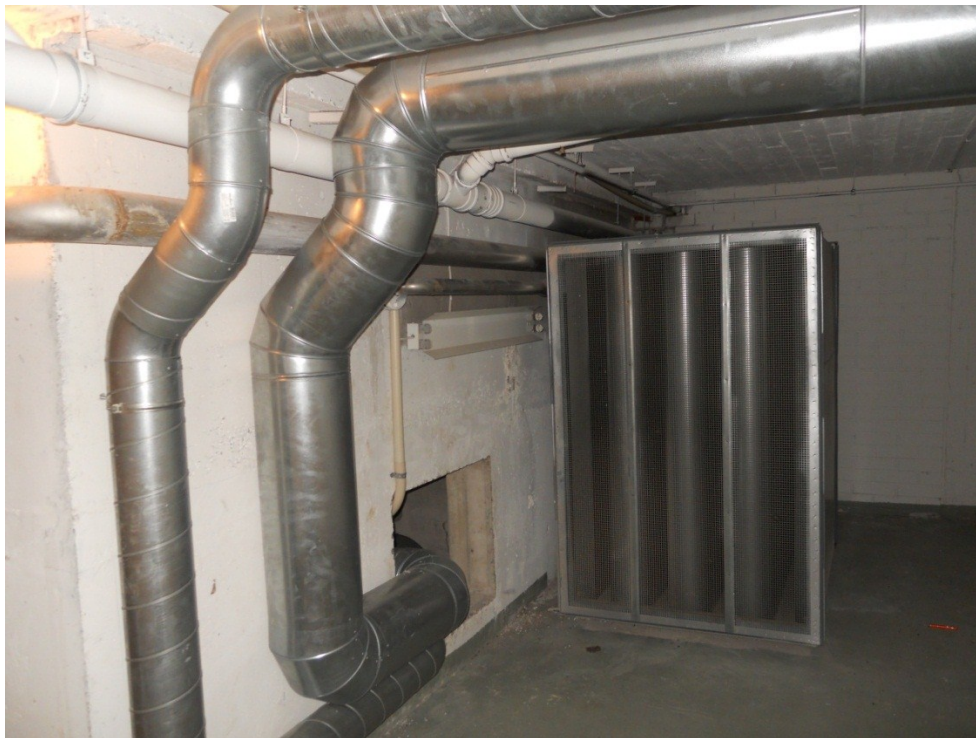
Kuva 33. Kellari "ilmakäytävän puhallusosa ja kanavointia.
