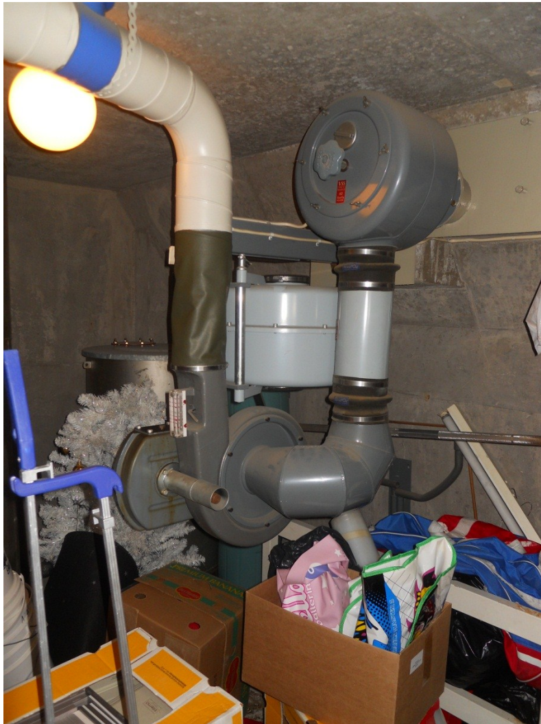
Kuva 36. Väestönsuojan sodanajan ilmanvaihtolaite.
