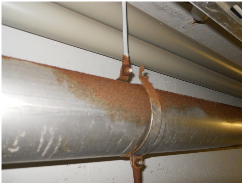
Kuva 11. Pistekorrodoitunut Rst-allasvesiputki ja syöpynyt kannake.
