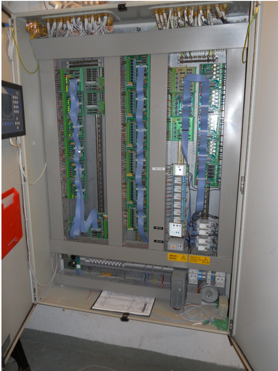
Kuva 30. Rakennuksen valvonta-alakeskus VAK201 lämmöjakohuoneessa.
