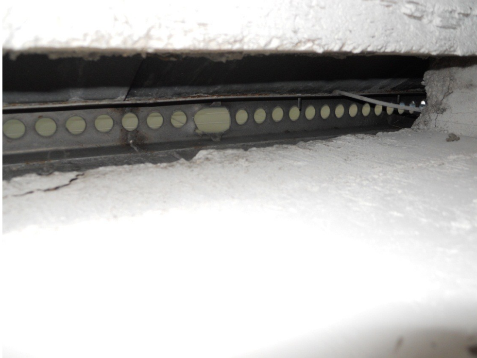
Kuva 24. Allastilojen tuloilmasäleikkö kellarin "ilmakäytävästä" nähtynä.
