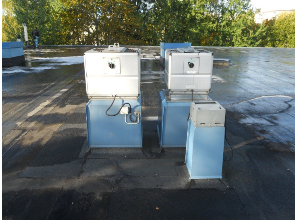
Kuva 19. TK03 erillispuhaltimet PF02 ja PF03 (isot).
