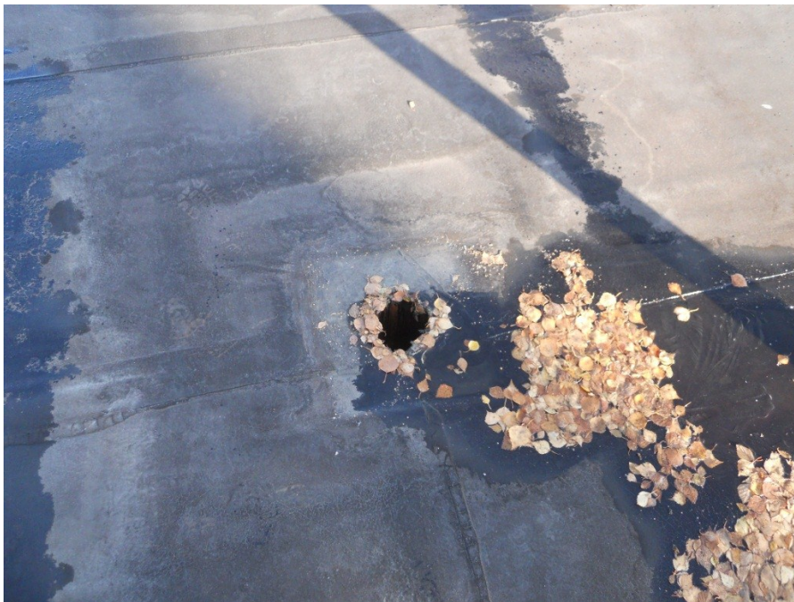
Kuva 13. Vesikaton sadevesikaivo, josta puuttuu sihti. Kaivoja yhteensä 3.
