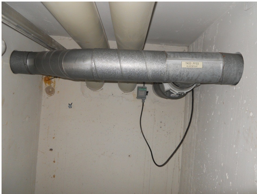
Kuva 20. Alustatilojen poistopuhallin TK03 PF03.
