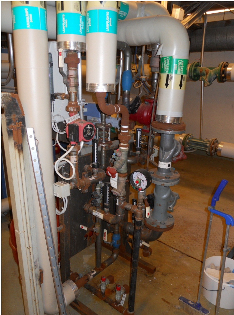
Kuva 2. Lämmitys- ja ilmanvaihtoverkoston lämmönjakokeskus.
