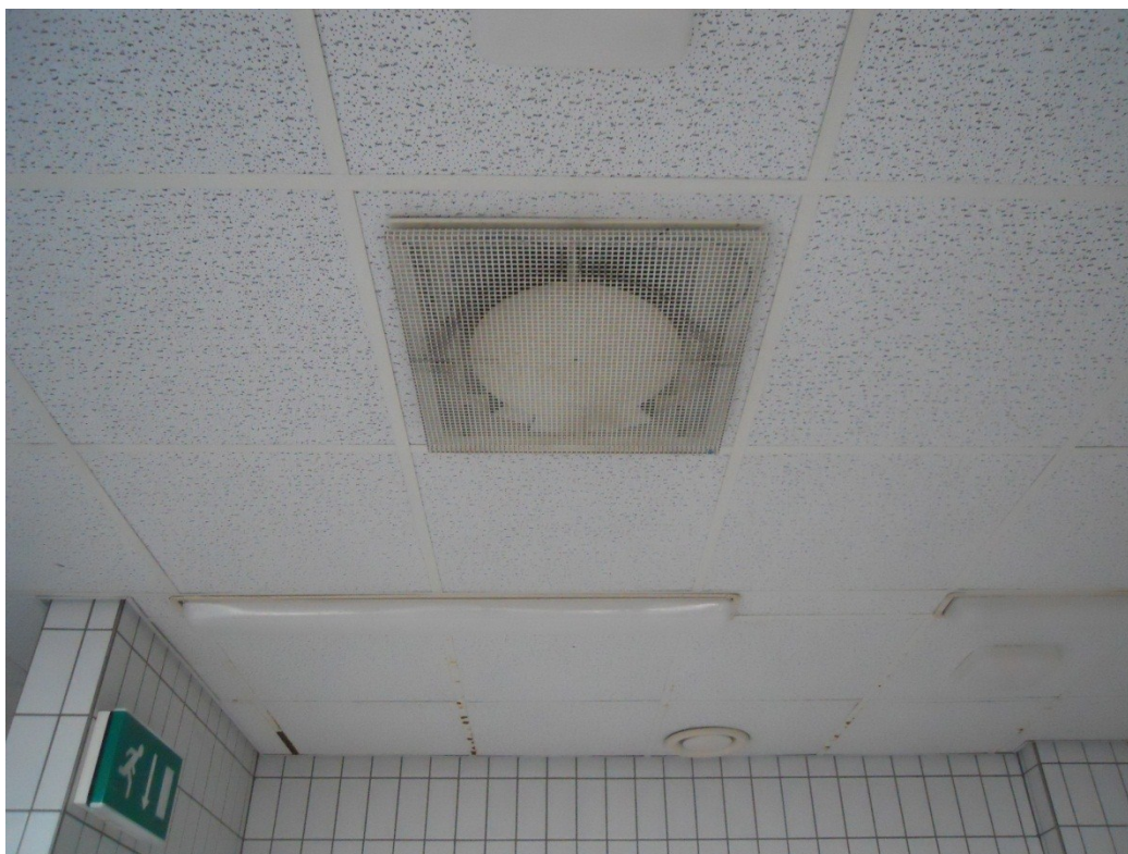
Kuva 27. Pesutilojen tulo- ja poistoilmalaitteita.
