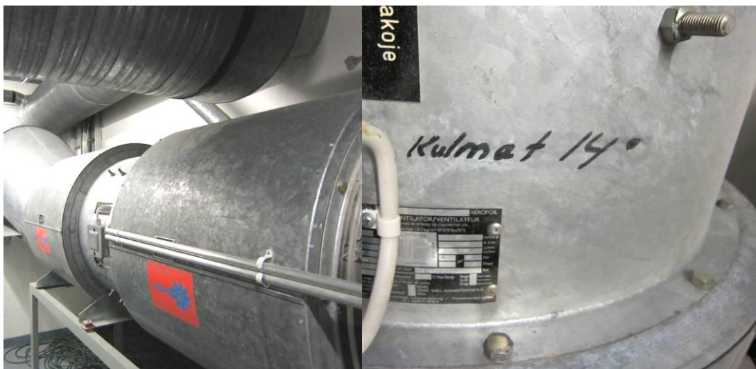
Kuvat 14-15. Yleiskuvat poistoilmapuhaltimesta ja ns. lapakulma 14 astetta.
