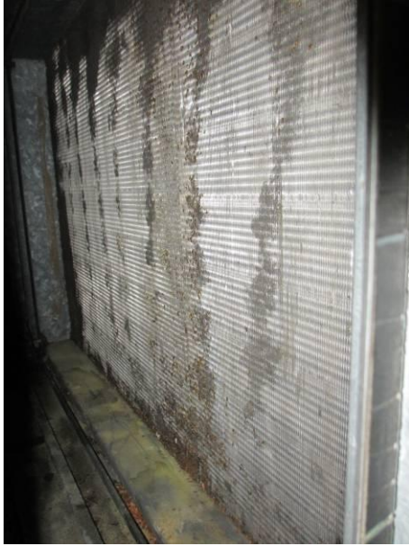
Kuva 27. Lämmityspatteri on pölyinen ja roskainen.
