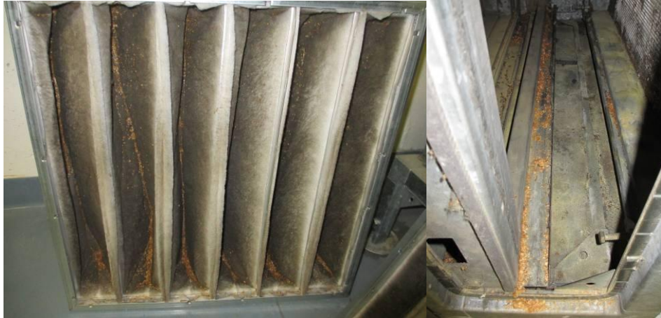
Kuvat 23-24. Tuloilman suodatinkehikko ei ole tiivis, kehikossa tapahtuu ohivirtausta ja suodattimet ovat F3 luokkaa.
