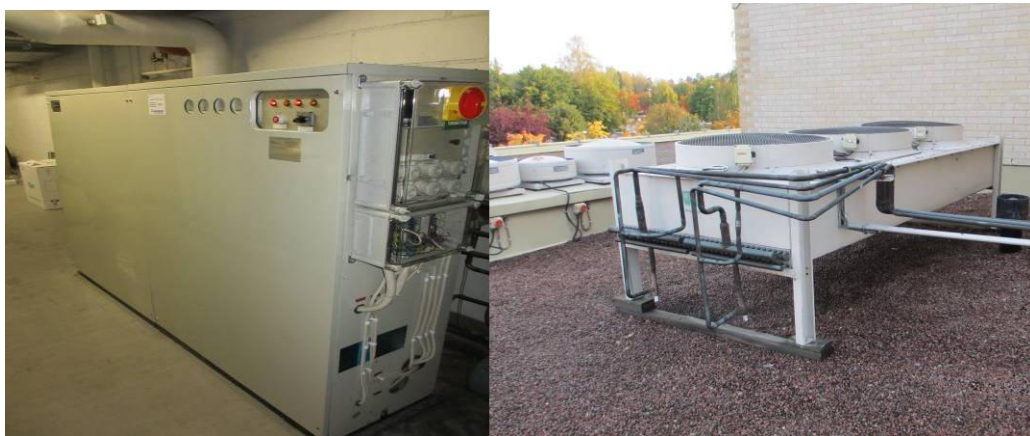
Kuvat 38-39. Yleiskuvat vedenjäähdytyskoneesta ja lauhduttimesta.
