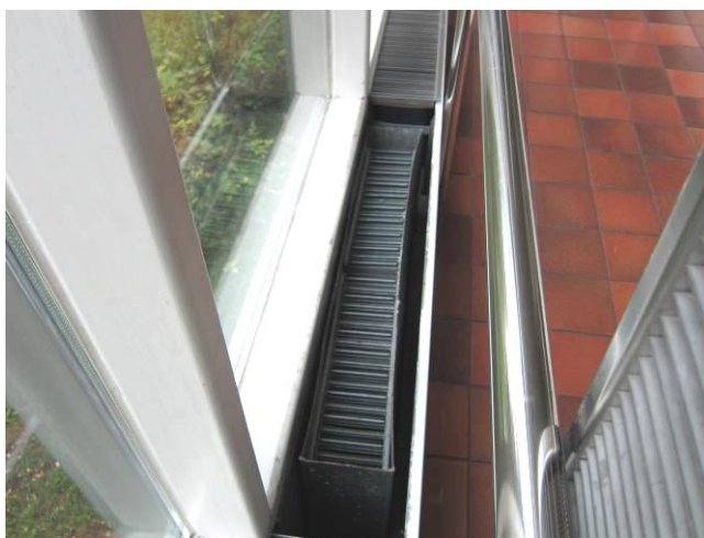
Kuva 36. Yleiskuva toimistohuoneen pääte-elimistä.
