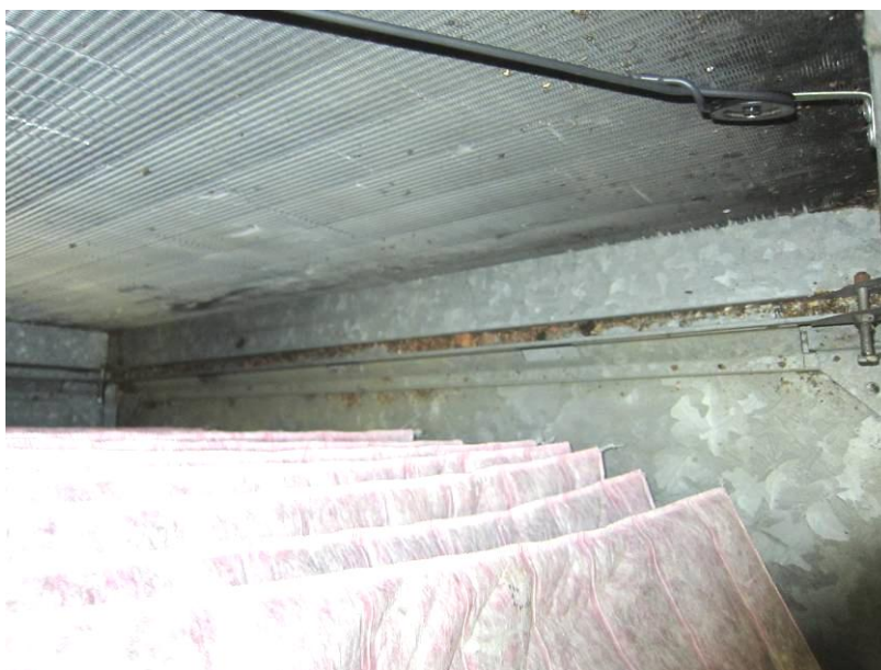
Kuva 18. Tuloilmakoneen kammioissa on havaittavissa roskia.
