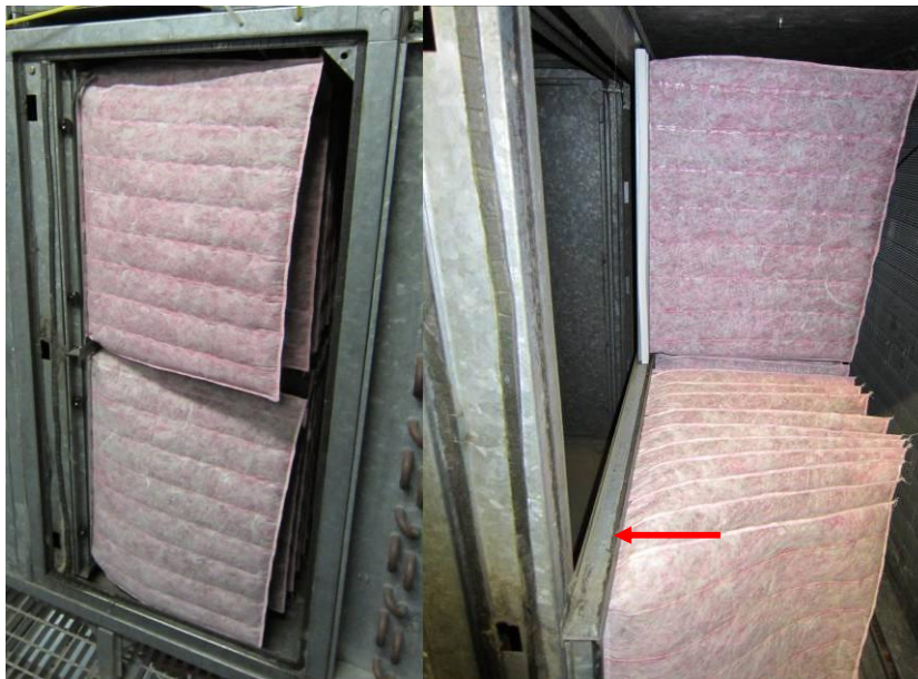
Kuvat 16-17. Tuloilmasuodattimet ovat puhtaat ja suodatinkehikko on melko tiivis.
