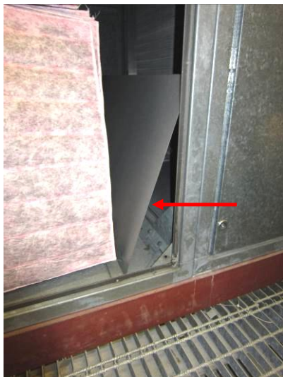
Kuva 7. Suodatinkammioon on asennettu ohjainpelti, jotta ilma sekoittuisi paremmin kammiossa.
