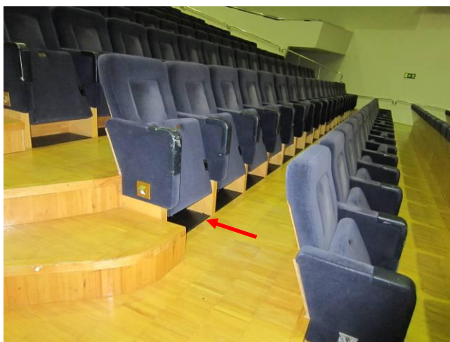
Kuva 37. Yleiskuva konserttisalin tuloilmapuhalluksesta.
