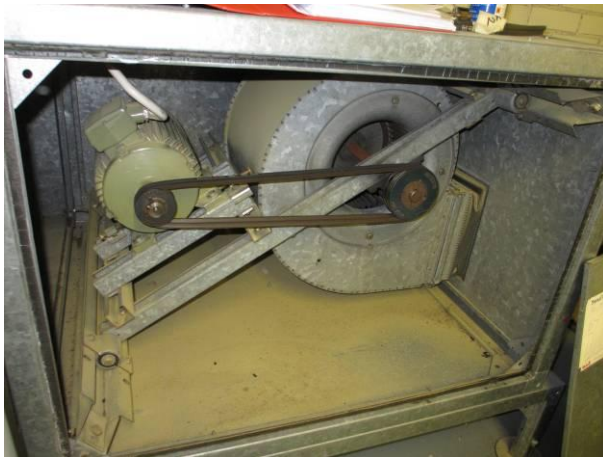
Kuva 28. Tuloilmapuhaltimen hihnat ovat löysällä.
