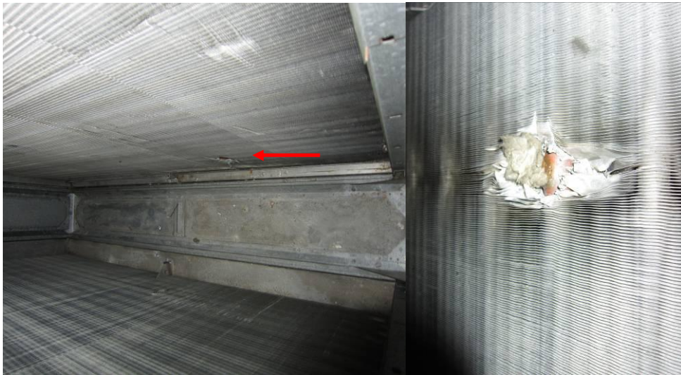
Kuvat 5-6. Lämmitys- ja jäähdytyspatteria on korjattu jääty- misen vuoksi.
