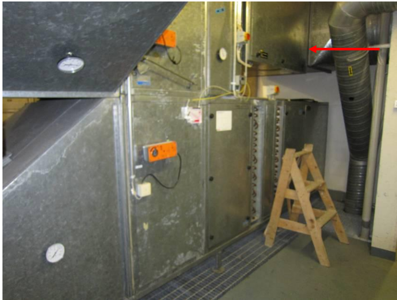
Kuva 22. Poistoilmakoneen avattava luukku on melko korkealla ja se on painava.
