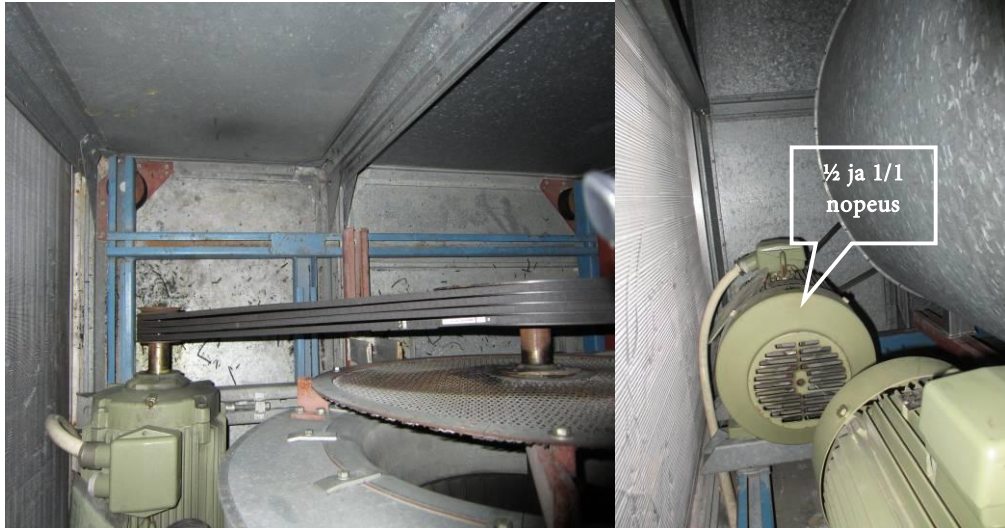
Kuvat 12-13. Puhaltimen urapyörät eivät ole linjassa.
