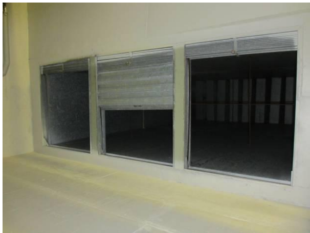
Kuvat 34. Yksi palopelleistä on lauennut ja se tulee korjata.
