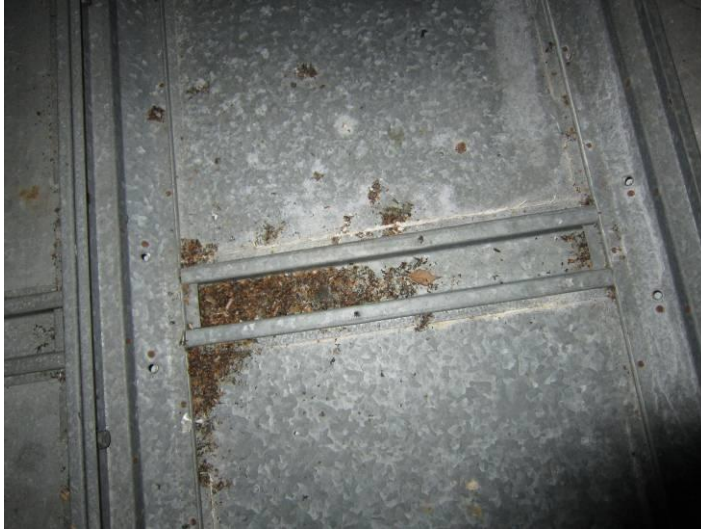
Kuva 4. Ilmanvaihtokoneen kammioissa on havaittavissa pölyä ja roskaa.
