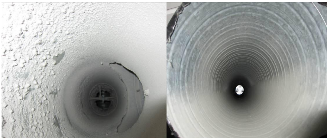
Kuvat 30-31. Yleiskuvat poistoilmakanavasta.
