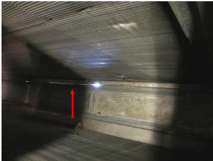
Kuva 11. Tuloilmakammion liittokset eivät ole tiiviitä.
