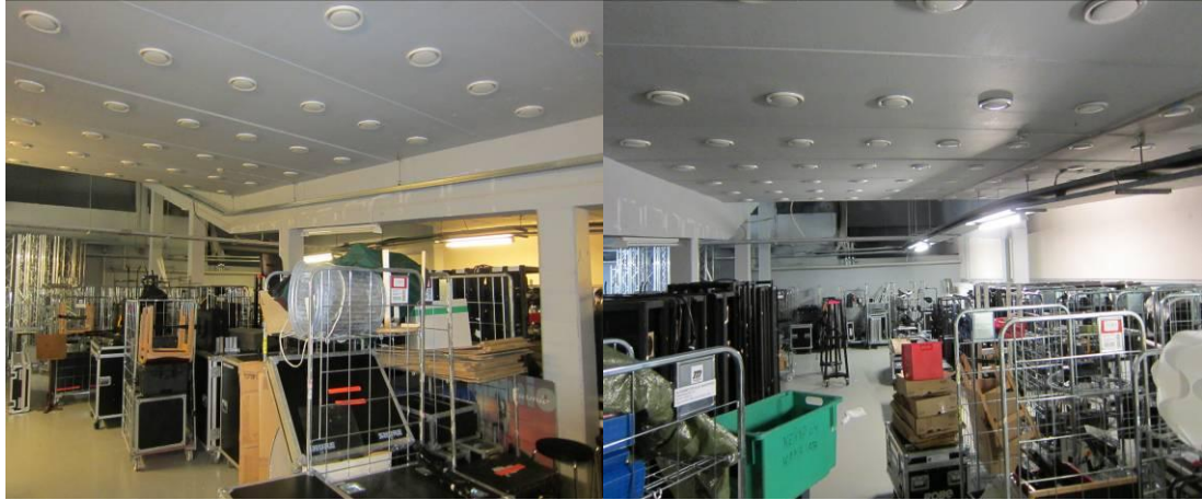
Kuvat 32-33. Yleiskuvat tuloilmakammioista.
