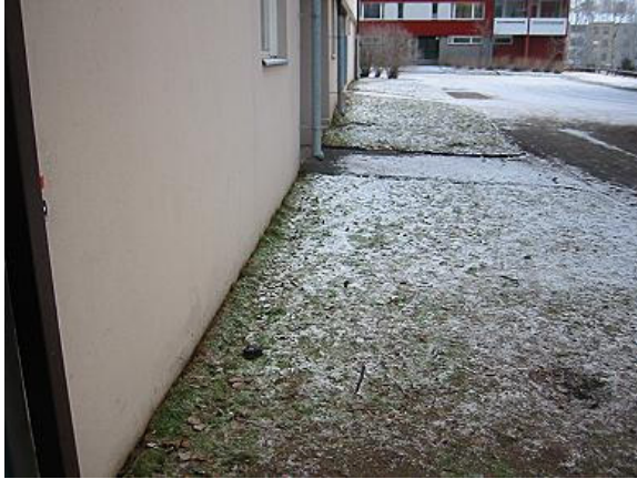
Kuva 1 Eteläsivustalla nurmimaata. Vietto rakennuksesta poispäin puutteellinen.
