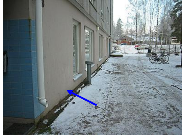
Kuva 2 Pohjoisen puoleisella sivustalla asfalttia. Ensimmäisen ikkunan kohdalla lastenhuonetta 3, jossa lähellä ulkoseinää kohonnutta kosteutta lattiassa.
