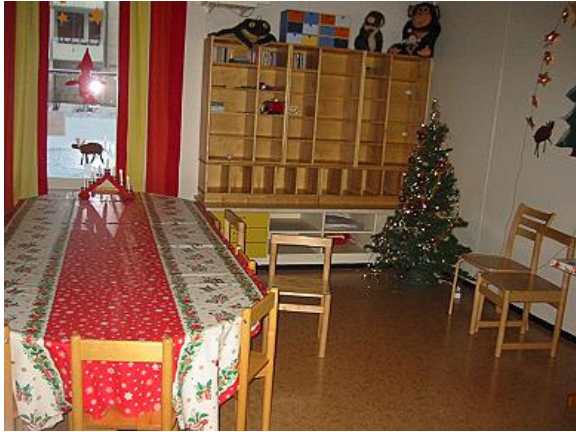
Kuva 5 Lastenhuonetta 3 kohdasta, jossa lattiassa kohonnutta kosteutta.
