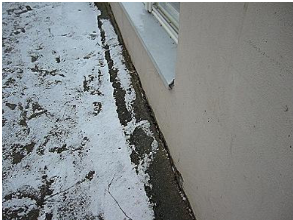
Kuva 3 Asfaltin ja ulkoseinäelementin välissä rakoja.
