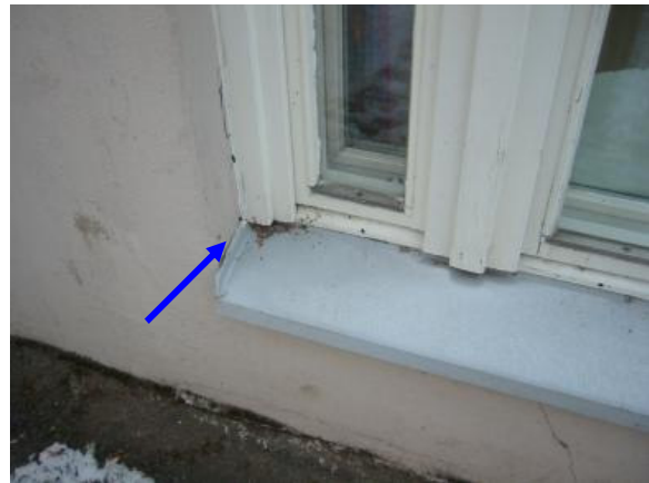
Kuva 8 Vesipeltien tiivistykset puutteelliset.
