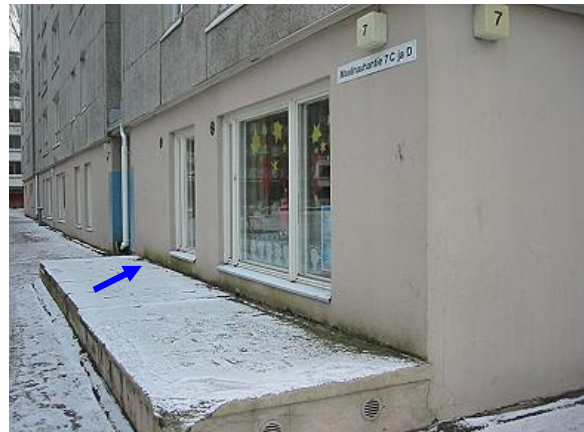
Kuva 4 Betonikorokkeen kohdalla lastenhuonetta 3, jonka lattiassa mm lähellä ulkoseinää kohonnutta kosteutta.
