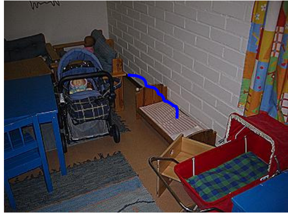
Kuva 6 Tarvikevaraston ulkoseinässä 1. tiilirivin korkeudella hieman normaalista poikkeavat lukemat.
