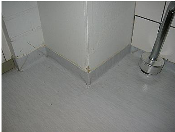
Kuva 7 Pesuhuoneessa 1 levyrakenteisen kotelon alaosalla kosteuden aiheuttamia jälkiä. Muovimaton sauma puutteellinen.
