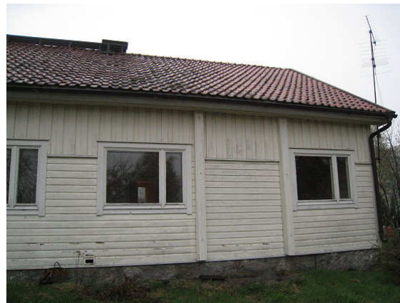
Kuva 10 Julkisivua etelän puoleiselta sivustalta. Ulkovuoritus on alaosaltaan huonokuntoista. Kulmassa havaittiin lahonnutta hirsirunkoa.
