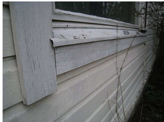
Kuva 16 Vesipeltien asennuksissa havaittiin puutteita.
