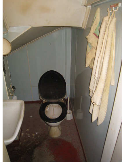
Kuva 18 2. asunnon WC-tilan pinnat ovat kuluneet.
