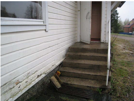
Kuva 9 Julkisivuoritus on alaosaltaan huonokuntoista pohjoisen puoleisella sivustalla. Portaat ovat kuluneet.
