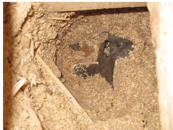
Kuva 4 Alapohjalaatan yläpinnassa on kreosottia sisältävä piki + tervapahvi .
