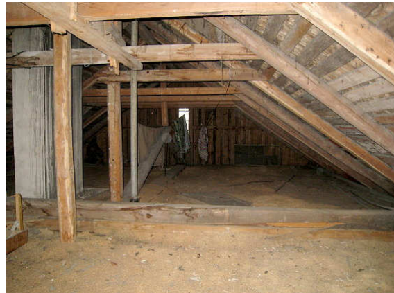
Kuva 14 Ullakon tuulettuminen vaikutti puutteelliselta.
