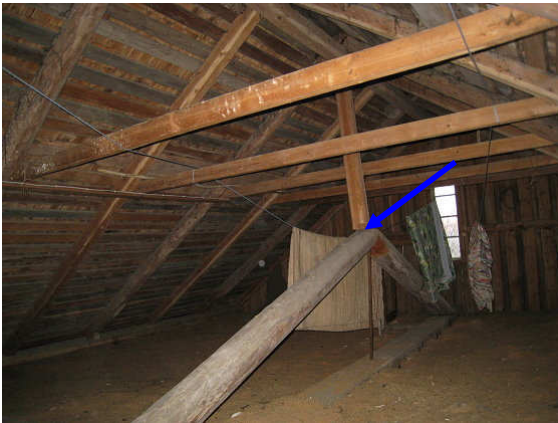
Kuva 13 Vesikattorakenteen epävarman oloinen tuenta.
