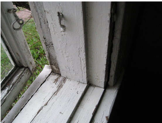
Kuva 15 Ikkunoiden puitteissa ja karmeissa on kosteusvaurioita.
