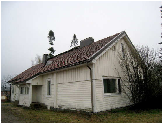
Kuva 1 Kattovedet on johdettu rakennuksen vierustoille. Ulkovuorauslaudoissa on vaurioita.
