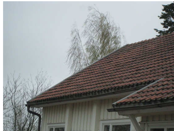
Kuva 2 Räystäskourut ovat paikoin painuneet.
