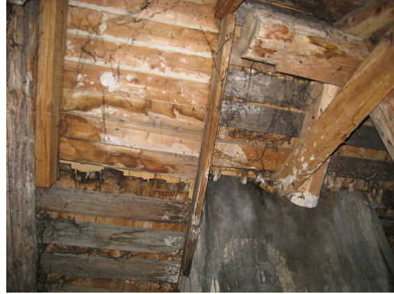
Kuva 12 Päärakennuksen vesikatteen alla pärekattoa, jossa vesivuotojälkiä mm. savupiipun kohdalla.
