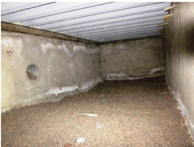
Kuva 7 Sisäänkäynnin kohdalla on teräspoimulevyä. Alustatilaan pääsee puunlehtiä yms..
