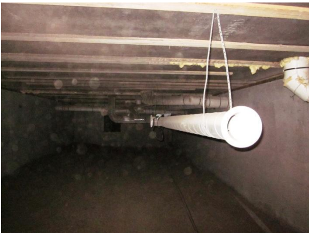
Kuva 10 Alustatilassa on koneellinen poistoilmanvaihto.
