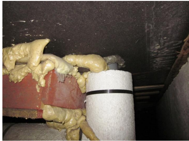
Kuva 6 Tiivistämätön viemäriputken läpivienti.
