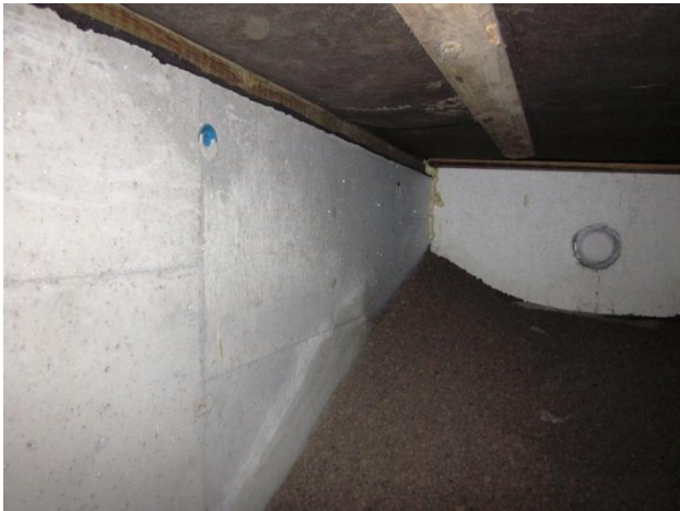
Kuva 1 Perusmuuria on lämmöneristetty polystyreenilevyillä. Päädyssä eristystä ei ole.
