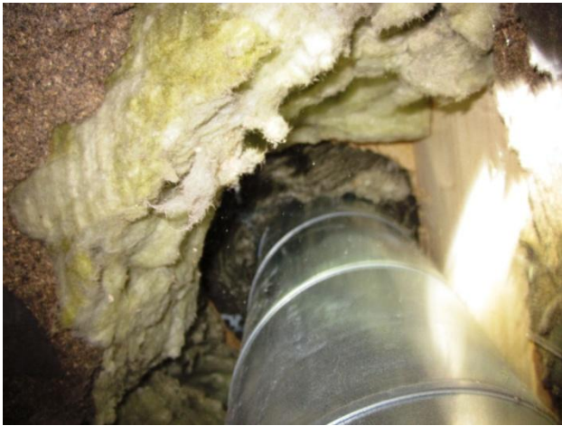
Kuva 5 Tiivistämätön IV-kanavan läpivienti.
