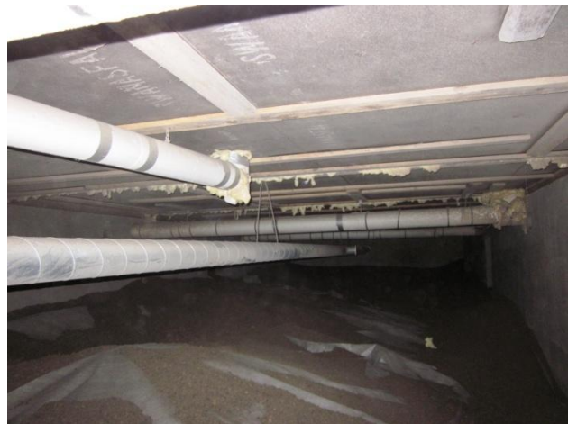
Kuva 4 Alustatilan pinta on epätasainen kallioista johtuen.
