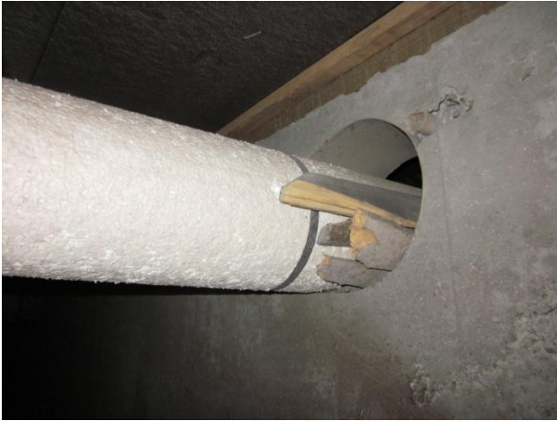
Kuva 12 Perustuspalkin läpiviennissä puutavaran kappaleita.
