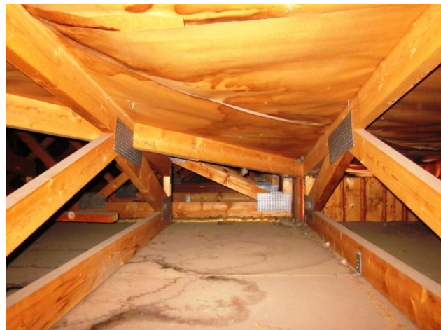
Kuva 14 Jiiritaitteessa vesivuoto-/ kondenssivesijälkiä.
