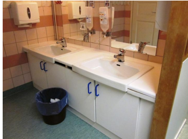
Kuva 22 Allaslevyissä on kosteusvaurioita.
