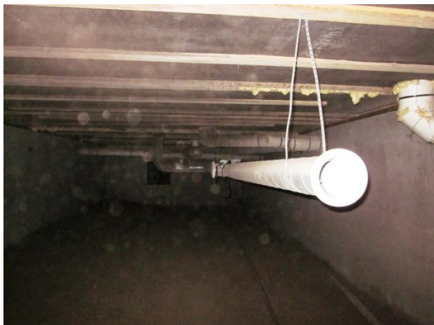
Kuva 5 Alustatila, jossa koneellinen poistoilmavaihto.
