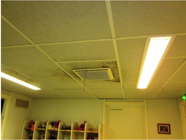
Kuva 17 Vesivuotojälki eteistilan 9 kohdalla.
