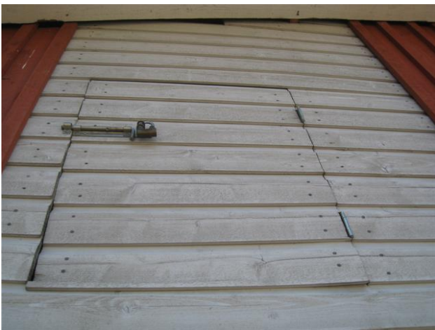
Kuva 13 Luukku yläpohjatilaa. Luukku kantaa, jolloin avaaminen on hankalaa.
