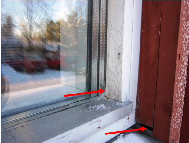
Kuva 11 Lasielementin tiivistyssilikonia on irronnut. Vesipeltien asennuksissa on puutteita.
