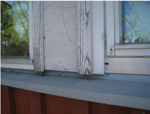
Kuva 9 Ikkunaväljen vanerilevyjen ja puulistojen pinnat ovat huonokuntoiset.
