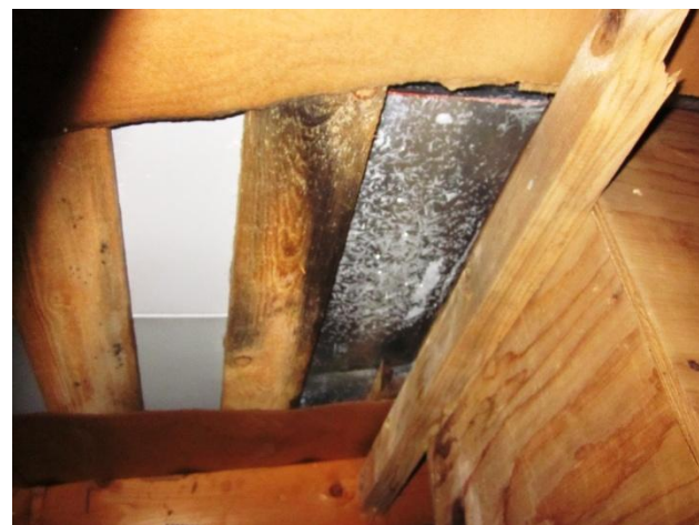
Kuva 16 Aluskatteen asennuksessa on puutteita. Epätiivis vesikatteen läpivienni.
