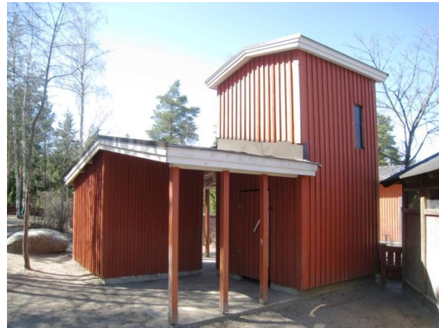
Kuva 10 Piharakennuksen julkisivulaudoitus on liian lähellä maanpintaa.
