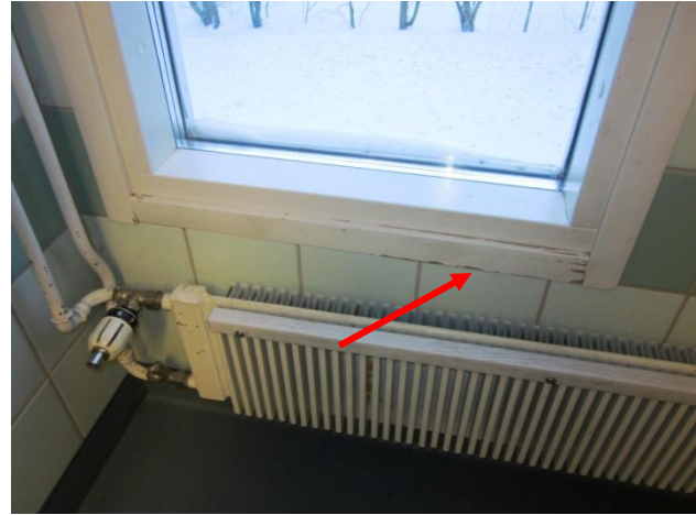
Kuva 12 Tuuletusikkunoiden kohdilla on kosteusjälkiä.
