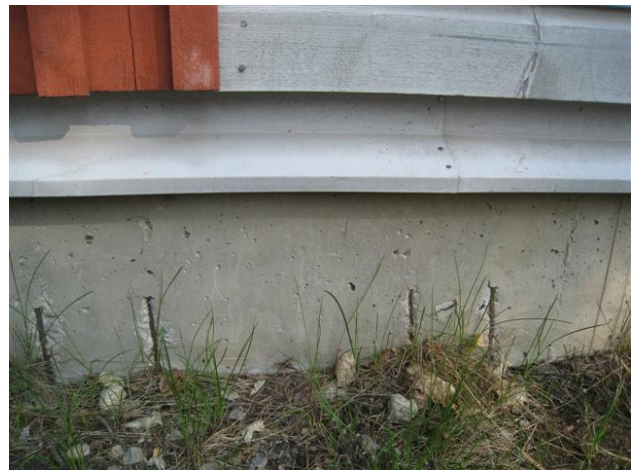
Kuva 4 Kaakon puoleisessa päädyssä näkyvillä raudoitusta.
