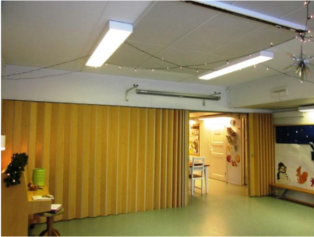
Kuva 7 Yläpohjarakenne on painunut. Liikuntatila 30.
