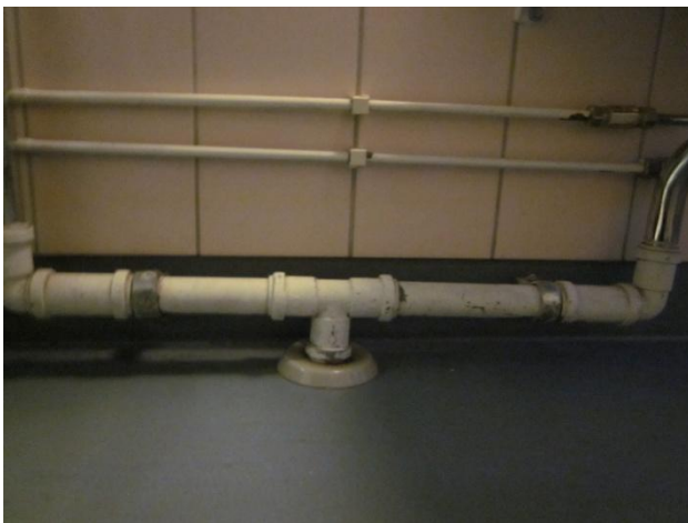
Kuva 24 Viemäriputken kaato on vesipisteelle päin.
