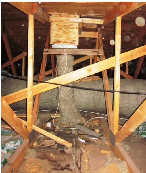
Kuva 15 Läpiviennin kohdalla vesivuotojälkiä.
