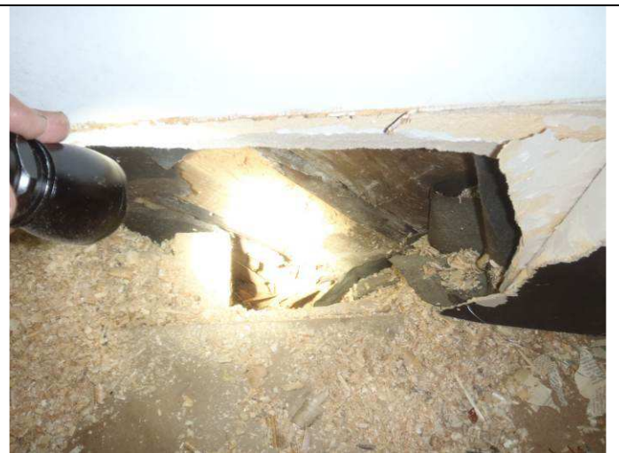
5. Ulkoseinärakennetta sivu-ullakolla, seinän ulkopinnan vinolaudoitus on lahovaurioitunut
