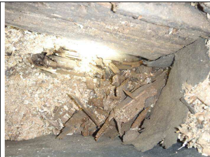
4. Ulkoseinärakennetta yläpohjakolmion päädyssä, seinän ulkopinnan vinolaudoitus sekä pystyrungon ulkopinta on lahovaurioitunut
