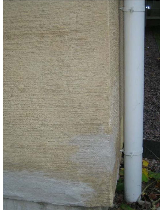
Kuva 20. Nurkkahalkeama ja laastipaikkauksia sokkelin yläpuolella (U).
