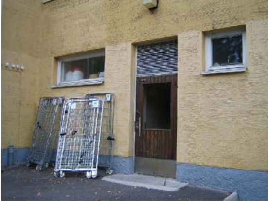
Kuva 6. Vanhan rakennuksen (V) korjausmaalaus on tehty toistamiseen 1. kerroksen ikkunoiden ylälaidan tasolle (rakennuksen ympäri).
