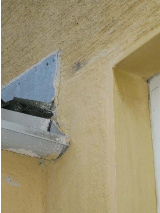
Kuva 10. Virheellinen seinään päättyvä liittymädetalji (kouru ja ylösnostopelti), (V).
