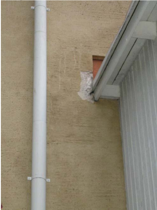
Kuva 18. Uusi osa etelään, yhdyskäytävän räystäsliittymän aiheuttama vaurio rappauksessa.
