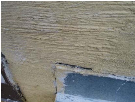
Kuva 15. Vaurioitunut rappaus. Ylösnostopellin liittymä rappauksen ei vastaa esim. RT 85-562- kortin ohjetta (V).
