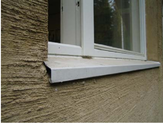
Kuva 22. Ikkunapellin ”tippanokka” on liian lähellä rappausta ja aiheuttaa ylimääräistä kosteusrasitusta (U). Ikkunapeltien kaadot ovat monin paikoin turhan pienet.
