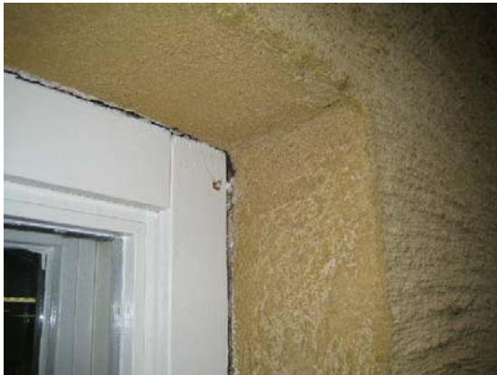
Kuva 23. Ikkunoiden pielirappauksien ja karmien saumat eivät ole vesitiiviit (U). Elastinen kittaus auttaisi asiaa.
