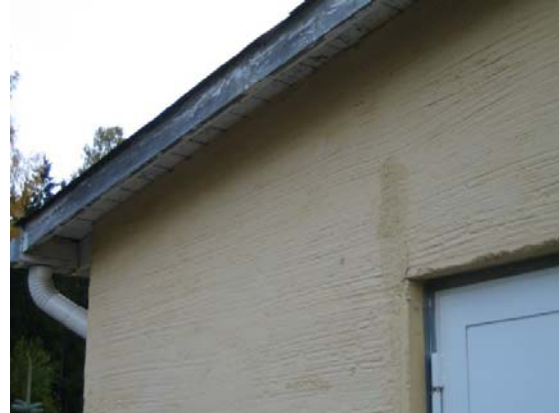
Kuva 12. Räystään pelti on virheellinen, otsalauta on vaurioitunut (V).
