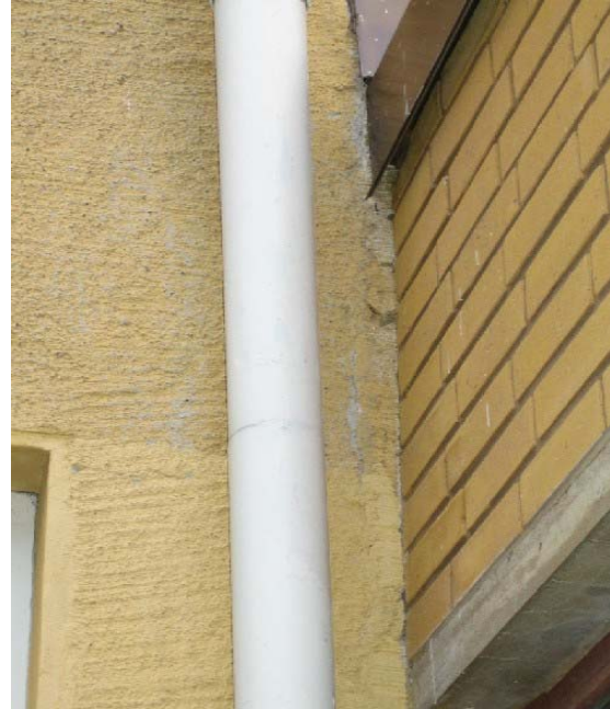
Kuva 4. Tyypillinen liittyvän rakennuksen nurkkahalkeama (V).
