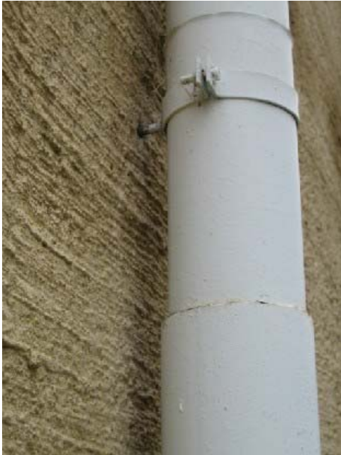
Kuva 26. Syöksytorvien kiinnitykset ovat virheellisesti vaakasuoria.
