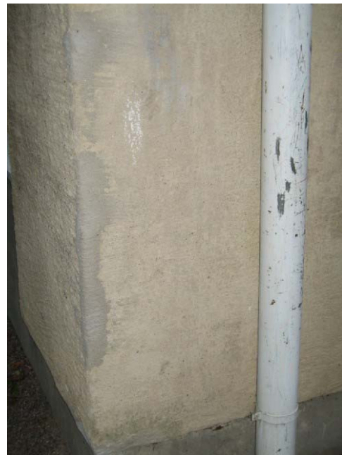
Kuva 25. Koillisnurkan laajaa rapautuma- aluetta syöksytorven taustalla (U).
