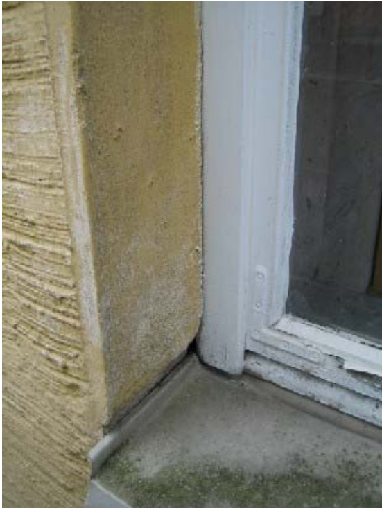
Kuva 14. Tyypillinen ikkunapellin liittymä piilirappaukseen ja pieni lohkeama. Ei vastaa esim. RT 85-10562- kortin ohjetta (V).
