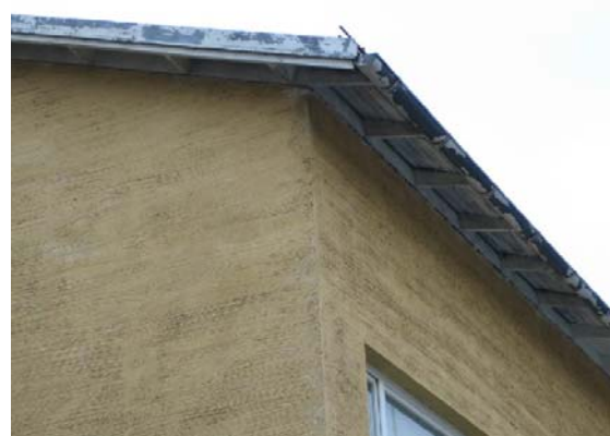
Kuva 13. Räystäärakenteiden (puu ja kourut) pintamaali on hilseillyt pahoin (V). Katto vuotaa mahdollisesti lumiESTEiden kiinnikkeistä.
