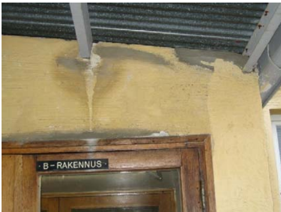
Kuva 11. Katto- ja ovirakenteiden liitoksissa rappauksen lohkeilua, pääsisäänkäynti (V).
