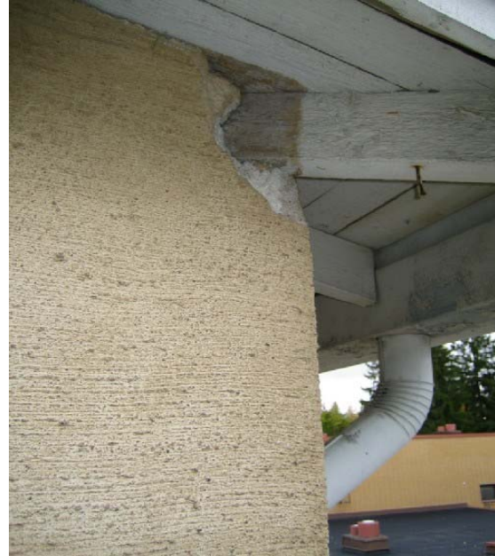
Kuva 28. Kattorakenteen ja rappauksen liitoskohdan lohkeama (U).
