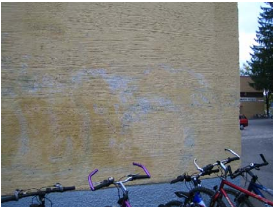
Kuva 7. Pintarapautumista vanhan rakennuksen eteläpäädyssä (V).
