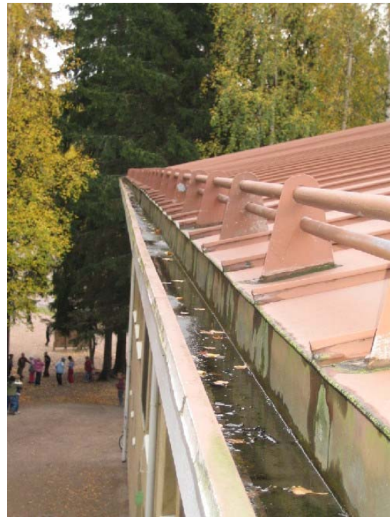
Kuva 29. Vesikouruissa ei havaittu mainittavia vaurioita. Kuvassa mahdollisesti vuotavat kattosillan kiinnikkeet (U).
