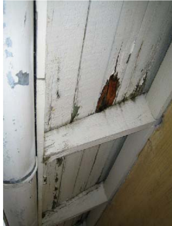
Kuva 16. Räystäänaluslaudat ovat paikoittelun lähes läpi lahonnet (vanha ja uusi)
