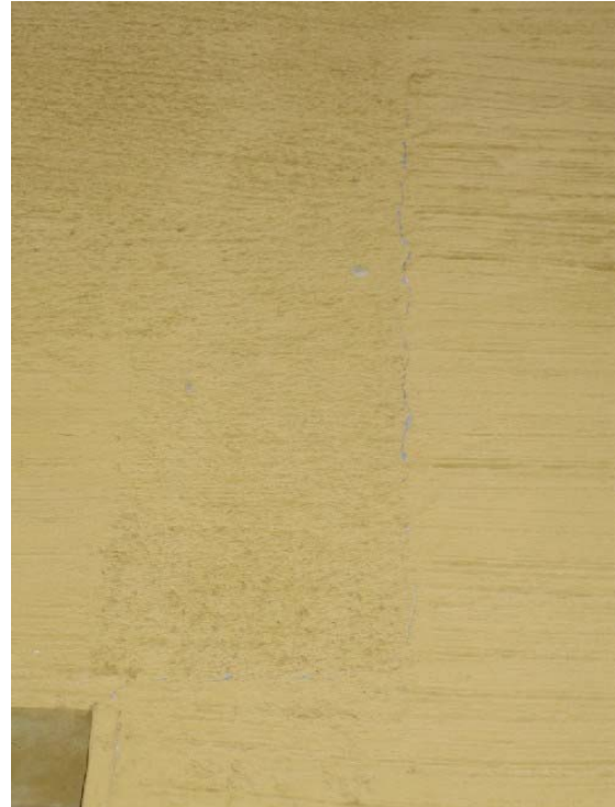
Kuva 8. Tyypillinen kapea halkeama laasti paikatuksen kohdan ja vanhan rappauksen saumassa (V).
