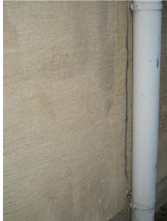
Kuva 24. Pohjoispuolen liikuntasäama on ”epämääräinen” ja vaurioitunut (U).
