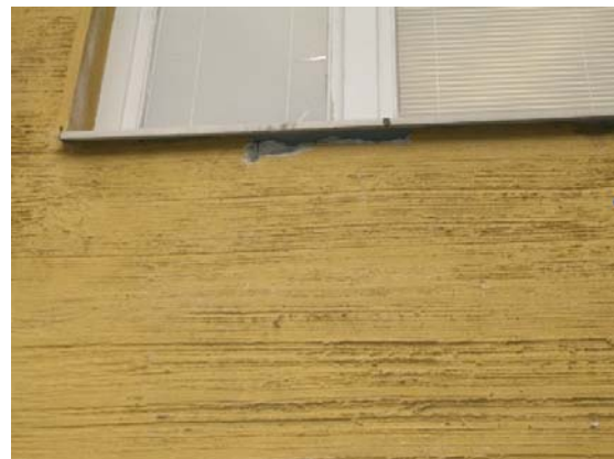
Kuva 5. Tyypillinen ikkunapellin alla oleva vähäinen lohkeama kiinnityslangan kohdalla (V).
