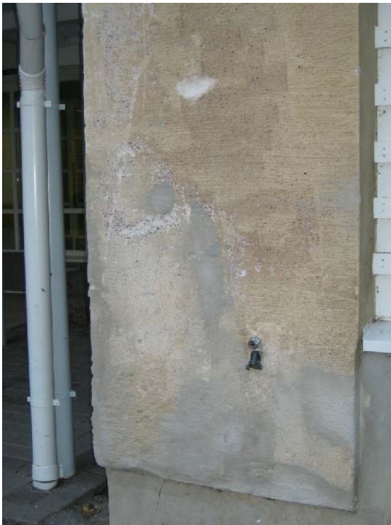
Kuva 27. Itäjulkisivun pintarapautumista ja paikkausalueita (U).
