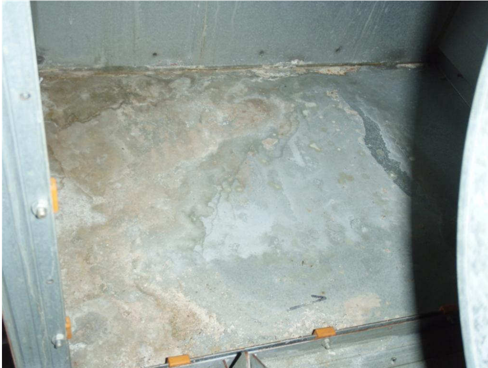
KUVA 4. Kosteuden jättämiä jälkiä poistoilmakammiossa.
