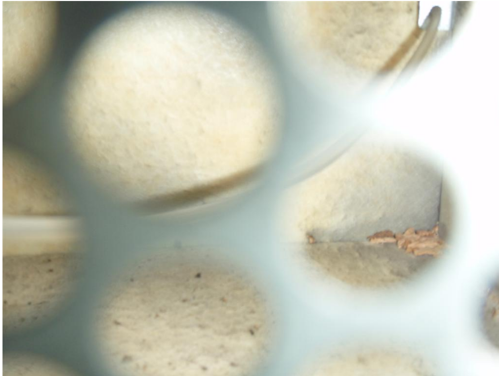
KUVA 2. Tuloilman pääte-elimessä kuivia lehtiä ja muuta likaa.
