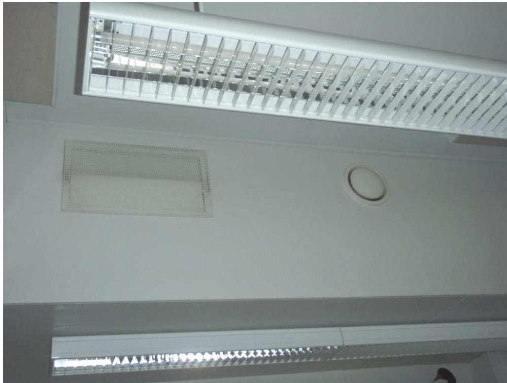
KUVA 6. Huonetilojen tulo- ja poistoilmaventtiilit.
