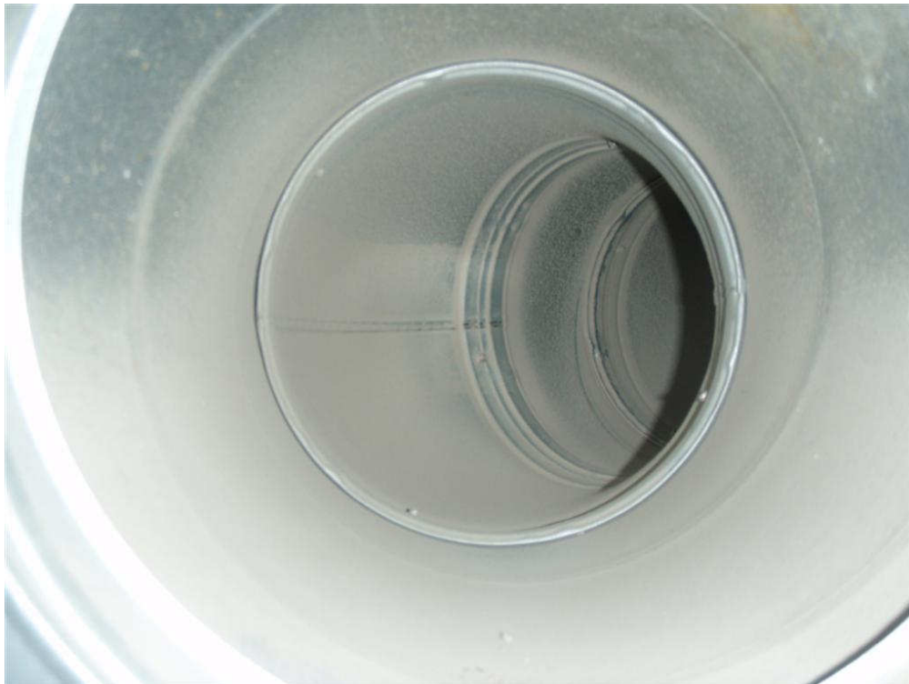
KUVA 3. Poistoilmakanavat ovat melko likaiset.
