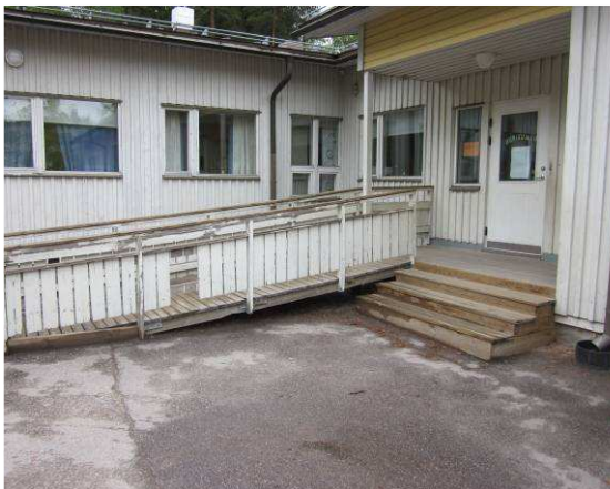
Sisääntulorampissa ja portaissa on korjaus- tarvetta
