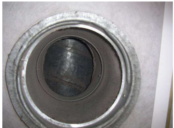
Päiväkodin ilmanvaihtokanavat olivat vielä melko puhtaita.
