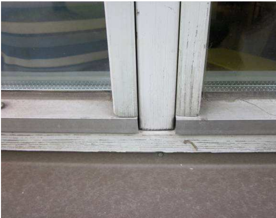
Hilseilyä ikkunan maalipinnassa.
