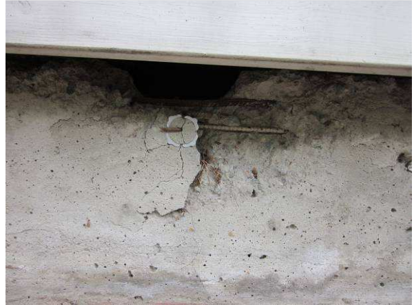
Epätiiveytskohta sokkelissa, josta pieneläimet pääsevät alapohjatilaan
