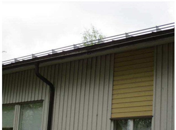
Räystäskourun kannake on taipunut
