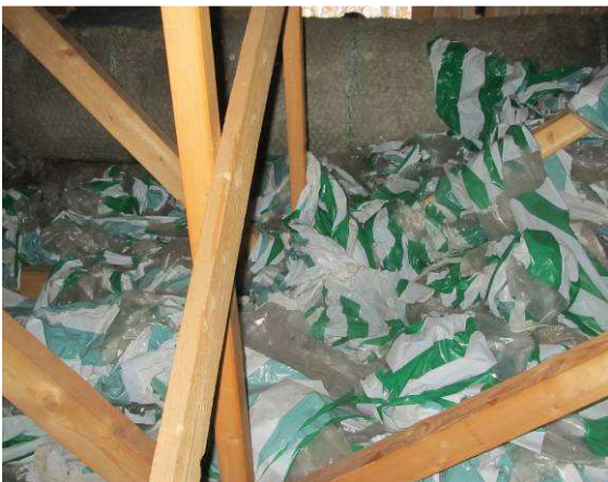
YP. tilassa on rakennusjätettä
