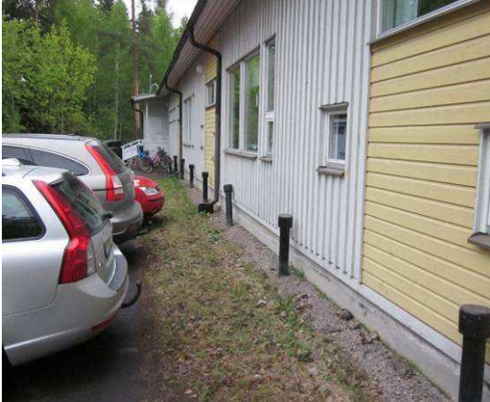
Sokkelin vierustalla asianmukainen sora- tus, alapohjan tuuletusputkia on arviolta riittävästi
