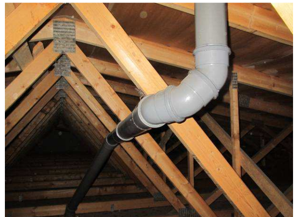
Aluskatteen päällä ei ole korotusrimoja ja tuuletusputkea ei ole eristetty, putken kannakointi OK
