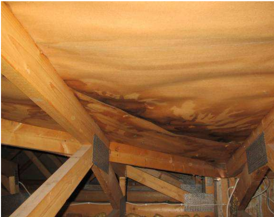
Jiirin kohdalla aluskatteessa on laajasti kosteusjälkiä
