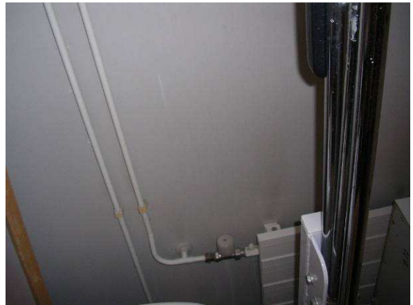
Käyttövesipatterien venttiilit ovat vuodelta 1989.
