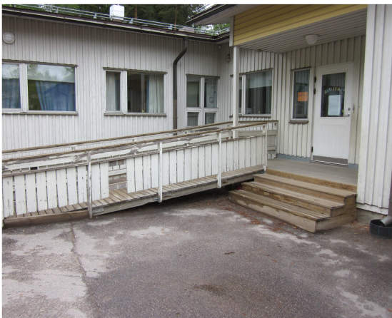
Sisääntulorampissa ja portaissa on korjaus- tarvetta
