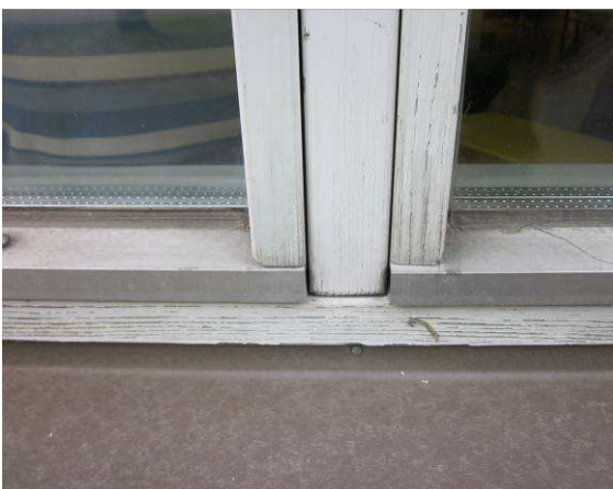
Hilseilyä ikkunan maalipinnassa
