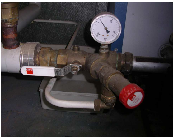
Käyttöveden paine oli noin 6 bar.
