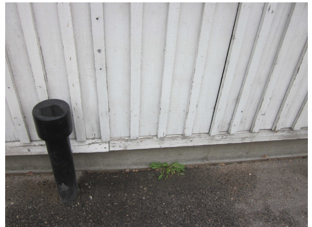
Ulkoverhouksen huoltomaalaus ja kunnostus ajankohtaista jakson alussa
