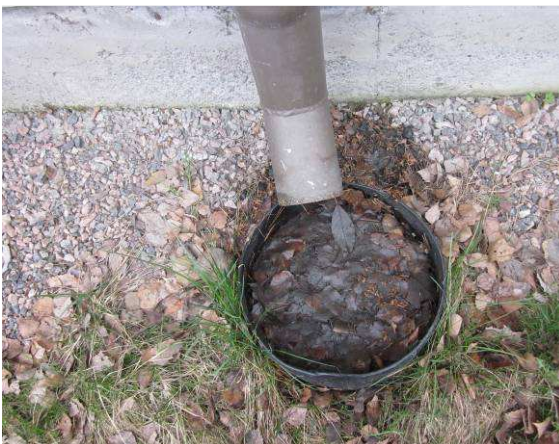
Rännikaivojen puhdistuksesta tulisi huolehtia säännöllisesti
