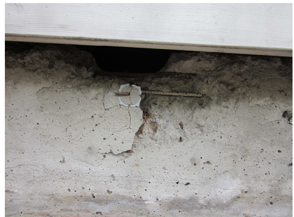
Epätiiveyskohta sokkelissa, josta pieneläimet pääsevät alapohjatilaan
