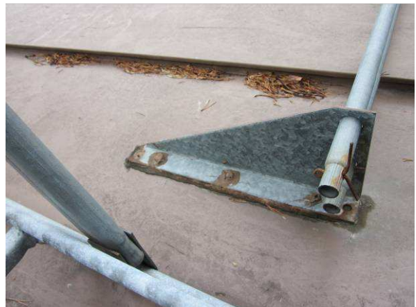
Lumiesteiden kiinnikekohtia on paikattu kittamalla
