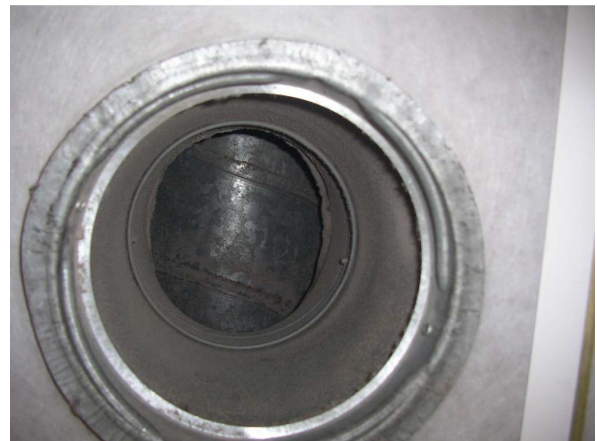
Päiväkodin ilmanvaihtokanavat olivat vielä melko puhtaita.
