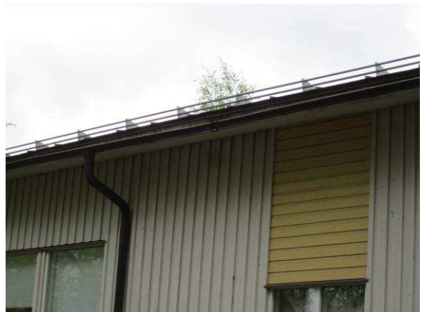
Räystäskourun kannake on taipunut
