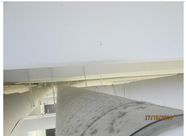
IV-kanavien päällä on runsaasti pölyä (tila 165).
