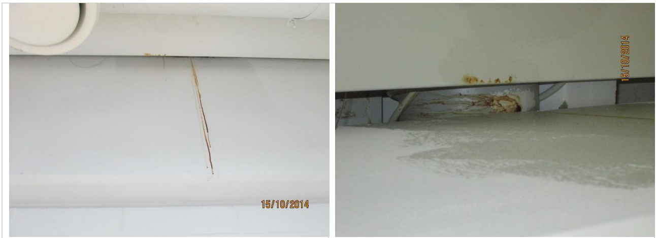
Veden aiheuttamia vaurioita kattorakenteessa.
