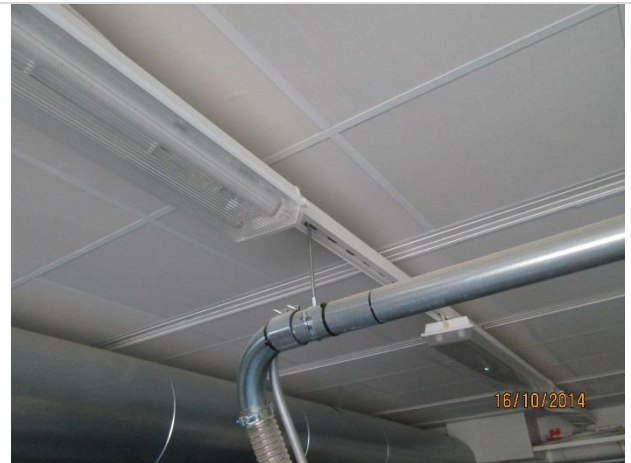
Pölyjä IV-kanavien ja valaisinkiskojen päällä.
