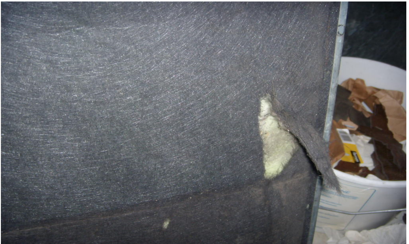
KUVA 4. Tuloilmakoneen kammiot on eristetty mineraalivillalla, joka on paikoin rikki.
