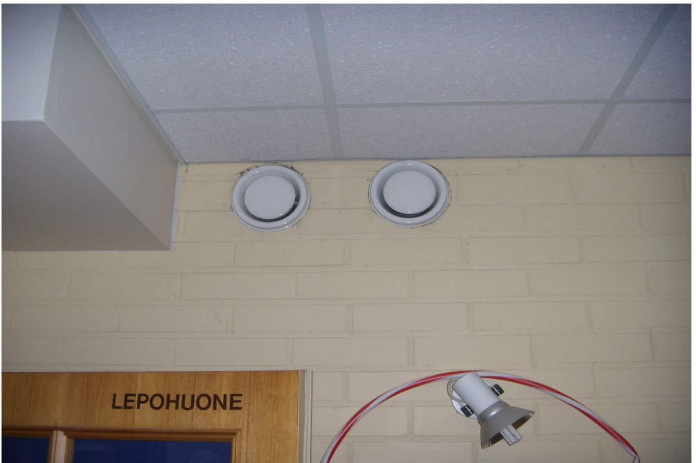
KUVA 12. Yleiskuva huoneiden poistoilmaventtiileistä.
