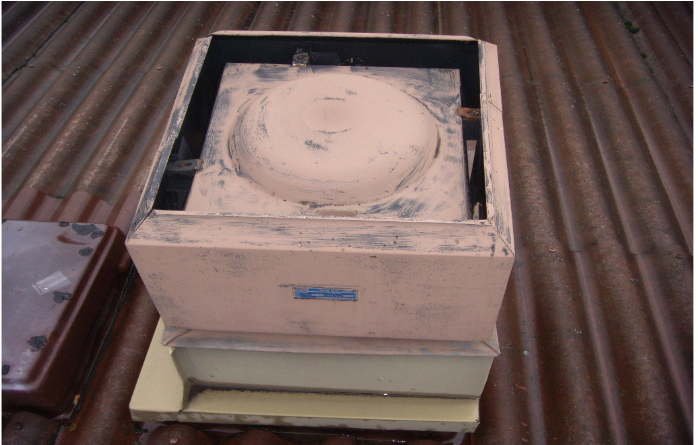
KUVA 7. Yleiskuva vesikatolla olevasta huippuimurista.
