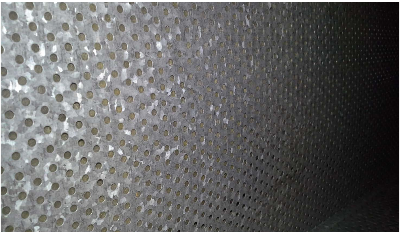
Kuva 9. Lähikuva tuloilmakoneen äänenvaimenninpellistä, jonka sisällä näkyy mineraalivilla
