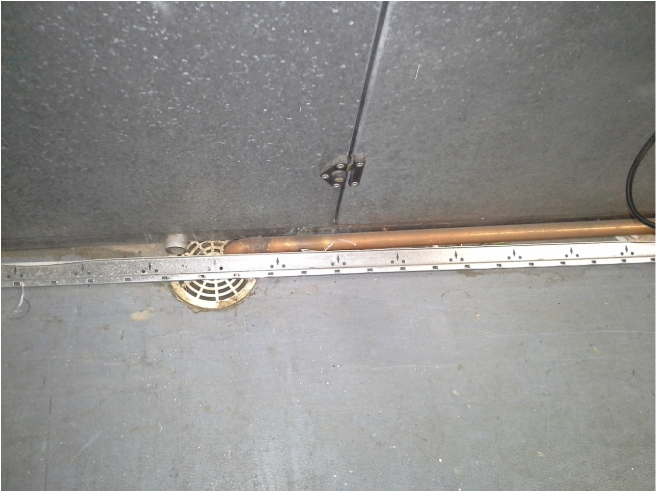
Kuva 4. Tuloilmakammion vedenpoisto yhdistyy suoraan lattiakaivoon.
