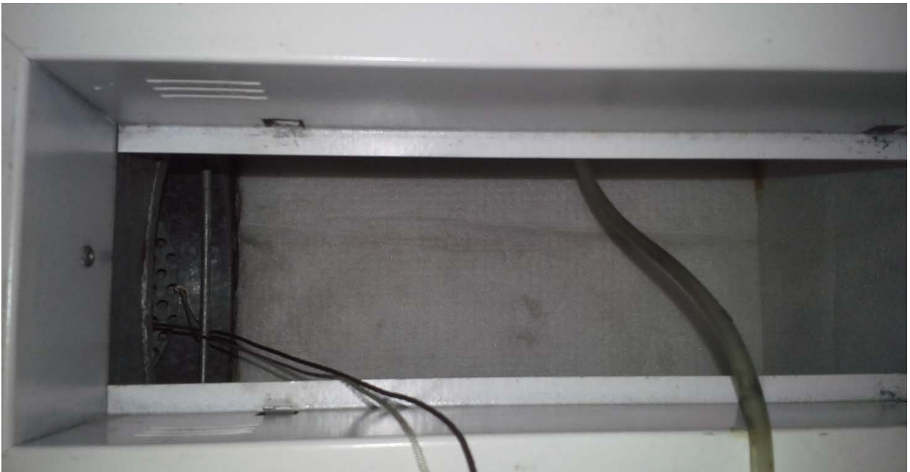
Kuva 7. Tuloilman päätelaite, josta villainen äänenvaimennin on vaihdettu
