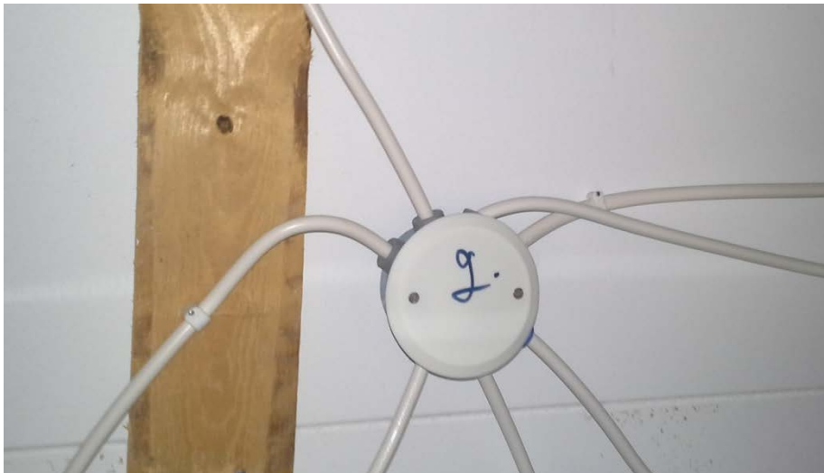
Kuva 11. Vuotava sähköläpivienti alakaton yläpuolella(
