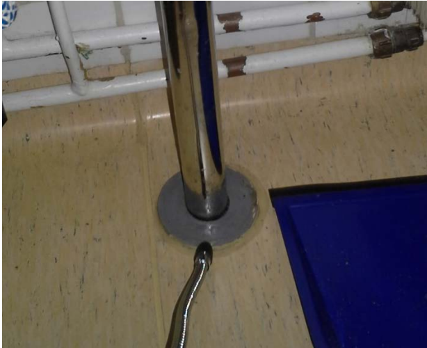
Kuva 10. Lavuaarin läpivienti vuotaa
