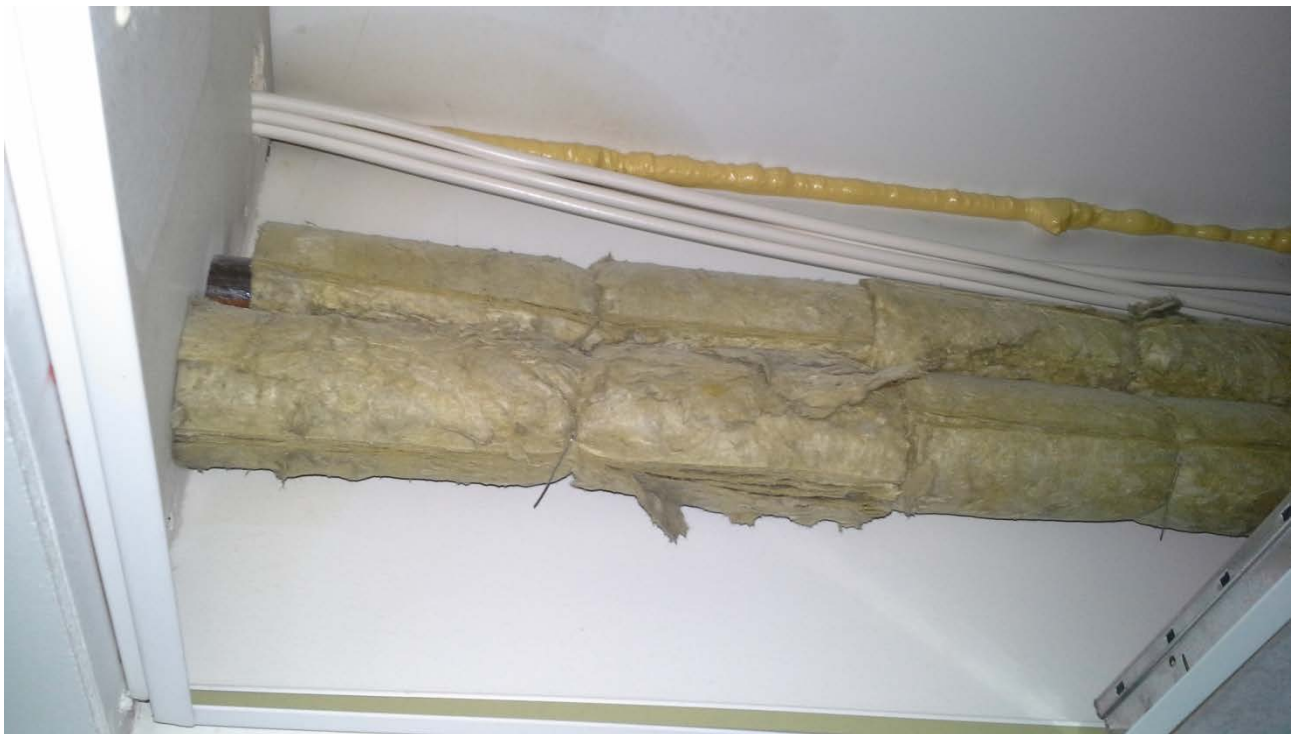
Kuva 5. Lasivillalla eristettyjä putkia alakaton yläpuolella
