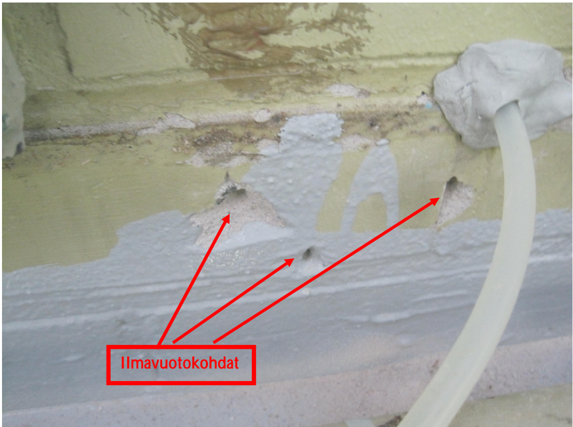
Kuva 2. Ulkoseinän sisäkuori, jossa havaittiin ilmavuotokohtia.
