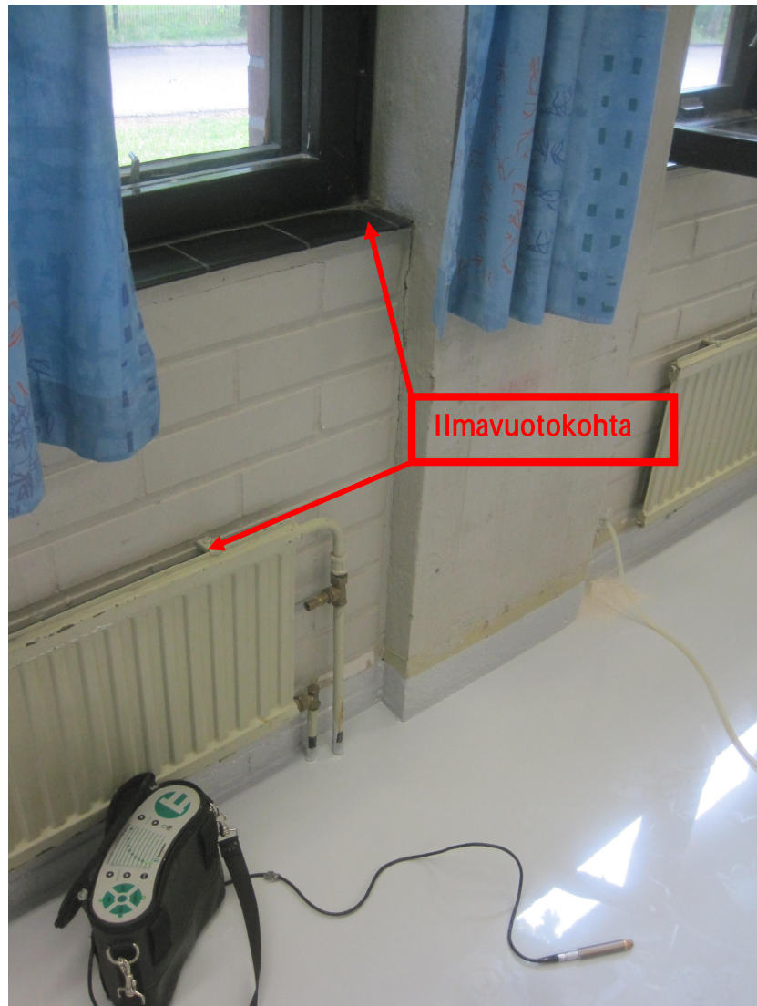
Kuva 4. Ulkoseinän sisäkuori, jossa havaittiin ilmavuotoja
