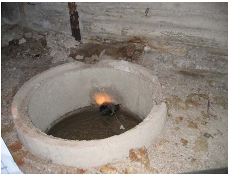
Kuva 1. Putkikanaalissa oleva salaojakaivo johon tulee asentaa tiivis kansi.
