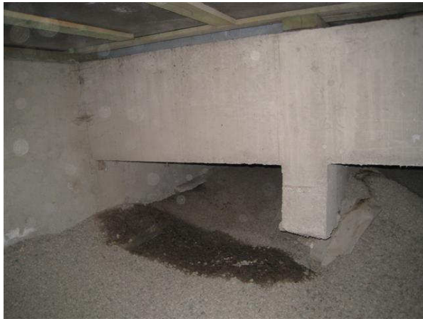
Kuva 21 Vuotojälkiä sisäänkäyntisyvennyksen palkin kohdalla. Varmaa vika ei saatu selville, esim. viistosade voi valua.
