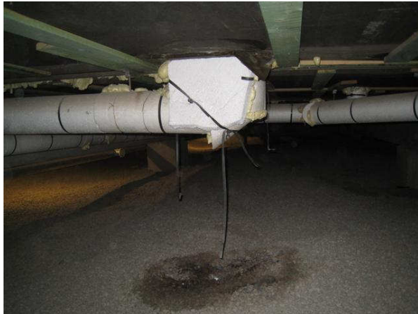
Kuva 15 Wc-tilan 46 tienoilla oleva vesivuotojälki sepelissä ja viemäriiliittymässä.
