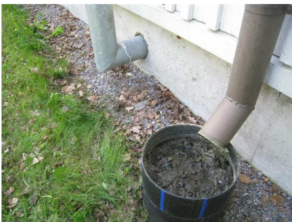
Kuva 5 Rännikaivoissa oli tukkeena maatunutta lehtijätettä, joka voi aiheuttaa ylitulvimisen.
