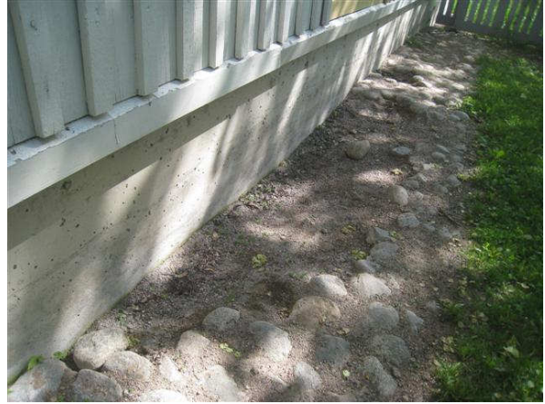
Kuva 8 Maanpinnan painuma/ on poistettu mukulakiviä eteläpäädyssä, joka kerää pintavesiä.
