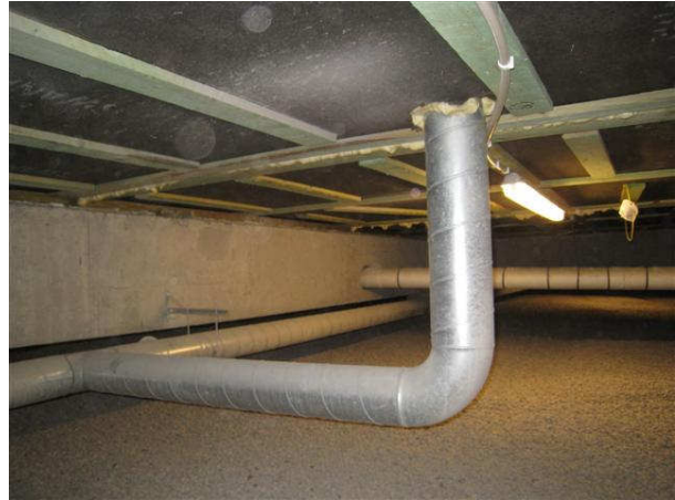
Kuva 22 Alustatilan poistoilmavaihto tapahtuu koneellisesti peltikanavien kautta vesikatolle.
