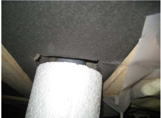
Kuva 18 Tiivistämätön viemärin läpivientikohta.
