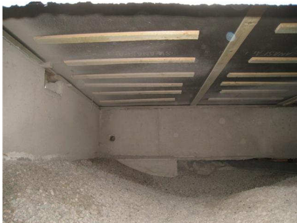
Kuva 11 Sokkelipalkkien vastatäytöt ovat osin hieman vajaat, pääosin hyvät.
