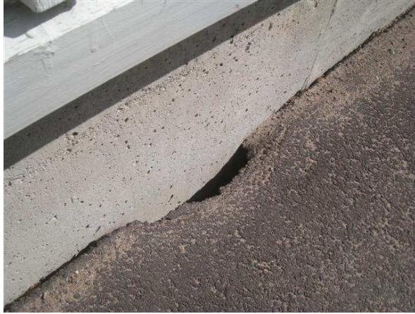
Kuva 7 Asfaltin painannereiän kohdalta voi päästä pintavesiä.
