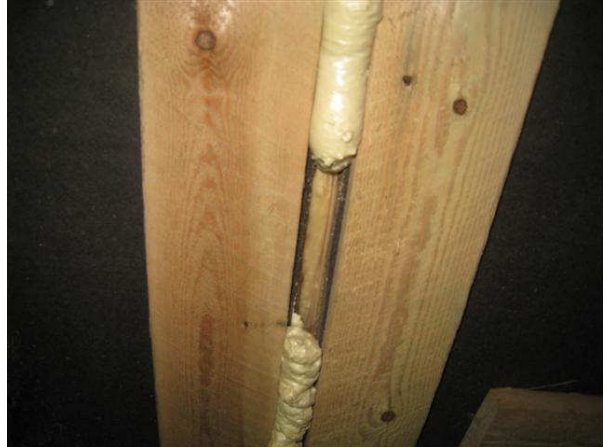
Kuva 16 PU-saumaus on osin kesken tai irronnut alapohjaelementtien saumassa.
