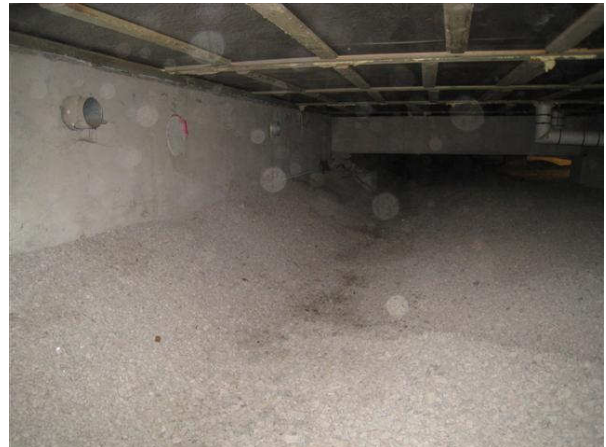
Kuva 12 Painanteissa sepelipinnassa on paikallisesti hieman kosteutta.
