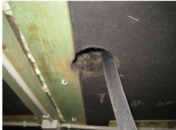
Kuva 24 Sähkökeskuksen kaapeliläpivienti on tiivistämättä myös alustatilassa.
