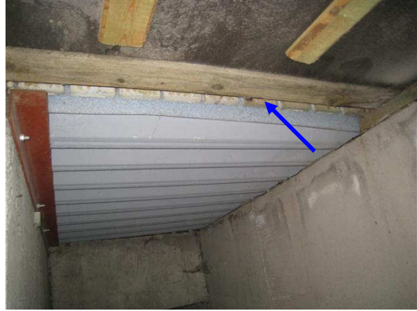
Kuva 20 Sisäänkäyntisyvennyksen liittymä, jossa ulkovoorauslaudoituksen ja laatan välissä on rako.
