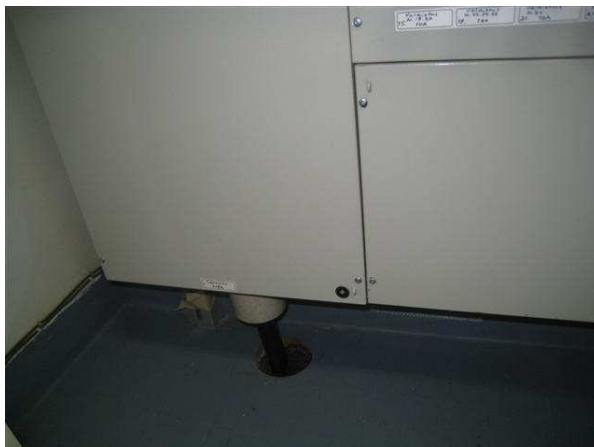
Kuva 23 Teknisen tilan lattiassa sähkökeskuksen kaapeliläpivientiä ei ole tiivistetty yläpuolelta.
