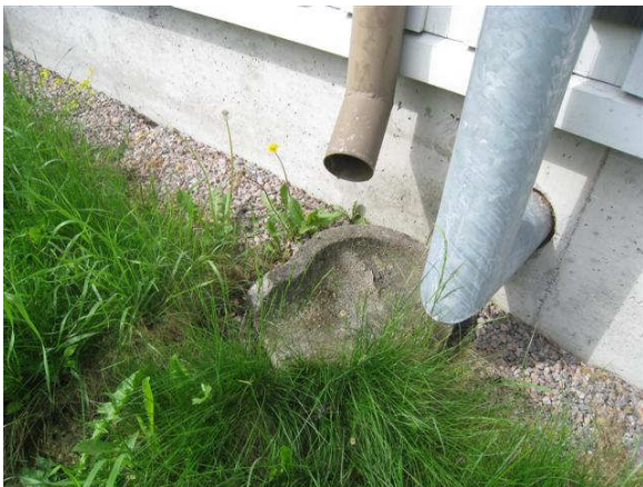
Kuva 6 Loiskekouru on pois paikaltaan, rännivesiä valuu perustusten juureen ja edelleen alustatilaan.
