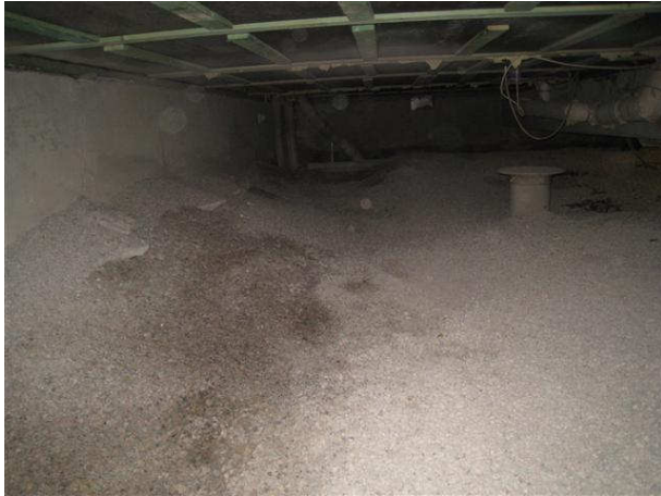
Kuva 13 Ulkoseinävierillä paikallisesti kosteaa sepeliä, mutta ei mikrobikasvua.
