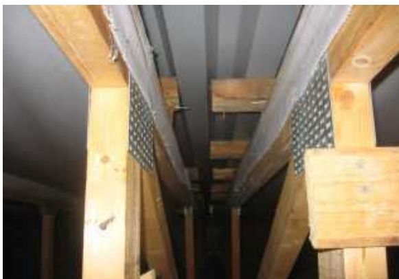
Kuva 3 Kaikkien parakkilohkojen välisiltä kohdilta puuttuu aluskate. Aluskate on vedetty virheellisesti harjalta räystäälle eikä harjan suuntaisesti limitettyä.
