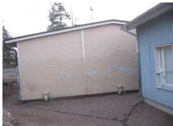
Kuva 14 Itäisivulla maanpintojen kallistus on piehenkö ja loiskekourujen vietto vaikuttaa riittämättömältä.
