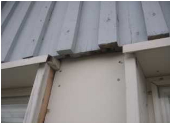
Kuva 13 Ulkovuorauksen taustan tuuletus on tällä kohdilla puutteellisesti järjestetty. Ikkunoiden yläreunan vesipelti ei suojaa riittävästi, laudan päät kastuvat.
