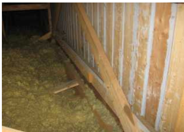
Kuva 10 Päätyseinän vieressä lämpöeristys on vajaa. Vuorauslautojen koolaus on tehty harvaan, tuulisuojava ei ole lainkaan.
