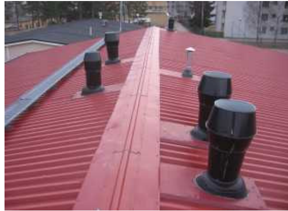
Kuva 12 Yleisnäkymä vesikatolta. Harjapellin molemmin puolin on lisätty pellit. Peltien alla ei ole solumuovitiivistettä.
