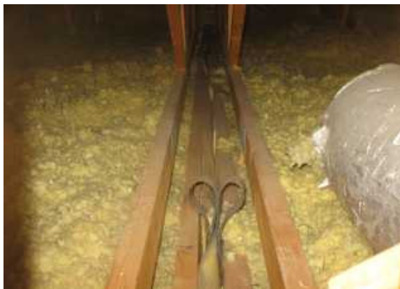
Kuva 7 Parakkilohkojen liittymien kohdalla lämpöeristys on puutteellinen. Höyrinsulun liittymän tiiveyttä ei päästy tarkastamaan. Lämpöeristysten paksaus liittymän vieressäkin on vain 15 cm.
