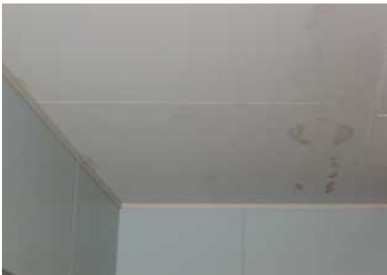
Kuva 1 Sisäpuolisia vuotojälkiä katossa (Mikko Krohnin ottama valokuva v. 2005)
