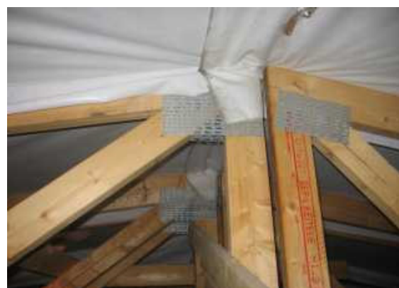
Kuva 4 Aluskatteen liitos harjalla on epävarma, koska aluskate on taitettu alas. Harjapellin alle pääsevä vesi valuu tästä alas.
