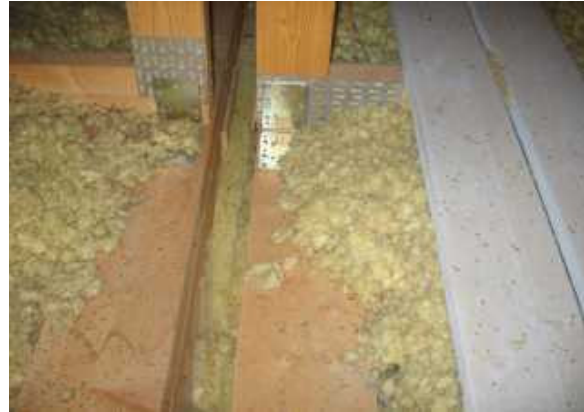
Kuva 8 Harjalinjalla on huono lämpöeristys lohkojen liittymässä. Höyrinsulun liittymän tiiveyttä ei päästy tarkastamaan.
