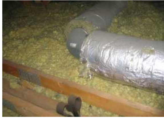
Kuva 6 IV-kanavan mutkassa ei ole lämpöeristystä, joten voi tapahtua kondenssia.
