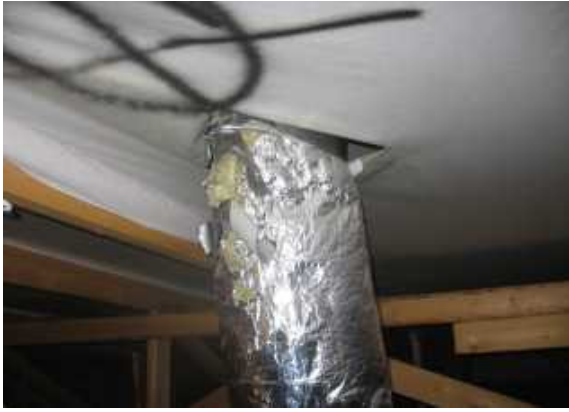
Kuva 5 Tyypillinen IV-kanavan läpivienti, jossa aluskatetta ei ole tiivistetty.
