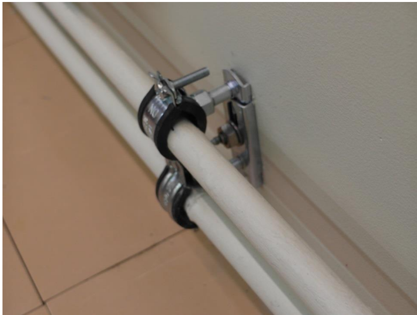
Kuva 4. Putkikannakkeen juuresta havaittiin ilmavuotoa.
