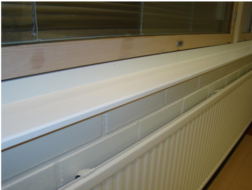
Kuva 3. Ikkunapenkin etureunan alta havaittiin muutamista kohdista ilmavuotoa.
