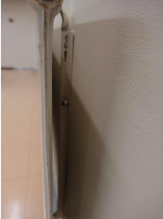
Kuva 5. Patterikannakkeiden juureista havaittiin ilmavuota merkkiainekokeessa 12.12..
