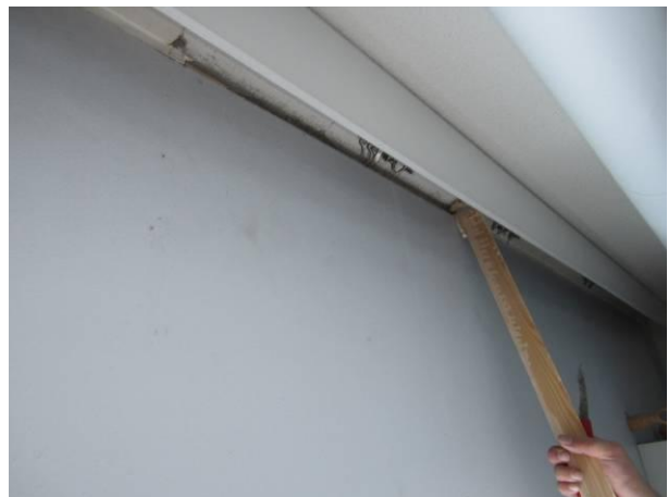
Kuva 8. Verhokotelon reunassa listan alla on rako yläpohjaan, tästä tuli merkkikaasua ja lämpökamera osoitti ilma-/lämpövuotoa.
