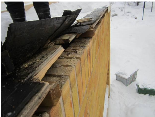
Kuva 3.. Räystääsavaus, myrskypeltiä ei ole.
