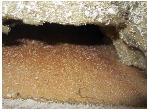
Kuva 6. Kattokuilun villat olivat tummuneet ja kipsilevyssä oli selviä vauriojälkiä.
