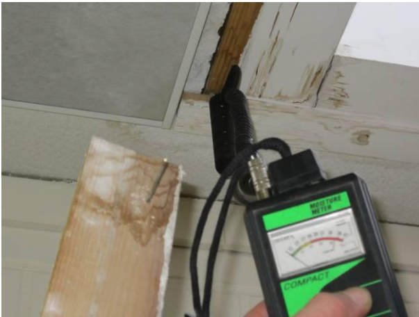
Kuva 5. Kattokuilun reunan vuotojälkiä, puu oli kuiva.
