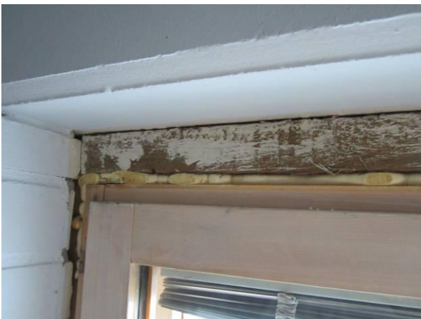
Kuva 7. Ikkunapielen liittymissä vaikutti olevan terveet rakenteet. Kaikkia liittymien rakoja ei kuitenkaan ole kitattu ilmatiiviiksi.
