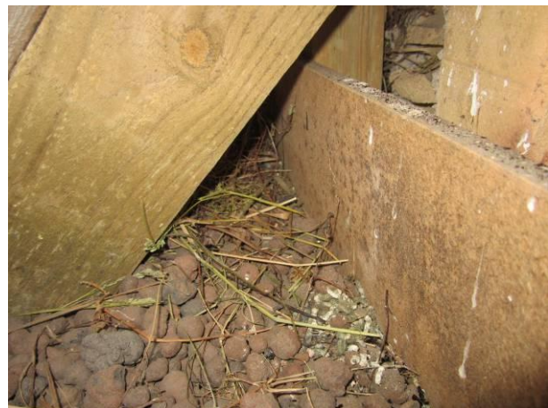
Kuva 4. Yläpohjan rakenteita, kuitulevy ja heinää räystäskotelossa, mikrobinäyte.
