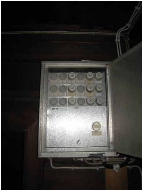
Ison rantasaunan sekä sähköis-saunan ryhmäkeskukset ovat tämän tyyppisiä
