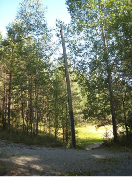
AMKA -linjan viimeinen pylväs on taipunut. Pylvään harus on irti maasta.
