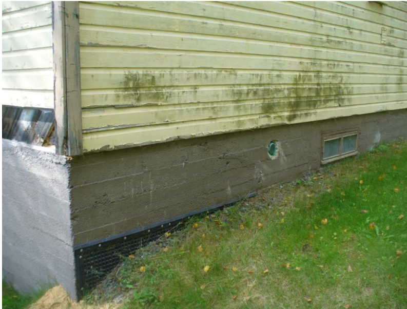
KUVA 7. Viite kohtiin 2.4 ja 2.5. Vanhan päarakennuksen vaurioitunutta seinäpintaa, maanra- jassa oleva kellarin ikkuna, sekä perusmuurin vesieristyslevy.
