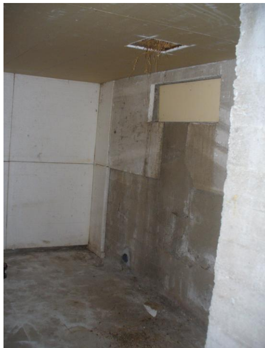
KUVA 2. Viite kohtaan 2.2. Vanhan päärakennuksen kellarikerroksen sisäpuolisessa Styrox-eristeessä on näkyvää hometta ulkopuolisen kosteuden johdosta. Kuvassa näkyy myös levytetyn puuvälipohjan orgaanista mikrobivaurioitunutta lämpöeristystä.
