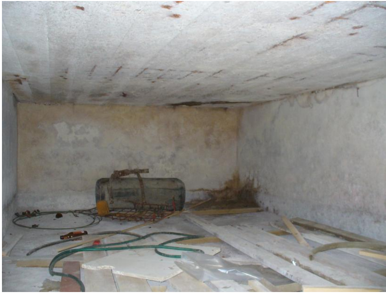
KUVA 9. Viite kohtaan 3.1. Vanhan navettarakennuksen kellarikerroksen betoniholvissa on näkyvissä paljon betoniraudoitusten ruostumista, niin käyttämättömän kuin myös käytössä olevan kellarikerroksen osilta
