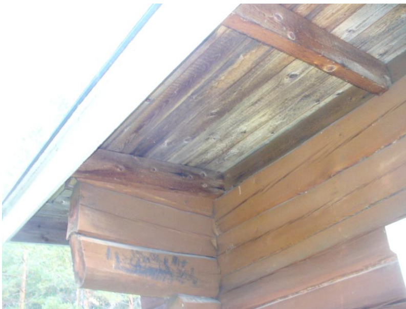
KUVA 20. Viite kohtaan 4.4. Ison rantasaunan pääosin vesikaton suuntaisen yläpohjan tuuletus on tukittu tehokkaasti sekä sivu- että päätyräystäillä. Katteen aluslaudoituksessa on näkyvissä paljon vaurioitumisen merkkejä näkyviltä osiltaan, eniten seinän vierellä
