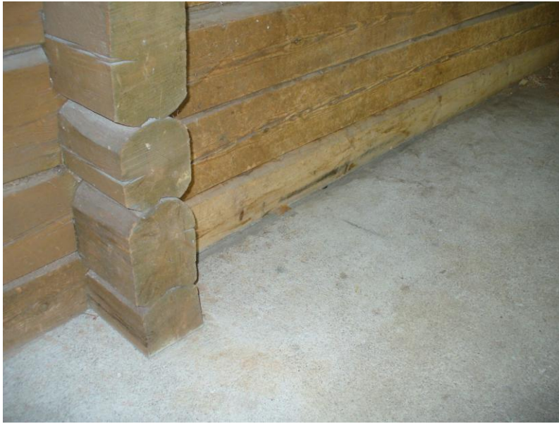
KUVA 19. Viite kohtaan 4.3. Ison rantasaunan hirsirunko lähtee suoraan betonilaattajalustan päältä, merkkejä kapillaarikatkosta ei betonin ja hirsien välissä ole näkyvissä.
