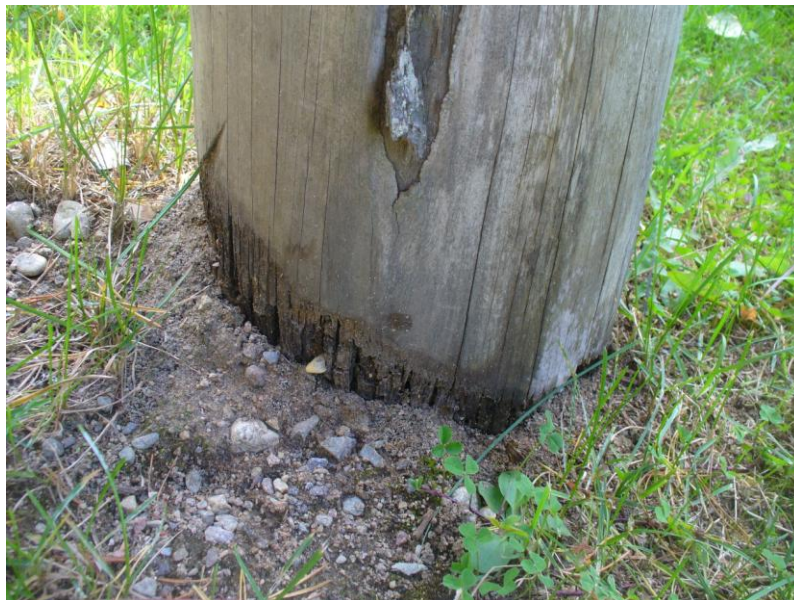
KUVA 26. Viite kohtaan 5.3. Leirikeskuksen pyöröpuista tehdyn leiriportin pystypilareiden alapääät ovat kaikki lahonneet maanrajasta. Raskas portti on kaatumassa
