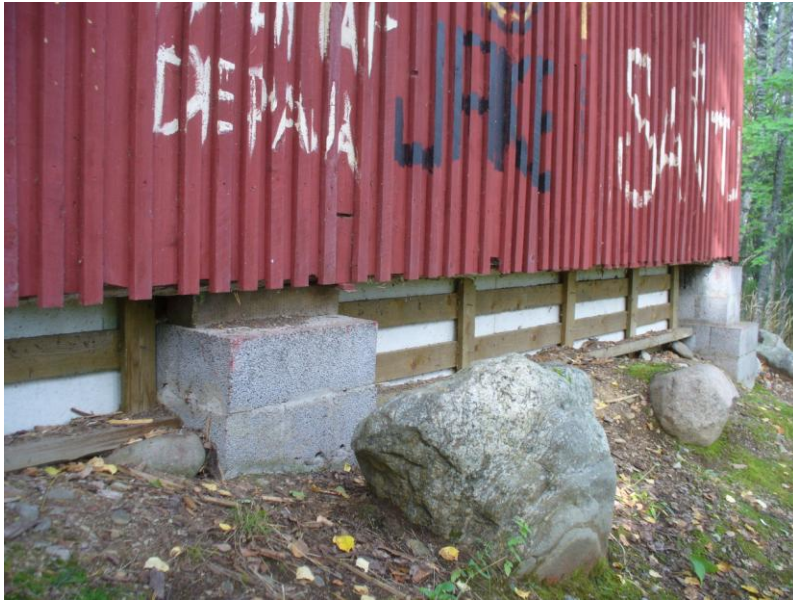
KUVA 13. Viite kohtaan 3.4. Entisen ladon luonnonkiviperustuksia on korjattu eri tavoilla, mm. päädyssä kevytsorabetoniharkoilla
