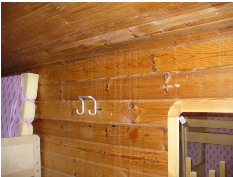
KUVA 24. Viite kohtaan 5.2. Mökissä 13 on vanhojen vesikattovuotojen aiheuttamia vauriojälkiä sekä sisäkatto- että seinäpinoilla
