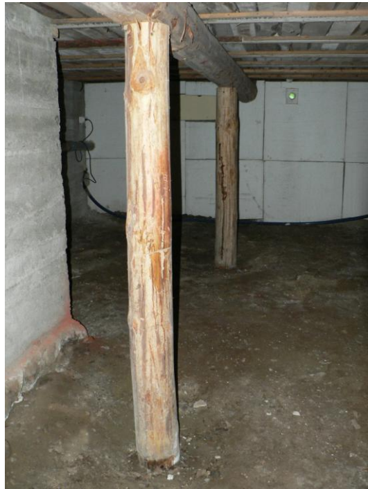
KUVA 3. Viite kohtaan 2.2. Vanhan päärakennuksen maapohjainen alapohjatila on märkä ja homeinen mm. puuvälipohjan kannatustolppien alapäiden osilta.
