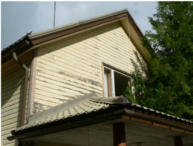
KUVA 8. Viite kohtiin 2.3 ja 2.4. Vanhan päarakennuksen yläpohja tuulettuu käytännössä vain tiilijäljitelmäpellin profiilien alta. Julkisivumaalaus ja pehmenneet verhouspaneelit ovat vähintäänkin täyden maalausremontin tarpeessa
