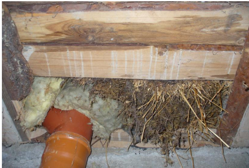
KUVA 4. Viite kohtaan 2.2. Vanhan päärakennuksen kellarin puurakenteisen välipohjan mikrobivaurioitunutta orgaanista lämpöeristettä viemäriputken läpimenokohdassa.
