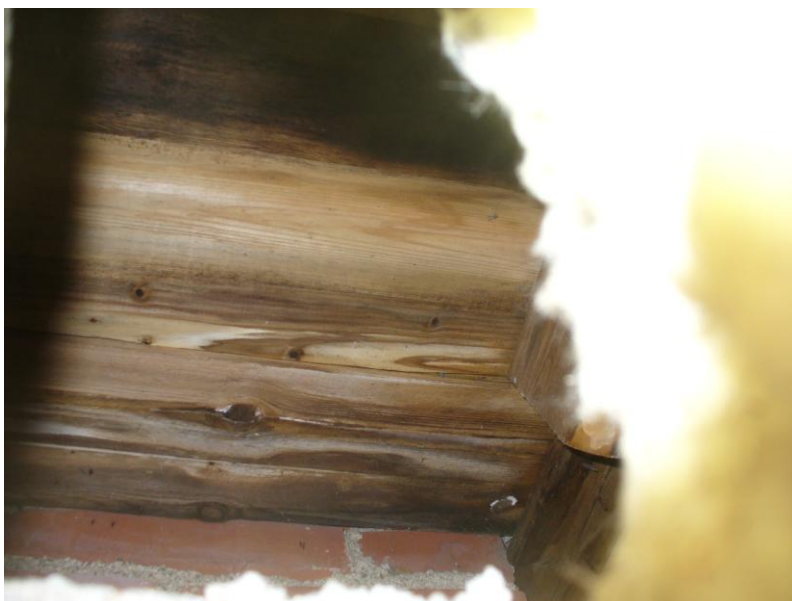
KUVA 18. Viite kohtaan 4.2. Sähkösaunan eteisen sisäkattoon, hormin viereiseen vesivauriokohtaan tehdystä purkaukosta voitiin todeta yläpohjan puu- ja eristevillamateriaalien olevan pilaantuneita, sekä vesikatteen aluslaudoituksen olevan vaurioitunutta laajemminkin johtuen vuodosta ja yläpohjatilan olemattomasta tuuletuksesta
