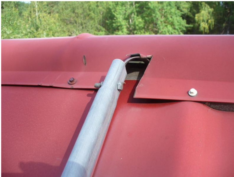
KUVA 12. Viite kohtiin 3.2 ja 3.3. Entisen navettarakennuksen lapetikkaiden kiinnityskohdassa on varma vuotokohta vesikaton harjalla. Katepelti on haalistunutta ja kuvassa näkyy myös pieni ruosteinen muovipinnoitteen vauriokohta
