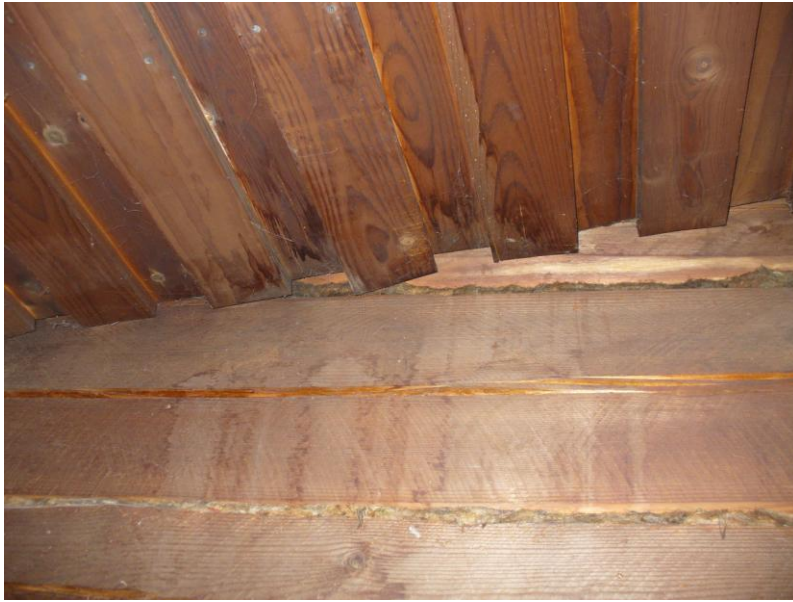
KUVA 21. Ison rantasaunan tuvassa on useassa kohtaa näkyvissä vesikatolta joko vesikattovuodoista tai/ja yläpohjan tuuletuksen toimimattomuudesta johtuvia vesivuotojälkiä vinon sisäkaton ja hirsiseiniä liitoskohdassa
