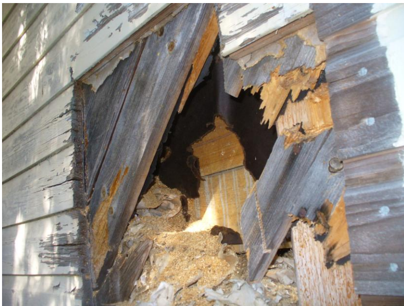
KUVA 6. Viite kohtiin 2.2 ja 2.4. Vanhan päärakennuksen mikrobi- ja osin myös lahovaurioitunutta ulkoseinärakennetta. Vanha purueriste on tyhjentynyt purkuaukon kautta.
