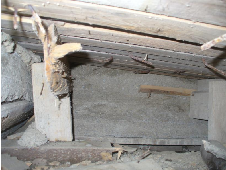
KUVA 16. Viite kohtaan 4.1. Sähkissaunan saunan ja pesuhuoneen kantavan betonilaatta-alapohjan alle on jätetty kaikki muottipuutavarat paikoilleen, jotka osin suorassa maaja betonikosketuksessa ovat varmuudella mikrobivaurioituneita. Alapohjatilasta on yhteys tuvan tuulettuvan puualapohjan alapuoliseen tilaan
