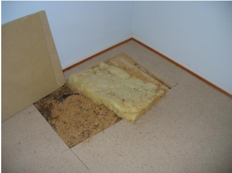
KUVA 5. Viite kohtaan 2.2. Oleskeluhuoneen lievästi mikrobivaurioitunutta lattiarakennetta maapohjaisen kellaritilan alapuolella.
