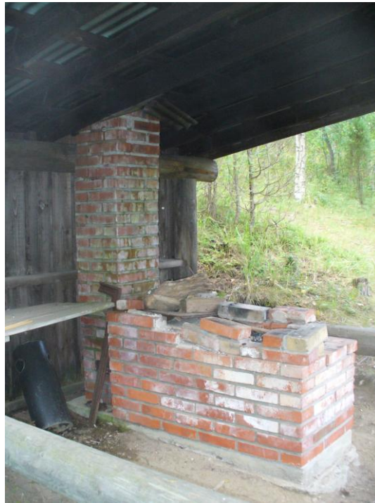
KUVA 25. Viite kohtaan 5.3. Sähkösaunan vieressä sijaitsevan grillikatoksen tiilirakenteet ovat täydellisen korjauksen tai mieluummin uusimisen tarpeessa. Hormi on kaatumassa
