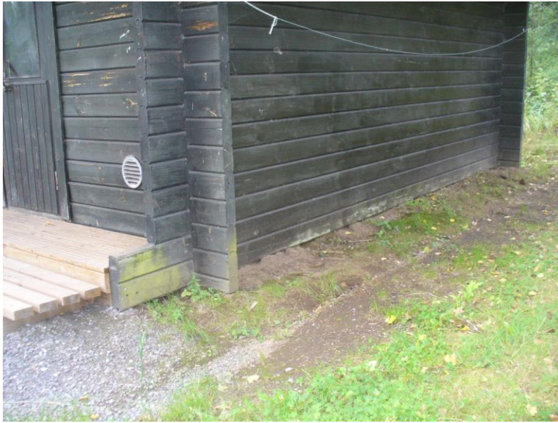
KUVA 23. Viite kohtaan 5.2. Pienempien majoitusmökkien kunto on huonompi ja alapohjan tuulettuminen vähintään kyseenalaista johtuen osin ”maanvaraisesta perustamisesta”
