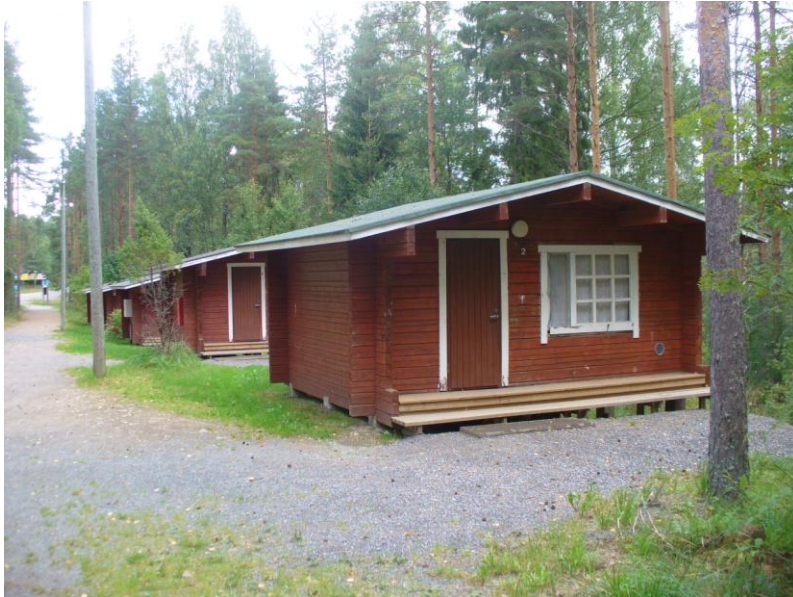
KUVA 22. Viite kohtaan 5.1. Suurempien majoitusmökkien ikkunoiden korjaustyö on jäänyt keskeneräiseksi sisä- ja ulkopuolen listoitusten osilta. Myös tuuletusluukuissa ja ulkoviennin toiminnassa/kunnossa todettiin ongelmia
