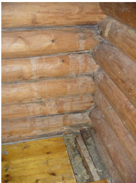
KUVA 17. Viite kohtaan 4.1. Sähkösaunan tuvan nurkassa on vesivuotokohta. Tuulettuvaan puualapohjaan tehdyssä purkaukossa olevissa eriste- ja puumateriaaleissa todettiin vakavaa pilaantumista
