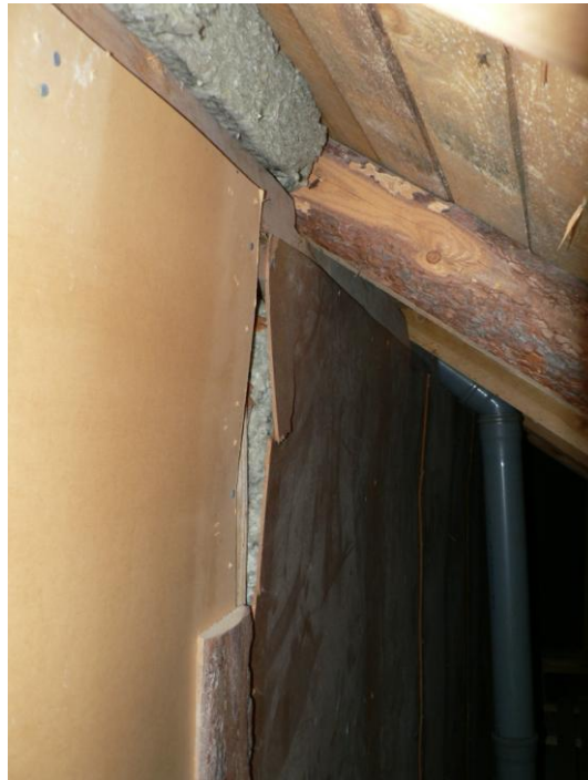
KUVA 1. Viite kohtiin 2.1 ja 2.3. Vanhan päärakennuksen ullakkotilan kovalevypinnassa on kosteusjälkiä ja kosteutta. Yläpohjan tuulettuminen on osin tukittu ja viemärin tuuletusputki on eristämättä.
