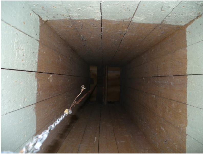
KUVA 11. Viite kohtaan 3.2. Entisen navettatilan vanhat poistoilmahormit on johdettu nykyisin yläpohjatilaan, eikä vesikaton yläpuolelle, kuten alun perin oli
