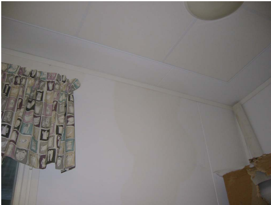
Kuva 3. Huonetilassa 20 on seinäpinnalla valunut vuotovesi tummuttanut maalipintaa.
