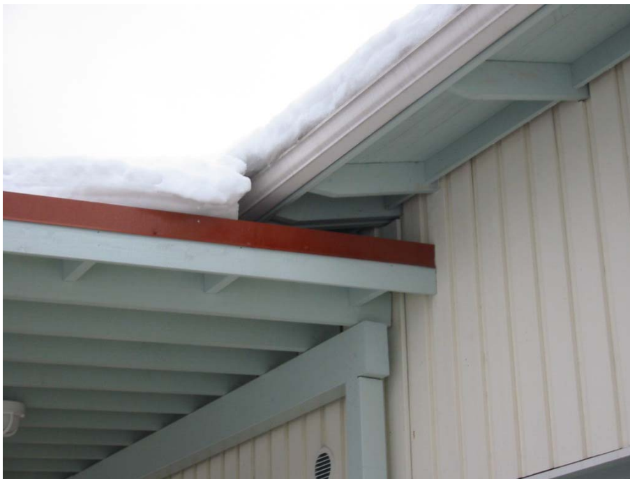
Kuva 4. Terassin katon liitos rakennuksen räystääseen. Tietyissä sääoloissa voi terassin katolla oleva lumi kulkeutua tuuletusraon kautta yläpohjan onteloon.
