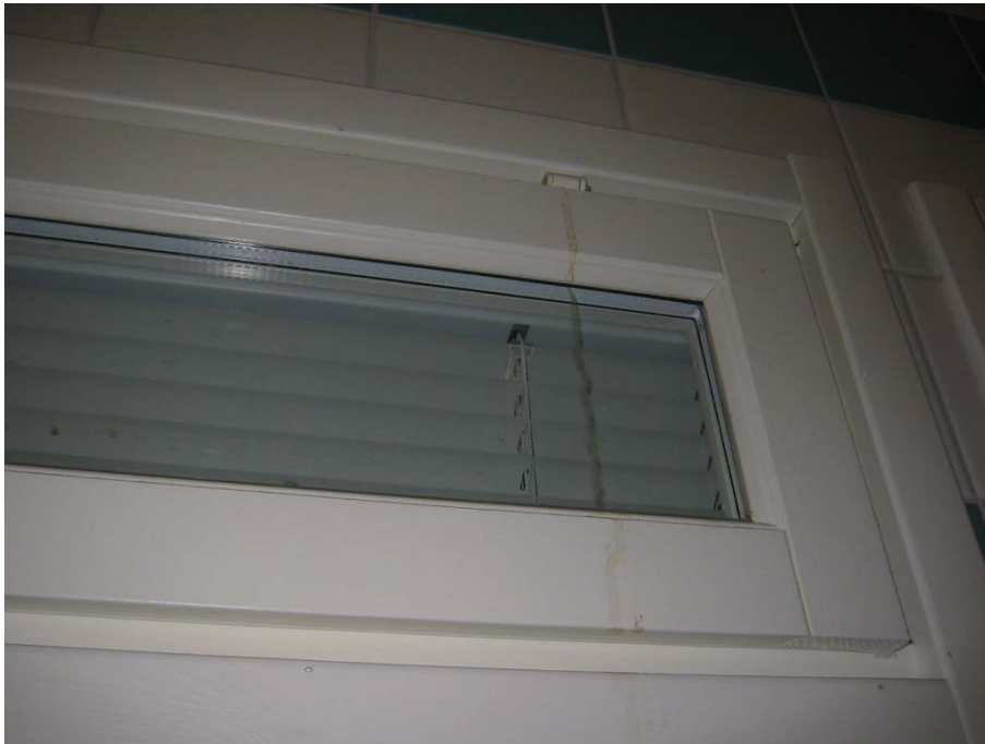
Kuva 1, Vuotojälkiä seinä- ja ikkunapinnalla huonetilassa 14.
