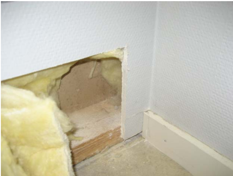
Kuva 2. Rakenneavauskohta AV.01–23. Väliseinä on puurunkoinen (100x50-puusoiorunko) ja mineraalivillaeristetty, kipsilevytyks on oikeaoppisesti erotettu alapuolisesta betonilaattapinnasta (rako 3...5 mm). Avaukseen perusteella seinän mineraalivillaeristeet, puurunko ja levytykset ovat hyväkuntoisia ja vaurioitumattomia.
