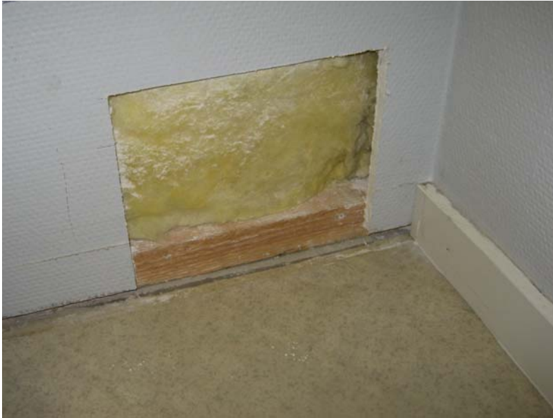
Kuva 1. Rakenneavauskohta AV.01–23. Avaus käsitti tutkimusaukon tekemisen (~220x240 mm 2 ) rakennuslevyn (kipsilevyn) alareunaan huonetilan 26 puolelta. Avauksesta ei tehty mitään viitteitä rakenteen kosteus- ja mikrobivaurioista.
