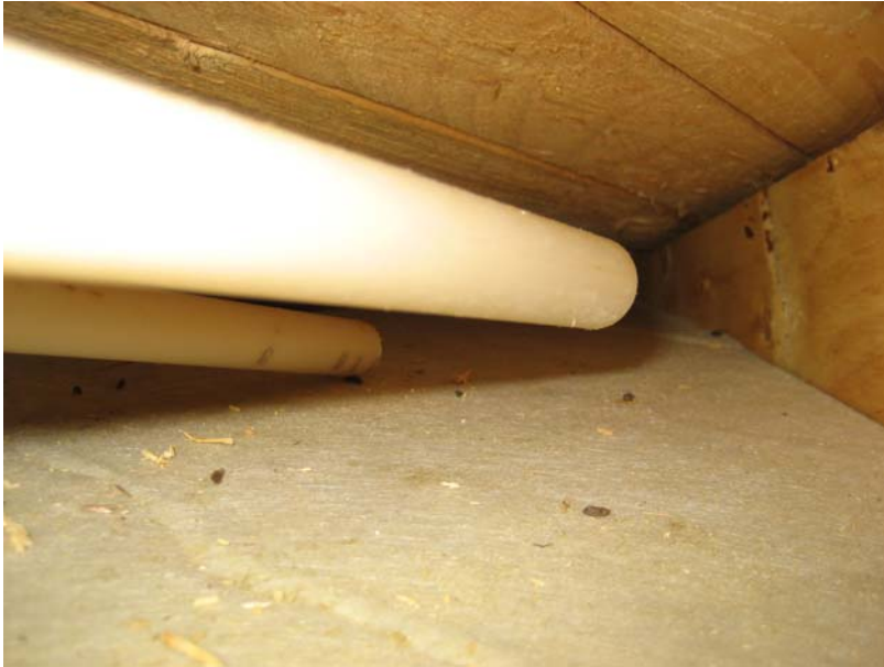
Kuva 9. Rakenneavauskohta AV.03–23. Kuvassa näkyy tuulensuojavillan yläpuolinen ilmatila (tuuletusrako) ja raossa olevia sähköputkituksia (suojaputkia, joihin ei liity johdotuksia).
