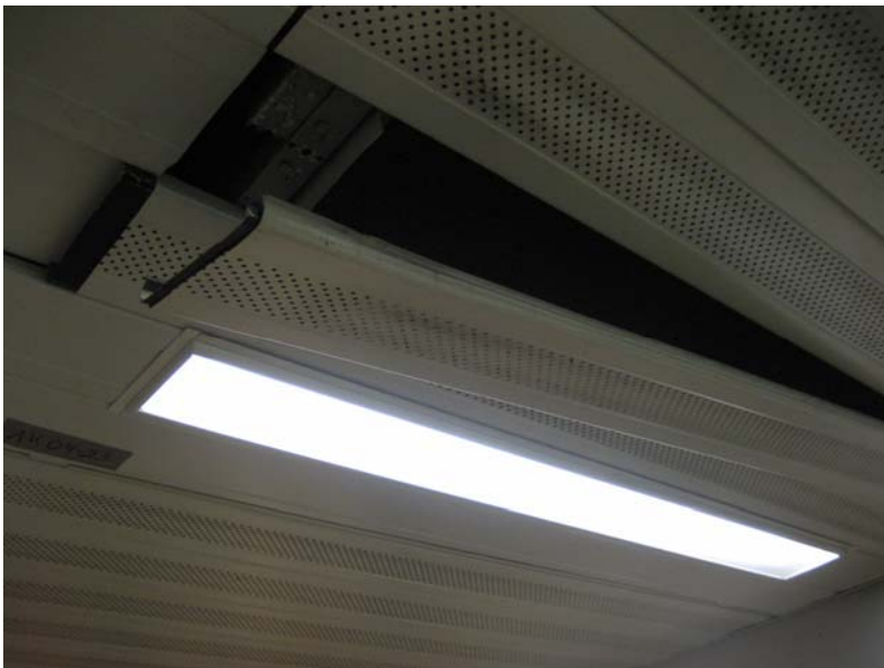
Kuva 10. Rakenneavauskohta AV.04–23. Kuvassa näkyy avattuja metallisäleitä, joiden kautta/läpi keittiöön puhalletaan tuloilmaa.
