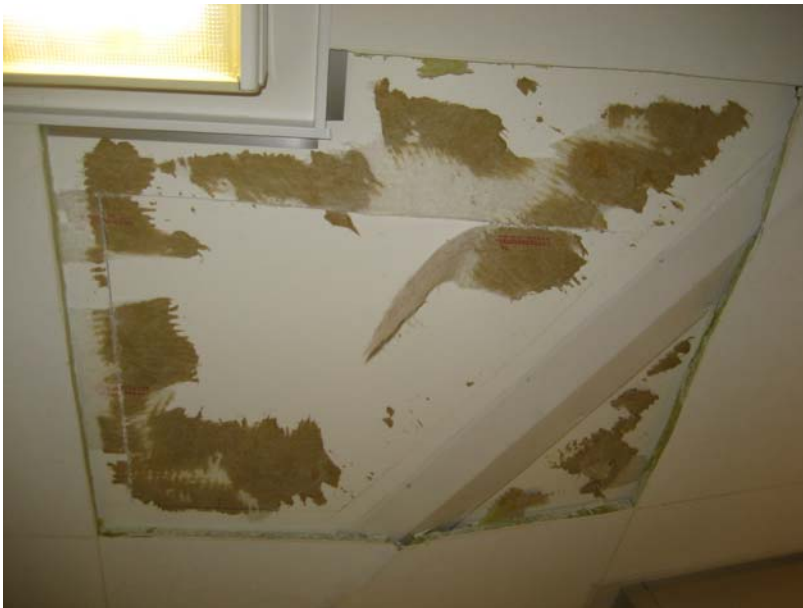
Kuva 6. Rakenneavauskohta AV.03–23. Avaus käsitti huoneilmaa vasten oleva akustoivan (ja pinnoi- tetun) mineraalivillalevytyksen purun kattojiirin kohdalta.
