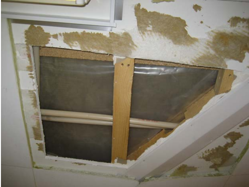
Kuva 7. Rakenneavauskohta AV.03–23 . Kuvassa näkyy kipsilevytyksen takainen ilmatila (50x50-koolaus) sekä ilmatilan takainen höyrynsulku (muovikelmu).
