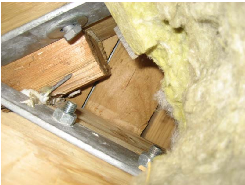
Kuva 8. Rakenneavauskohta AV.03–23 . Kuvassa näkyy kertopuiden asennus jiirissä sekä se, ettei tuuletus jiirissä ole toimiva, koska kertopuut ulottuvat aluslaudoitukseen saakka eikä rakennetta ole varustettu ristikoolauksella ja/tai kertopuupalkkeja tuuletusrei'in. Aluslaudoituksen väleistä näkyy jiirissä oleva kattopelti.
