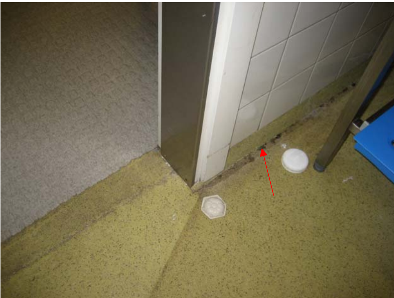
Kuva 17. Huonetilojen 23 ja 34 välinen seinä oviaukon vierellä. Kuvassa näkyvät tummentumat seinävieren akryylibetonipinnalla (punainen nuoli) eivät ole mikrobikasvustoa vaan akryylibetonipinnalle kerääntyneitä/jäänyttä likaa tai esimerkiksi akryylibetonin asennukseen liittyviä pohjustejäämiä (poistetaan mekaanisesti/kemiallisesti tavanomaisena puhdistustoimenpiteenä).
