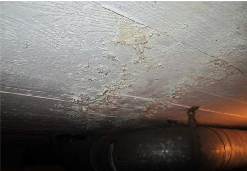
Kuva väestönsuojasta. katto kastunut paikoin
