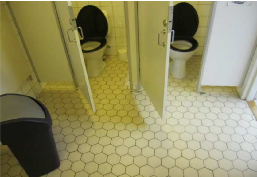
Kuva päiväkodin pesuoneesta. välipohjaeriste kastunut
