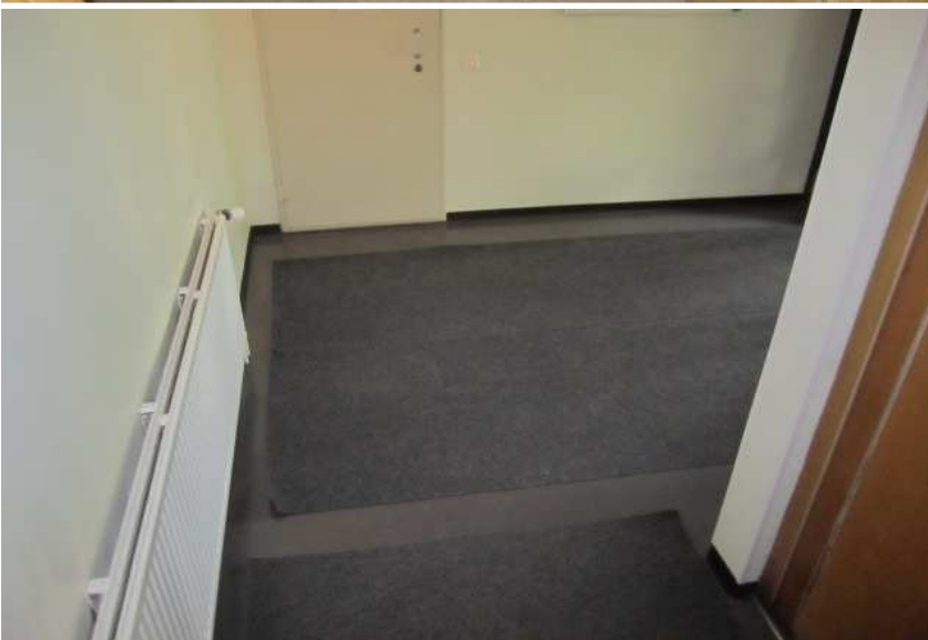
Kuva F-portaan ala-aulasta. välipohjaeriste kastunut
