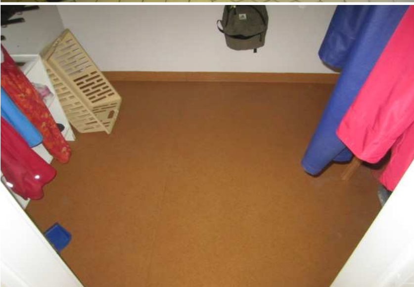
Kuva päiväkodin kuivaushuoneesta. välipohjaeriste kastunut
