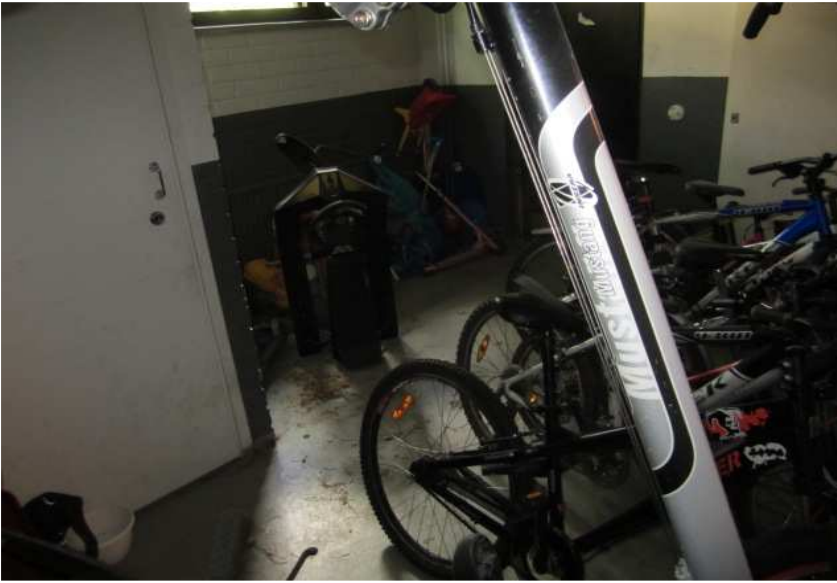
Kuva urheiluvälivarastosta. välipohjaeriste kastunut
