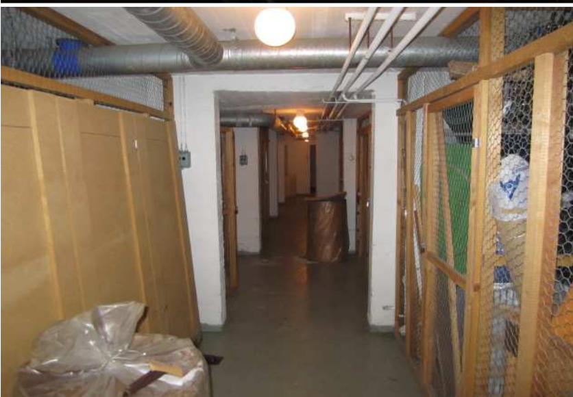
Kuva väestönsuojasta. katto kastunut paikoin
