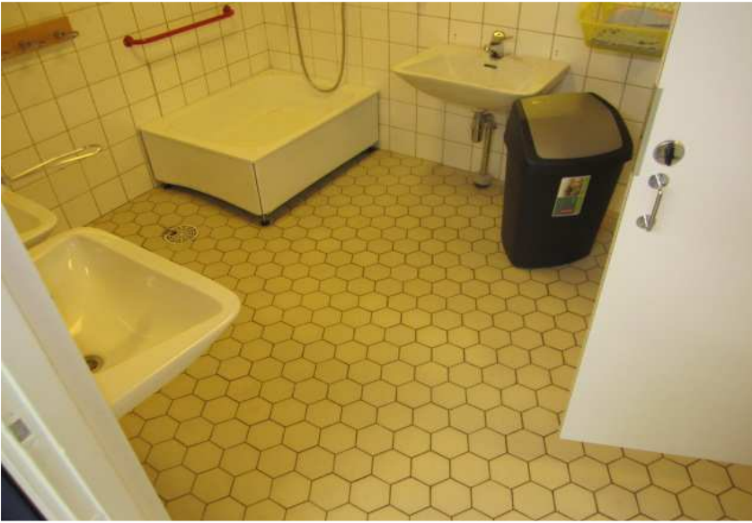
Kuva päiväkodin pesuoneesta. välipohjaeriste kastunut
