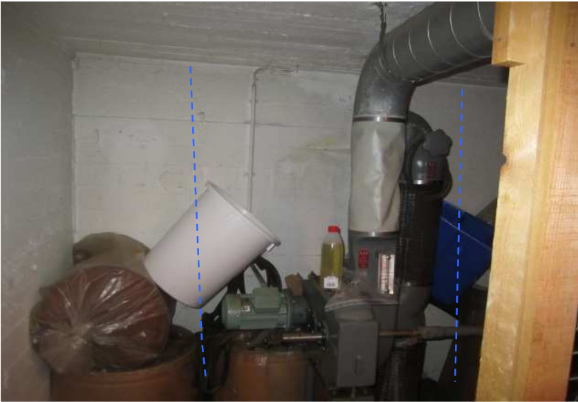
Kuva väestönsuojasta. seinä kastunut
