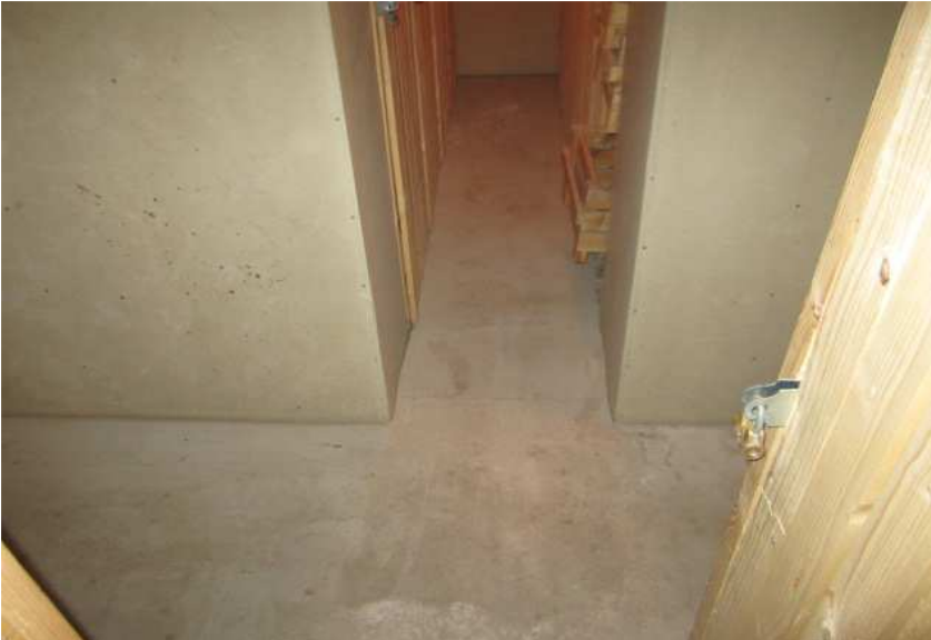
Kuva kylmäkellarista. välipohjaeriste kastunut
