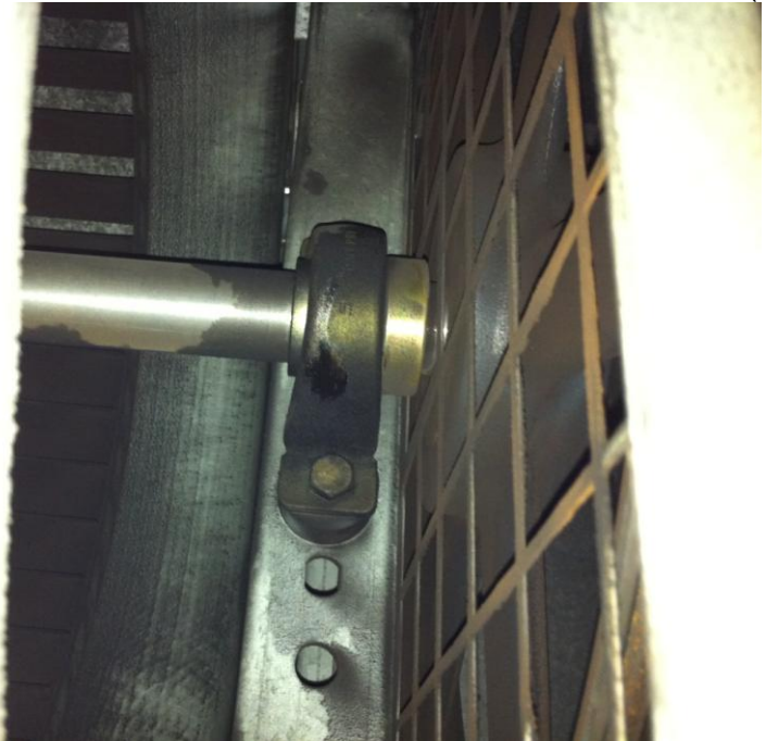
Kuva 6, Puhaltimen laakerista on tiivisteestä tullut rasvat ulos.
