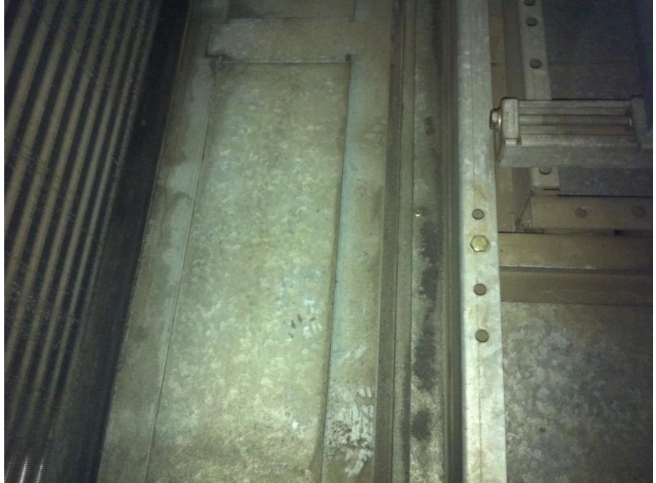
Kuva 4 Karkeaa likaa puhallinkammiossa.
