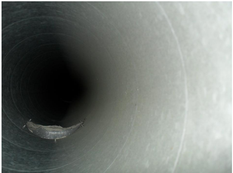
Kuva 7 Tulokanavan runkolinjaa, (pohja vasemmalla).
