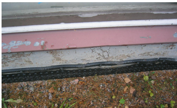
Kuva 4. Kiinnityksestään irronnutta Pato-levyä kellarin seinustalla.
