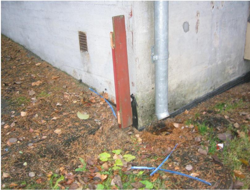
Kuva 5. Kellarin ulkonurkan syöksytorvi kastelee ulkoseinää.
