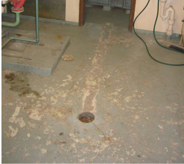
Kuva 3. Lämmönjakohuoneen lattian maalipinta oli laajalti vaurioitunut ja lattiakaivo oli puutteellinen.
