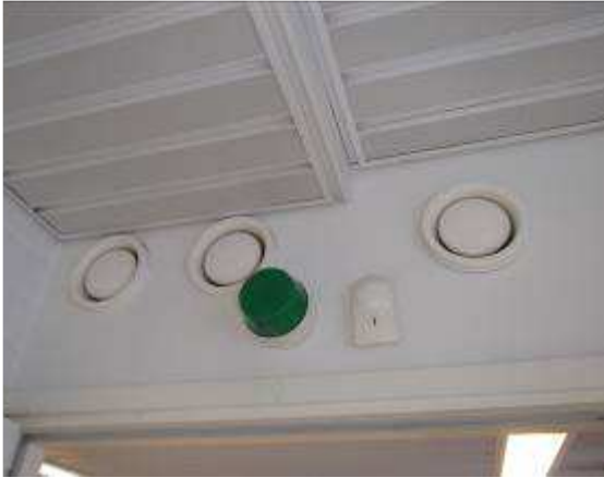
Opasteeton ja toimimaton poistumistievalaisin
