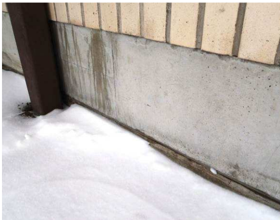
Sokkelipinnat ovat maalattuja ja vielä tyydyttävässä kunnossa.
