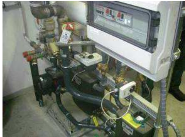
Lämmönsiirrinpaketti on vuodelta 2008.
