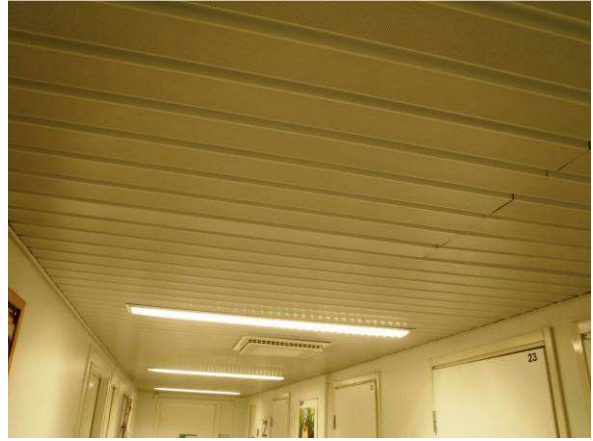
Alakatot käytävillä suojaavat tekniikkaa ja ovat kunnossa
