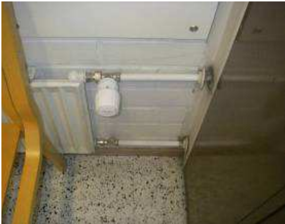
Termostaattiset patteriventtiilit ovat uudempia asennuksia.
