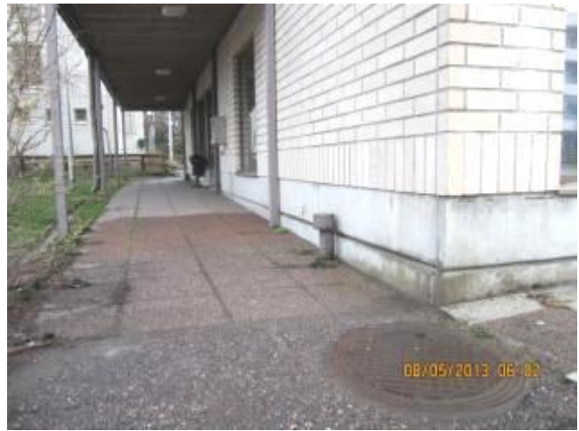
kuva 2 Neuvolan sisäänkäynnin puoleisella sivustalla saattaa sadevesi aiheuttaa kosteusrasitusta perusmuuriin.
