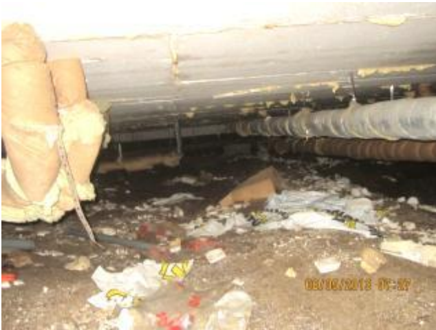
kuva 13 Alustatilassa on paljon kaikenlaista roskaa ja muuta sinne kuulumatonta tavaraa.
