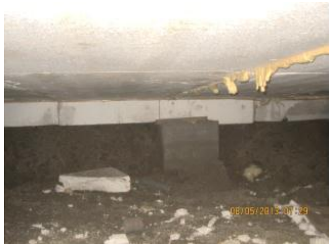
kuva 16 Vastatäyttö on puutteellinen.
