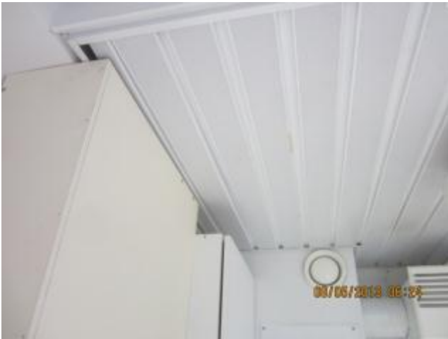
kuva 25 Hoituhuoneen 3 alumiinisälekatossa on jonkin verran vuotojälkiä.
