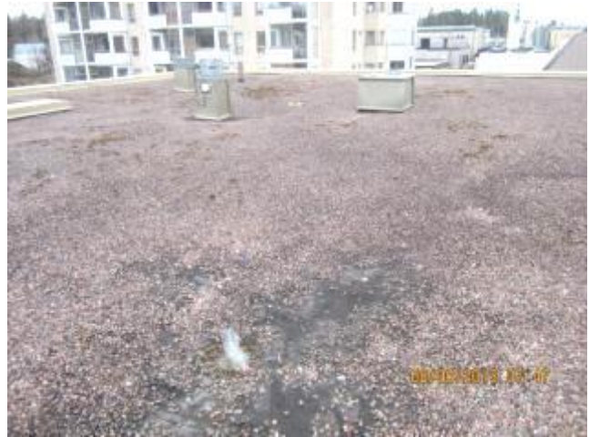
kuva 24 Bitumihuopakate on näkyvissä monin paikoin.
