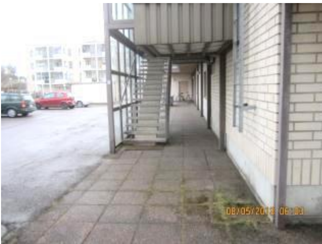
kuva 3 Takapihan puolella sadevesi lammikoituu perusmuurin viereen.
