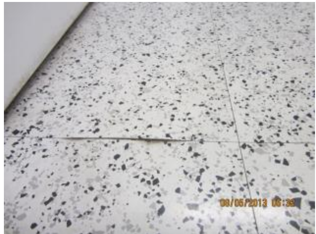
kuva 10 Hieman irrallaan oleva hovilaatta hammashoitolan odotustilan lattiassa.
