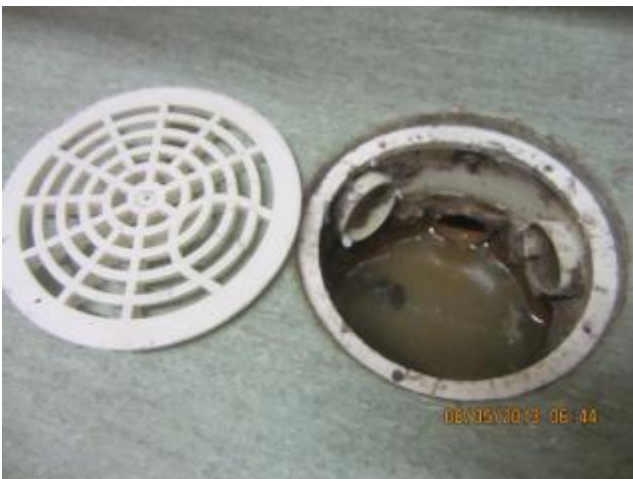
kuva 29 Inva wc:n lattiakaivo.
