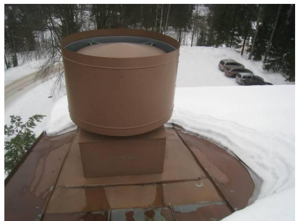
Kuva 6 Länsipäädyn uudehko puhallin, jolle ei ole kulkusiltaa.
