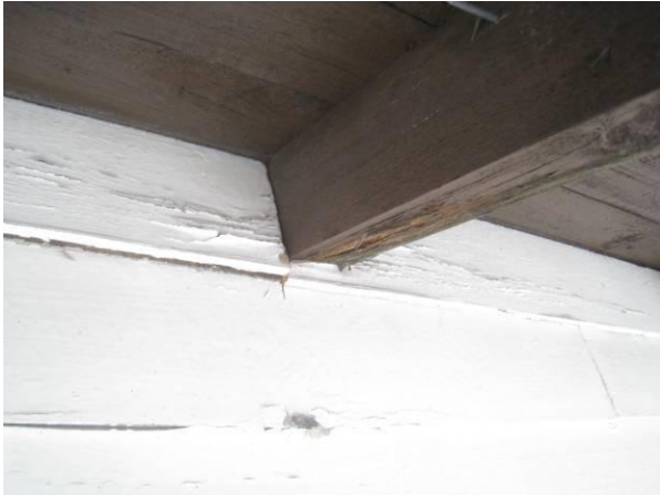
Kuva 13 Rästältä ei ole yhteyttä tuuletusväliin, kattotuoli on osin laho.
