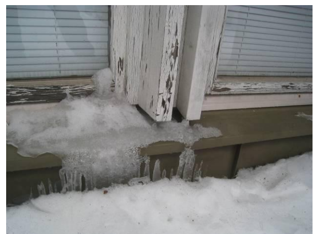
Kuva 10 Pitkäaikainen vuotokohta räystään alta ikkunoille
