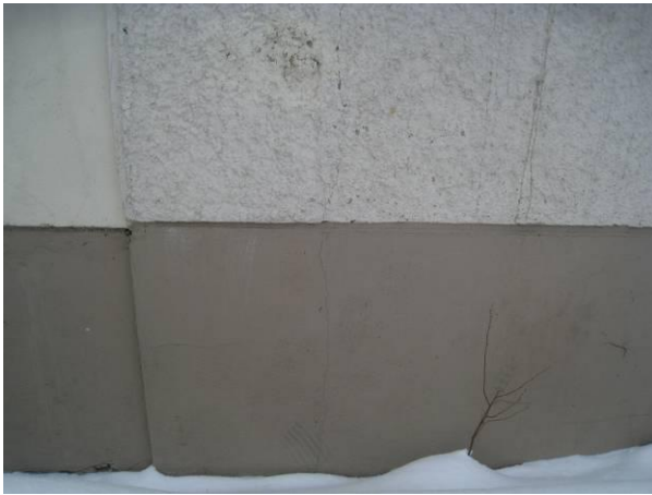
Kuva 21 Itäpäädyssä sokkelin halkeilua.
