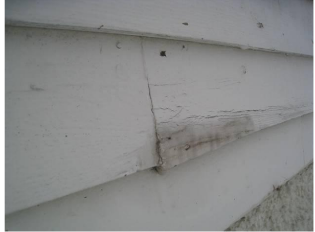
Kuva 20 Itäpäädyn lautojen liitos on turvonnut ja maali irtoaa.
