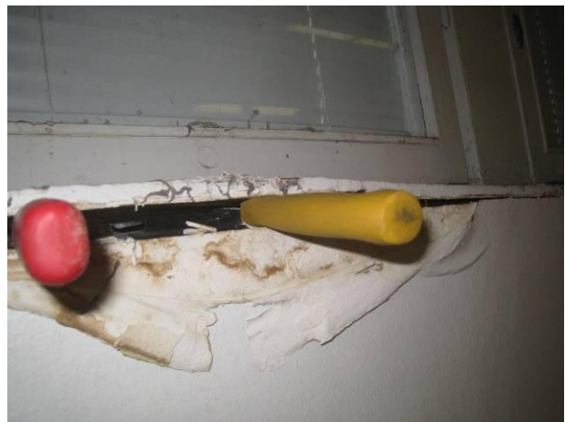
Kuva 40 Eteläsivulla levyjen välinen höyrösulku taipuu ikkunan alareunan levyn alle, vaurioita levyssä.
