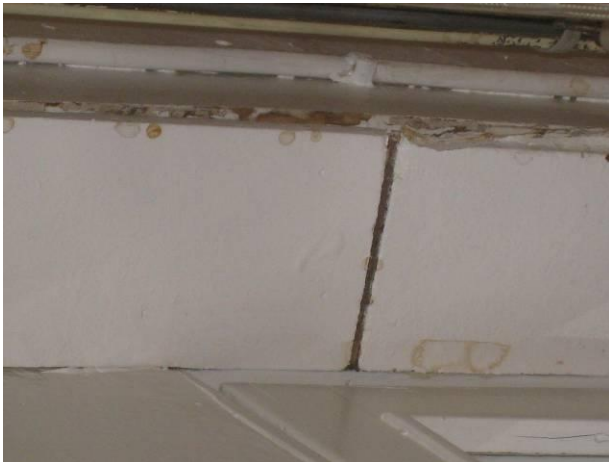
Kuva 39 Ikkunan yläpuolelta vuotojälkiä ja kosteusvaurioita salin eteläsivulla.
