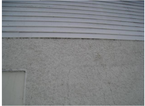
Kuva 22 Itäpäädyssä sokkelin halkeaman kohdalta myös rappauksessa on halkeama.
