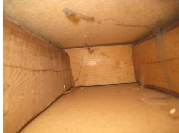
Kuva 32 AV3 kohdalla ei höyrysulkua eikä eristettä koolaustilassa, muuten ok?
