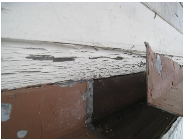
Kuva 11 Ikkunan yläpuolinen vesipelti on liitetty kehyspuun ja panelin väliin.
