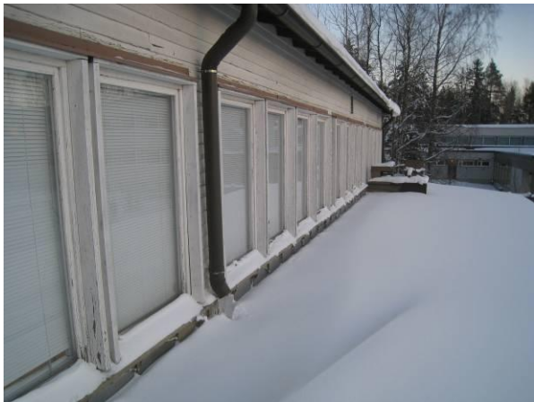
Kuva 15 Näkymä matalan osan katolta 29.11.2010, ei vielä jäätä räystäällä
