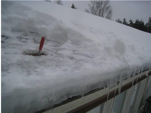
Kuva 7 Paksu jääkertymä 2.2.2011, puukon kohdalla on lumieste.
