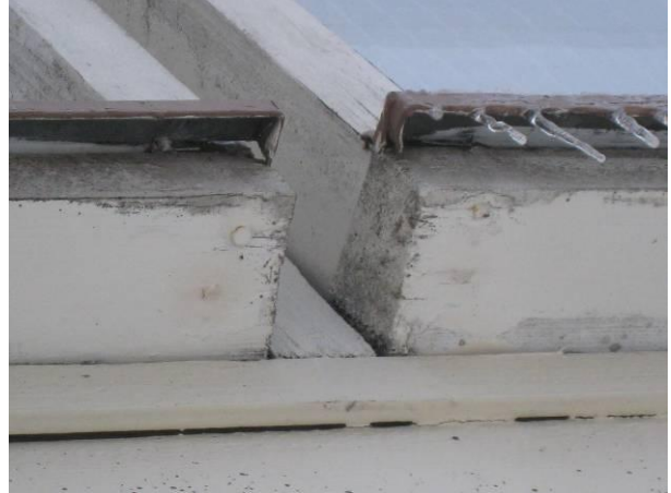
Kuva 26 Ikkunoiden vesipellitys ei suojaa puosien päitä.
