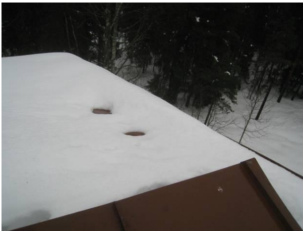
Kuva 3 Itäpäädyssä on lämpövuotolaikut ulkoseinän kohdalla.
