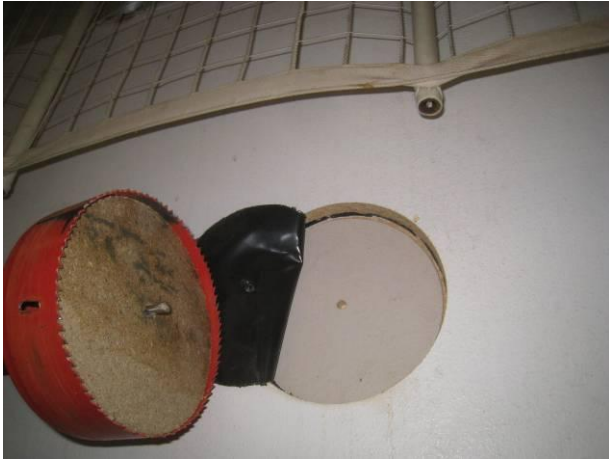
Kuva 37 Rakennavaus AV4 salin eteläseinän ikkunan alle, mikrobivaurio yms.
