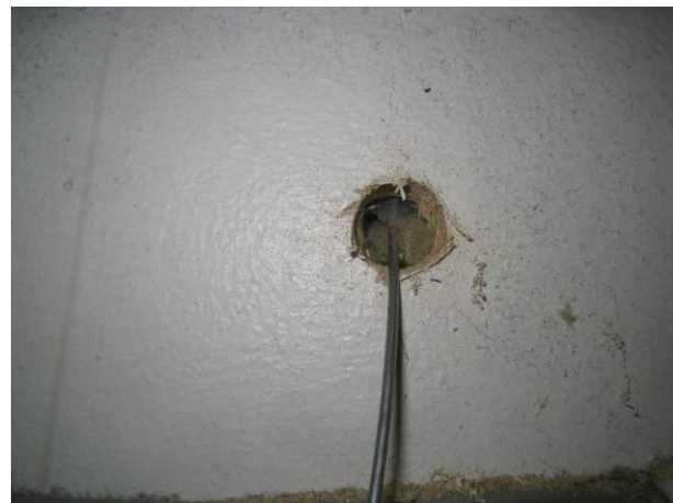
Kuva 46 Rakenneporaus AV7 salin sivuseinään h 2,5 metriä lattiasta: lastulevy, h-sulku-min.villa
