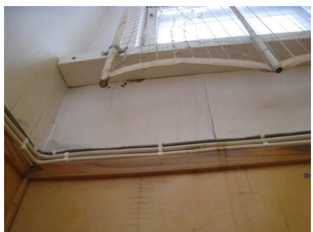
Kuva 42 Vuotojälkiä ja vaurioita pohjoissivulla lounaisnurkassa.
