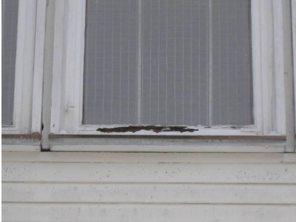
Kuva 25 Pohjoissivun laho alapuite salin kohdalla.
