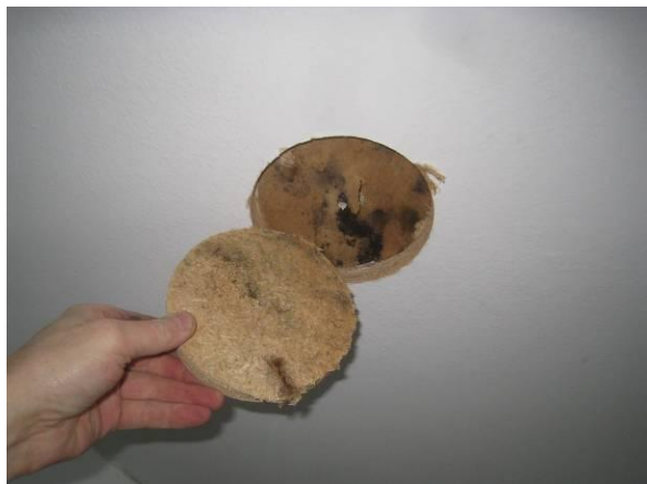
Kuva 35 Rakenneavaus AV8 matalan osan kattoon, tästä mikrobinäyte M3 kohdasta jossa on vain turvonnut levy.
