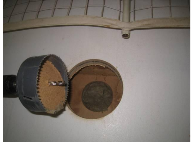
Kuva 38 AV4 levyjen takana eristämätön 100 mm ontelo, kovalevy ja mineraalivilla.
