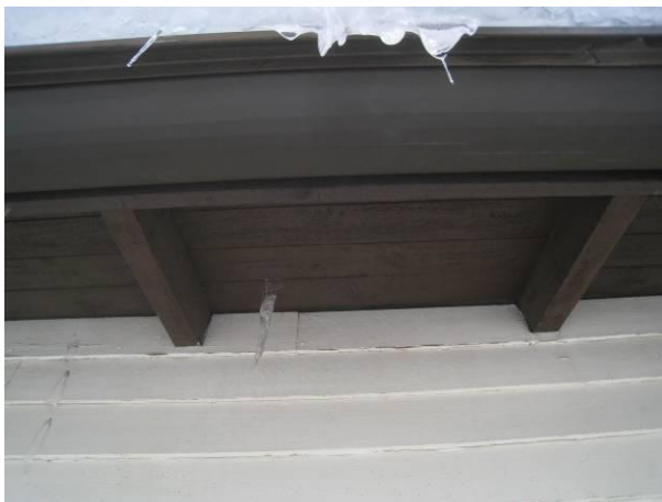
Kuva 9 Katto vuotaa jääpeitteen alta.
