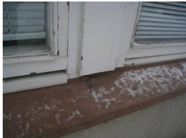
Kuva 30 Pohjakerroksen ikkunoiden alaosa ja pellitys.
