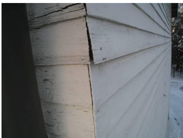
Kuva 17 Itäpäädyn kupuruutta ja kulmassa jiriiliitos auki.
