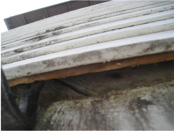
Kuva 19 Itäpäädyn puuvuorauksen alarajalla puuaines ja vinolaudoitus on kovaa.
