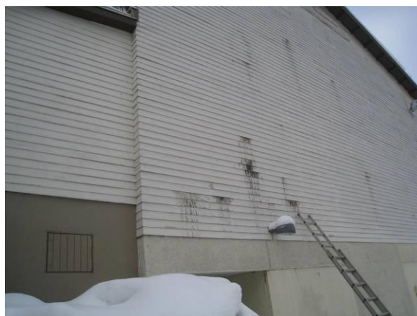
Kuva 18 Itäpäädyn tutkimusalue tikkaiden kohdalla 9.2.11, seinällä paikallista mikrobikasvua.
