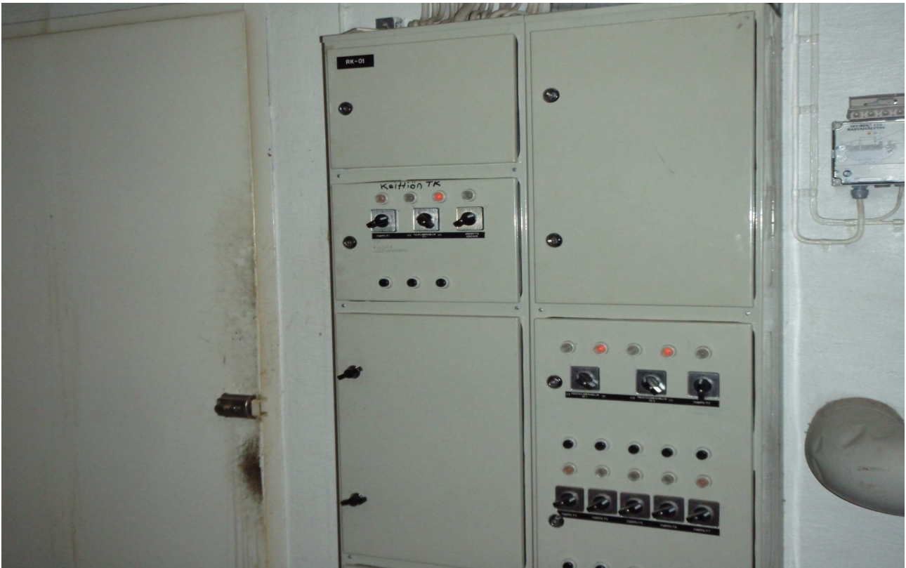
S- kuva 6. Lämmönjaon keskus.
