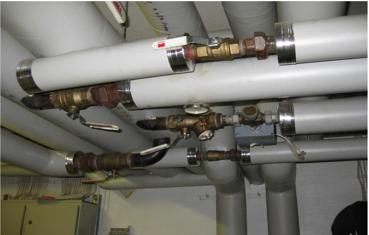
LVI- kuva 2. Yleiskuva koulun päärakennuksen lämpöjohtoverkoston venttiileistä.
