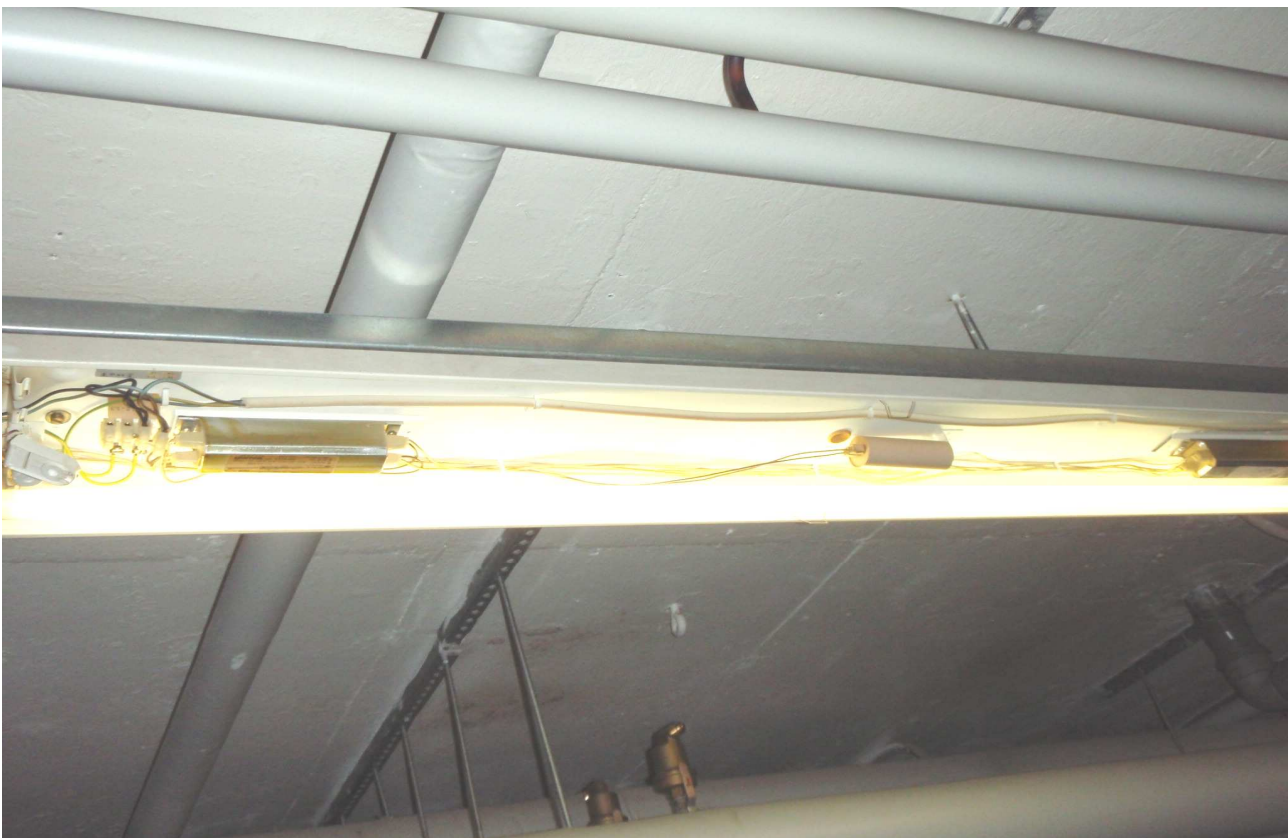
S- kuva 19. Teknisten tilojen valaistus, valaisimen kupu on rikki.
