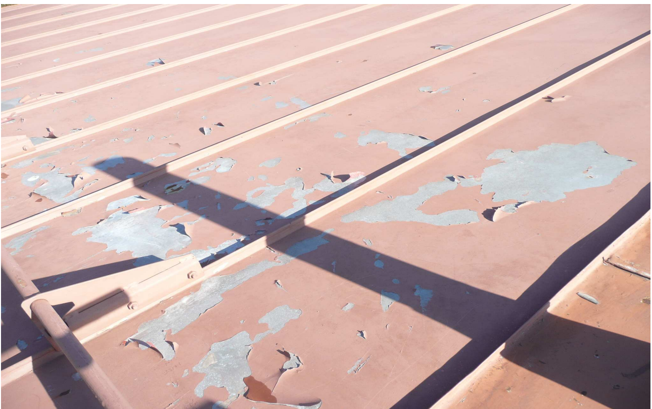
RAK- kuva 10. Peltikatossa esiintyy eriasteisia maalipinnan kulumia ja ruostevaurioita.
