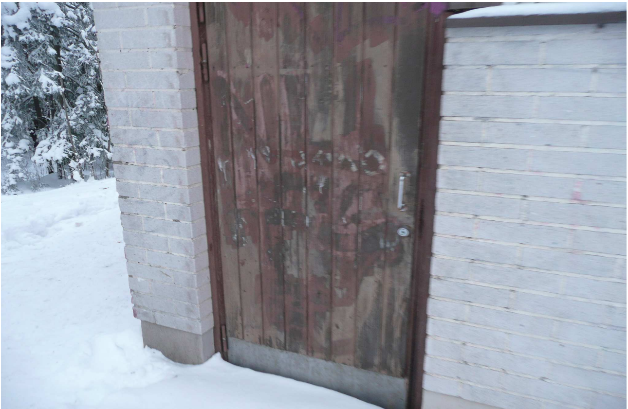
RAK- kuva 9. Paneelipintaisissa ovissa esiintyy pinnan kulumia.
