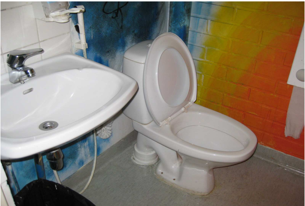
LVI- kuva 9. Yleiskuva koulun päärakennuksen vesikalusteista.
