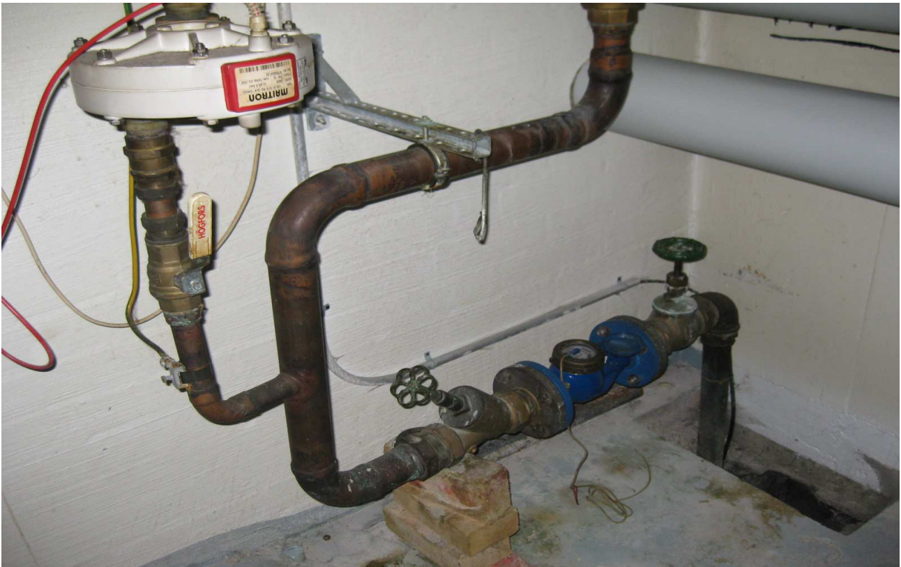
LVI- kuva 6. Yleiskuva vesimittarista ja pääsuluista.
