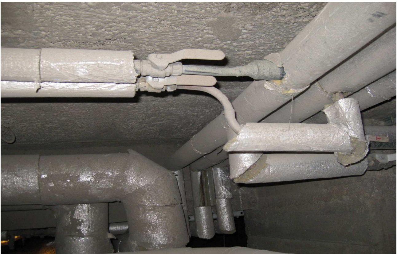
LVI- kuva 7. Yleiskuva koulun päärakennuksen käyttövesiverkoston venttiileistä.
