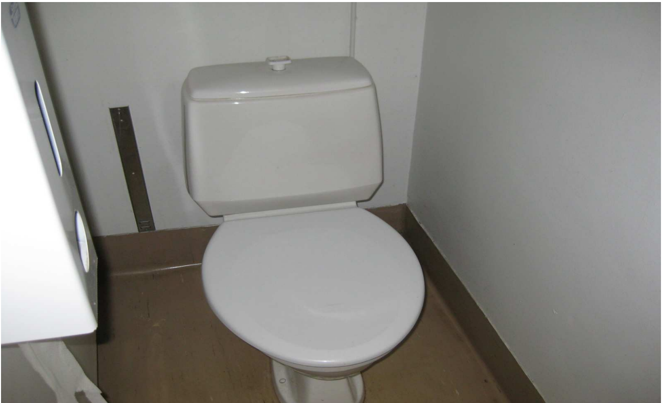
LVI- kuva 10. Yleiskuva koulun päärakennuksen vesikalusteista.
