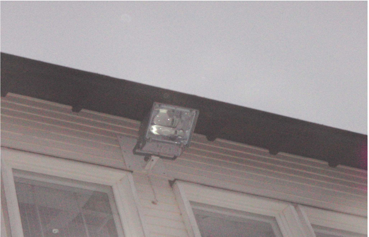
S- kuva 2. Rakennuksen seiniin on asennettu HQL- valonheittäimiä.
