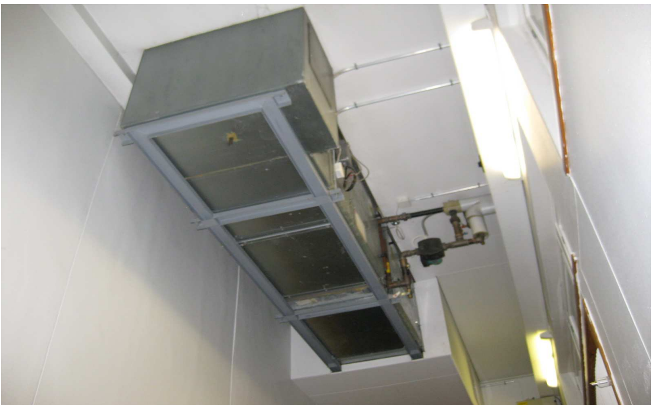
LVI- kuva 15. Yleiskuva koulun päärakennuksen voimistelusalua palvelevasta IV- koneesta.
