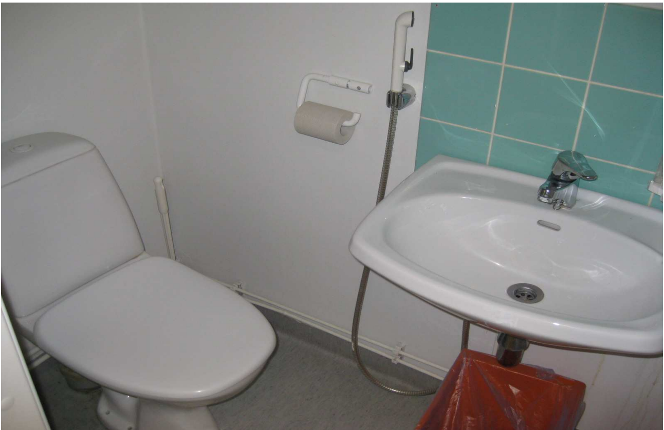
LVI- kuva 11. Yleiskuva koulun uuden puolen vesikalusteista.
