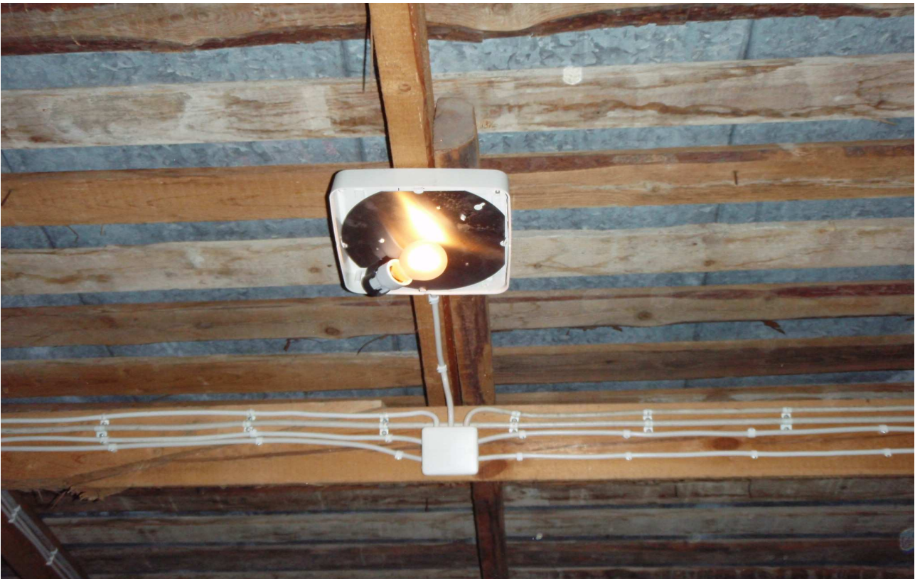
S- kuva 20. Ullakkotilan huonokuntoinen valaisin.
