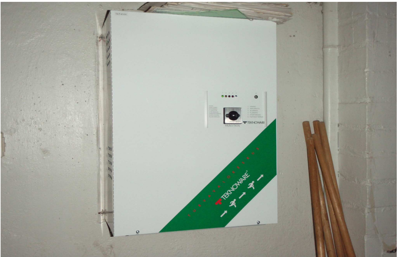
S- kuva 23. Turva- ja ovimerkkivalaistusjärjestelmän keskus.
