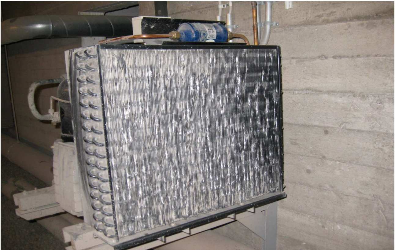
LVI- kuva 20. Yleiskuva keittiön kylmiöitä palvelevasta kylmäkoneesta.
