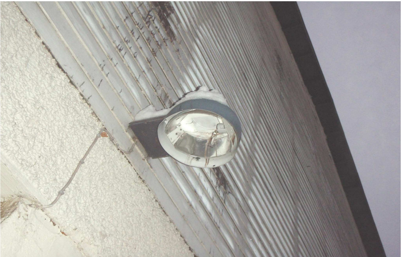
S- kuva 3. Rikkinäinen seinävalaisin.
