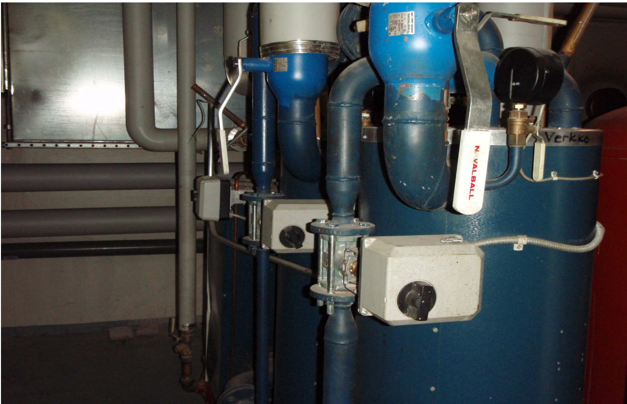
S- kuva 27. Rakennusautomaatiojärjestelmän kentälaitteet.
