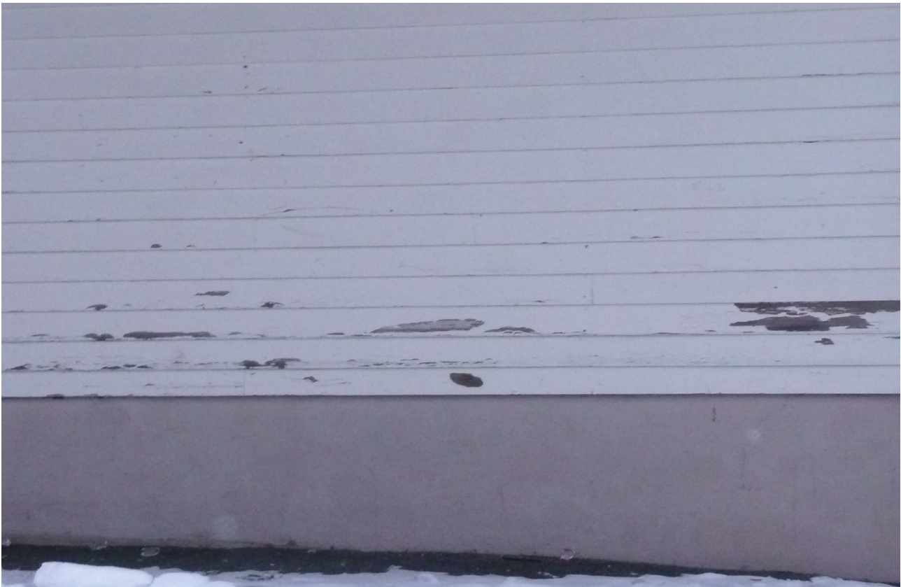
RAK- kuva 7. Liikuntasalin julkisivussa esiintyy maalipinnan lohkeilua.
