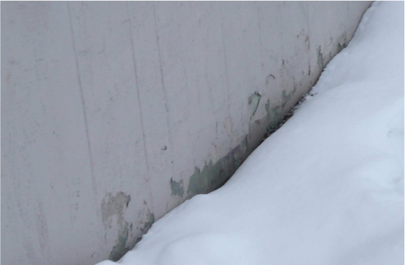
RAK- kuva 3. Koulun uuden puolen sokkelissa on maalipinnan irtoilua.
