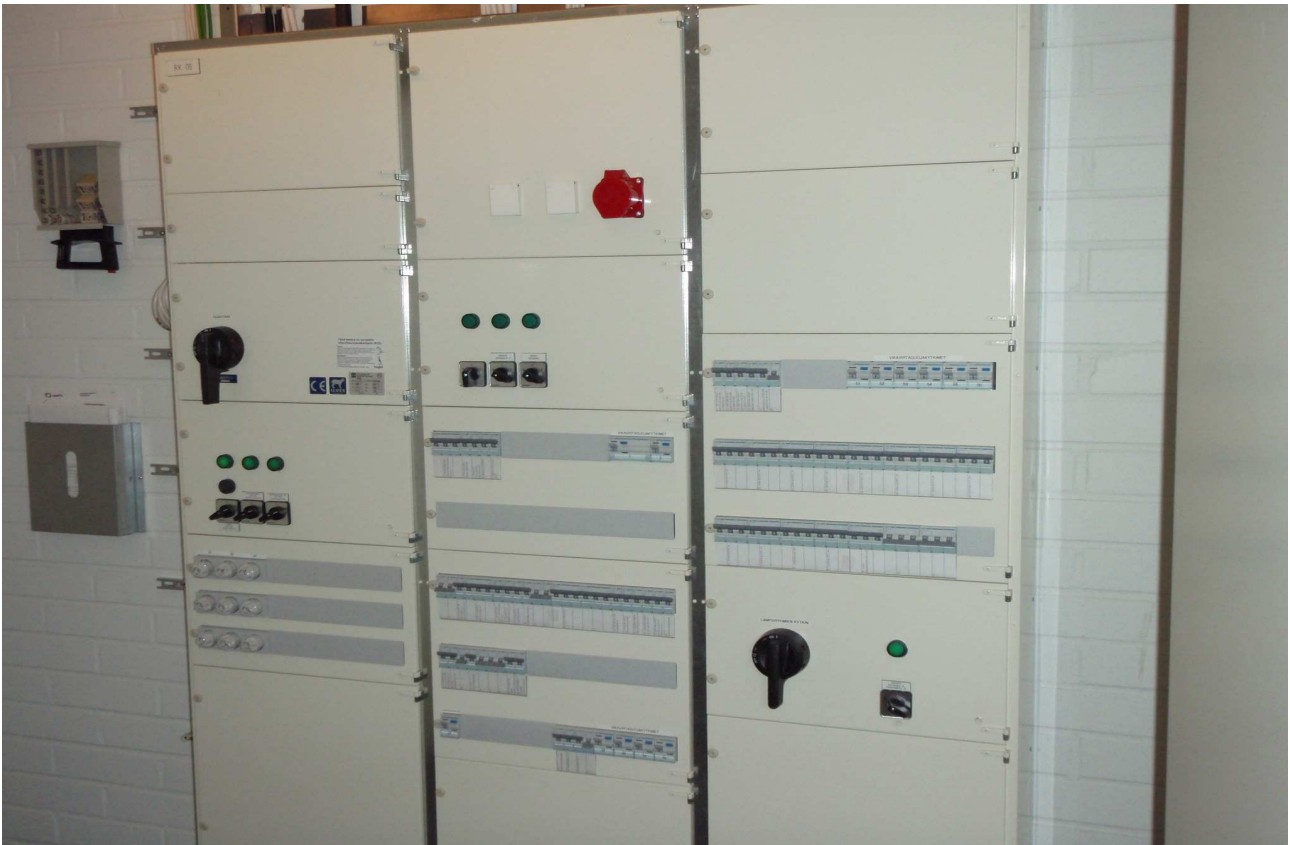
S- kuva 8. Uusittu opetuskeittiön tiloja palveleva keskus.
