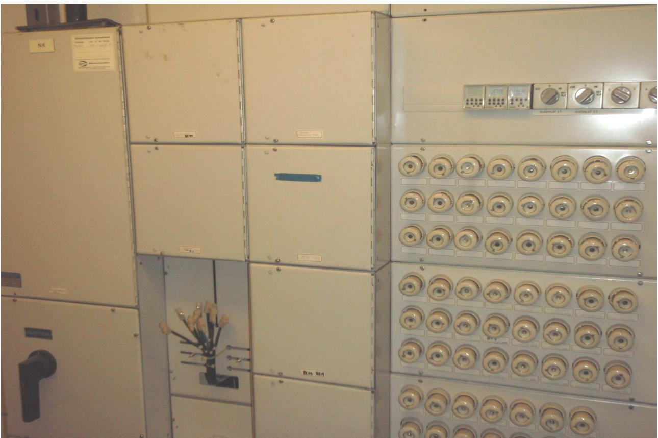
S- kuva 5. Vanhemman rakennuksen pää- /NK- keskus.
