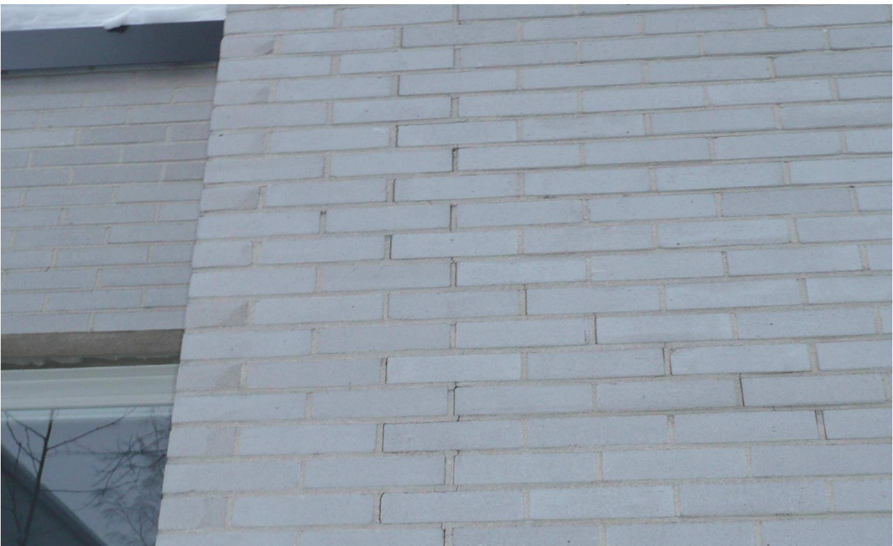
RAK- kuva 6. Kalkkihiekkatiilestä muuratussa julkisivussa todettiin paikoitellen halkeamia.
