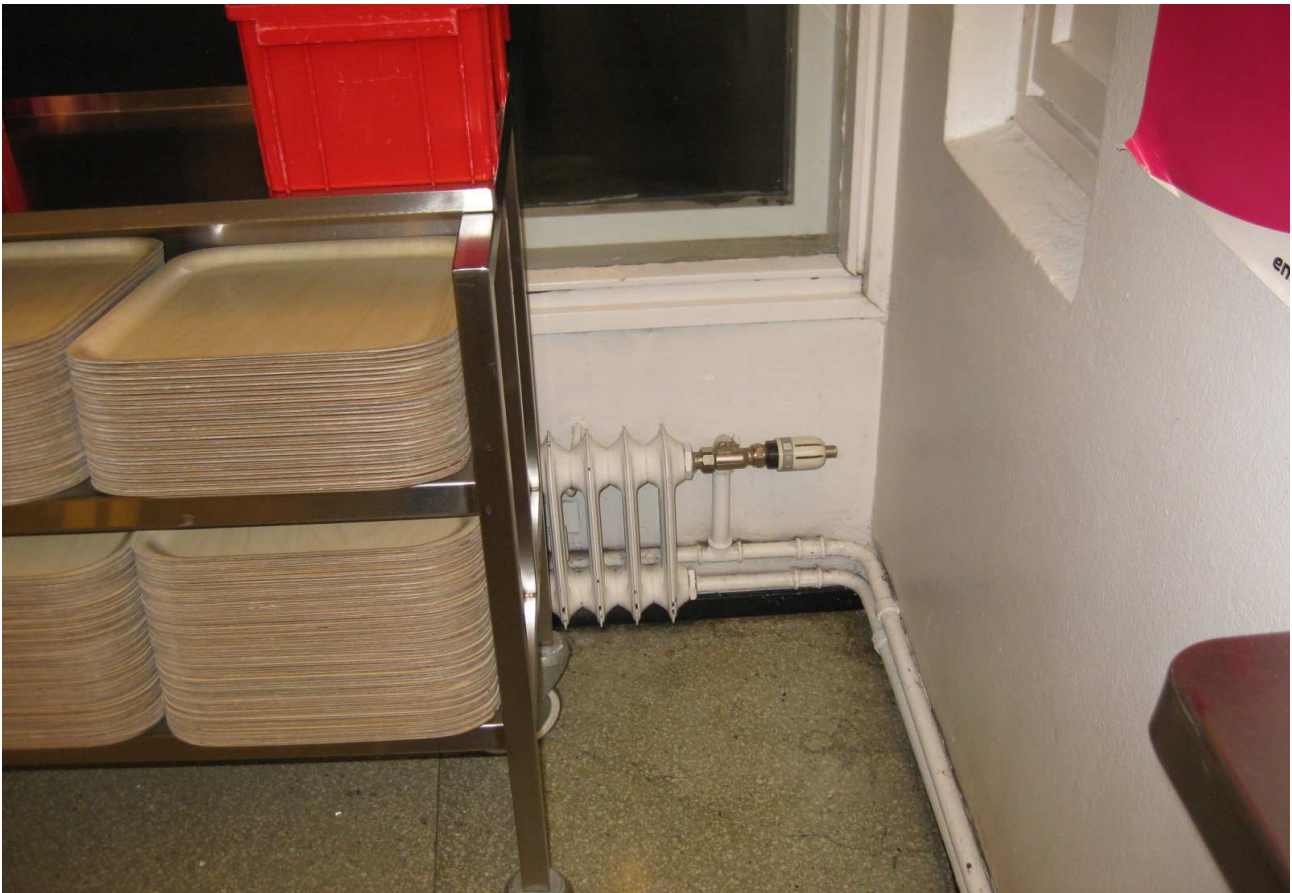
LVI- kuva 4. Yleiskuva koulun päärakennuksen patteriventtiilistä.
