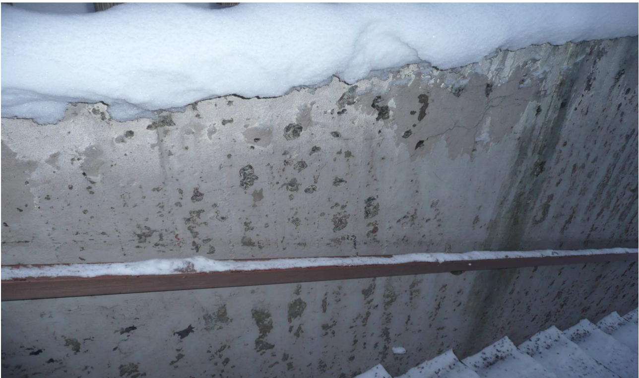
RAK- kuva 2. Tukimuurissa on todettavissa pinnan irtoilua ja lohkeilua sekä halkeamia.
