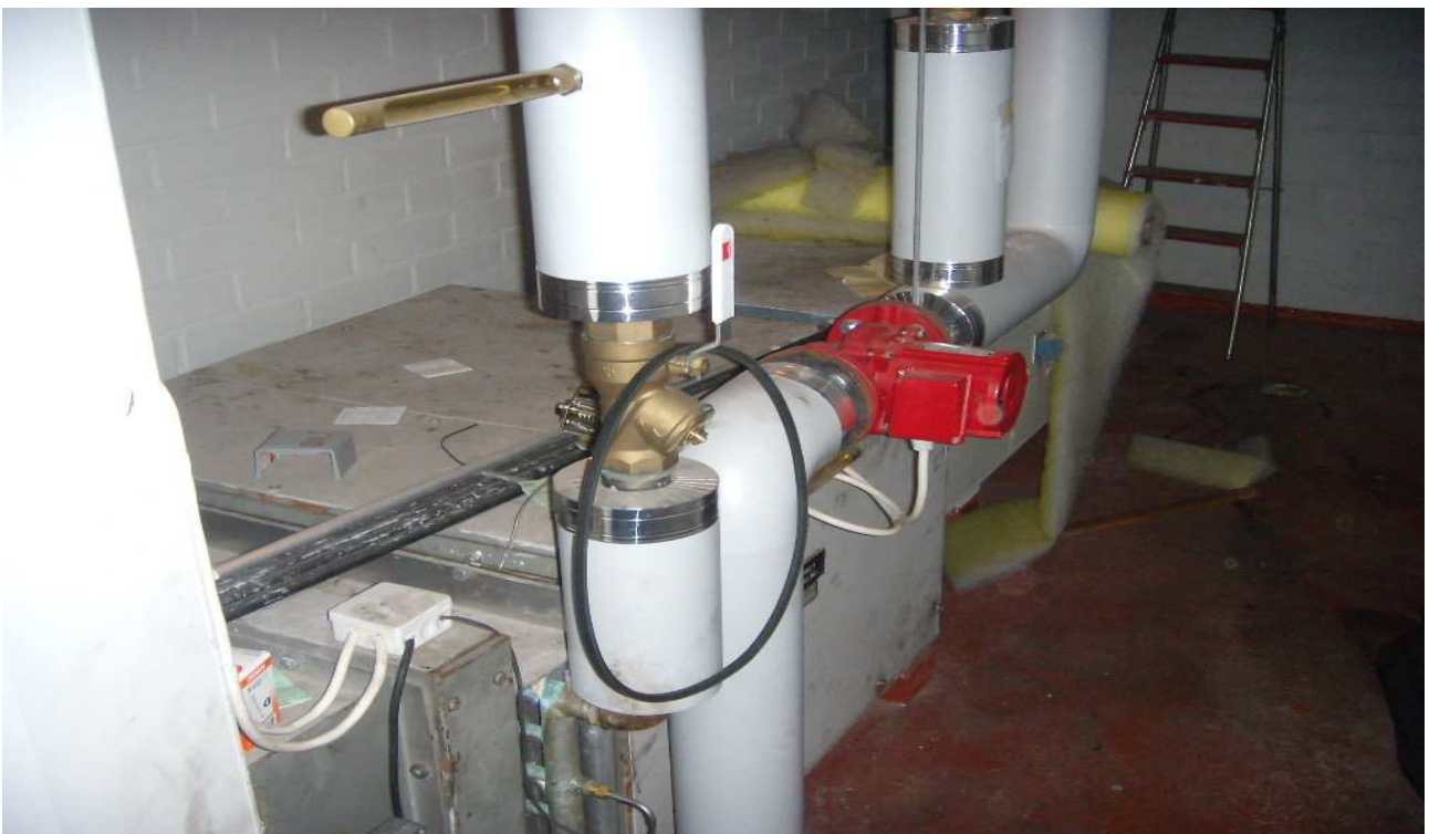
LVI-kuva 17. Yleiskuva uuden puolen vanhasta IV-koneesta.
