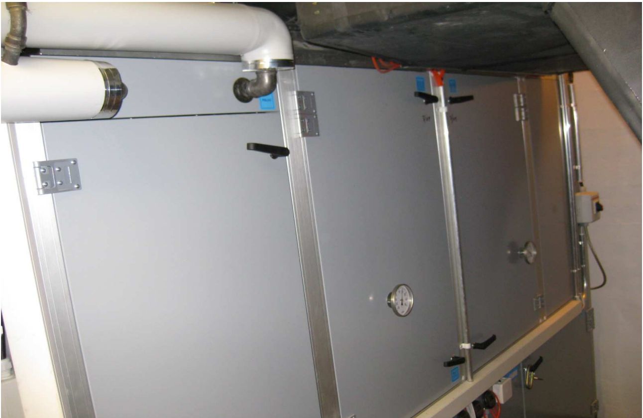
LVI-kuva 16. Yleiskuva koulun päärakennuksen kotitalousluokkia palvelevasta IV-koneesta.
