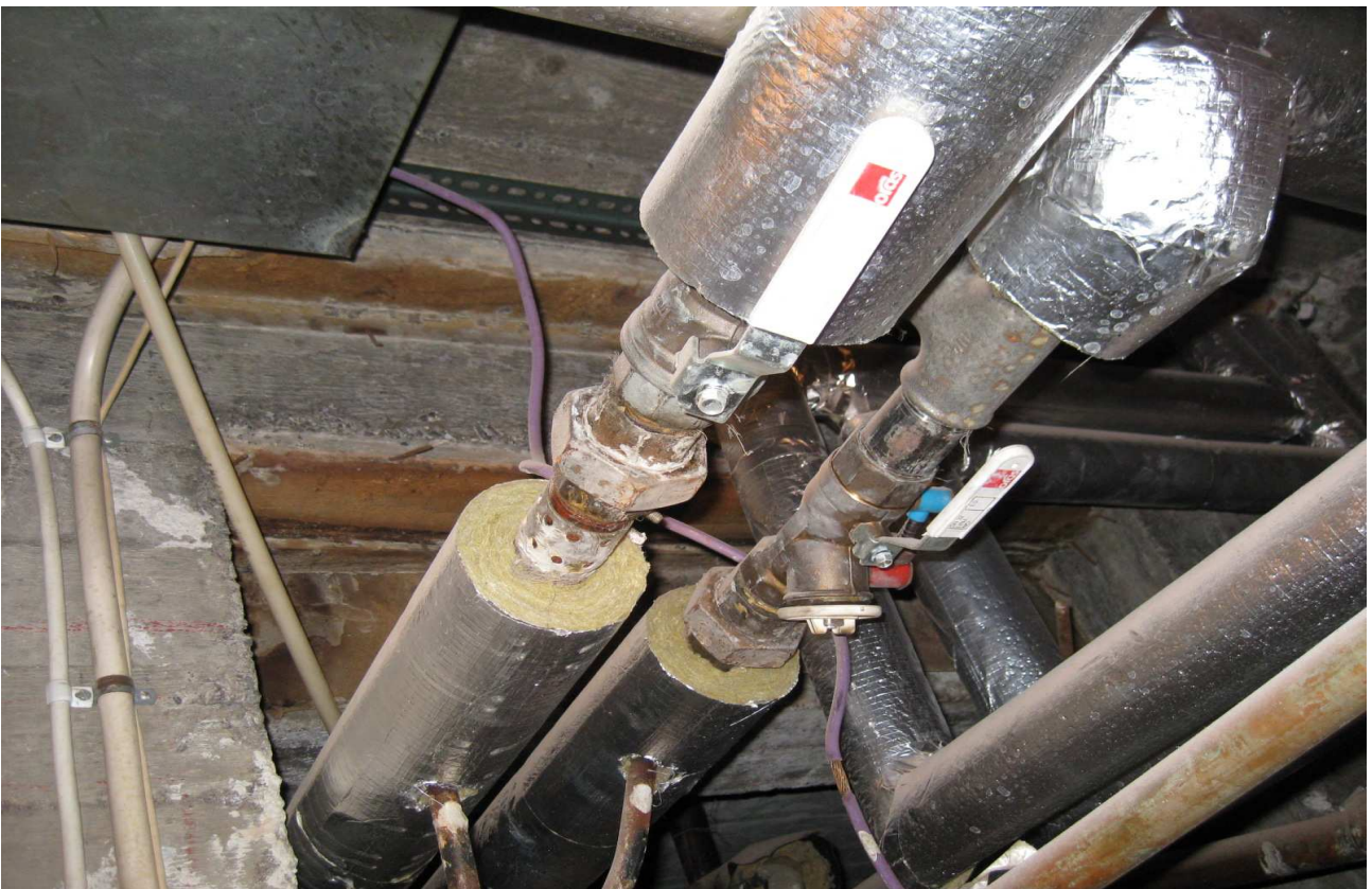
LVI- kuva 3. Yleiskuva koulun uuden puolen lämpöjohtoverkoston venttiileistä.
