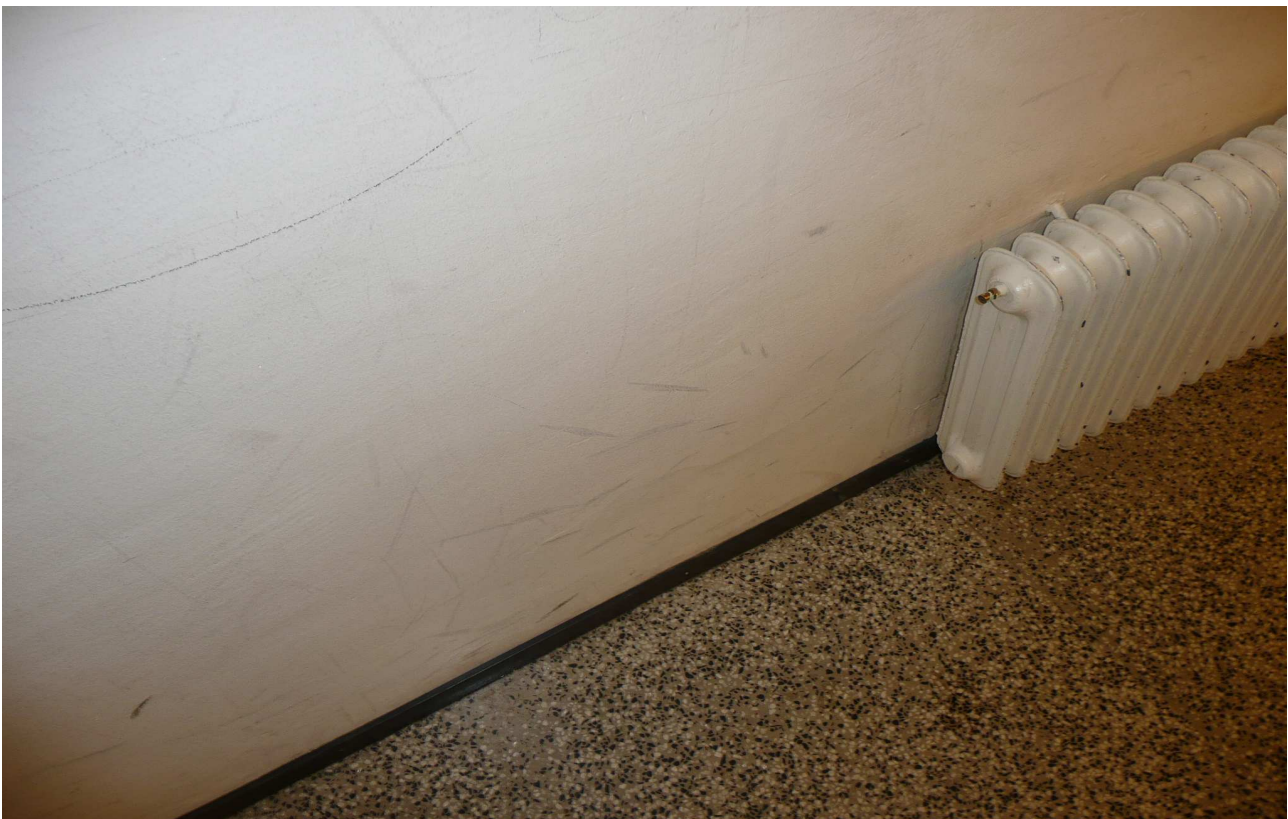
RAK- kuva 14. Käytävien seinissä esiintyy eriasteisia kulumia.
