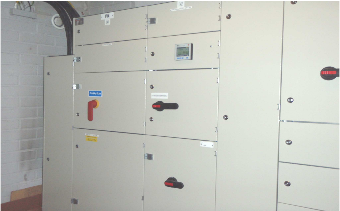
S- kuva 4. Sähköpääkeskus uudempi rakennus.
