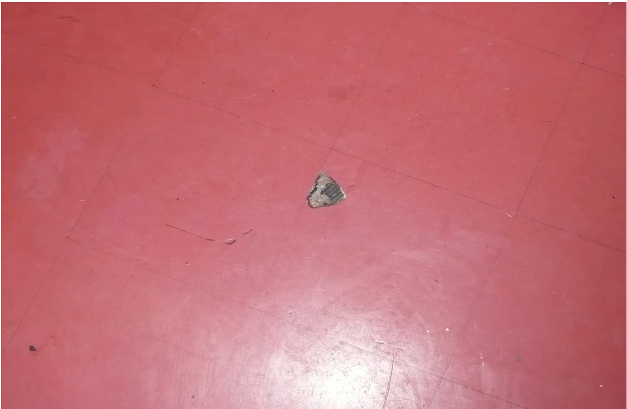
RAK- kuva 15. Porrashuoneiden pinnat ovat kuluneet ja vaurioituneet.
