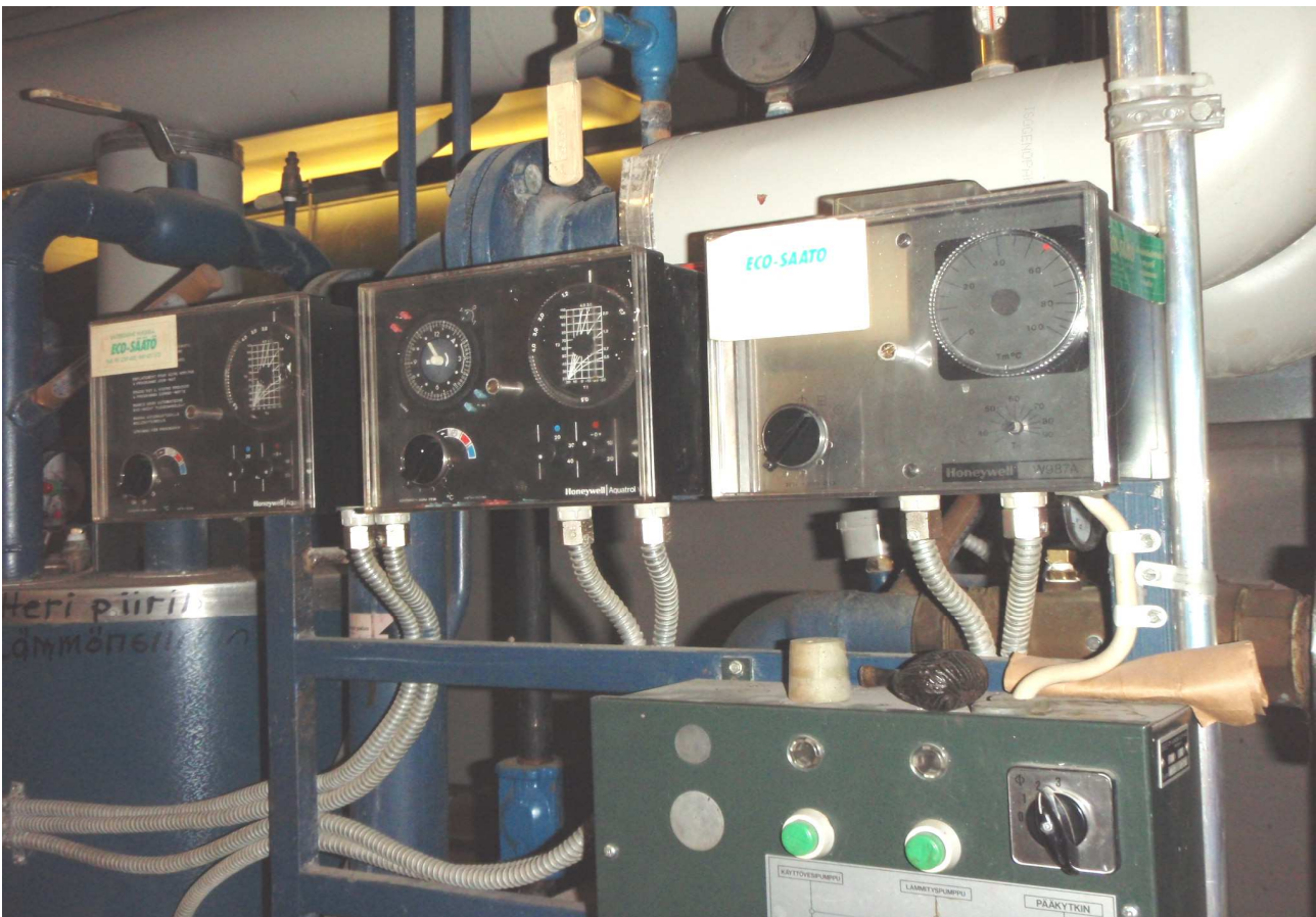
S- kuva 25. Lämmönjaon yksikkösäätimet.
