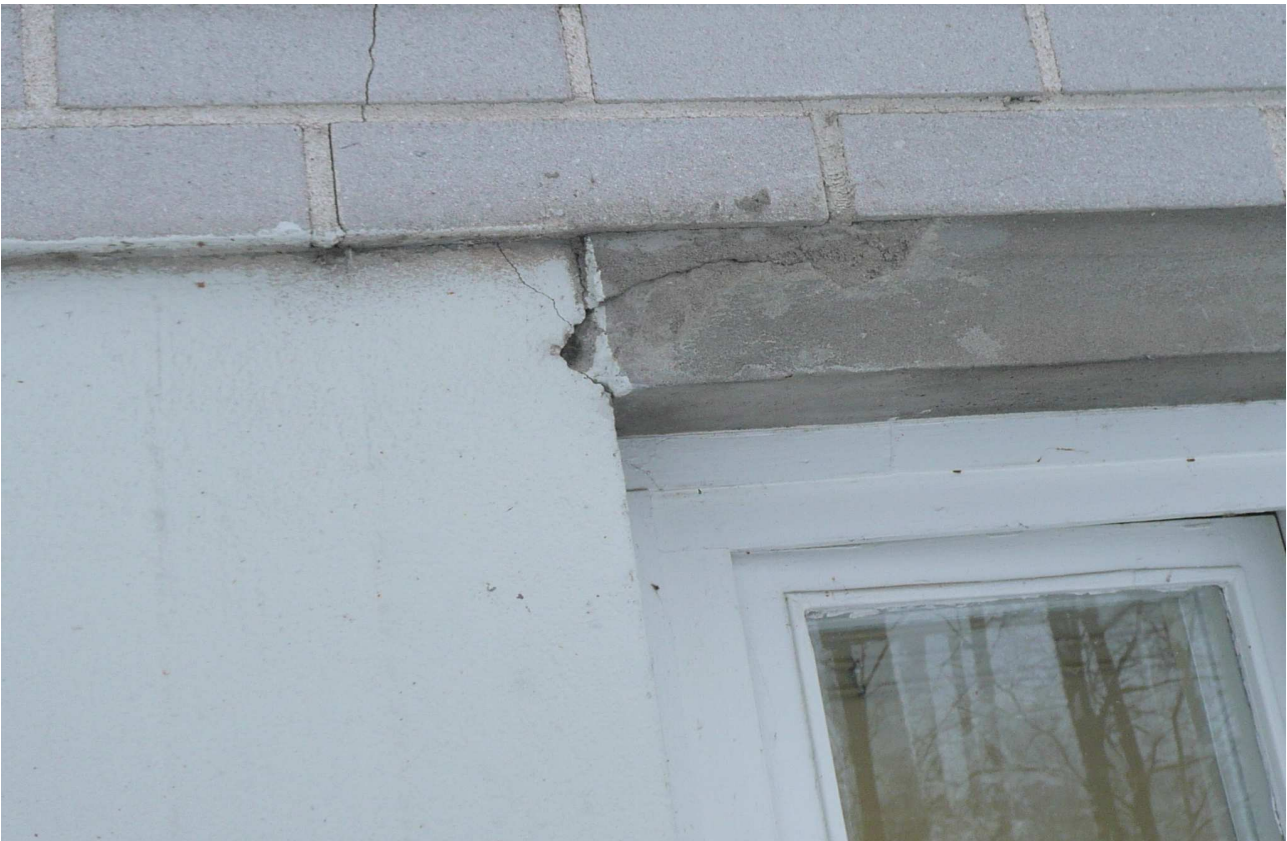
RAK- kuva 5. Betonirakenteisissa ylityspalkeissa todettiin muutamissa kohdissa lohkeamia.
