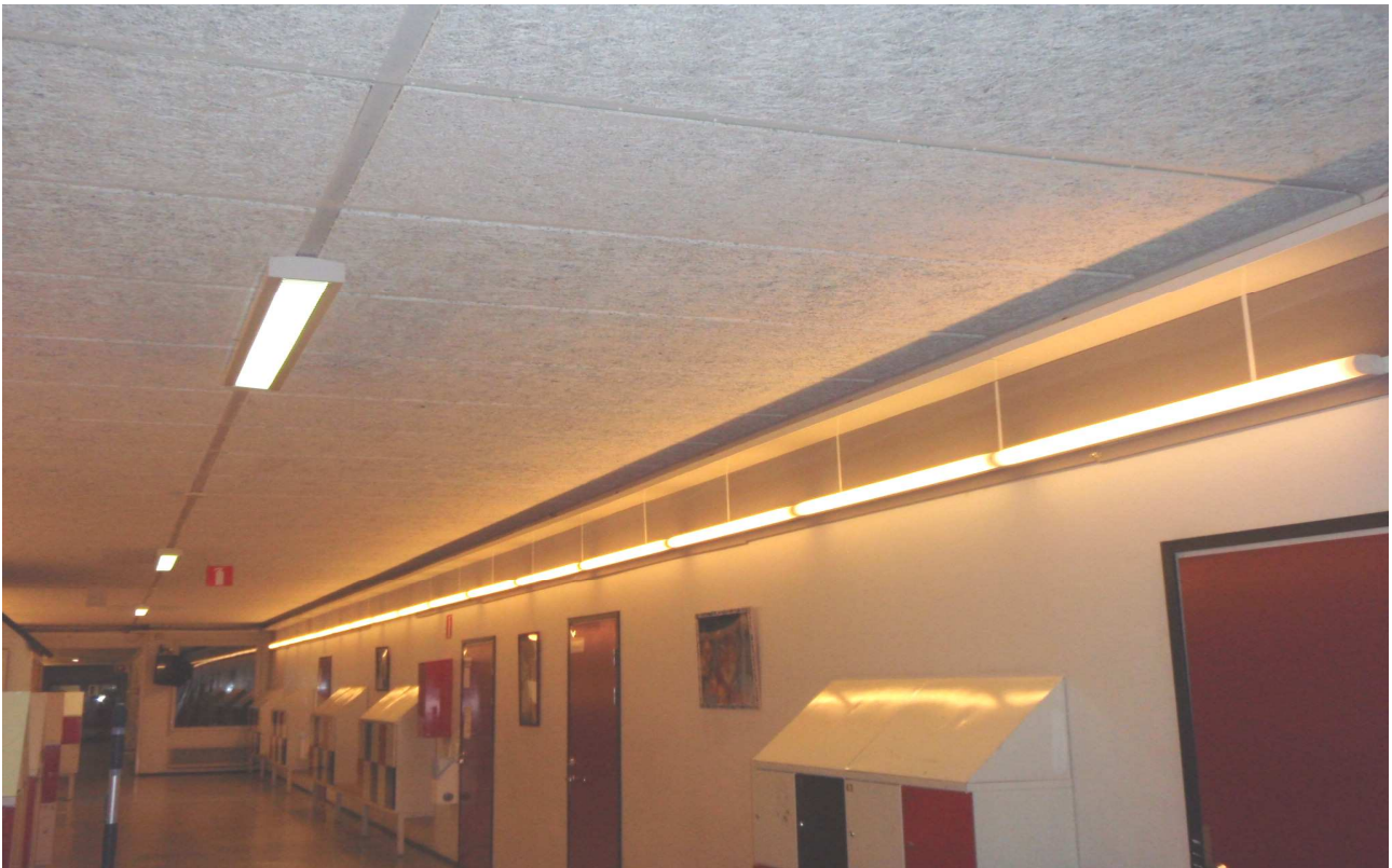
S- kuva 12. Käytävän valaistus.
