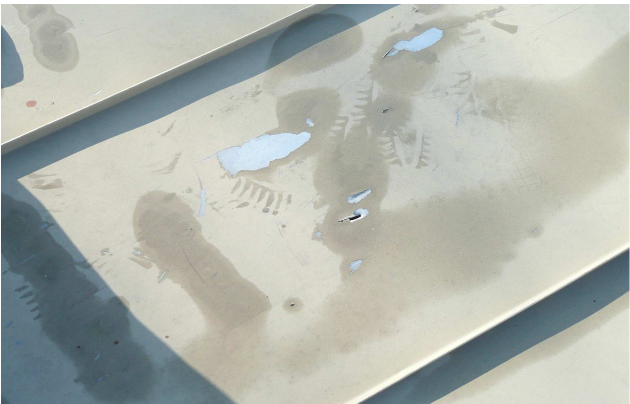
RAK- kuva 12. Peltikatteessa todettiin olevan reikiä.
