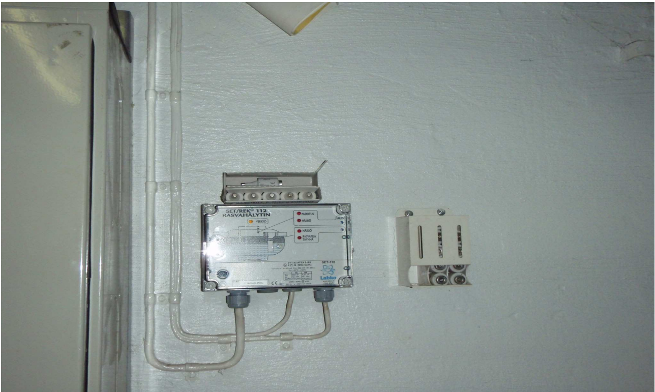
S- kuva 24. Rasvanerotuskaivon hälytyskeskus, keskus hälyttää padotusta.
