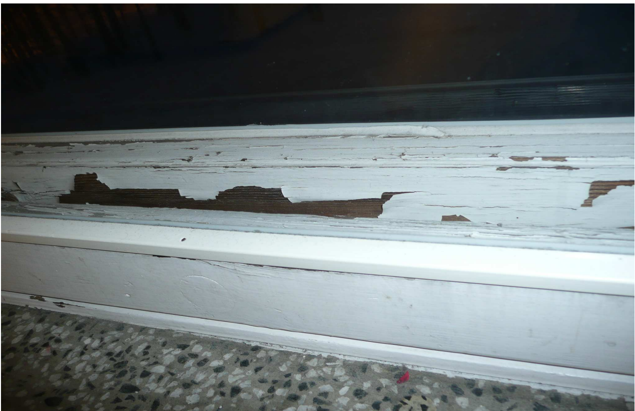
RAK- kuva 8. Puuikkunoissa esiintyy maalipinnan irtoilua ja osittain lahovaurioita.
