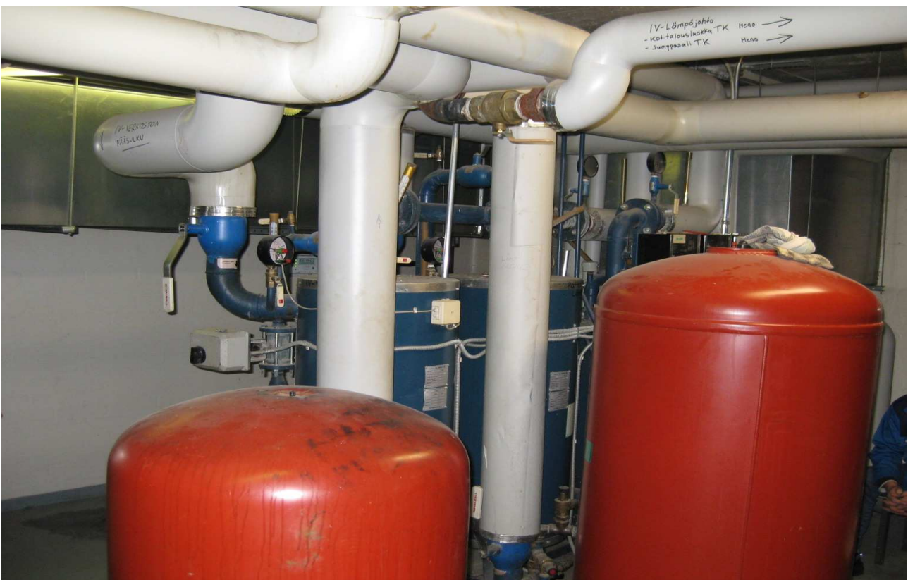
LVI- kuva 1. Yleiskuva lämmönjakohuoneesta.
