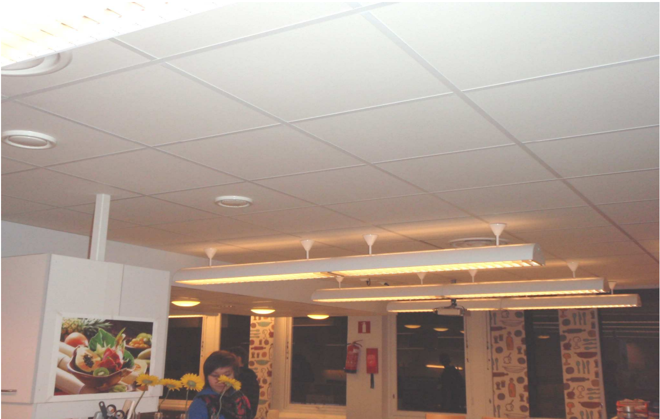
S- kuva 14. Opetuskeittiön valaistus.
