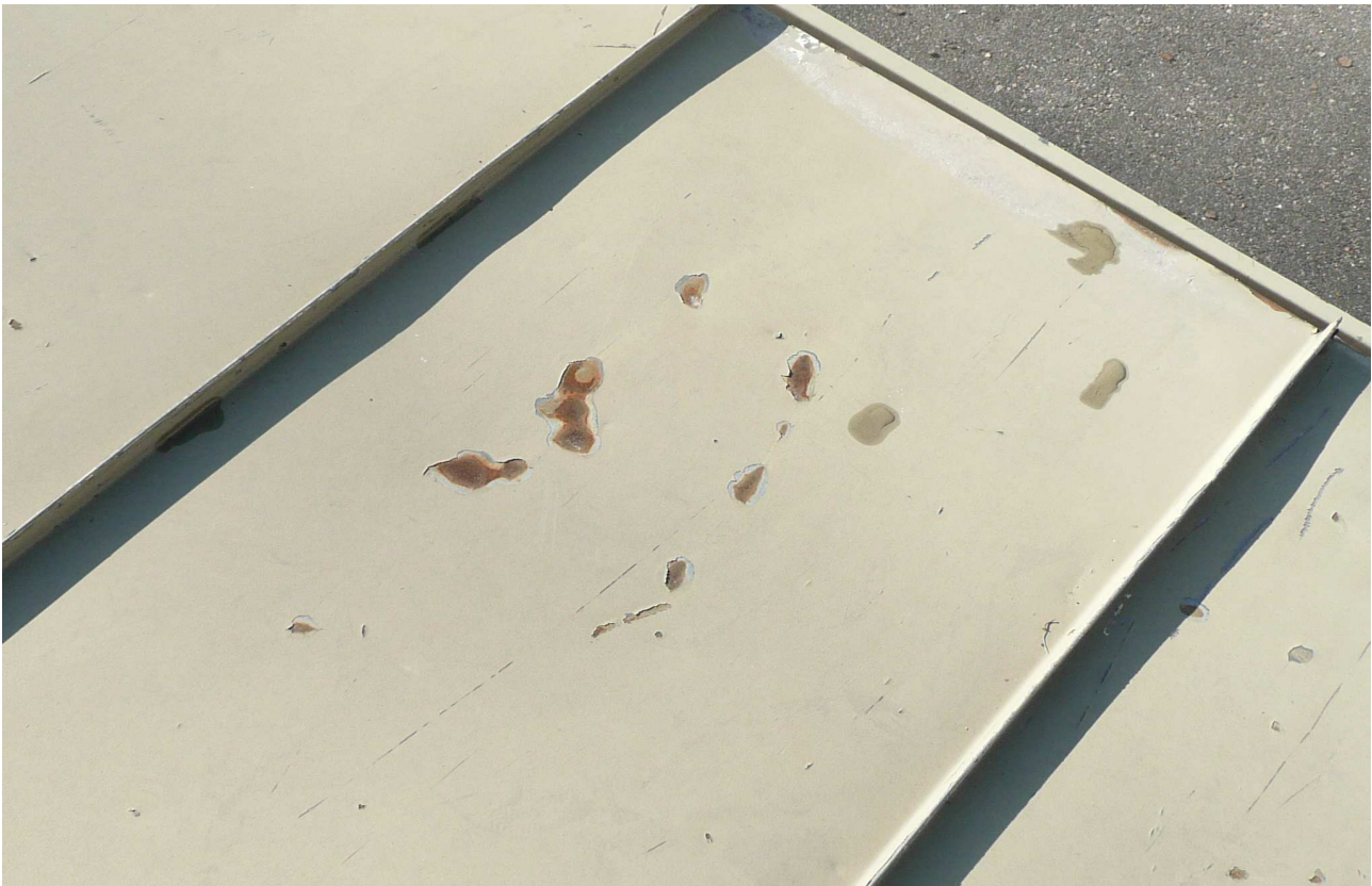
RAK- kuva 11. Peltikatossa esiintyy eriasteisia maalipinnan kulumia ja ruostevaurioita.
