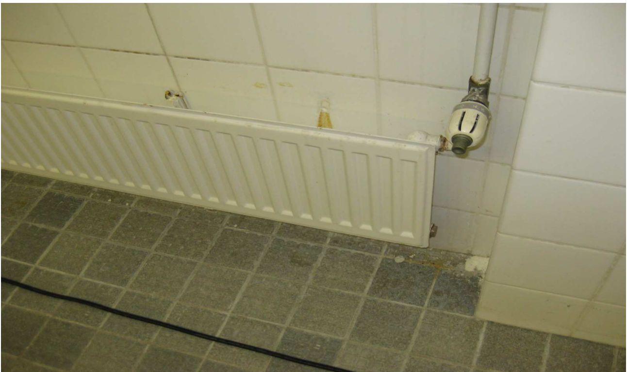
LVI- kuva 5. Yleiskuva uuden puolen patteriventtiilistä.
