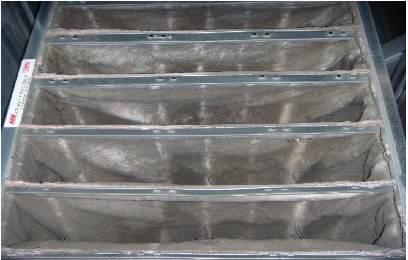
KUVA 3. Yleiskuva tuloilmasuodattimesta TK1.
