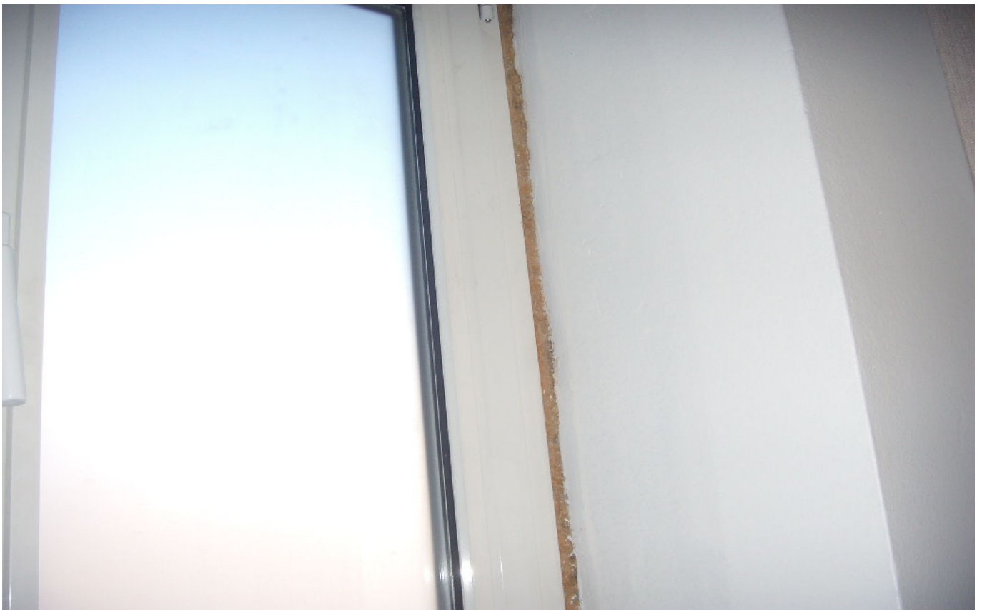
KUVA 32. Opetustilan n:o 302 ikkunalistat puuttuvat.
