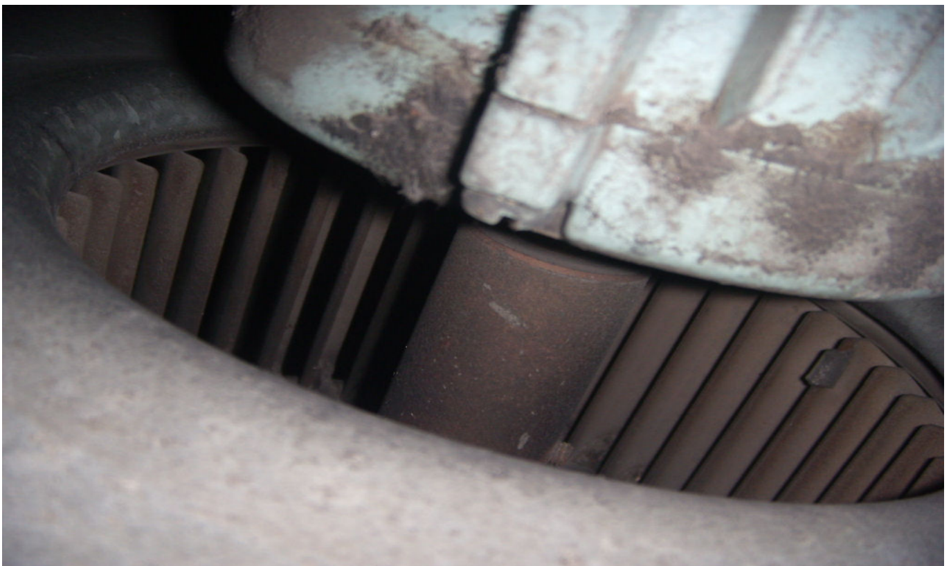
KUVA 12. Yleiskuva tuloilmapuhaltimesta LJ- koje 2.
