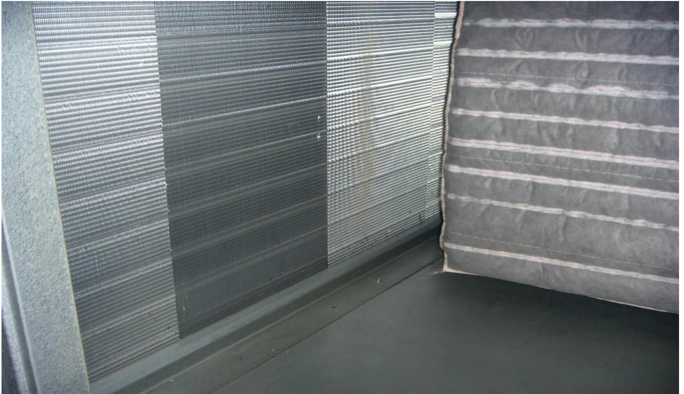
KUVA 15. Yleiskuva lämpöpatterista 3TK3.
