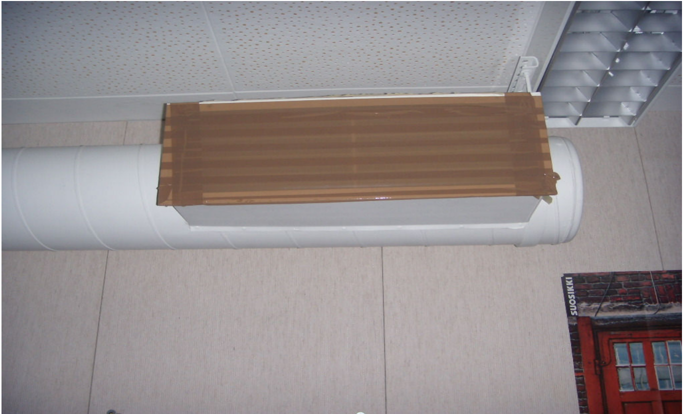
KUVA 33. Opetustilan n:o 302 tuloilmaventtiili on teipattu.
