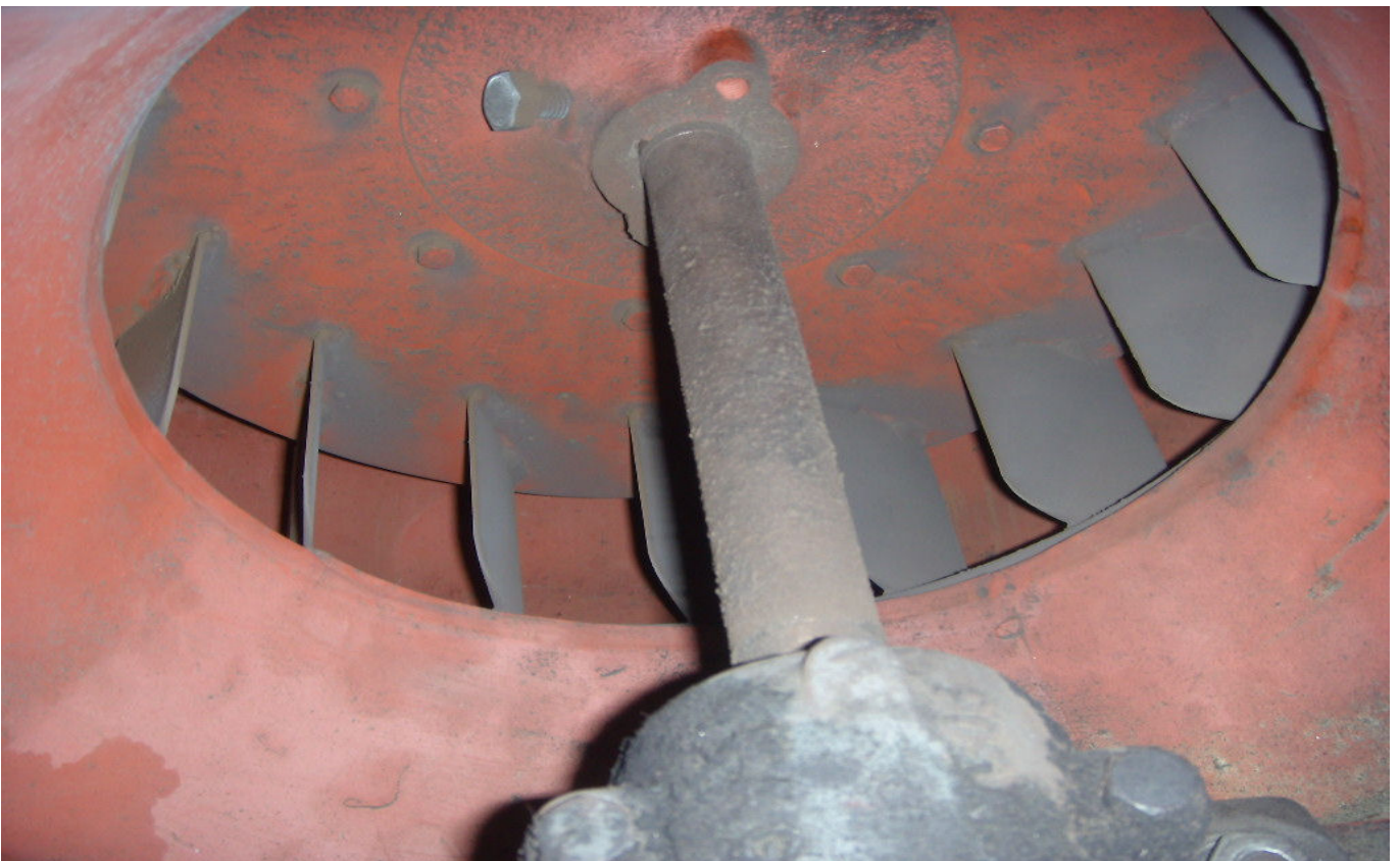
KUVA 8. Yleiskuva tuloilmapuhaltimesta LJ- koje 1.
