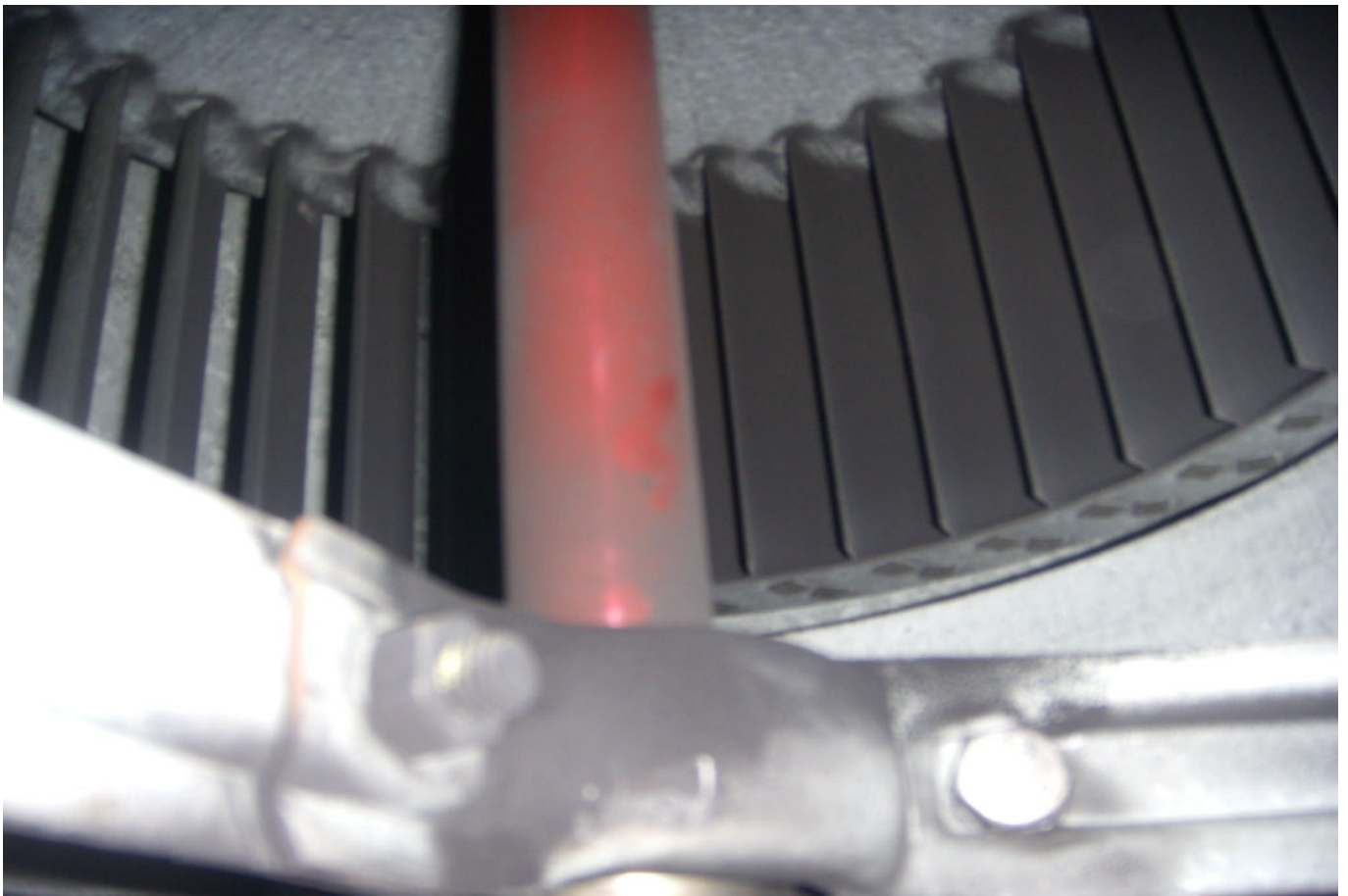
KUVA 18. Yleiskuva tuloilmapuhaltimesta 4TK4.
