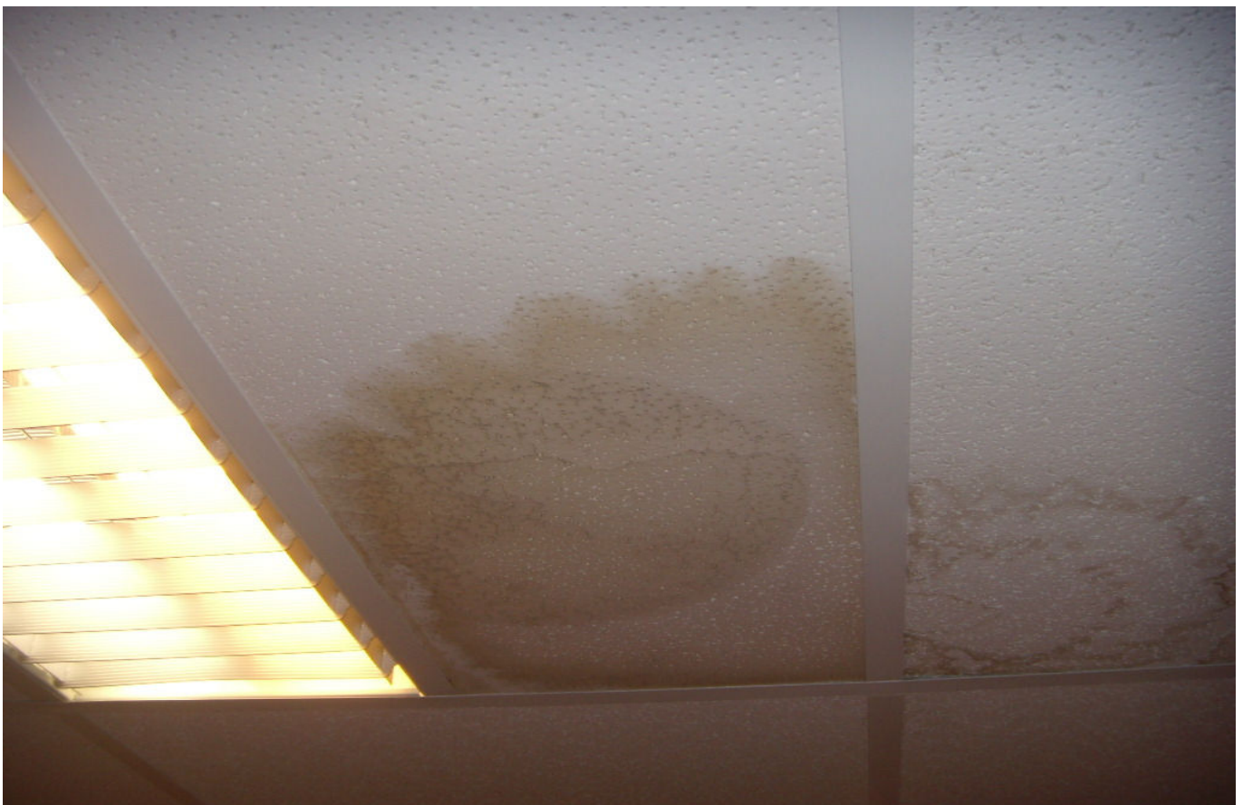
KUVA 30. Yleiskuva katosta, jossa on kosteuden jättämä jälki.
