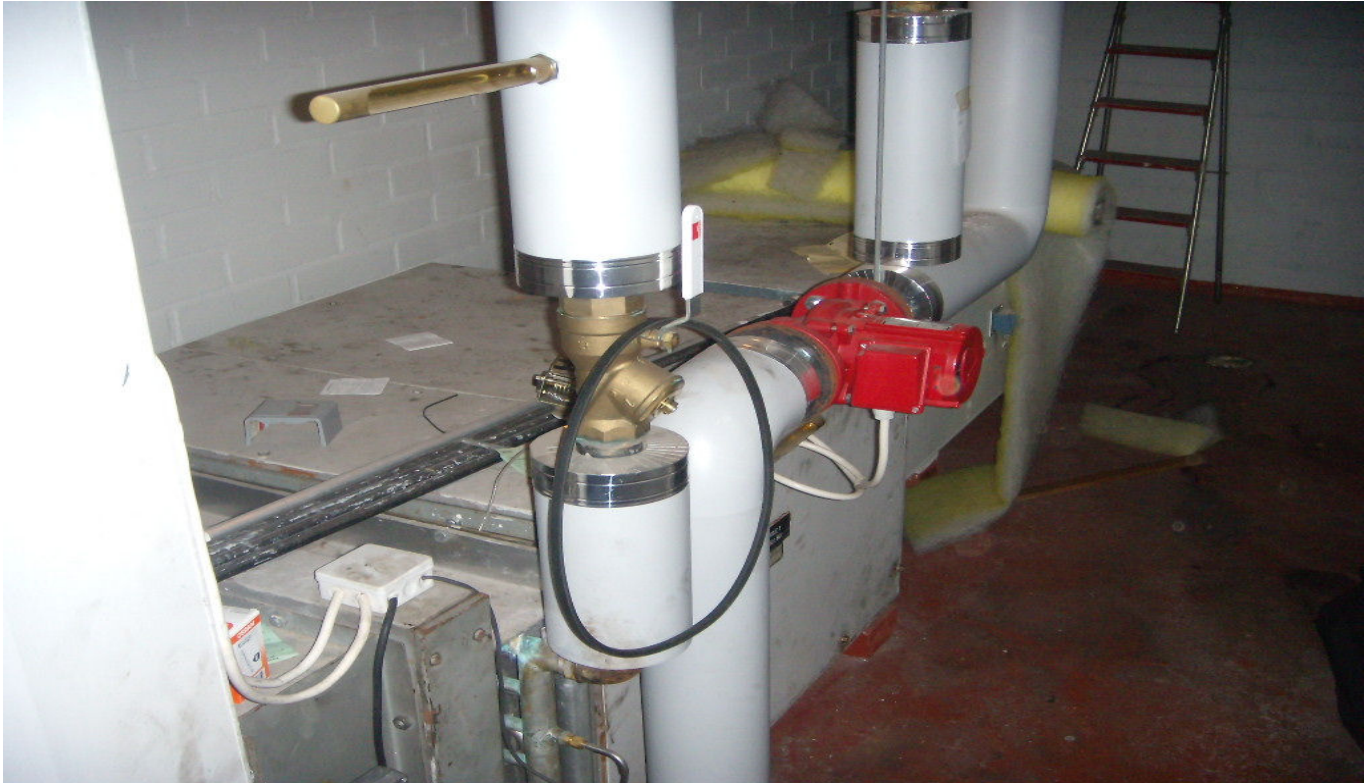
KUVA 1. Yleiskuva IV- konehuoneesta.
