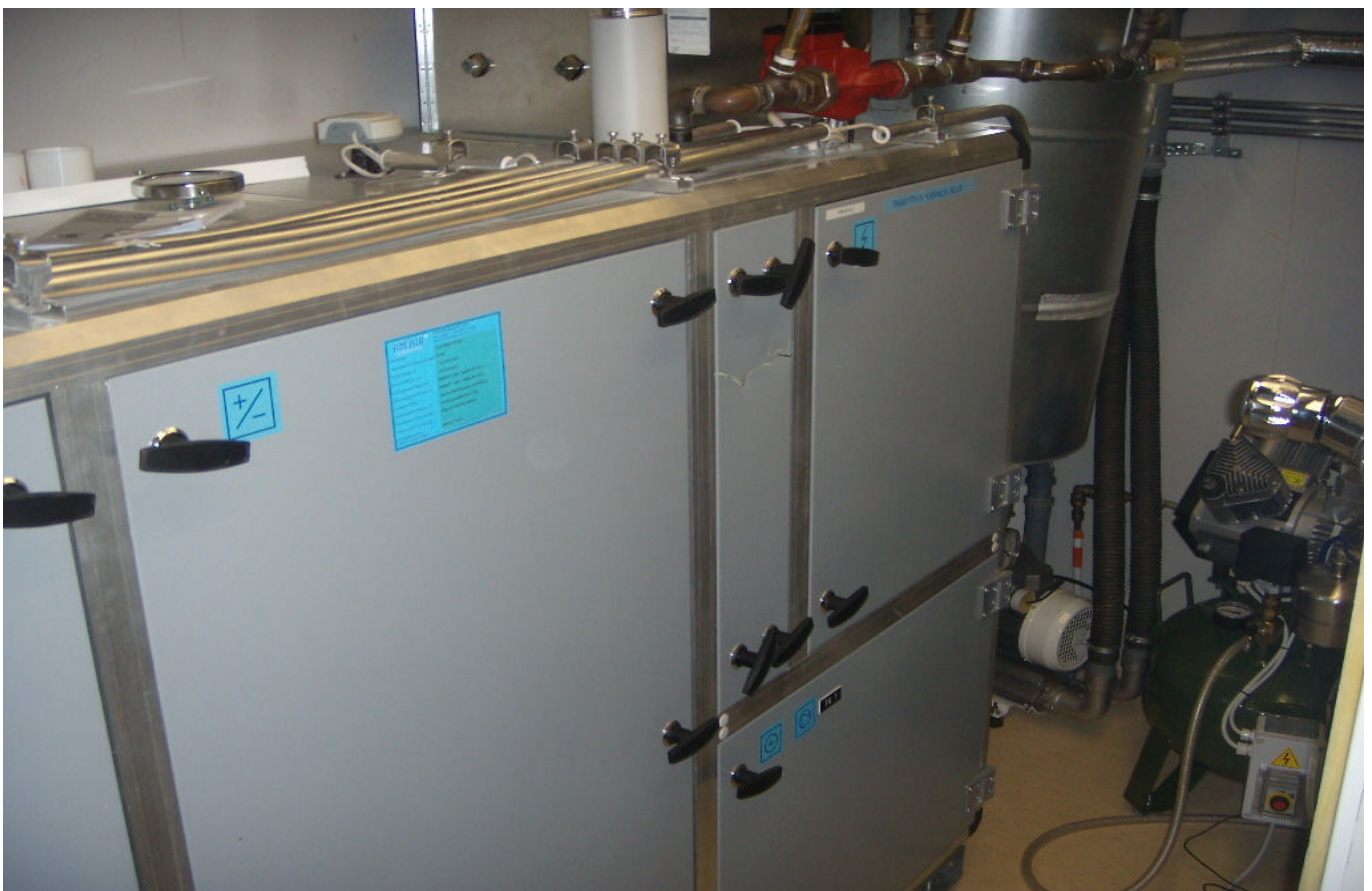
KUVA 2. Yleiskuva IV- konehuoneesta.
