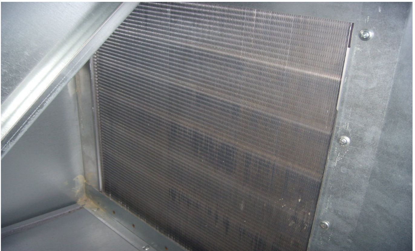
KUVA 4. Yleiskuva lämpöpatterista TK1.
