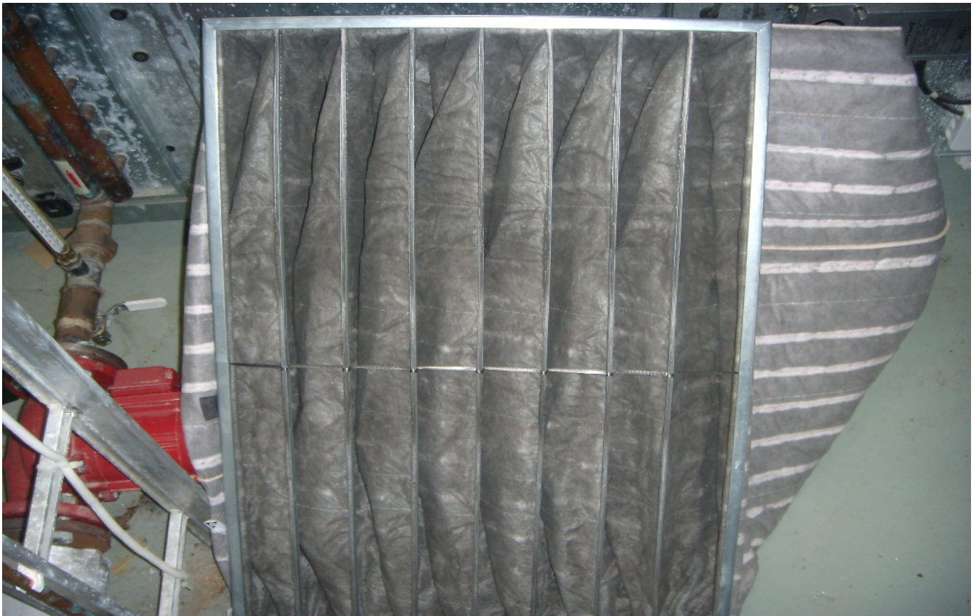
KUVA 14. Yleiskuva tuloilmasuodattimesta 3TK3.
