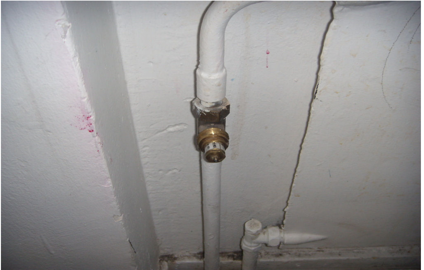
KUVA 31. Yleiskuva lämpöpatterin patteriventtiilistä.
