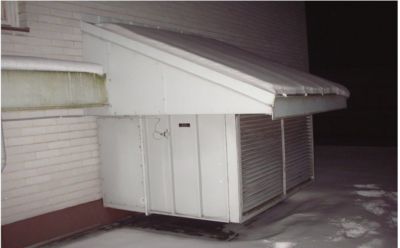
KUVA 13. Yleiskuva tuloilmakoneiden LTO- patterista.
