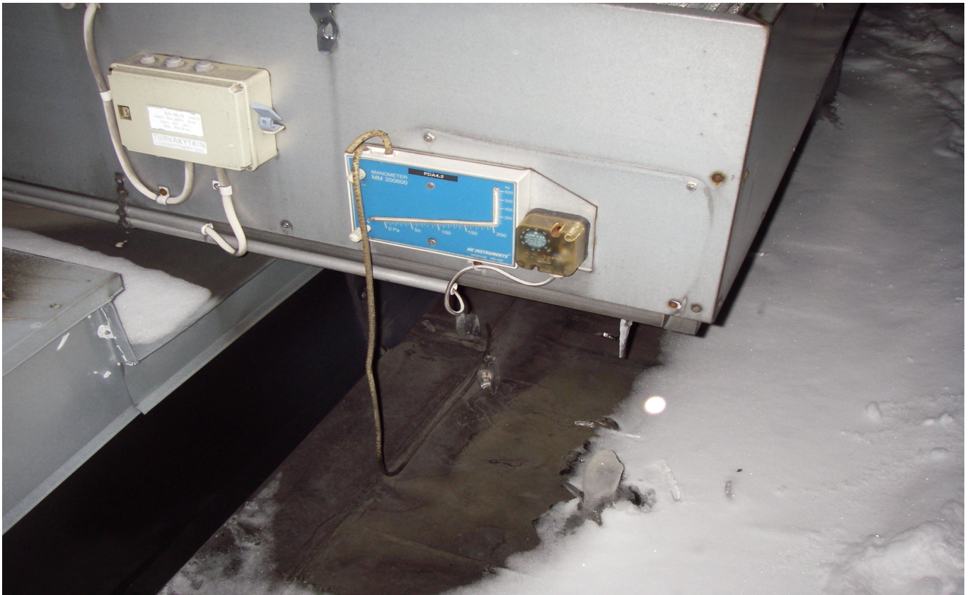
KUVA 22. Yleiskuva huippuimurin paine-eromittarista.
