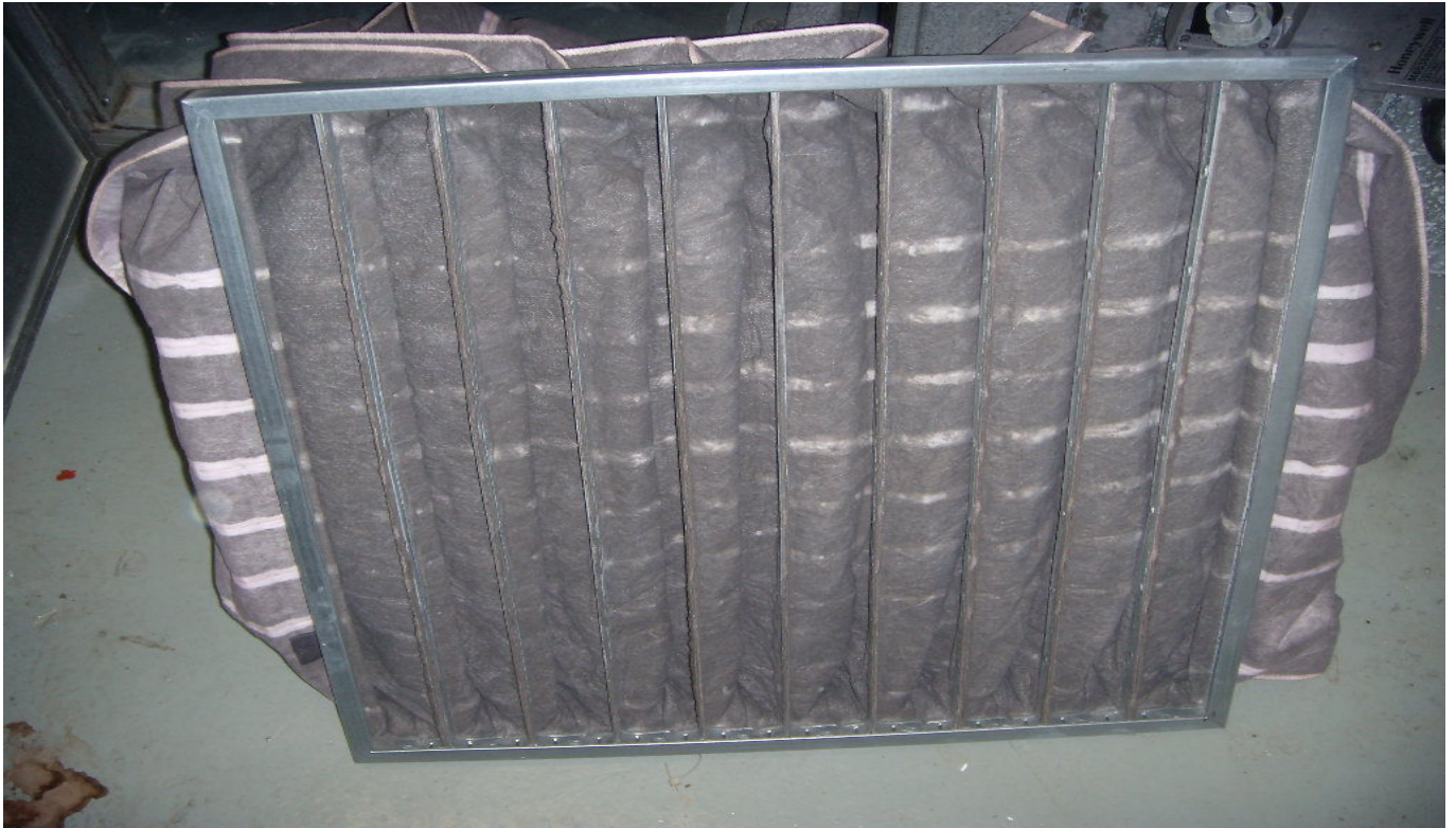
KUVA 17. Yleiskuva tuloilmasuodattimesta 4TK4.
