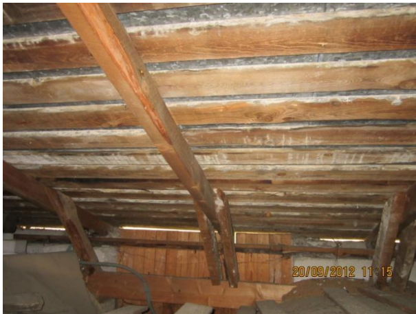
Kuva 39 Ontelo tuulettuu räystäältä, kattotuolin kantavuus tulee varmistaa.
