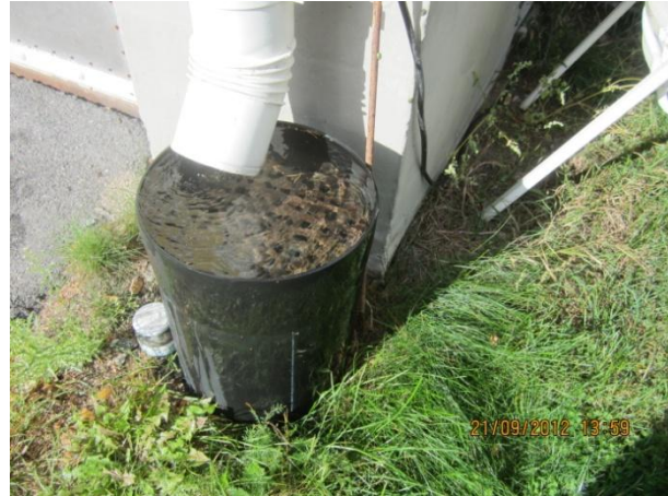
Kuva 20 Autotallin kulmalla tulviva rännikaivo
