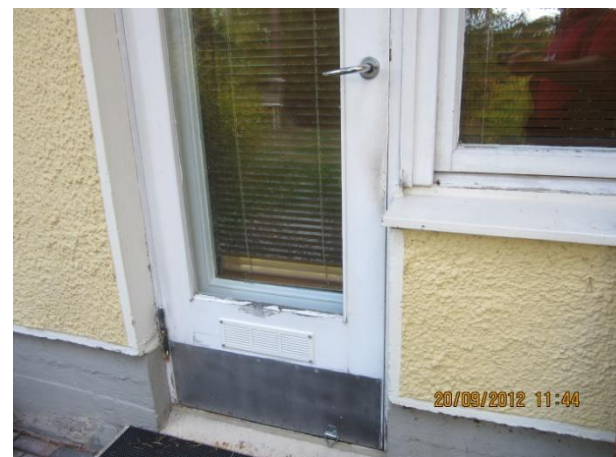
Kuva 30 Asunnon terassin ovi on kulunut, siinä on venttiili.
