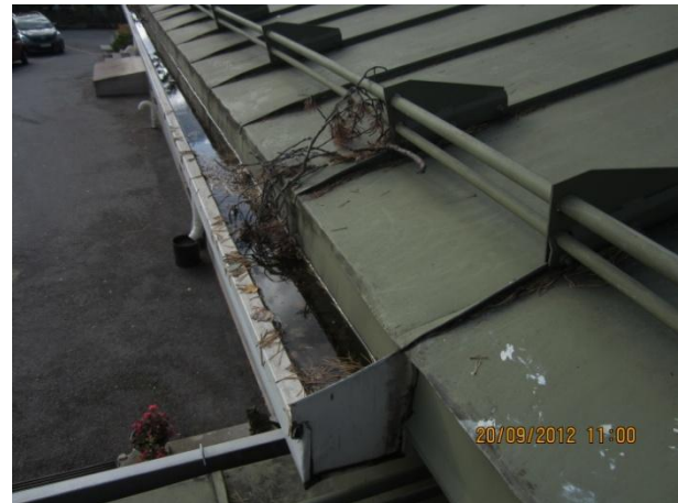
Kuva 34 Rännien huoltoväli on ollut liian pitkä
