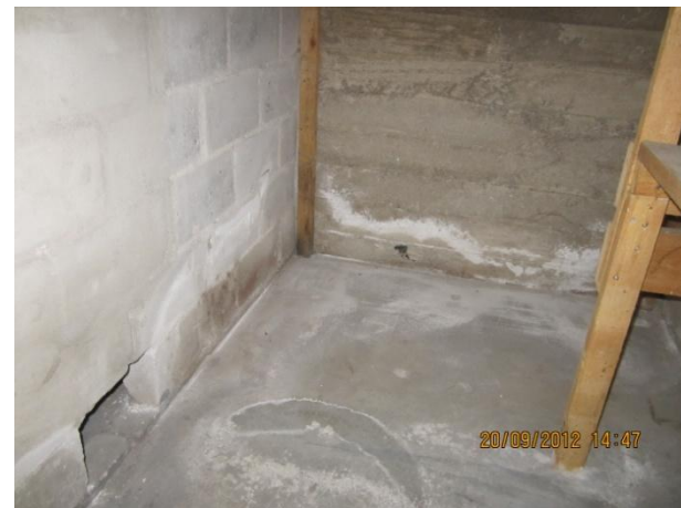
Kuva 10 Kosteuden johdosta tulleita kalkkijälkiä.
