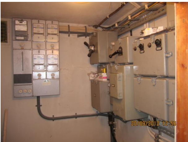
Kuva 65 Alkuperäinen sähköpääkeskus kellarissa
