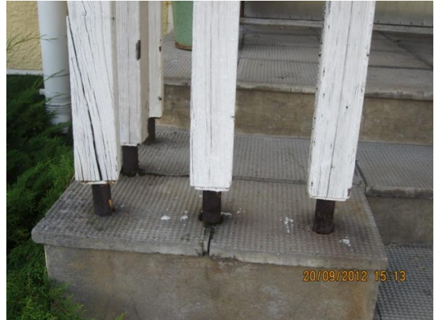
Kuva 26 Toimitilojen pääsisäänkäynnin pilarit ovat halkeilleet
