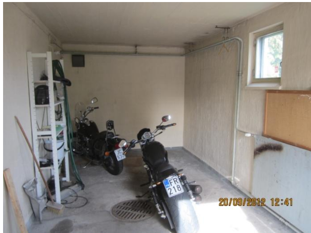
Kuva 13 Autotallin lattia kulunut, halkeamia pintalaatassa.
