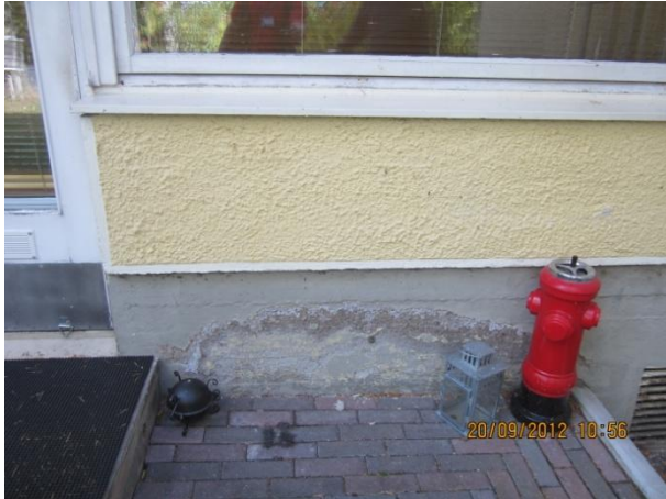
Kuva 7 Sokkelissa kalkkisuoloja asunnon 2 kohdalla
