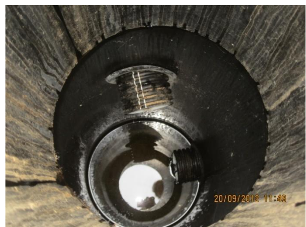
Kuva 18 Saunanurkan tarkastuskaivossa ylem- män putken jp1,2 metriä maanpinnasta ja alemmassa mp-jp n. 2,0 m
