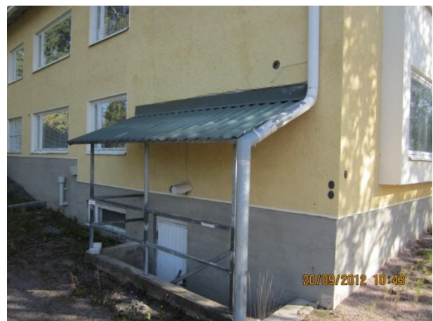
Kuva 6 Kellariorportaiden kaide ei täytä F2 määräyksiä.
