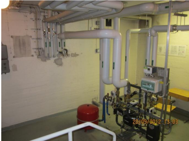
Kuva 55 Lämmönjakuhuoneen laitteisto on uudehko v. 2006.
