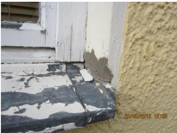
Kuva 23 Huono pellitysliittymä, jonka takia rappausvaurio, erikoinen vp-jatke.
