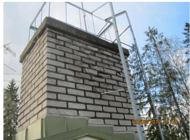
Kuva 42 Huonokuntoinen piippu, tikkailta vesikattolle siirtyminen on haasteellista.
