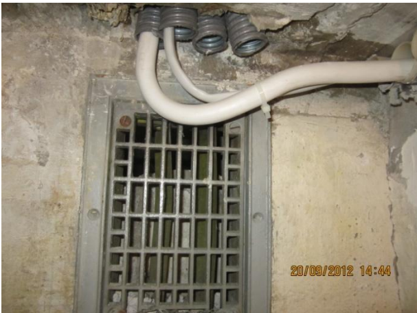
Kuva 63 Kellarin painovoimainen poistoventtiili, hormissa on esteenä tiilimuurausta.
