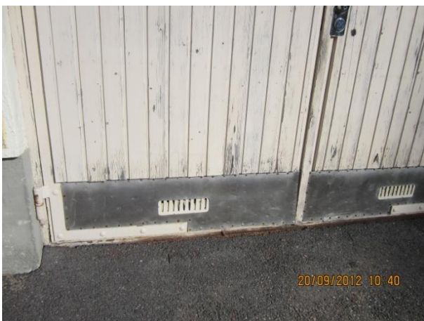
Kuva 29 Autotallien ovipaneelit on uusittu joskus, maali on huonokuntoinen
