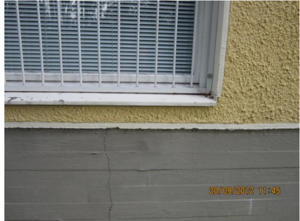
Kuva 8 Maanpaineseinän halkeama länsisivulla
