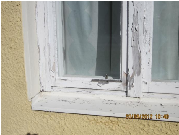
Kuva 27 Ikkunoiden ulkopinnat ovat kuluneet, mutta puu on vielä kovaa.
