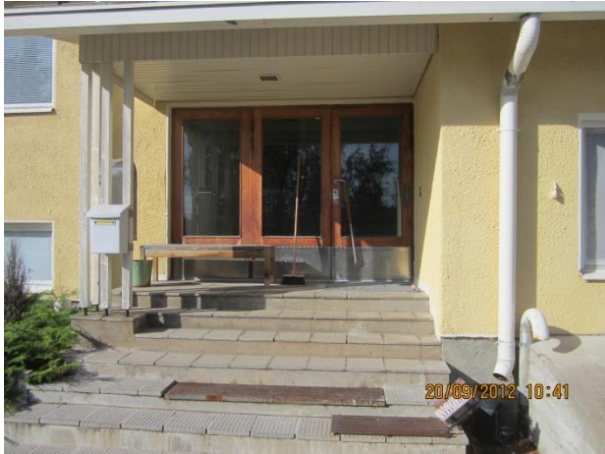
Kuva 31 Toimitilojen pääovi, vain yksi lasi. Betonilaatoissa on kopta.
