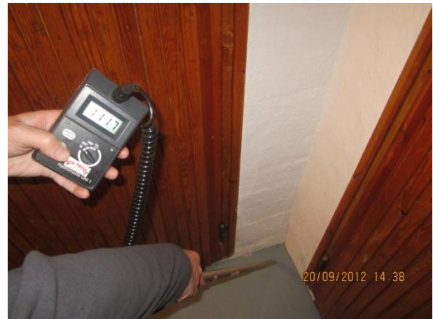
Kuva 14 Pintakosteusarvo koholla kellarin lattias- assa
