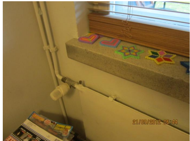
Kuva 58 Asunnon alkuperäinen lämpöpatteri, jossa on uudehko termostaatti.
