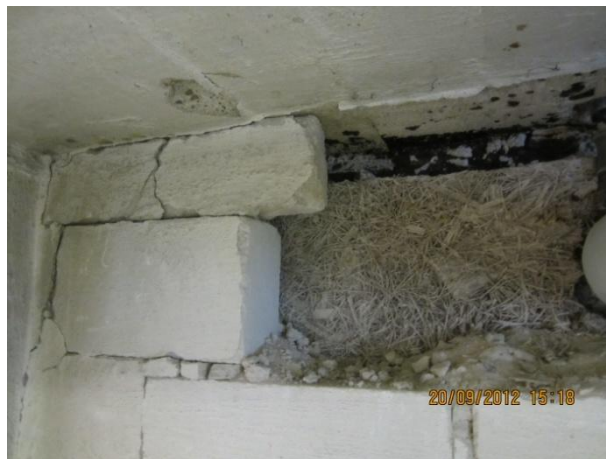
Kuva 9 Maanpaineseinän verhomuuraus, tojalevy ja pikisively kellarissa
