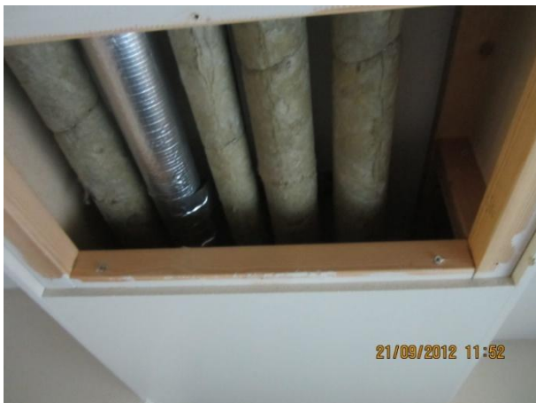
Kuva 59 Putkien runkolinjat asunnon katookotelossa.
