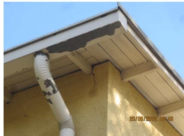
Kuva 24 Rappaushalkeama, maalit irtoaa rän- neistä.
