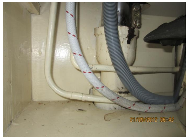
Kuva 60 Vanha valurautaviemäri asunnon keittiön alakaapissa.
