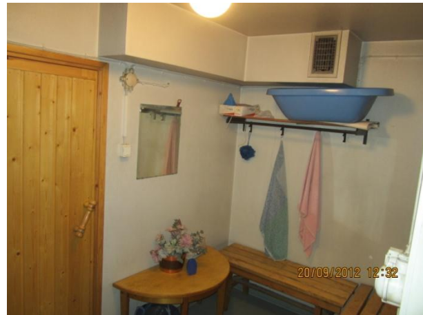
Kuva 64 Saunan pukuhuoneessa on painovoimainen poisto.
