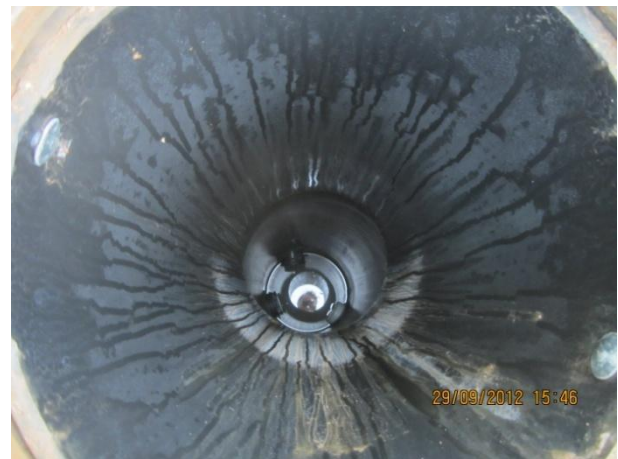
Kuva 16 Kuvan 15 tarkastuskaivossa salaojan juoksupinta on vain n. 50 cm kellarin lattiaa alempana.
