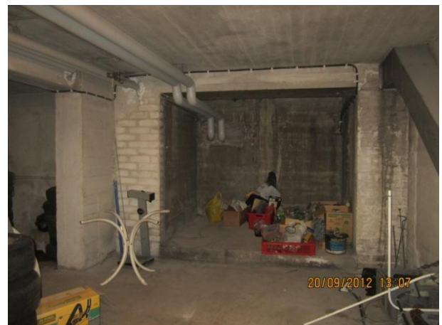
Kuva 54 Entinen koksivarasto toimii varastona, pinnat ovat kuluneet
