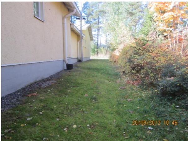
Kuva 3 Pohjoissivulla on ojanne, verkkoaita on kasvuston sisällä
