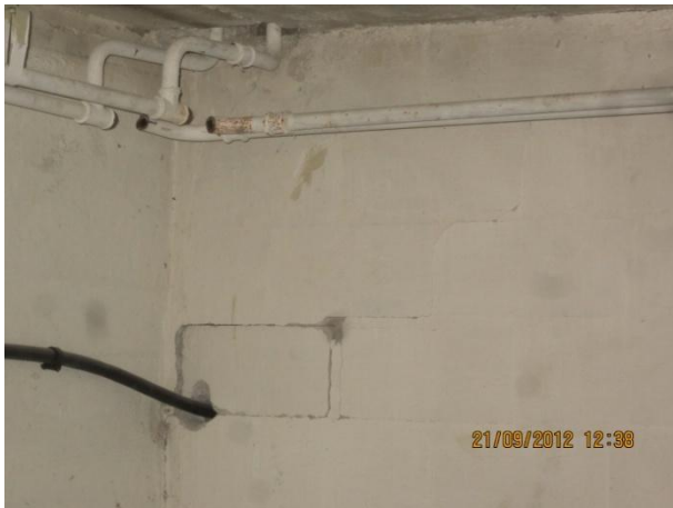
Kuva 57 Käytöstä poistettuja lämpöputkia kellarissa.
