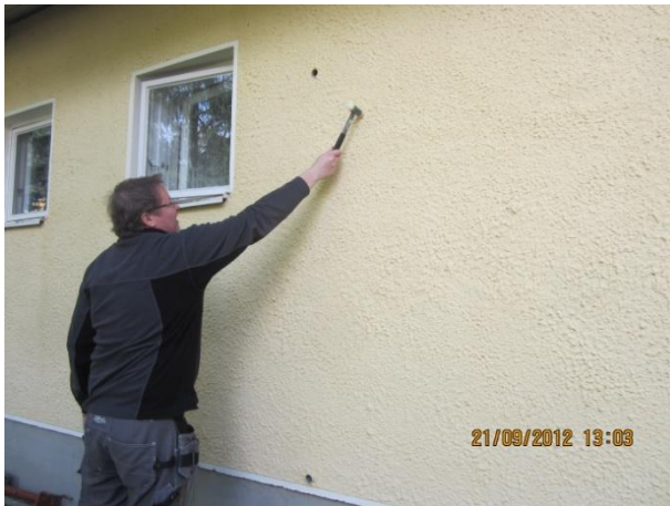
Kuva 21 Julkisivujen rappauksissa ei ole mer- kittävästi kopoa.
