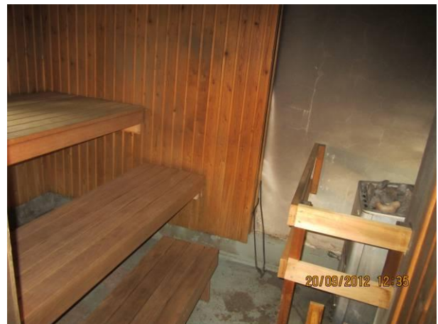
Kuva 22 Sauna on kulunut, lattiassa havaittiin kosteutta lauteiden alla
