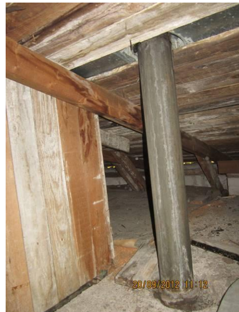
Kuva 20 Tuuletusviemäri on eristämättä, voi huurtua umpeen.
