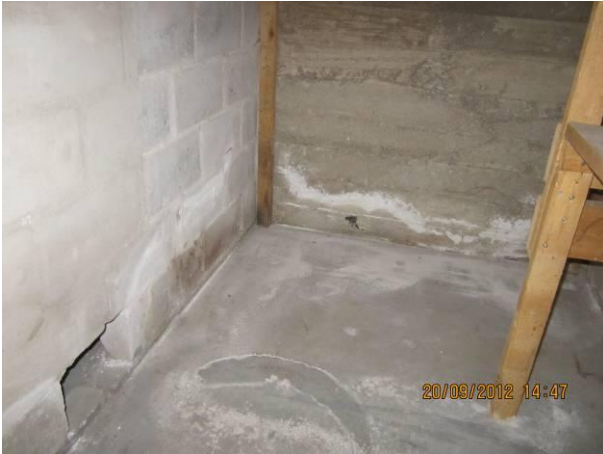
Kuva 13 Kalkkijälkiä tiiliväliseissä kellarissa, kapillaarista vedennousua
