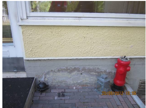
Kuva 4 Sokkelin pintavaurioita, asunto 2.
