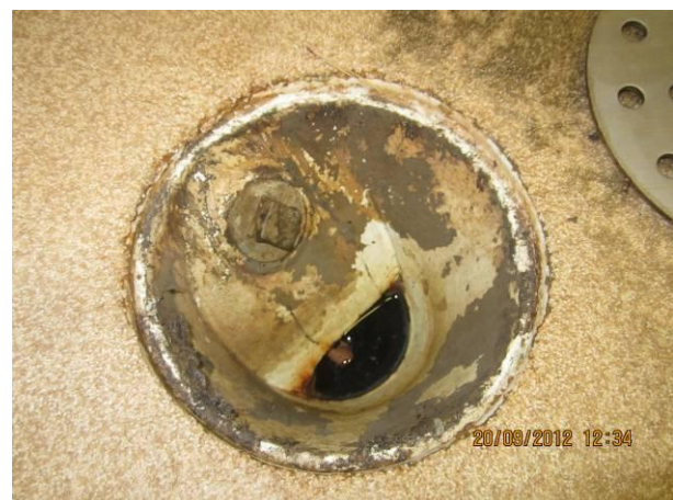
Kuva 24 Vanha valurautakaivo saunan pesuhuoneessa.
