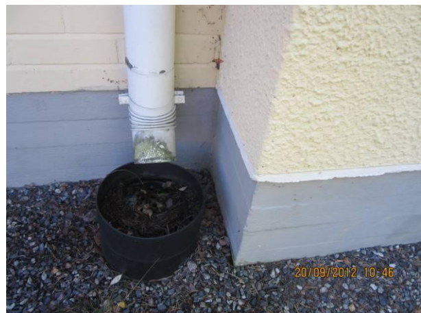
Kuva 2 Kattosadevedet n johdettu rännikaivoihin, mutta niitä ei ole puhdistettu riittävän usein
