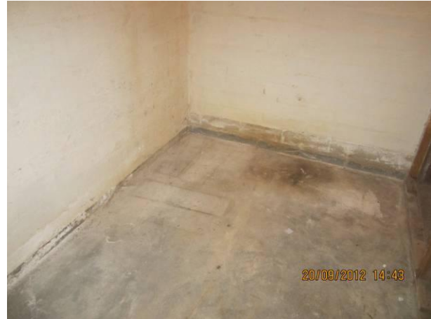
Kuva 14 Kalkkijälkiä ja maalivaurioita betoniväliseissä
