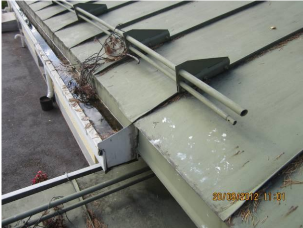
Kuva 17 Rännien huolto on ollut huonoa.
