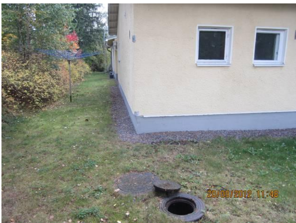
Kuva 1 Saunan kulma, maanpinnat ovat lähellä pohjalaattaa, pintakallistukset ovat pienehköt
