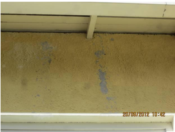
Kuva 11 Maali irti räystäään alla, mahd. kyseessä kosteus.
