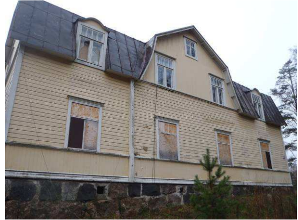
Ulkoverhouksissa on havaittavissa maalin irtoilemistä ja paikoin kunnostustarvetta.
