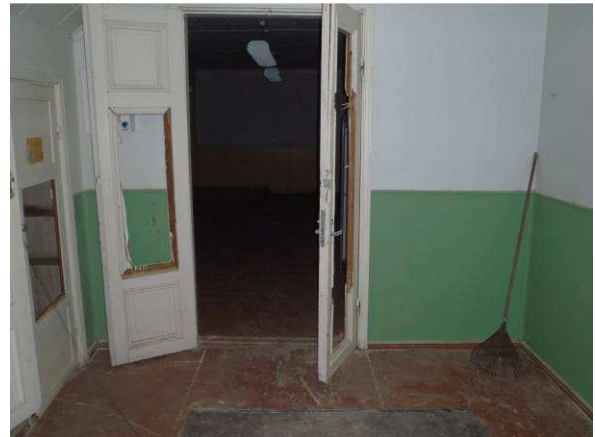
Sisäovet ovat osin hajalla.
