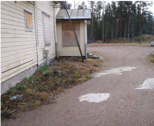
Kuvaa rakennuksen etupihalta, kallionpinta on melko korkealla. Pintavedet ohjautuvat rakennukseen päin.
