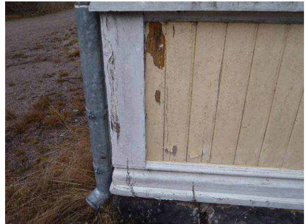
Paikoin julkisivuissa on vaurioita.
