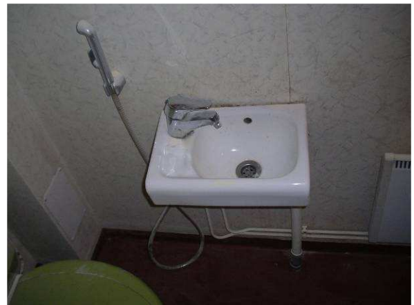
Vesikalusteet olivat vielä tyydyttäväkuntoisia.
