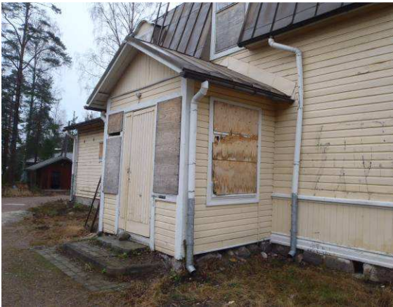
Pääsisäänkäynnin ovi on jo huonokuntoinen.
