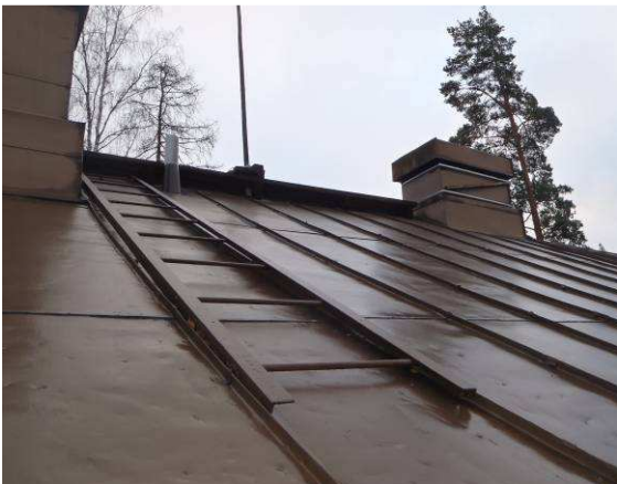
Hormien päällä ei ole suojahattuja, katolla on puukulkusillat. Lapetikkaat ovat asennettu väärin.
