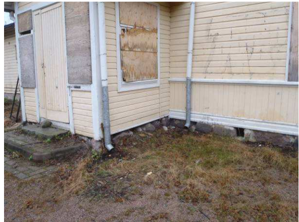
Kattovedet valuvat syöksytorstista rakennuksen vierustalle, sisäänkäynnin kohdalla sokkeli on matala.
