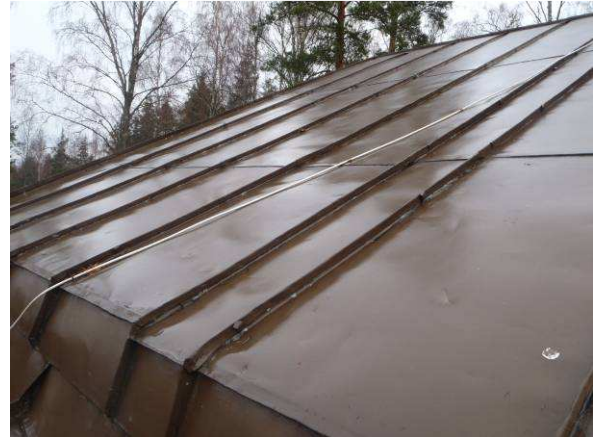
vanhan osan katto vaikutti olevan vielä tyydyttävässä kunnossa.
