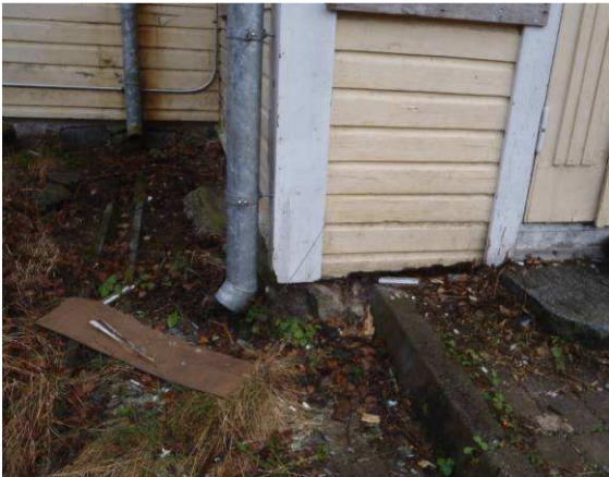
Eteisen osalla julkisivu on lähellä maanpintaa ja verhoukset on vaurioituneet.
