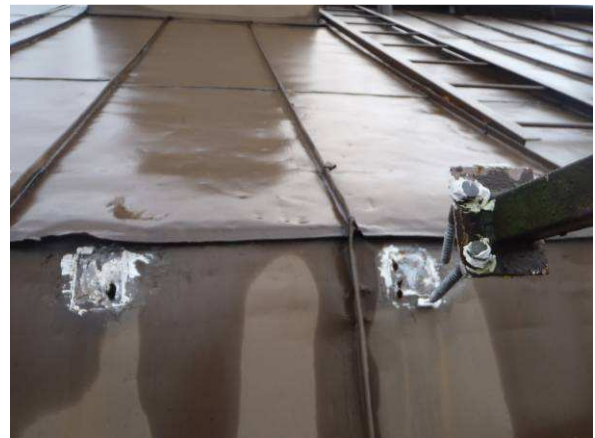
Talotikkaiden yläpään kiinnitys on irronnut katoista.
