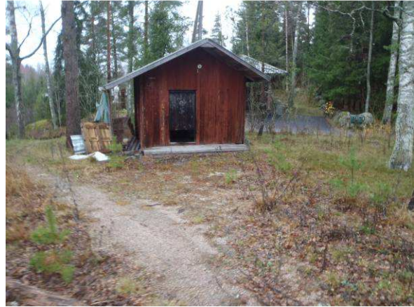
Varastorakennus on huonokuntoinen.
