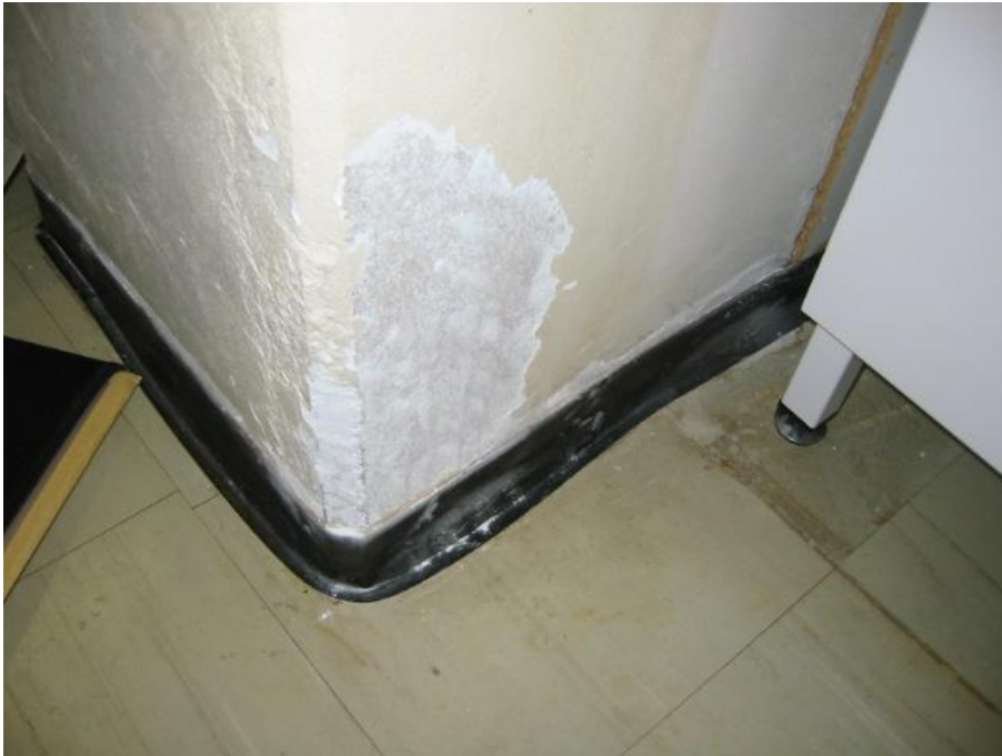
Kuva 5. Maali- ja tasoitepinnan hilseilyä pilariin liittyen huonetilassa 1.159.
