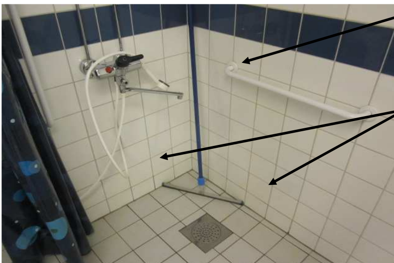
tukikahvan kiinnityskohdat on tiivistämättä
