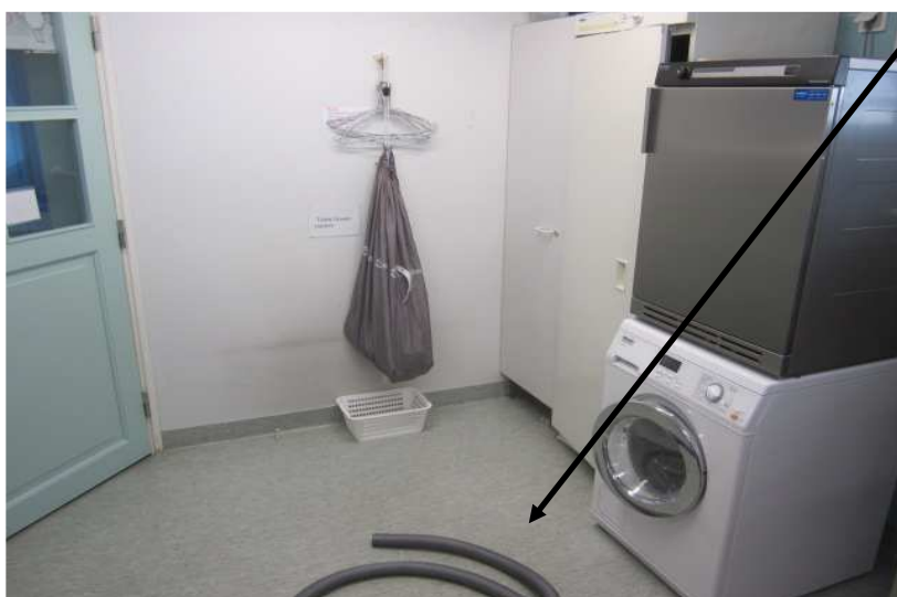
pesulahuoneen kastunut lattia
