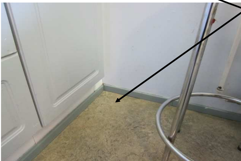
keittiön lattia on kastunut lievästi
