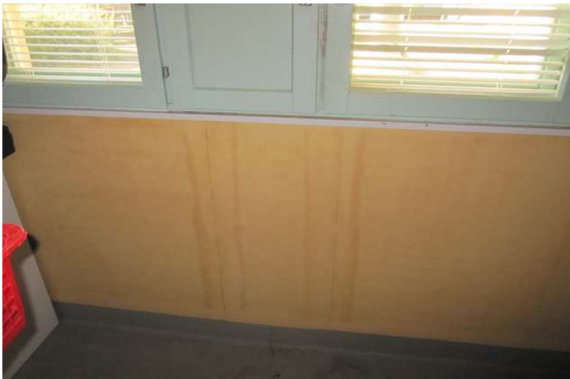
ulkoseinässä jo kuivuneita valumajälkiä
