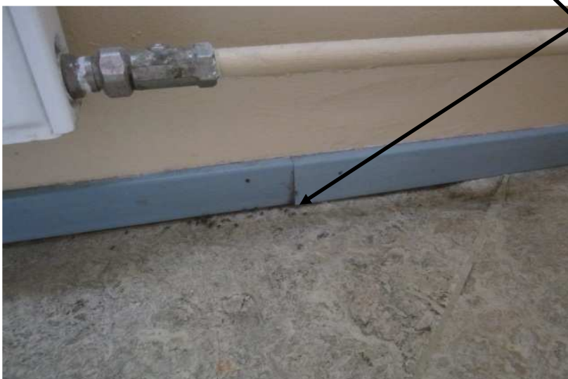
ulkoseinän vieressä muurahaisia
