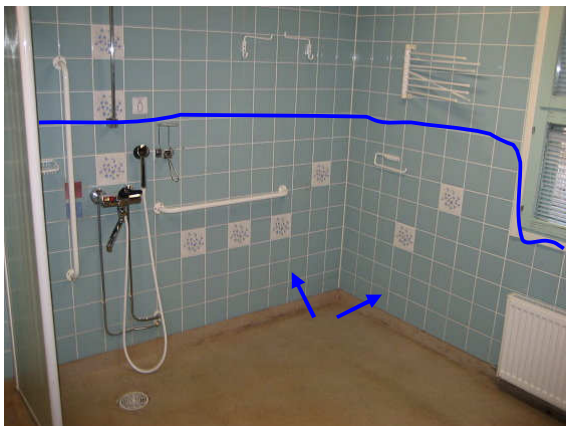
Kuva 8 Pesuhuone 24. Väliseinä on märkä ulottuen noin 1200 mm korkeudelle. Samoin ulkoseinän sisäverhouskipsilevy.
