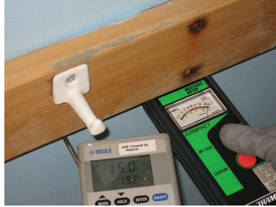
Kuva 4 PR1, pesutila 9. Alemman tukipuun alta mitattiin ulkoseinärakenteen eristetilasta kosteus ja lämpötila. Kipsilevy on märkää. Ruuvit ovat ruostuneet.
