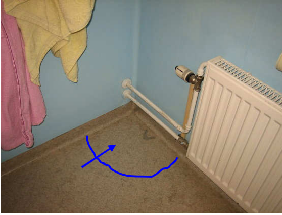
Kuva 3 Ulkoseinän vierustalla ikkunan alapuolella lattiassa on kohonnut pintakosteus.
