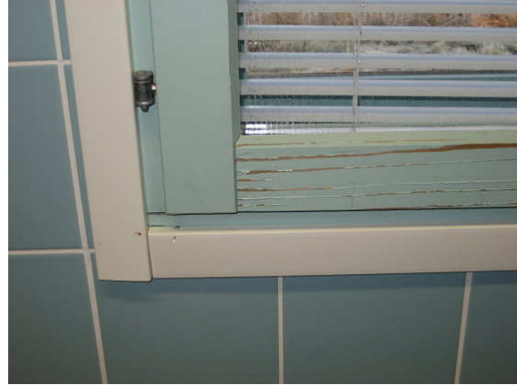
Kuva 16 Ikkunoiden maalipinnat hilseilevät märkätiloissa.
