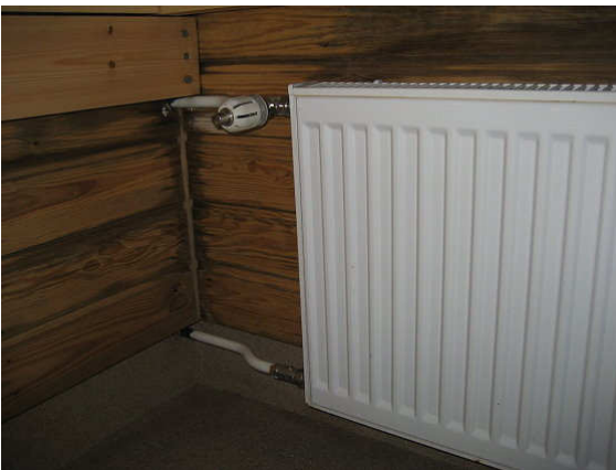
Kuva 11 Panelointi tummunut ylälauteen alapuolelta.
