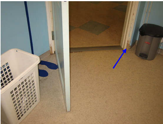
Kuva 13 Peitelistöjen alaosien maalipinnat hilseilevät.
