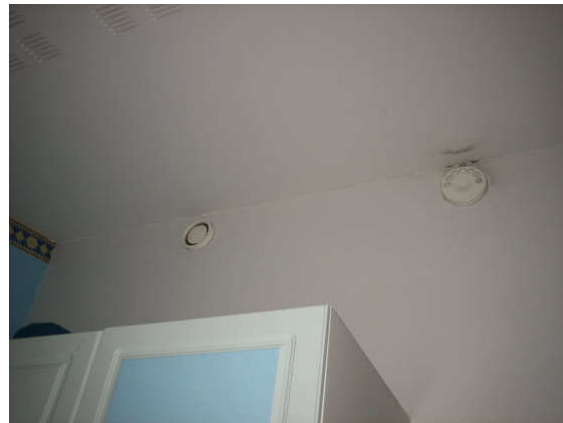
Kuva 14 Tuloilmakanavan kohdalla seinä- ja kattopinnoilla on pölyä tv.. Poistoilma-venttiilit ovat pölyiset.
