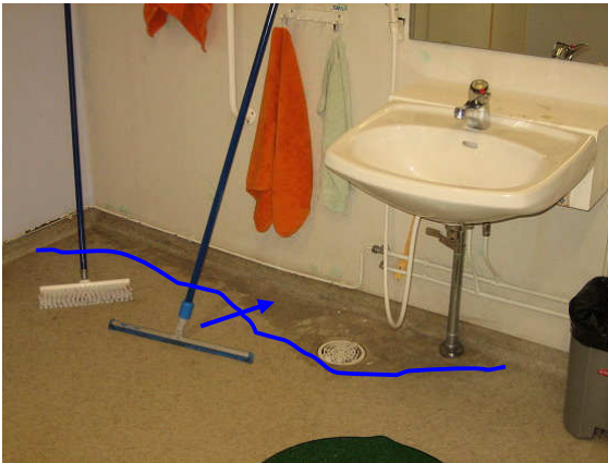
Kuva 5 WC-tilan 23 muovimatto on tummunut voimakkaasti tilan 24 erottavan väliseinän kohdalla. Lattiassa on lisäksi kohonnut kosteus.
