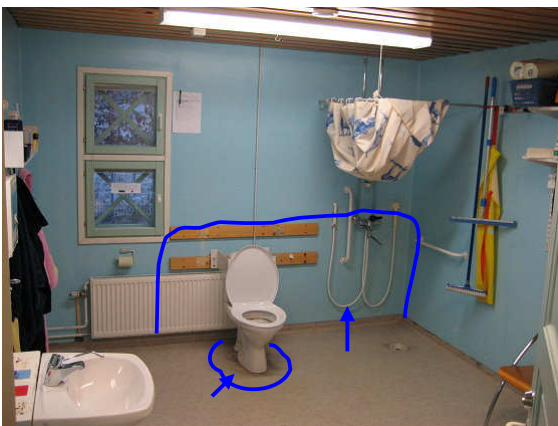
Kuva 1 Pesutila 9. Kostunut alue seinässä. WC-istuimen ympärillä lattiassa on kohonnut kosteus.
