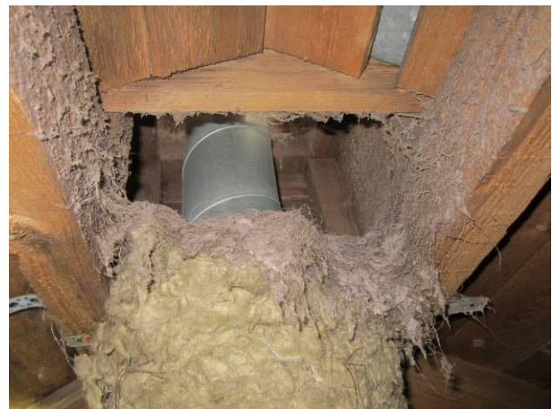
Kuva 8 Suoraan yläpohjan läpi nouseva IV-kanava on viety tuuletuspiippuun.
