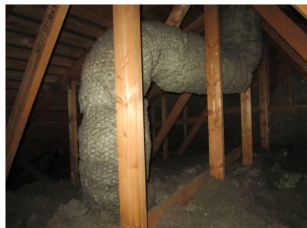
Kuva 10 Työtila 20 viereinen IV-kanava, joka nousee mutkan kautta tuuletuspiippuun.
