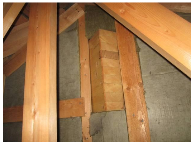
Kuva 20 Työtila 20 liimapuupalkin pää, eristyksissä on vikoja.
