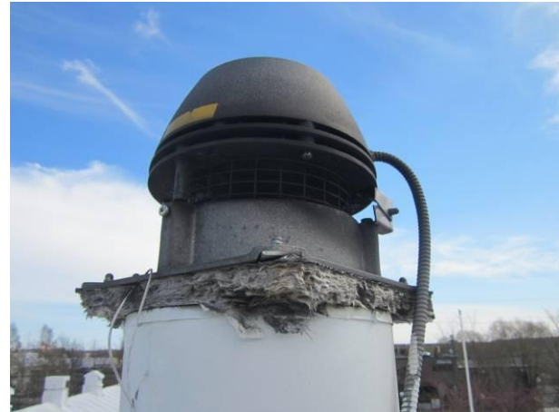
Kuva 34 Takan piipun päässä villa, joka kastuessaan uiittaa vettä piipun vaipan sisälle.
