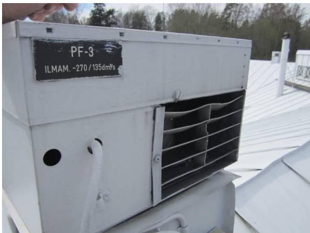
Kuva 35 IV-puhaltimen lamellit ovat väärään suuntaan, pääsee vettä.
