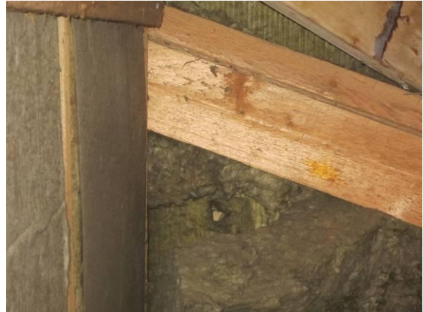
Kuva 22 Vaatetila 24 ulkoseinänurkan eristyksestä oleva reikä.
