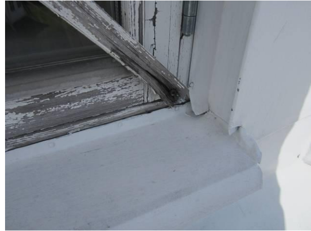
Kuva 38 Pellitysten liittymissä on vuotoreittejä
