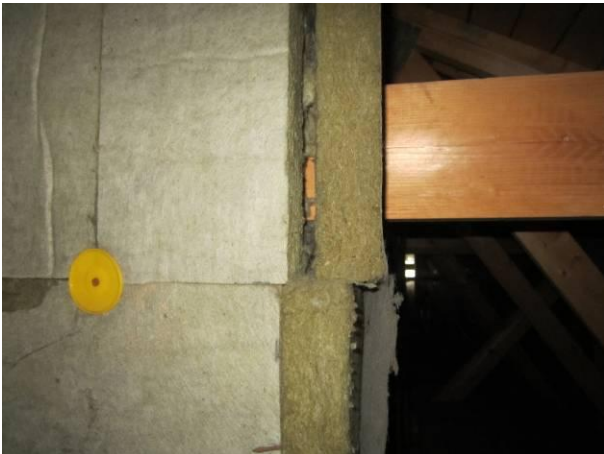
Kuva 17 Tuulensuojavilla on irti pohjastaan
