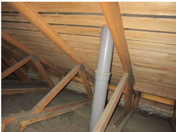
Kuva 7 Eristämätön tuuletusviemäri, joka voi huurtua umpeen.
