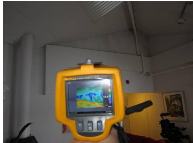
Kuva 4 Lämpökuvassa on selviä kylmiä alueita seinien tummumien kohdalla.
