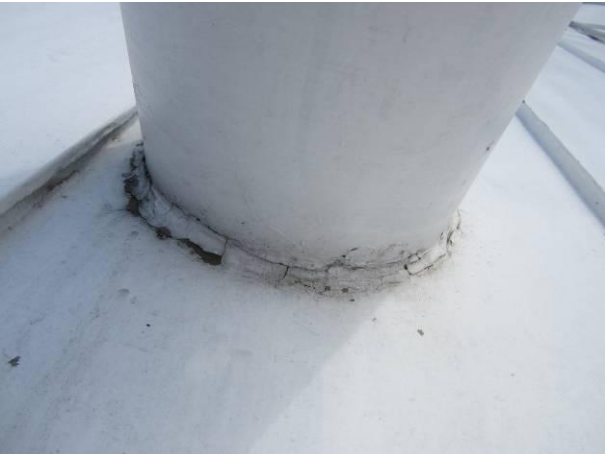
Kuva 33 Takan piipun juurikittaus on halki ja voi jo vuotaa.
