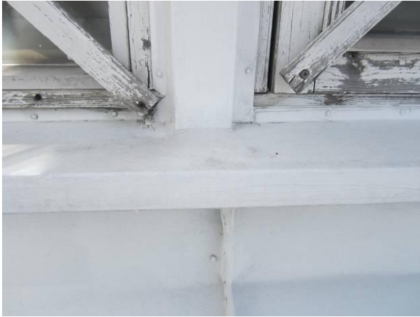
Kuva 37 Kattolyhtyjen ikkunat ovat huonokuntoiset, on rakoja.
