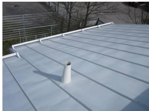
Kuva 30 Lappeella sijaitseva viemärin tuuletusputken läpivienti on vuotoriski
