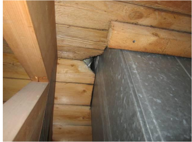
Kuva 6 Vesikatolla olevan IV-puhaltimen kanavan läpiviennin vuotojälkiä.
