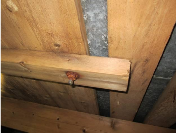
Kuva 5 Kiinnityspulttaus on jo ruostunut, vuotojälkiä.
