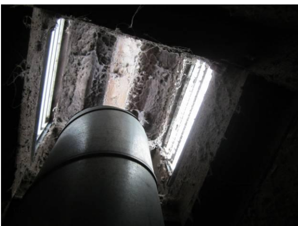
Kuva 9 Tuuletuspiippu on hyvin likainen IV-kanavan päässä, kosteusjälkiä.
