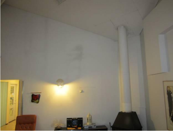
Kuva 1 Vuotojälkiä ja tummentumia.
