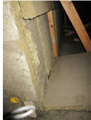
Kuva 18 Tuulensuojavillalevy on irronnut
