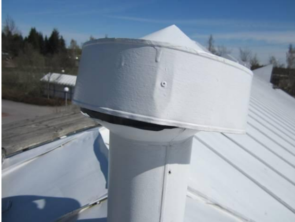
Kuva 31 Viällisen alipainetuulettimen hatun kautta pääsee vettä.
