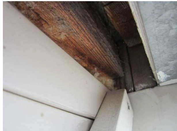
Kuva 40 Ikkunan yläpielen heikko liittymä.
