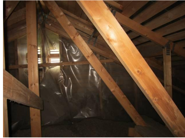
Kuva 12 Päätyventtiili ja muovisuojaus.
