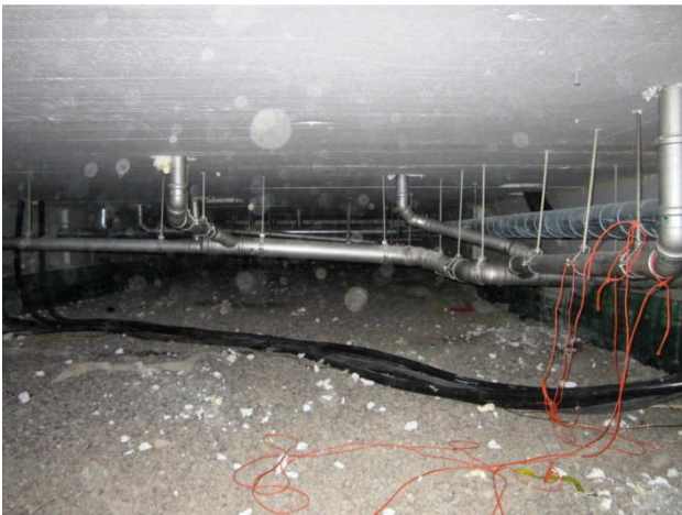
Kuva 22 Keittiön alapuolella viemärit ovat kondensoineet jonkin verran.
