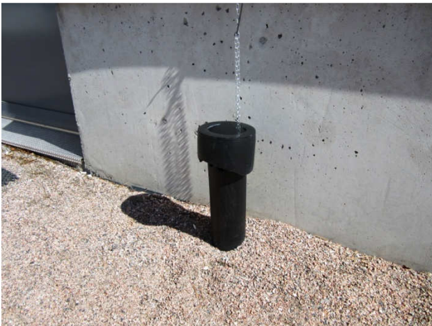
Kuva 9 Tuuletusputken "hattu" lohjennut.
