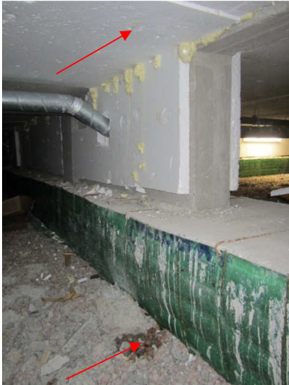
Kuva 3 Alapohjan lämmöneristeen alapinnassa vesipisara. Sepelitäyttö kastunut.
