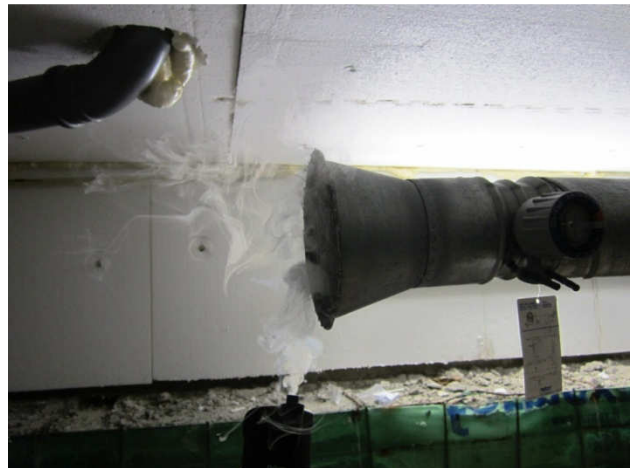
Kuva 10 Lohkoissa 1-3 poistoilmanvaihtokone ei ollut toiminnassa.
