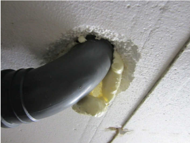
Kuva 20 Puutteellisesti tiivistetty läpivienti.
