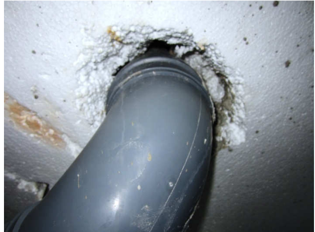
Kuva 21 Tiivistämätön läpivienti lohkossa 6.
