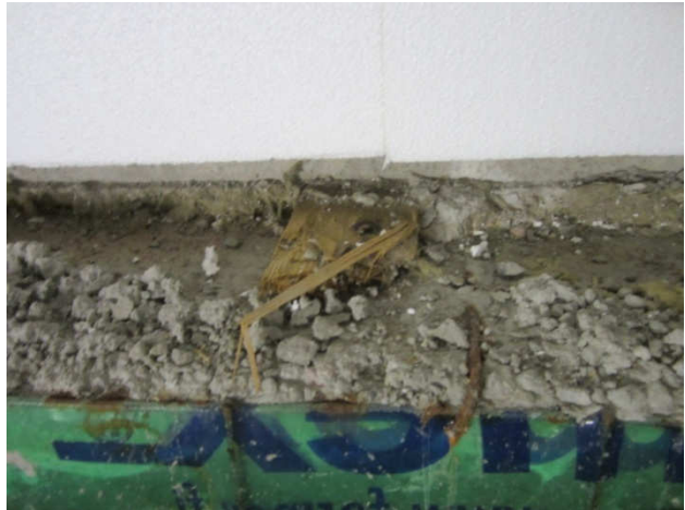
Kuva 4 Perusmuurin valunaikaiset sidepuut poistamatta.
