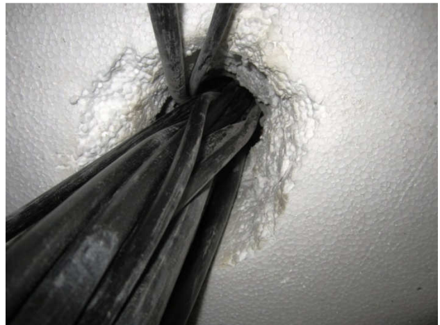
Kuva 23 Tiivistämätön sähkökaapeleiden läpivienti.
