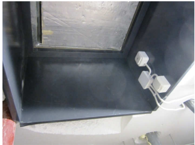
Kuva 2 Käyntiluukun kohdalla pistorasia ja valokytkin.
