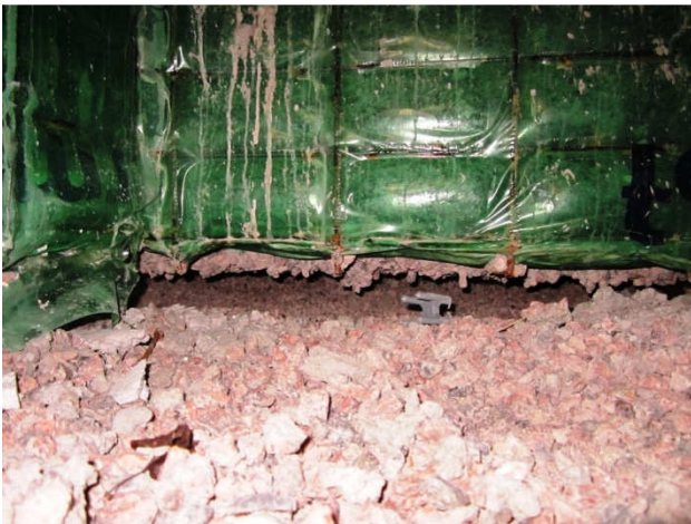
Kuva 19 Maanpinta on painunut, jolloin anturan alle on syntynyt tyhjää tilaa.
