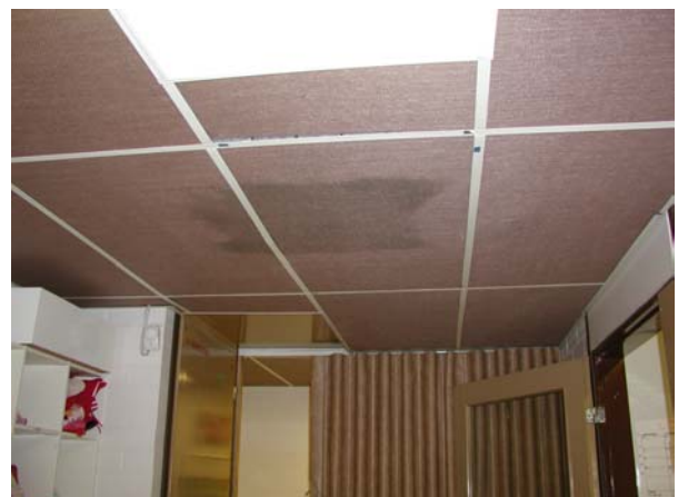
Kuva 6. Kosteusjälki eteishallin kattolevyissä.
