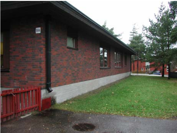
Kuva 7. Syöksytorstesta tuleva vesi roiskii paikoin sokkelille.
