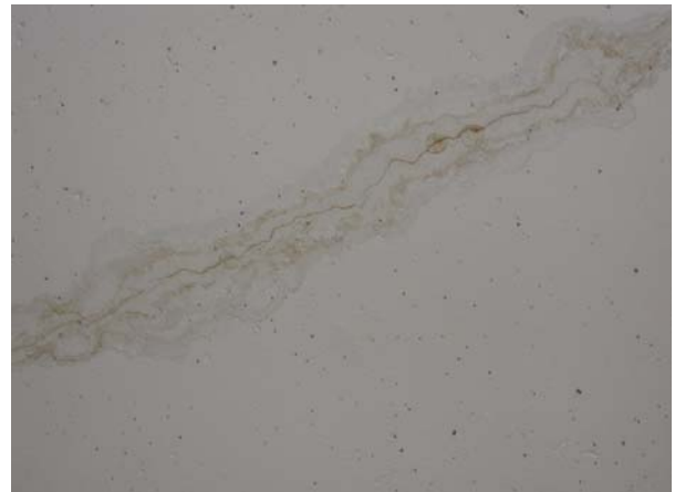
Kuva 5. Halkeama ja kosteusjälki henkilökunnan ruokailuhuoneen katossa.
