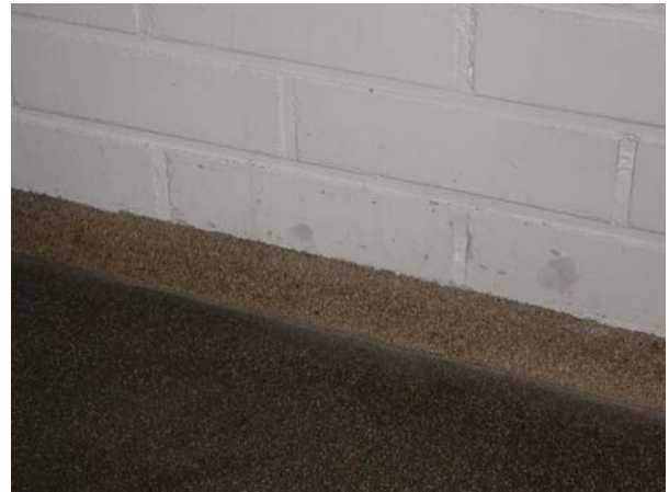
Kuva 8. Keittiön ulkoseinässä tiilen pinnoite on vähäisesti irronnut.
