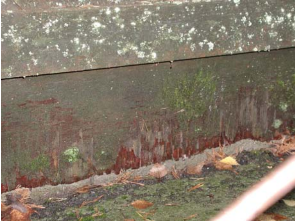
Kuva 1. Jätekatoksen lautaverhoilussa kasvaa sammalta ja vaneri on alaosasta lahonnut.
