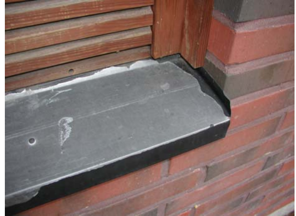
Kuva 4. Ikkunapeltien pinnoite on paikoin irronnut.
