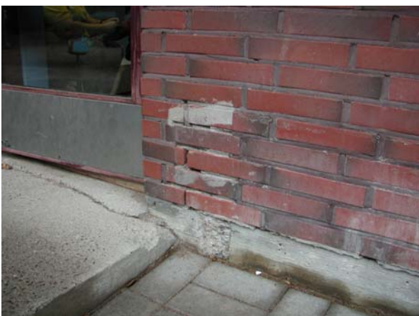
Kuva 3. Tiilisaumat ovat paikoin irronneet.
